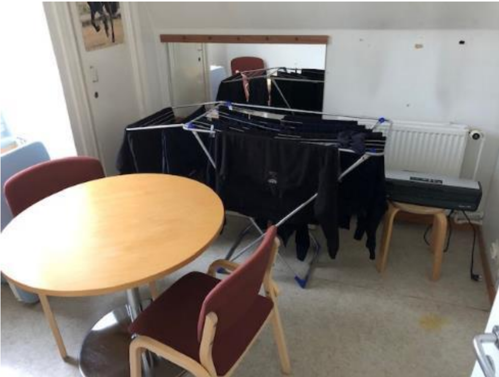
Kuva 4.11. 3393 Persfelt päärakennus / 2.kerroksen huoneessa 201 on märkää pyykkiä kuivamassa.
