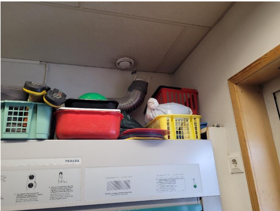
Kuva 5.6. 3081 Lakelan päiväkoti / Kuraeteisen 208 kuivauskaapin poistoputki on irti katosta.
