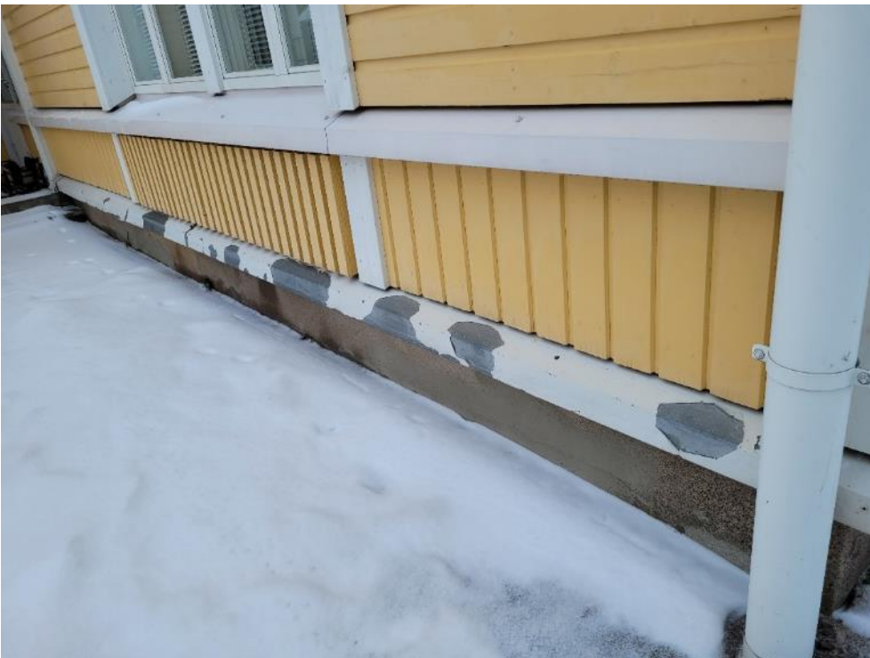
Kuva 4.9. 3081 Lakelan päiväkoti / Sokkelin verhoilurajan reunapellityksistä irtoilee maali.
