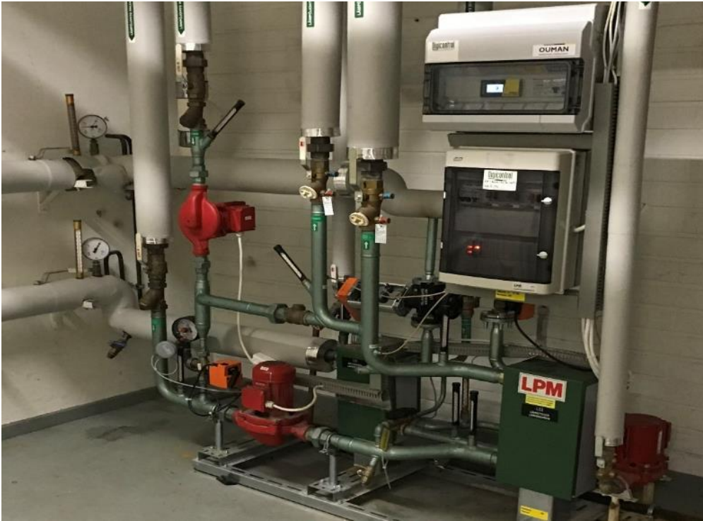
Kuva 6.2. 3081 Lakelan päiväkotia / Lämmönjakokeskus vuodelta 1999 ja lämmityksen uusi säädin.
