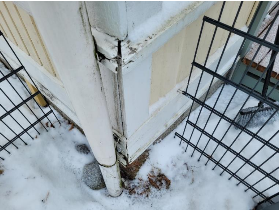
Kuva 4.15. 3393 Persfelt päärakennus / Sokkelin verhoilurajan reunapuut ja kulmalaudoitukset ovat paikoin huonossa kunnossa.
