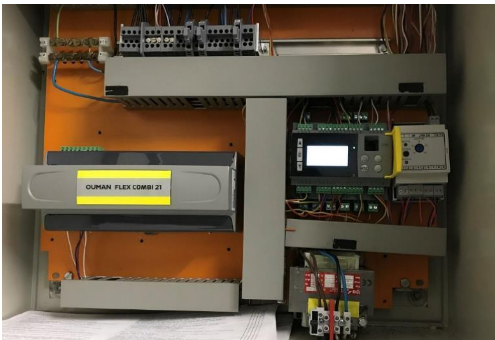
Kuva 6.1. 3081 Lakelan päiväkotia / Rakennusautomaation uusi säädin ilmanvaihdolle.
