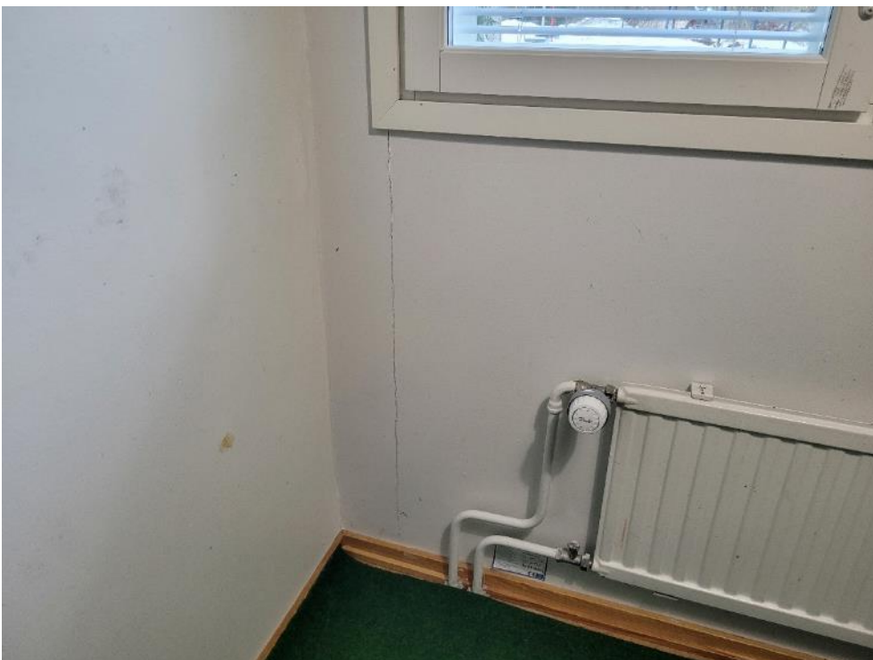
Kuva 4.2. 3081 Lakelan päiväkoti / Tilassa 219 seinän levysauma auennut.
