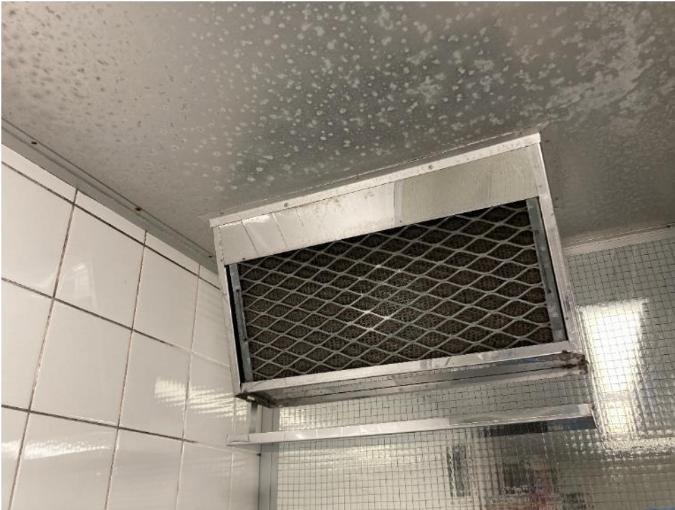
Kuva 5.5. 3081 Lakelan päiväkoti / Keittiön rasvasuodattimet ovat pölyisiä.
