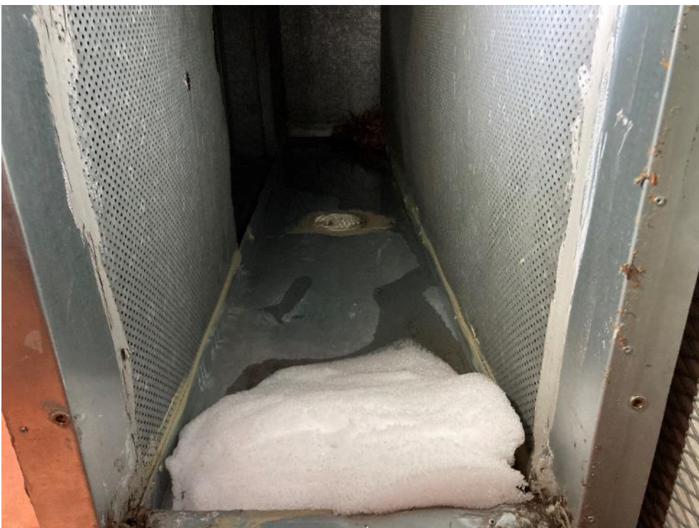
Kuva 5.2. 3081 Lakelan päiväkoti / Ilmanvaihtokoneen raitisilmakammioon pääse lunta sisään.
