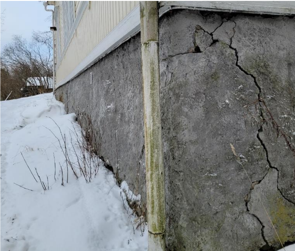
Kuva 4.17. 3393 Persfelt päärakennus / Halkeillutta sokkeliä.
