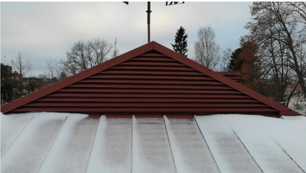
Kuva 5.4. 3081 Lakelan päiväkoti / Ilmanvaihtokoneen raitisilmasäleikön yleiskuva ulkopuolelta kattotasolta.
