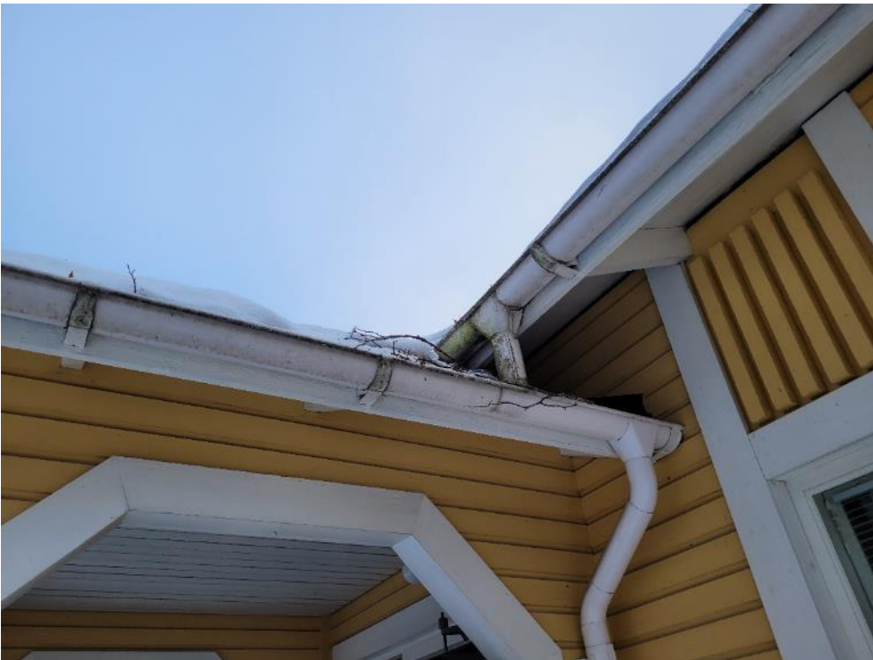
Kuva 4.7. 3081 Lakelan päiväkoti / Vesikatolla ja sadevesikouruissa on roskaa.
