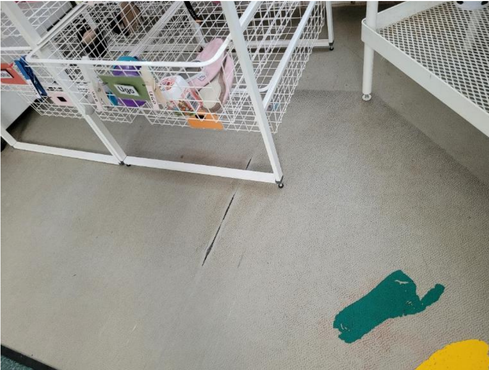
Kuva 4.12. 3393 Persfelt päärakennus / Eteisen 101 lattiamaton saumakohtaa on auki.
