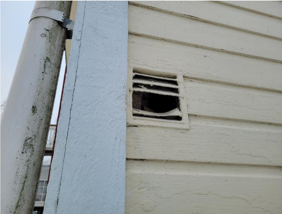
Kuva 4.16. 3393 Persfelt päärakennus / Ulkosäleikkö on vaurioitunut.
