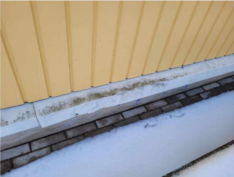
Kuva 4.8. 3081 Lakelan päiväkoti / Sokkelin verhoilurajan reunapellitystä on vaurioitunut.
