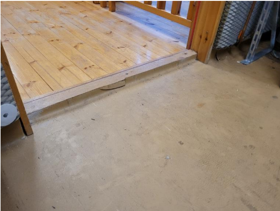
Kuva 4.4. 3081 Lakelan päiväkoti / Ilmanvaihtokonehuoneen 302 kynnyksivaurio.
