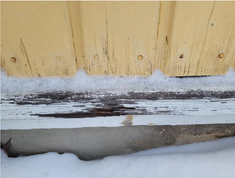
Kuva 4.10. 3081 Lakelan päiväkoti / Sokkelin verhoilurajan reunapuussa on lahovaurio.
