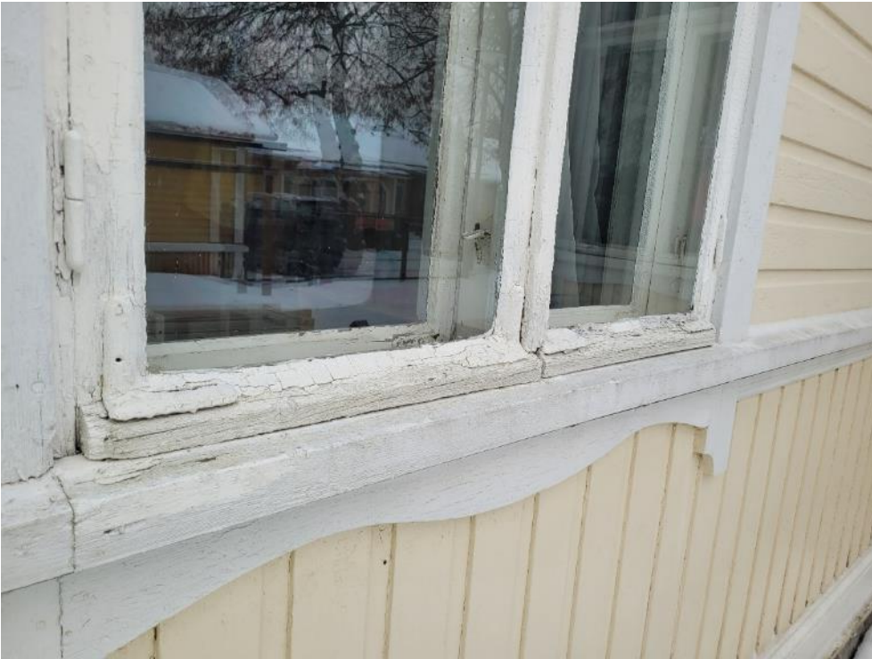
Kuva 4.14. 3393 Persfelt päärakennus / Ikkunat ovat huoltokäsittelyn tarpeessa.
