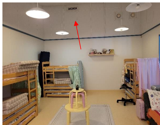
Kuva 2. Tiloissa, jotka koetaan erityisen tunkkaisiksi, tuloilmaventtiilit sijaitsivat seinän yläosassa. Kuva lepo huoneesta 137. Ilmamääriä ei pystytty tilasta mittaamaan.
