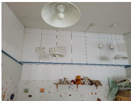
Kuva 3. Lepohuoneessa 154 on kaksi tuloilmaventtiiliä. Ilmamäärät mitattiin ko. huoneesta.
