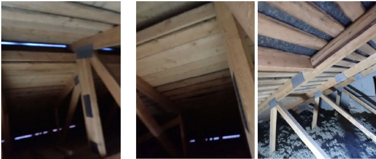
Kuva 32. Yläpohja tuulettuu räystäältä. Peltikatteen alta puuttuu aluskate. Puurakenteet ovat hyväkuntoisia.
