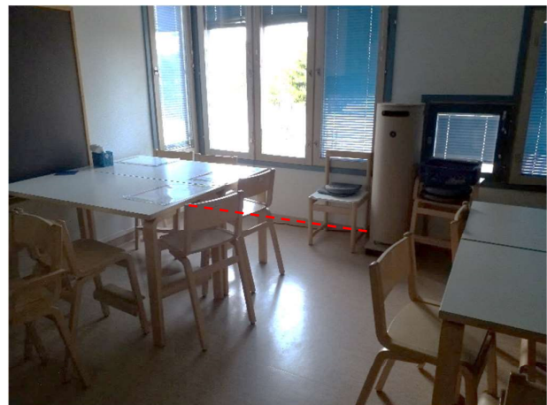
Kuva 20. Tila 102. Merkittävää ilmavuotoa alapohjasta.
