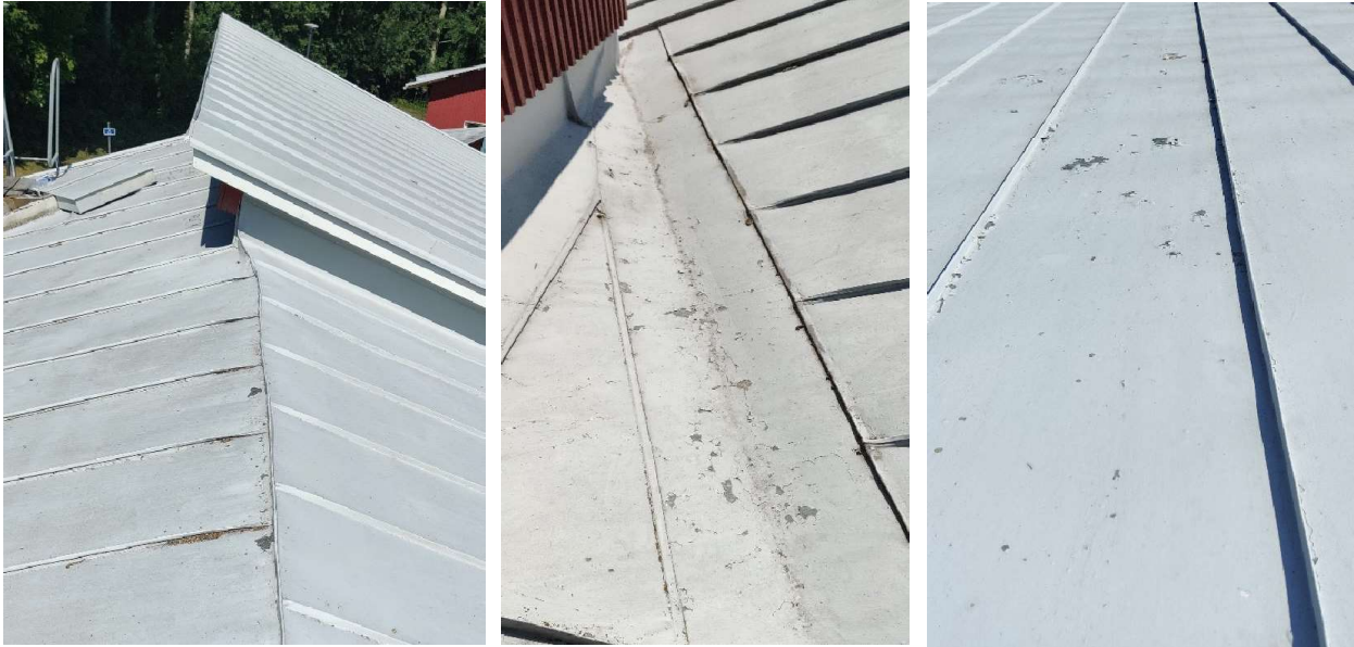
Kuva 31. Peltikatteen maalipinta on paikoin lohkeillut.
