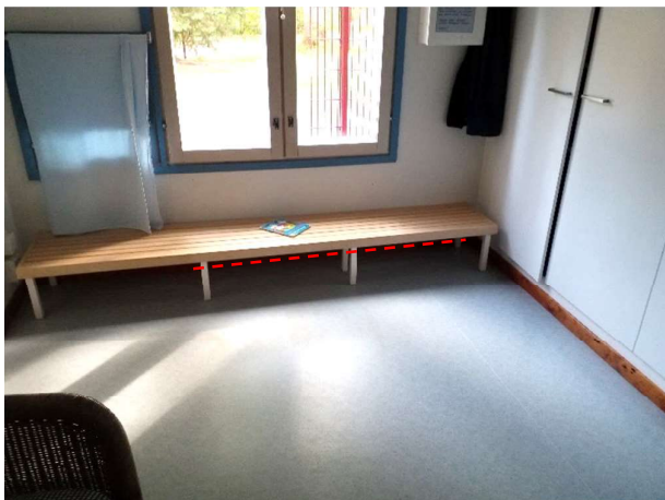
Kuva 19. Tila 107. Merkittävää ilmavuotoa alapohjasta.
