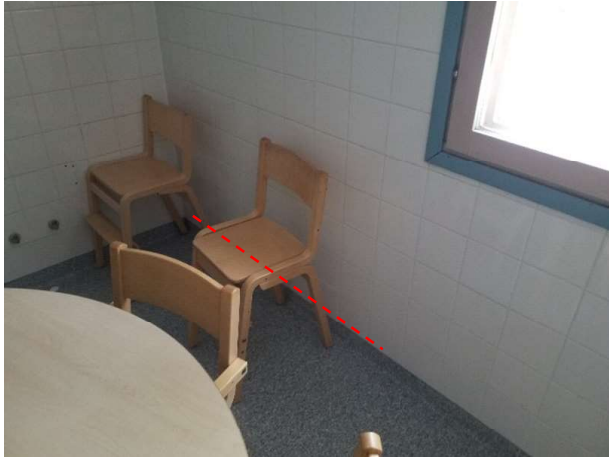
Kuva 17. Tila 141. Merkittävää ilmavuotoa alapohjasta.
