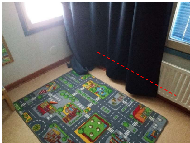
Kuva 13. Tila 154. Merkittävää ilmavuotoa alapohjasta.
