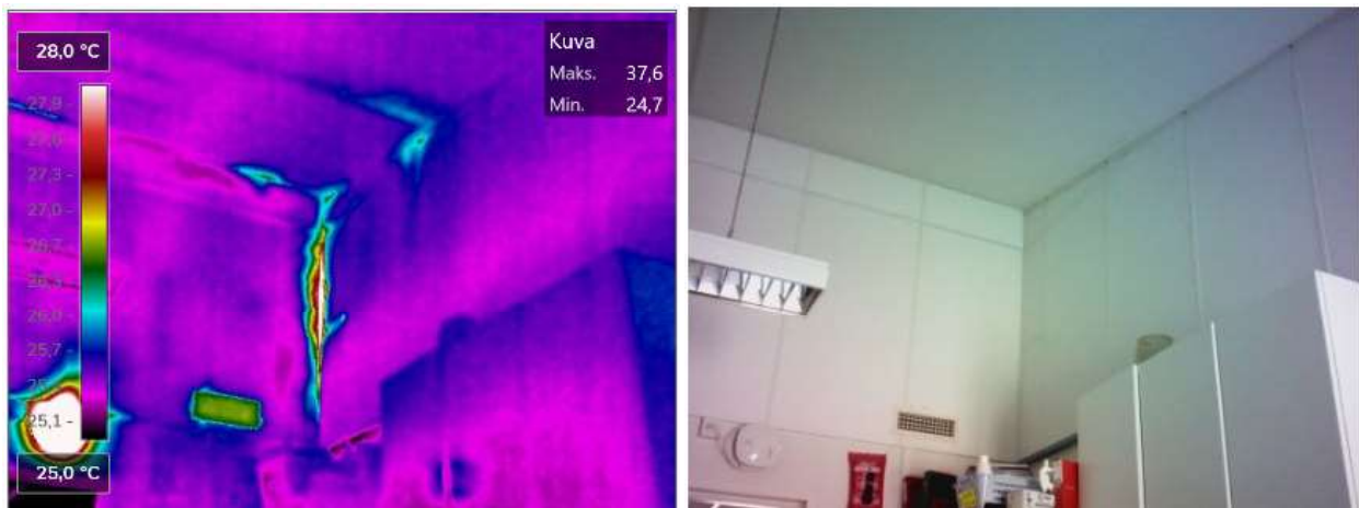
Kuva 39. Ilmavuotoa tilan 102 yläpohjan pystyliittymästä. Lämpökuva vasemmalla ja valokuva oikealla.
