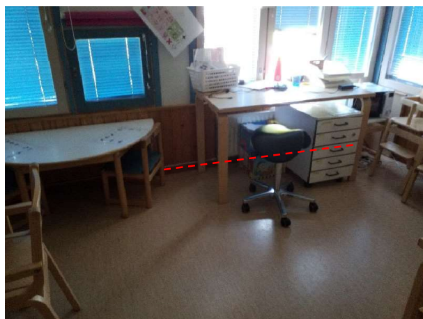
Kuva 14. Tila 155. Merkittävää ilmavuotoa alapohjasta.
