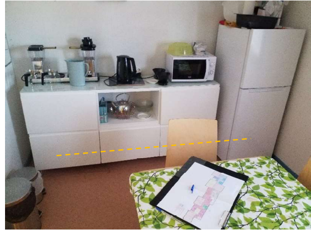
Kuva 18. Tila 136. Vähäistä ilmavuotoa alapohjasta.
