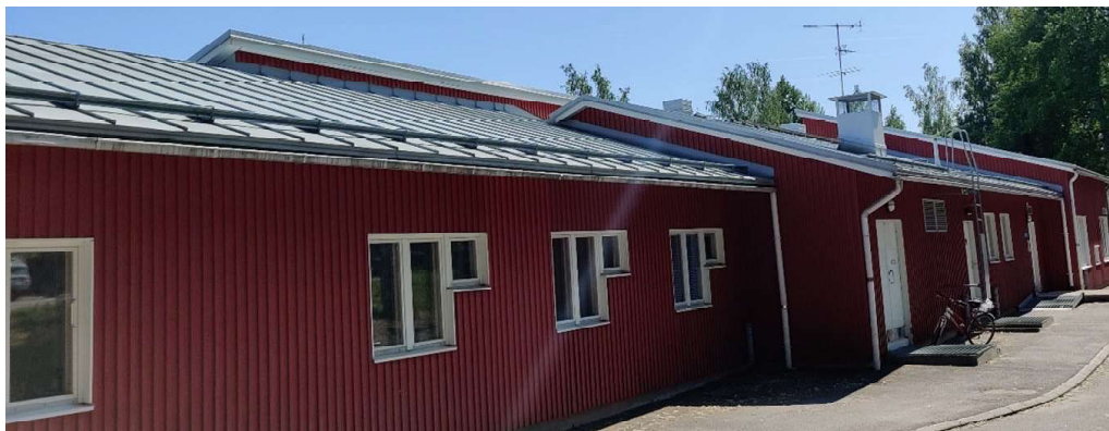
Kuva 30. Yläpohjassa on paljon korkeuseroja.
