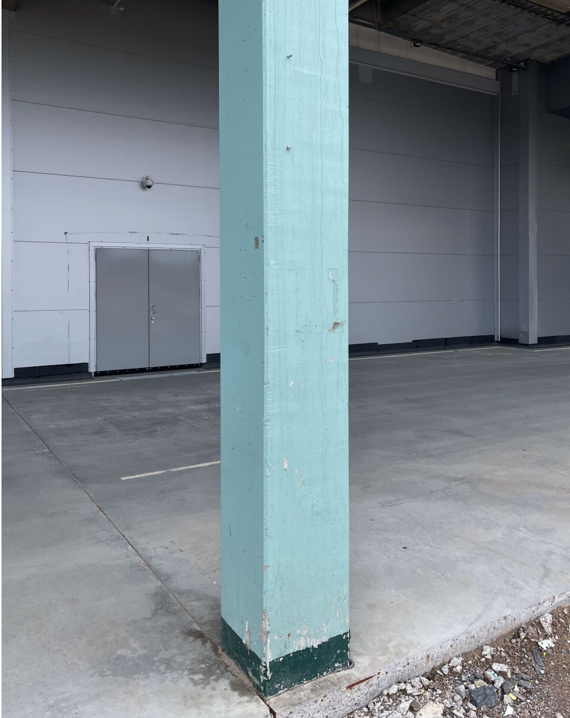
Kuva 10. Itähallin sääsuojaamaton pilari.
