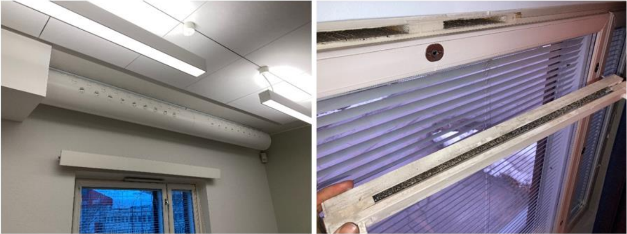
Kuva 5.3. Yleiskuva tuloilmakanavasta ja ikkunan päällä olevasta korvausilmaventtiilistä.
