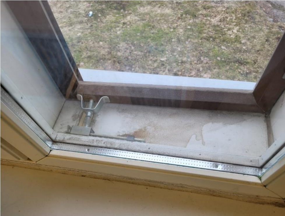
Kuva 4.18. Tilan 113 tuuletusikkunan ulkopuite on auki.
