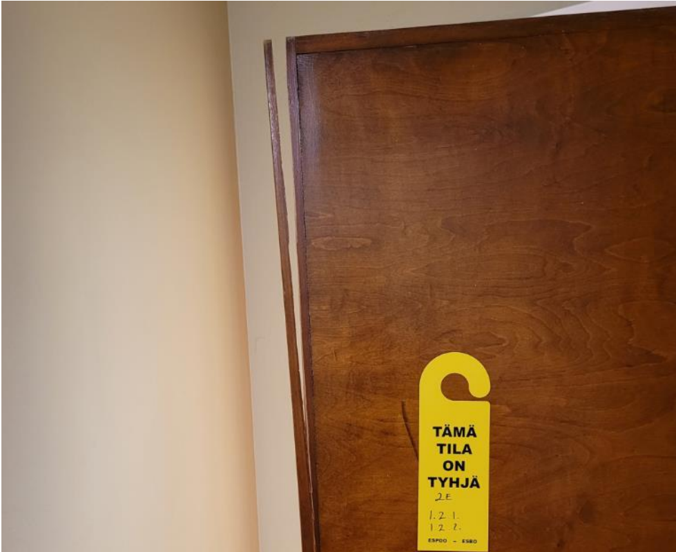
Kuva 4.22. Porrasaulan ja 121 välioiven reuna on lohjennut irti.
