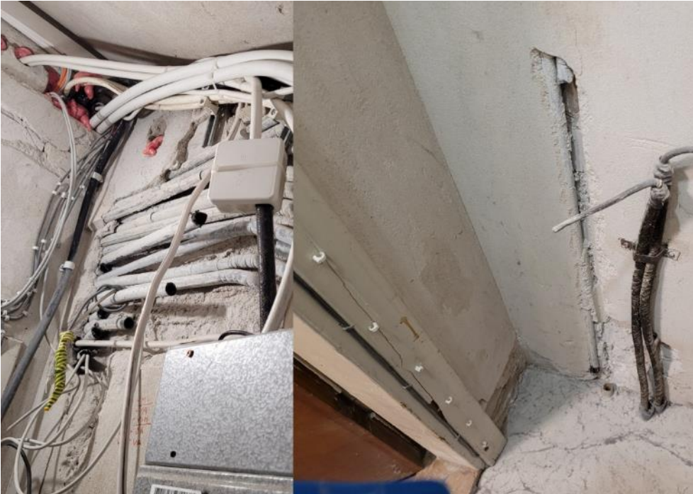
Kuva 4.20. Sähkökeskuksessa 118 on vielä tiivistämättömiä kaapeliläpivientejä.
