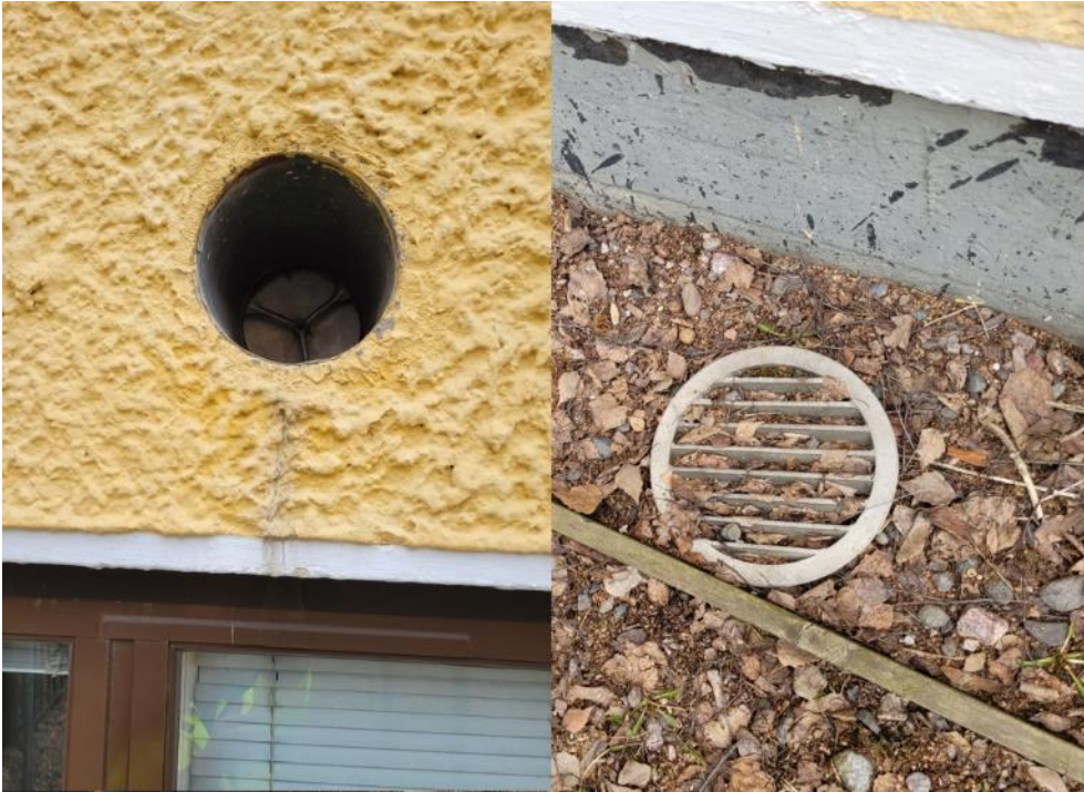
Kuva 4.32. Korvausilmakanavan ulkosäleikkö on irronnut.
