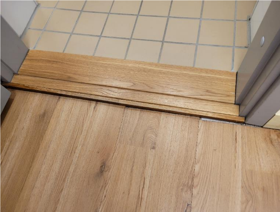
Kuva 4.16. WC:n 105 kynnyksen edessä lattiapinnoite on vajaa.
