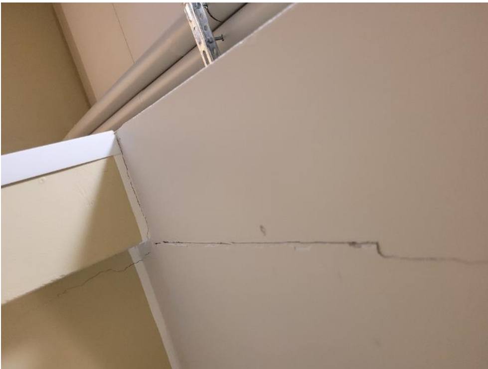
Kuva 4.13. Tilan 100 katossa ja seinässä Porrasaulan vieressä on halkeama.
