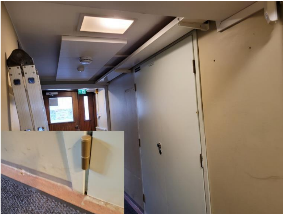
Kuva 4.15. Tilan 100 seinällä ja lattiassakin on pintavaurioita ja koloja.
