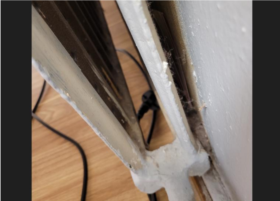
Kuva 4.12. Lämpöpattereiden takana ja väleissä on pölyä sekä likaa. Kuvassa Tila 214.
