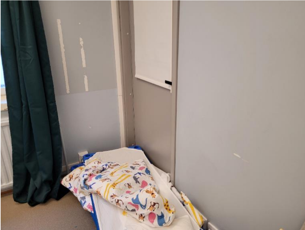
Kuva 4.4. Tilassa 213 seinäpinnassa on vaurioita.
