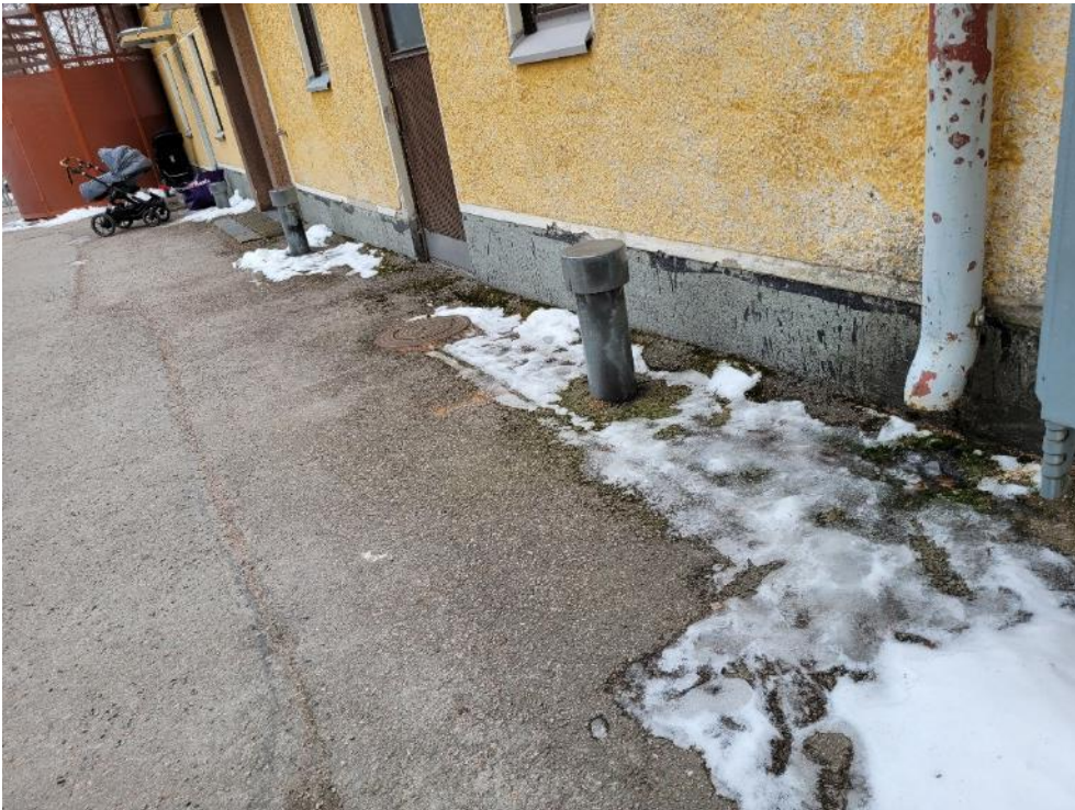
Kuva 4.27. Syöksytorven kohdalla sadevettä kertyy seinän vierelle.
