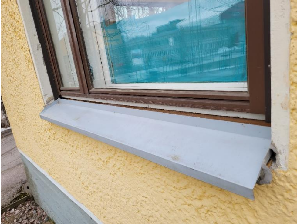
Kuva 4.24. Ikkunapelti on irti.
