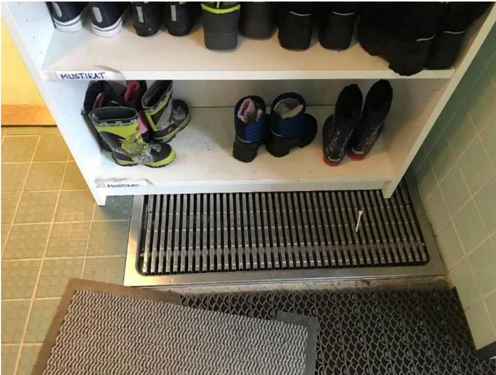
Kuva 5.5. Kuraeteisen allashana on poistettu ja kura-altaan vesilukkoa ei pääse täyttämään.
