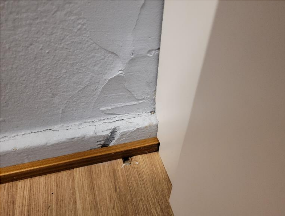
Kuva 4.6. Tilassa 214 lattia-seinärajassa on reikiä.
