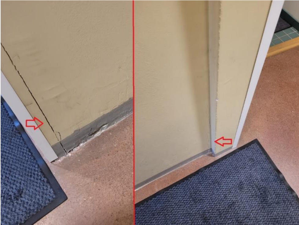
Kuva 4.14. Porrasaulan ja tilan 100 välisessä seinäkulmassa on halkeama.
