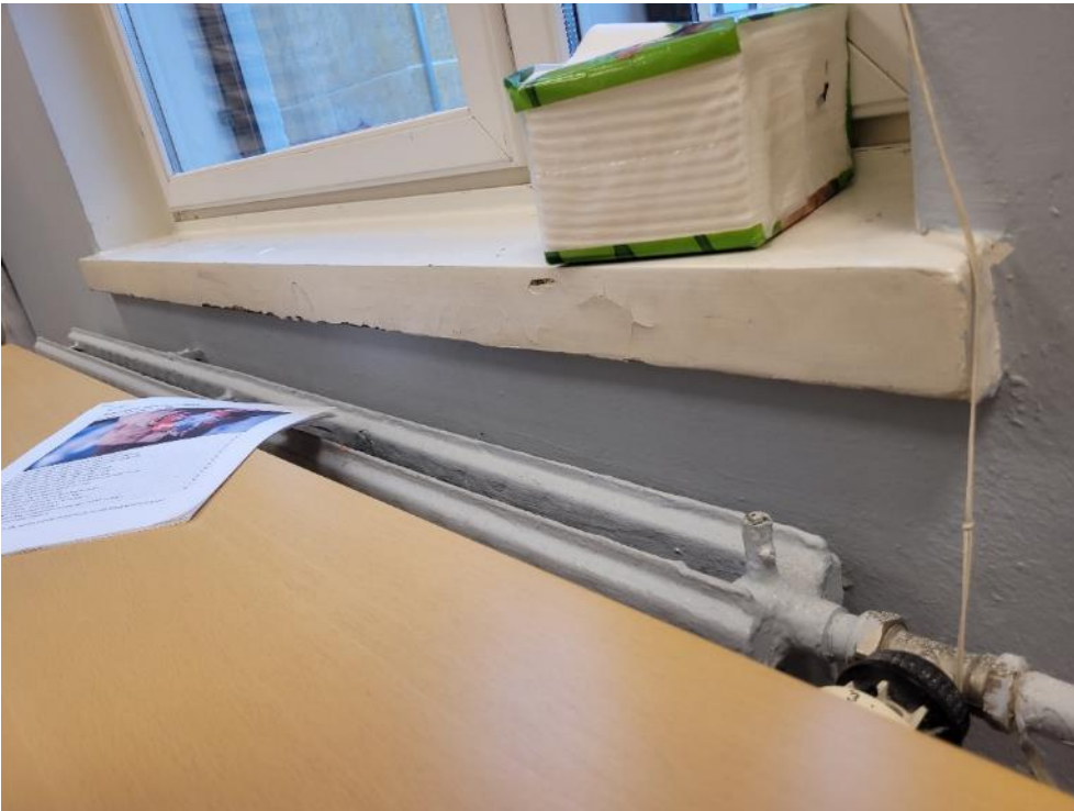
Kuva 4.7. Tilassa 214 ikkunapenkin reuna on huonossa kunnossa.
