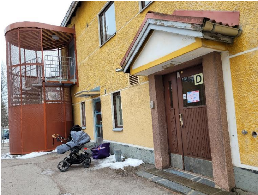
Kuva 4.29. Sisääntulokatoksen räystääslautoitus on lahonnut.
