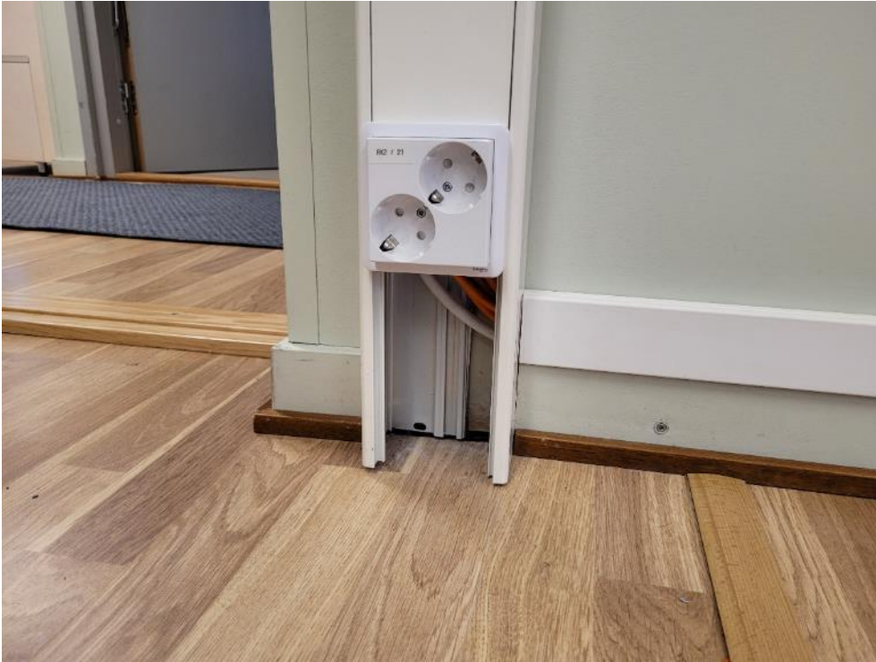
Kuva 4.10. Tilassa 225 johtokanavan kansipala puuttuu pistorasian alapuolelta.
