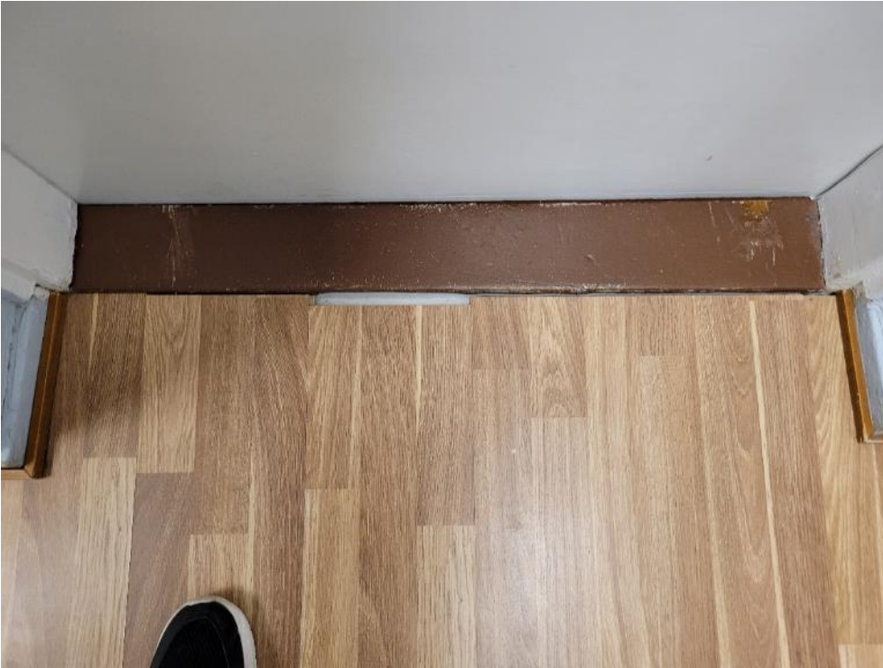
Kuva 4.2. Tilan 211 kynnyksen edessä lattiapinnoite on vajaa.
