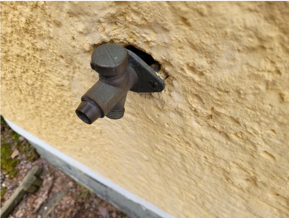
Kuva 4.31. Ulkovesihanan seinäliittymä on tiivistämättä.
