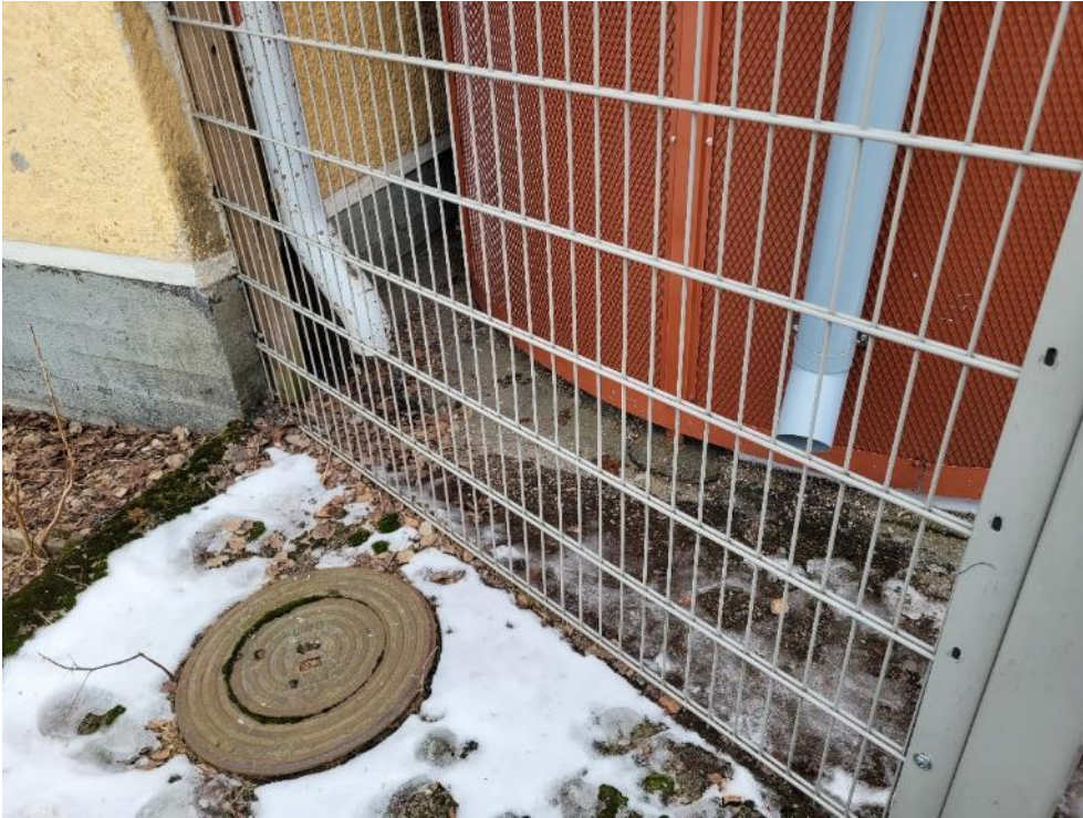
Kuva 4.26. Syöksytorvista sadevesi ei ohjautu hyvin pois rakennuksen kulmalta.
