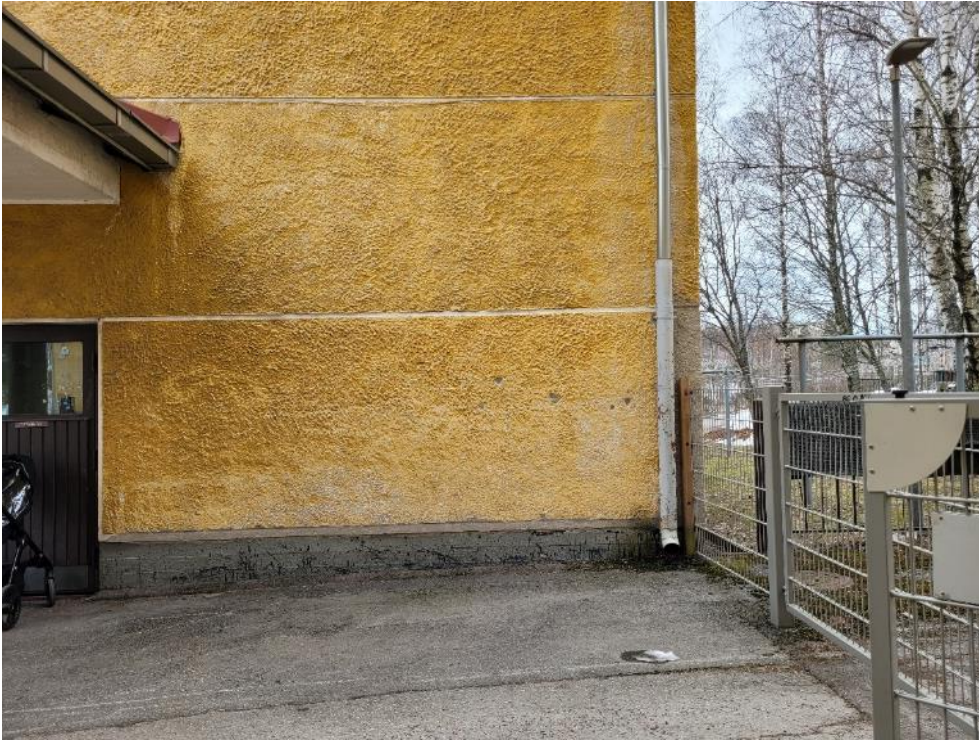
Kuva 4.28. Syöksytorvesta sadevesi ei ohjautu hyvin pois rakennuksen kulmalta.
