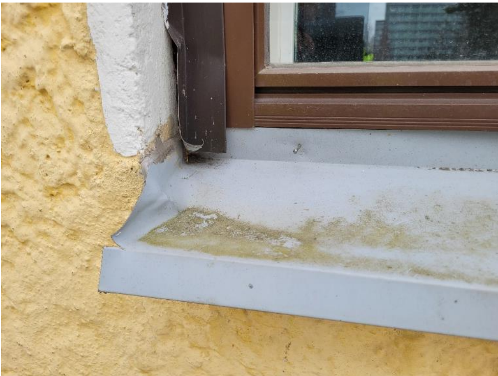
Kuva 4.25. Ikkunapellitys on vaurioitunut kulmassa.
