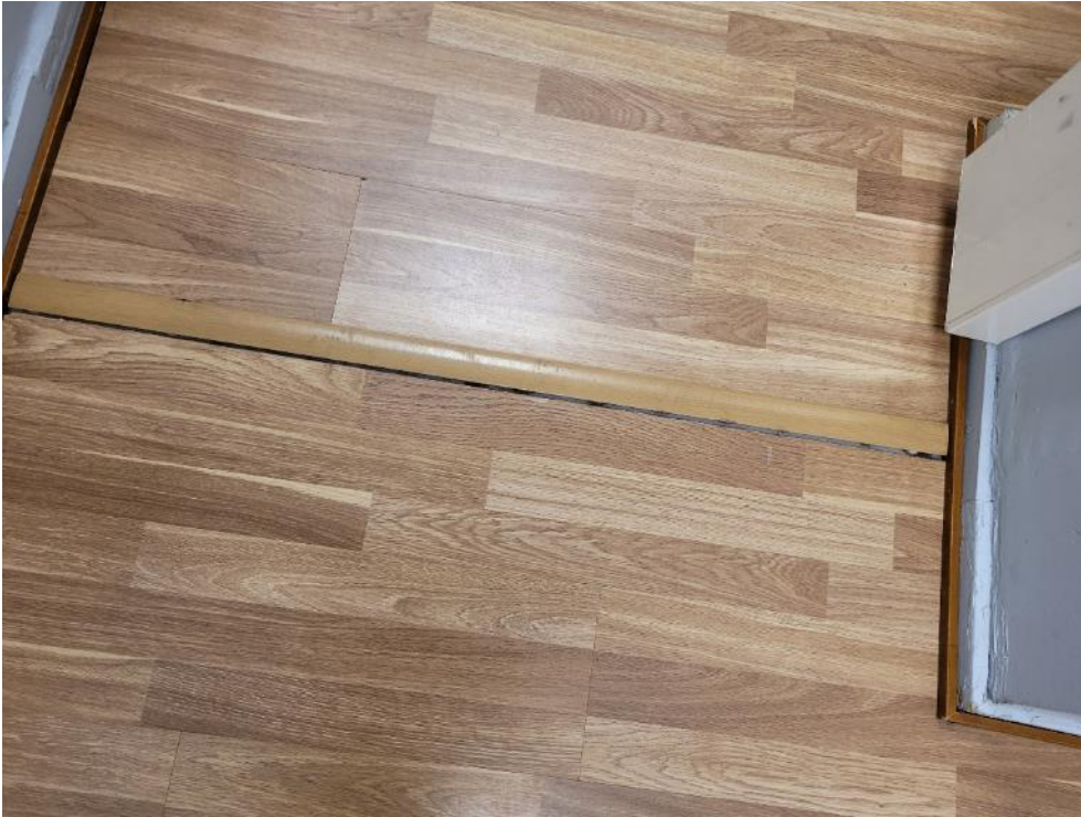
Kuva 4.8. Aulan 218 lattian liikuntasäuma irvistää listan alta.
