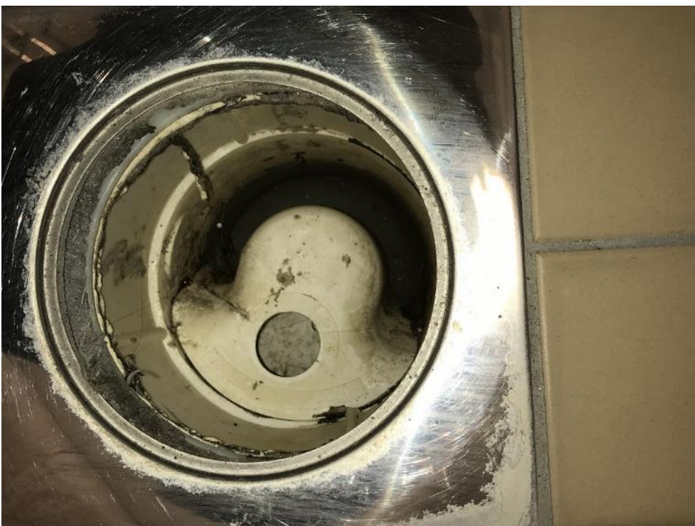
Kuva 5.6. Suihkutilan 123 lattiakaivo on tyhjä ja tulppa puuttuu.
