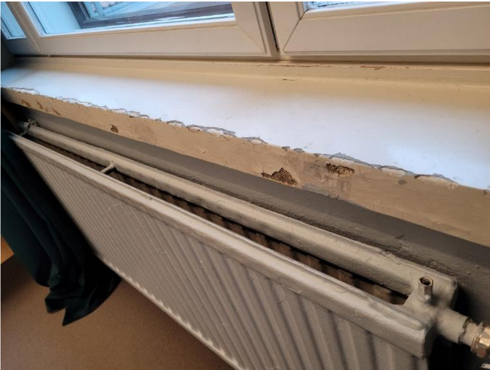
Kuva 4.3. Tilassa 213 ikkunapenkin reuna on huonossa kunnossa.
