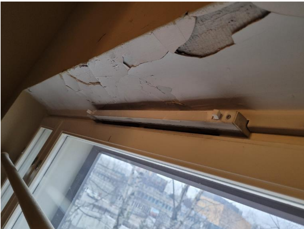
Kuva 4.23. Portaikon ylimmän ikkunan yläsmyygirappaus on irti.
