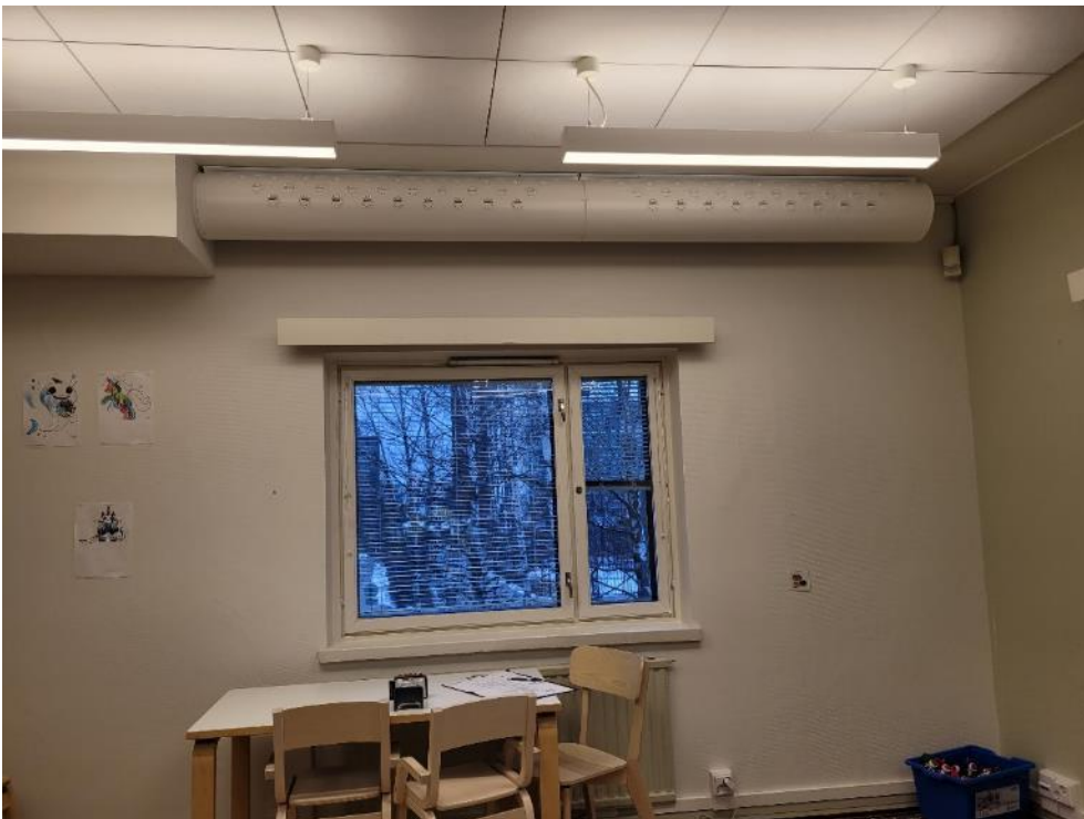
Kuva 4.9. Tilassa 225 hätäpoistumistien kyltti puuttuu.
