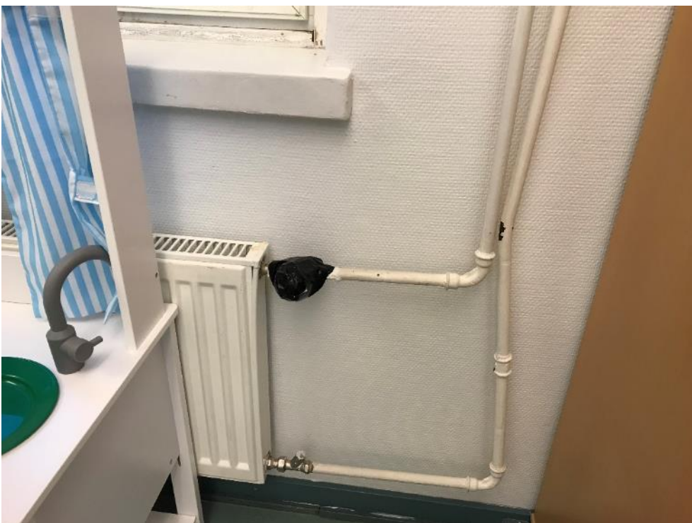
Kuva 5.8. Tilan 113 patteritermostaatti puuttuu ja patteriputki on vääntynyt.
