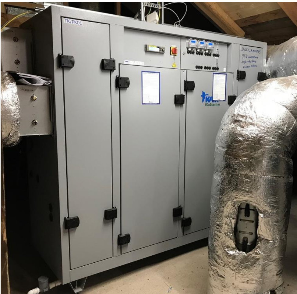
Kuva 5.2. Joitakin vuosia sitten uusittu ilmanvaihtokone TK/PK01 Ullakolla.
