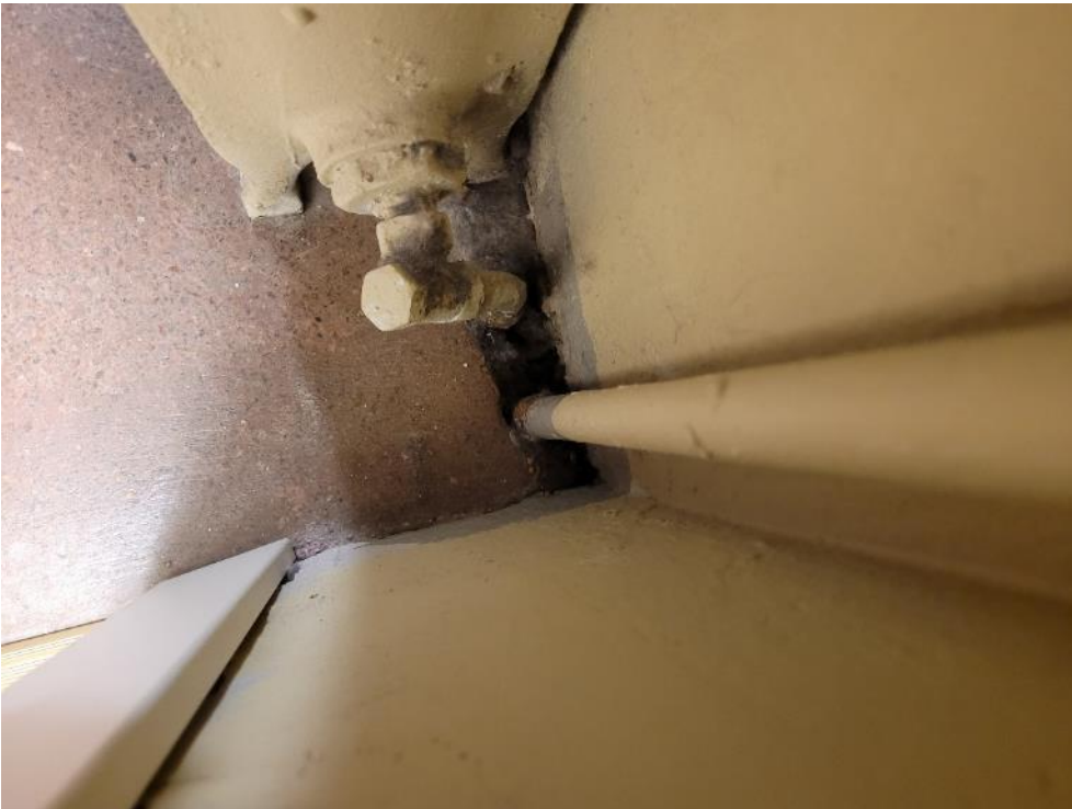
Kuva 4.17. Pohjakerroksen Porrasaulan lämpöpatterin sivulla lattiakulmassa on kolo.
