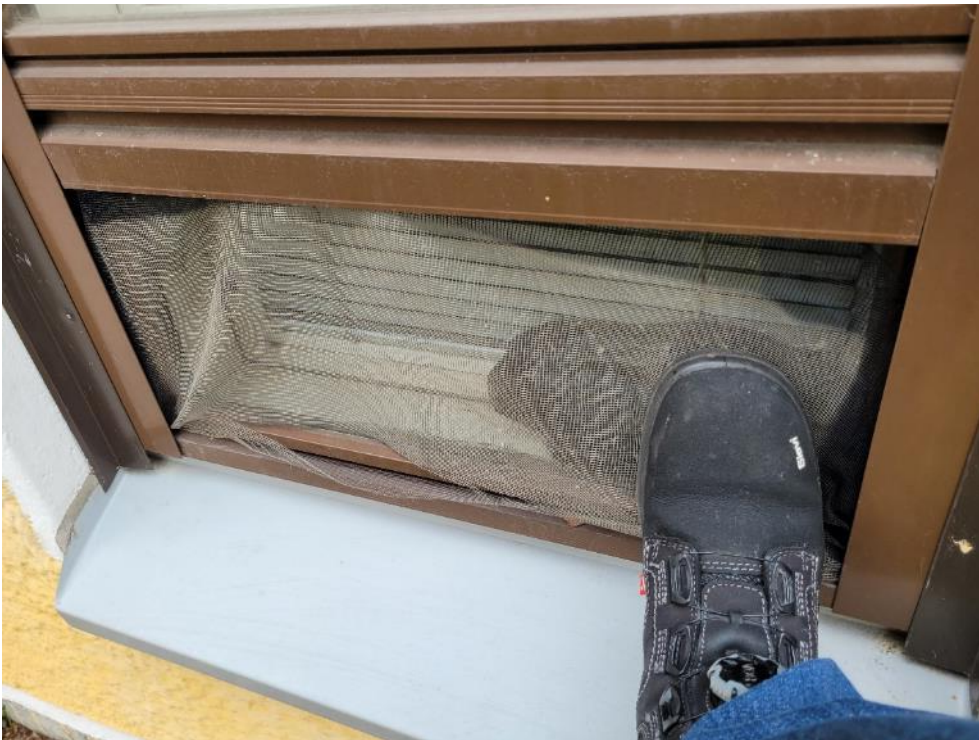
Kuva 4.33. Päädyn tuuletusikkunan oikeanpuoleinen ulkopuute jää auki.
