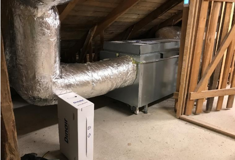
Kuva 5.1. Ullakolla sijaitsevan TK/PK02 ilmanvaihtokoneen ohjauslaite ei toimi.
