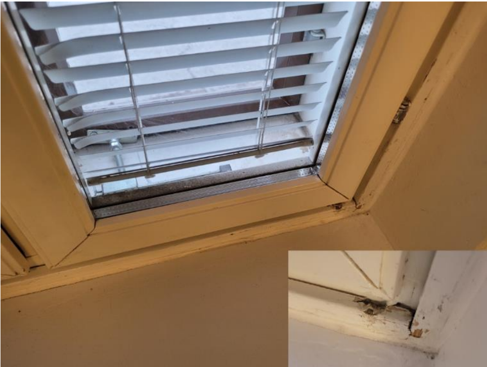
Kuva 4.19. Keittiön 114 tuuletusikkunassa on jälkiä vesivuodosta.
