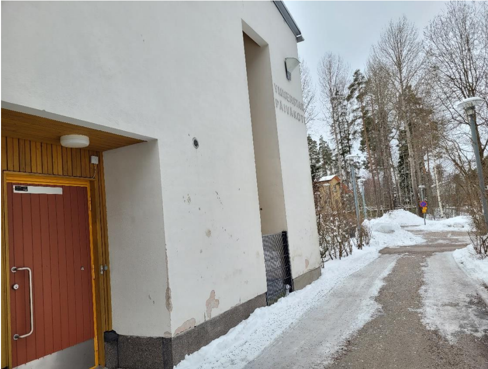
Kuva 4.13. Rappausvaurioita näkyvällä paikalla A-osan tekniikkatilojen päädyssä.
