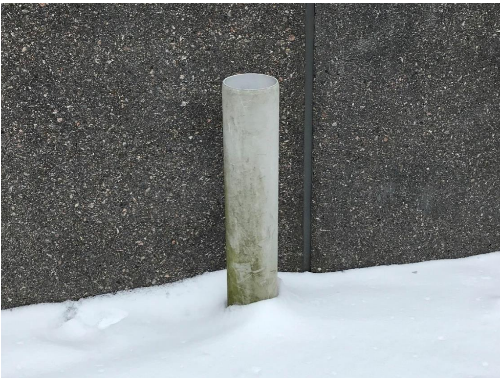
Kuva 5.8. Alapohjan tuuletusputken suojahattu puuttuu.
