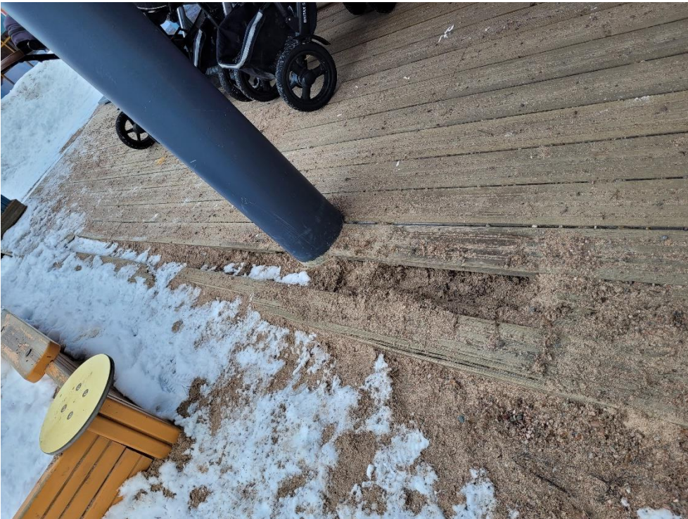
Kuva 4.6. B-osan päädyn terassilla kompastumisvaara.
