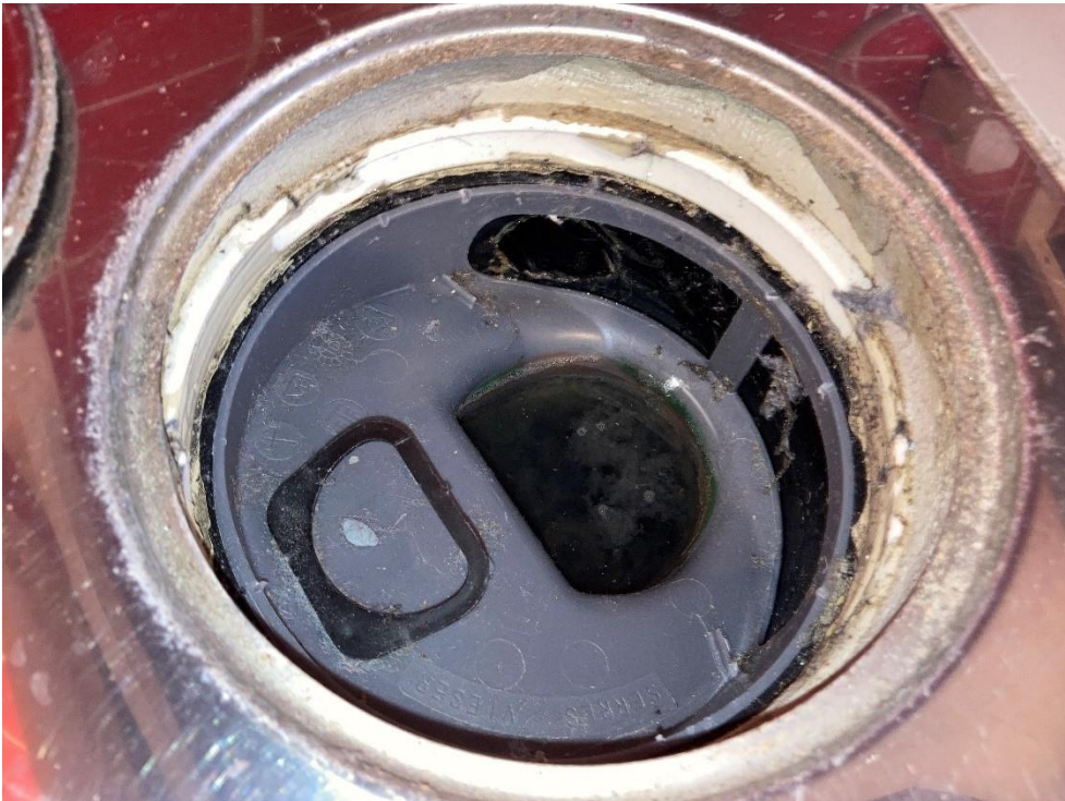
Kuva 5.6. Usean lattiakaivojen sisäosat ovat irti tai eivät ole työnnetty tarpeeksi tiiviisti paikalleen.
