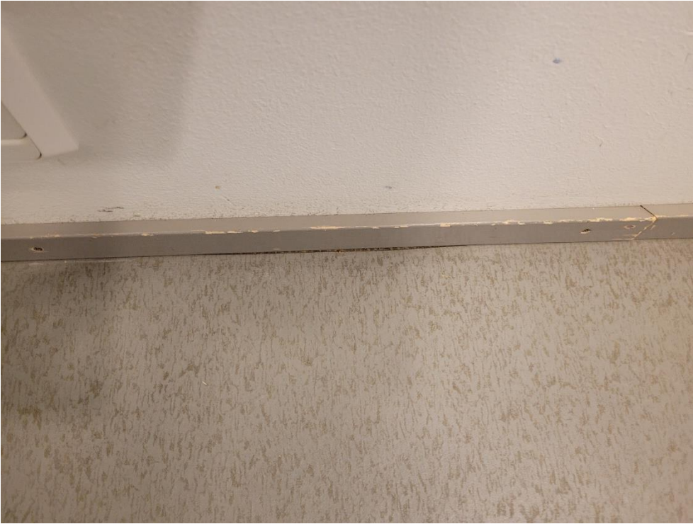
Kuva 4.3. Tilassa 141 vajaa mattoraja, oven vastakkaisella ulkoseinällä.
