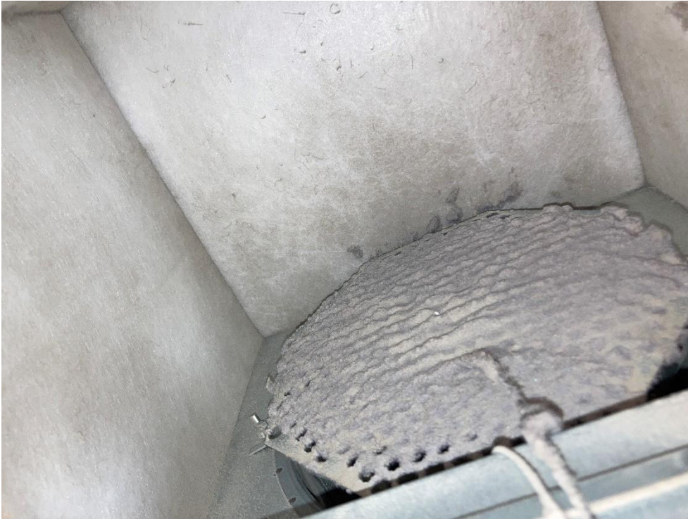
Kuva 5.3. Ilmanvaihdon poistoilman päätelaite pölyinen.
