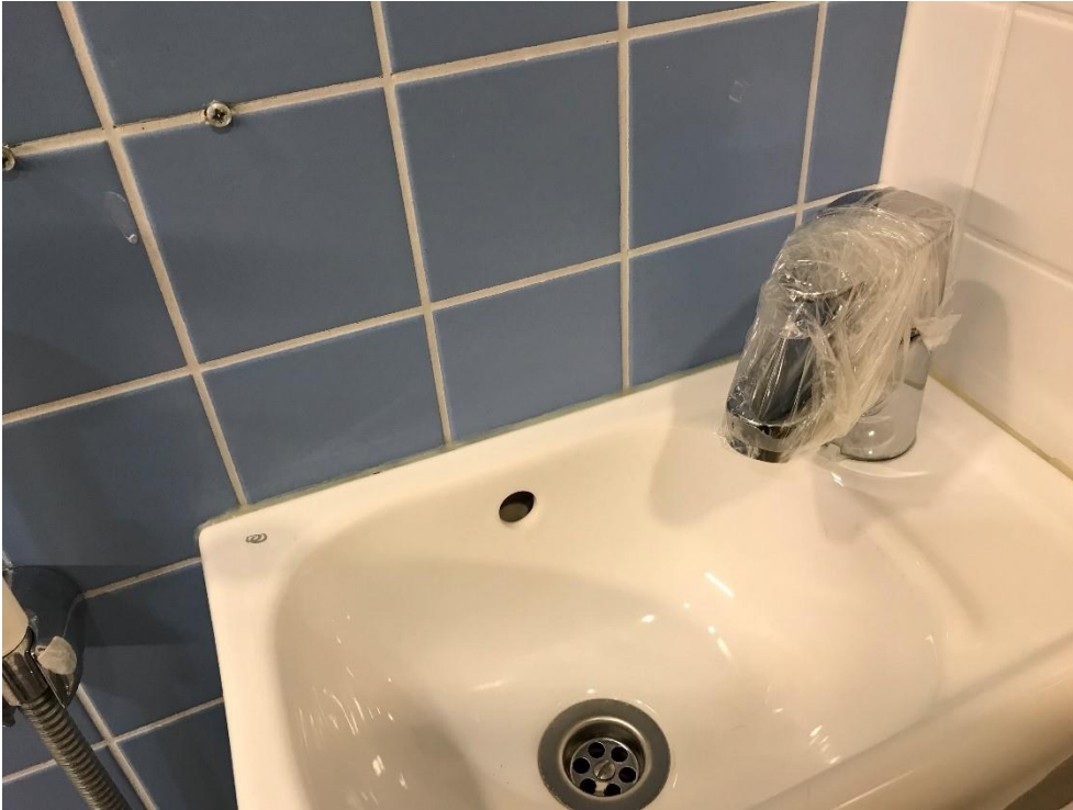
Kuva 5.5. Pesutilan 139 allashana on teipattu kiinni.
