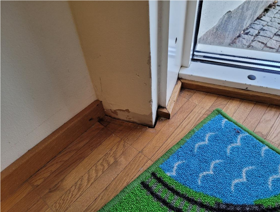
Kuva 4.5. Tilassa 123 ulkoseinäikkunakulmassa puuttuvia jalkalistapaloja.
