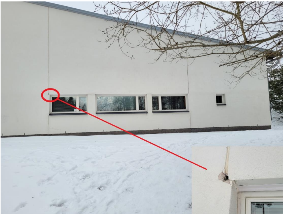
Kuva 4.10. B-osan sivulla seinäaurio ikkunanurkassa.
