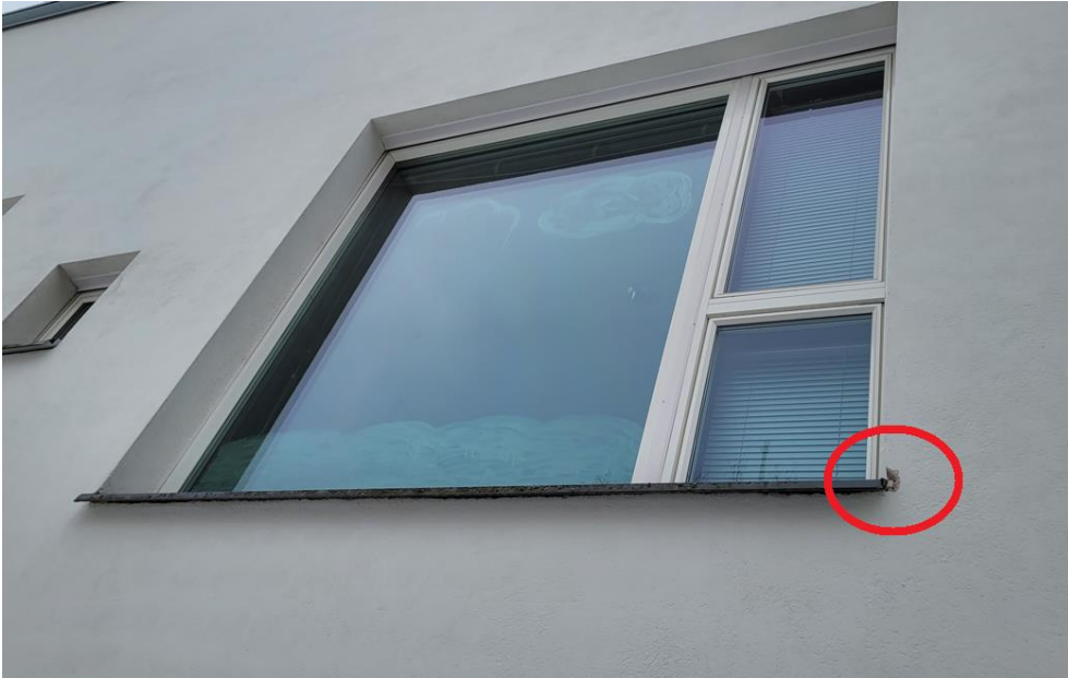
Kuva 4.11. A-osan huoltotiesivulla seinäaurio ikkunakulmassa.
