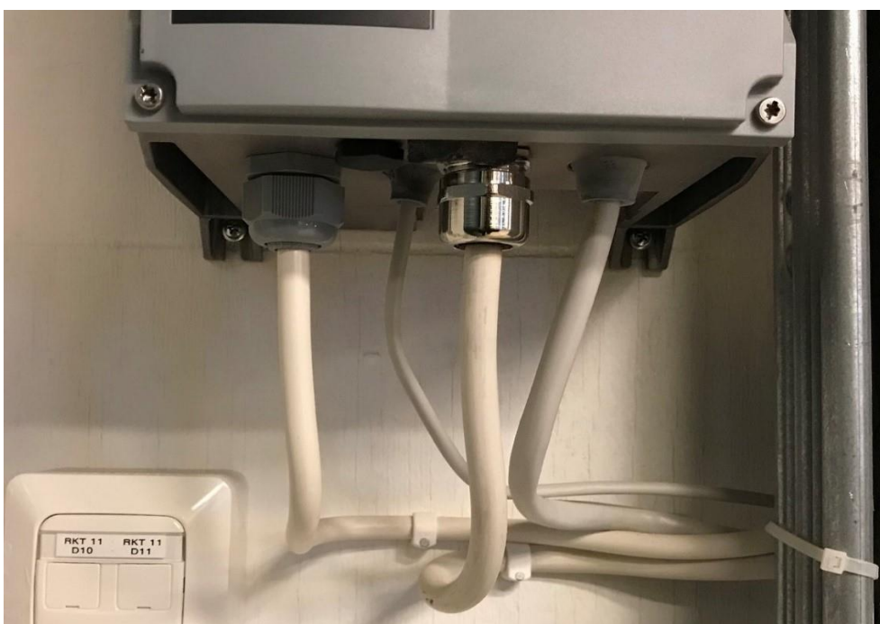
Kuva 6.2. Taajuusmuuttajien EMC-suojaus puutteellinen.
