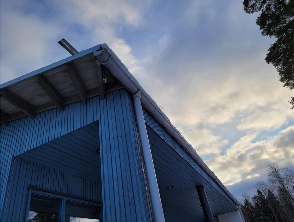
Kuva 4.7. B-osan päädyssä sadevesi tulee sadevesikourun yli päädystä ja sivuilta.
