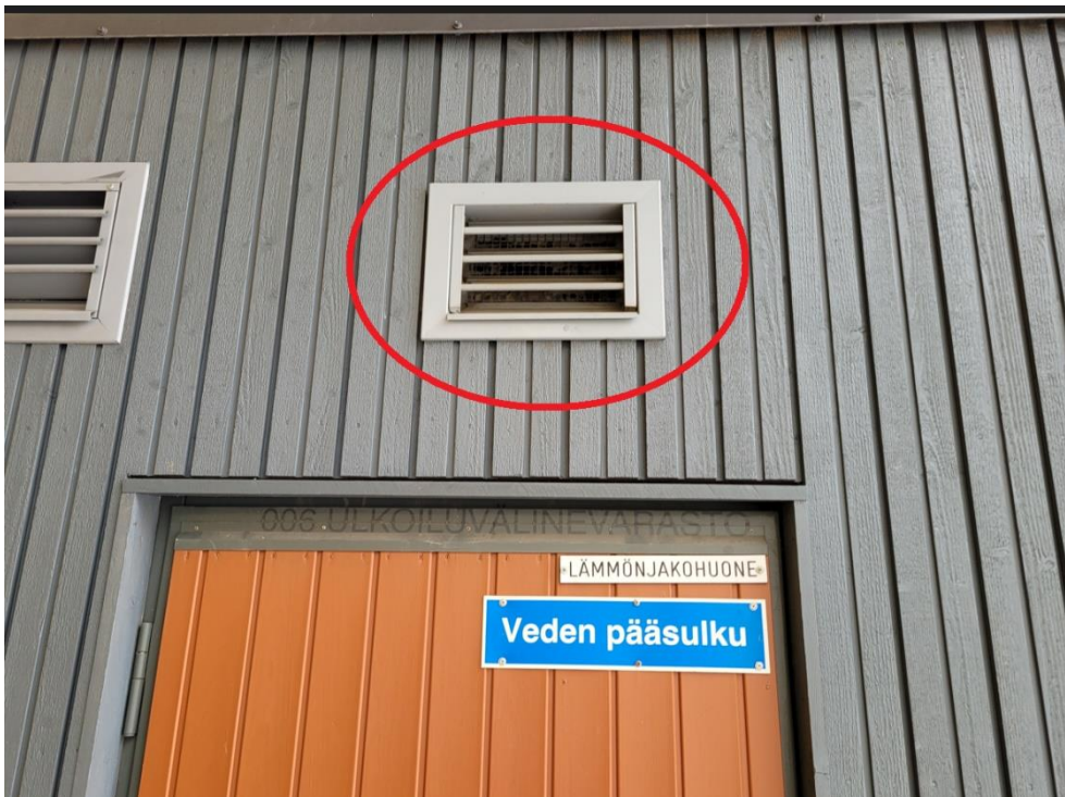
Kuva 4.14. Ulkovaraston 006 ilmasäleikkö oven yläpuolella lähes tukossa.
