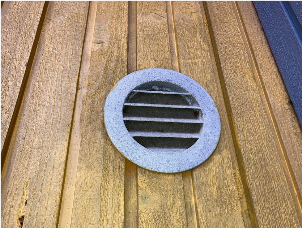
Kuva 5.7. Korvausilmaan tarkoitettu säleikkö tukossa.
