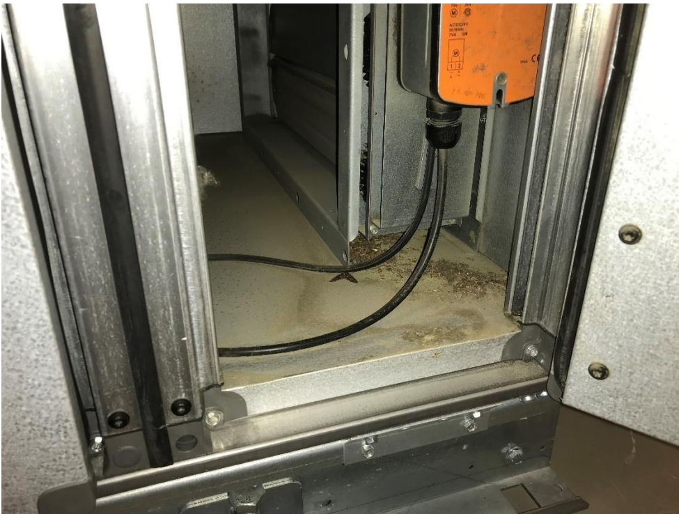
Kuva 5.2. Ilmanvaihtokoneen raitisilmakammiossa roskaa.
