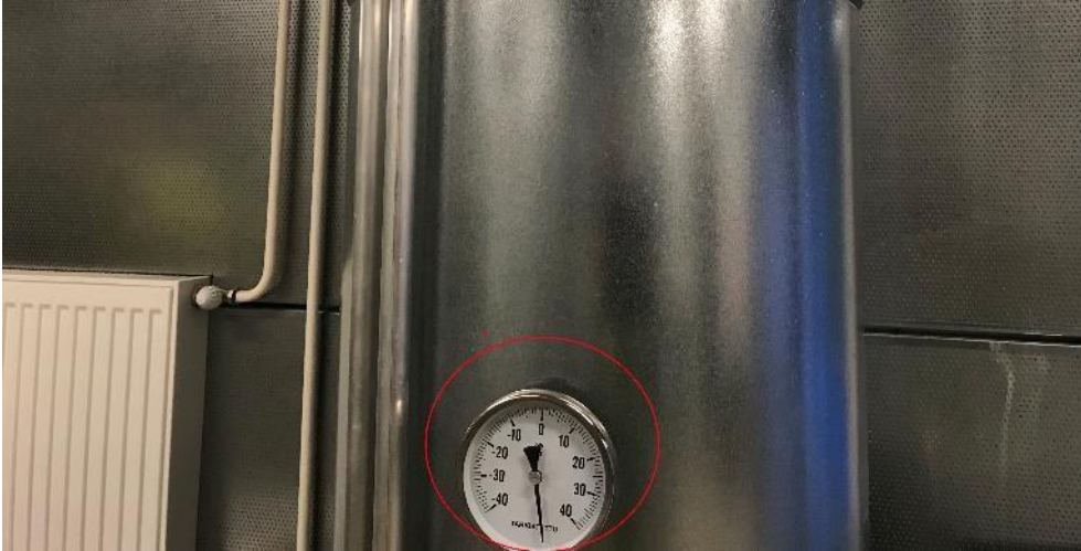
Kuva 5.1. Ilmanvaihtokanavan analoginen lämpömittari rikki.
