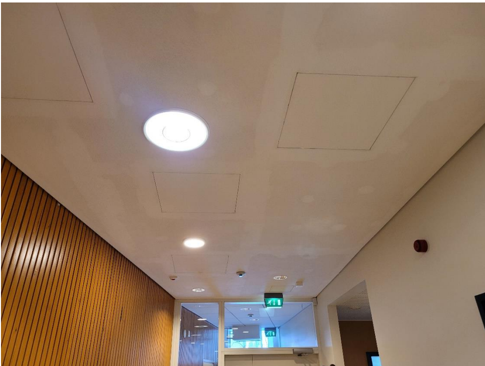
Kuva 4.2. Alakattojen käsittely jäänyt kesken - kuvassa B-osan aulan alakatto.
