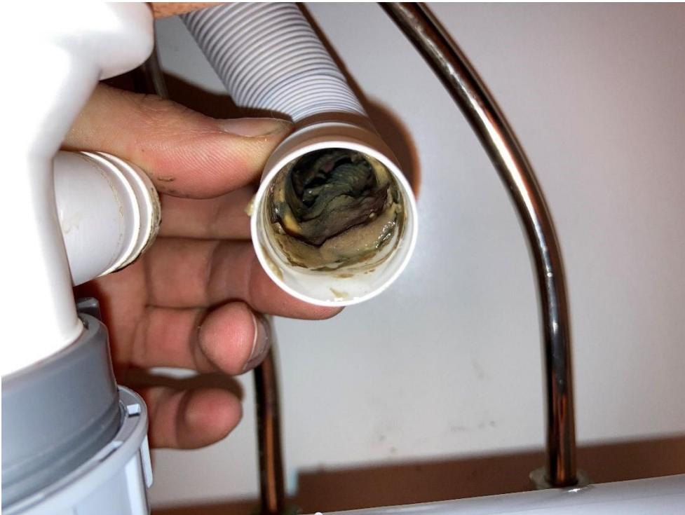
Kuva 5.4. Huoneen 145 altaan ylivuotoputkessa ylimääräistä tavaraa.
