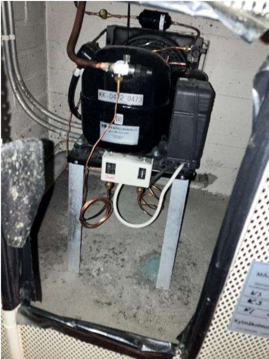
Kuva 4.21. Tilassa 120 portaiden alle on sijoitettu kylmäkone.
