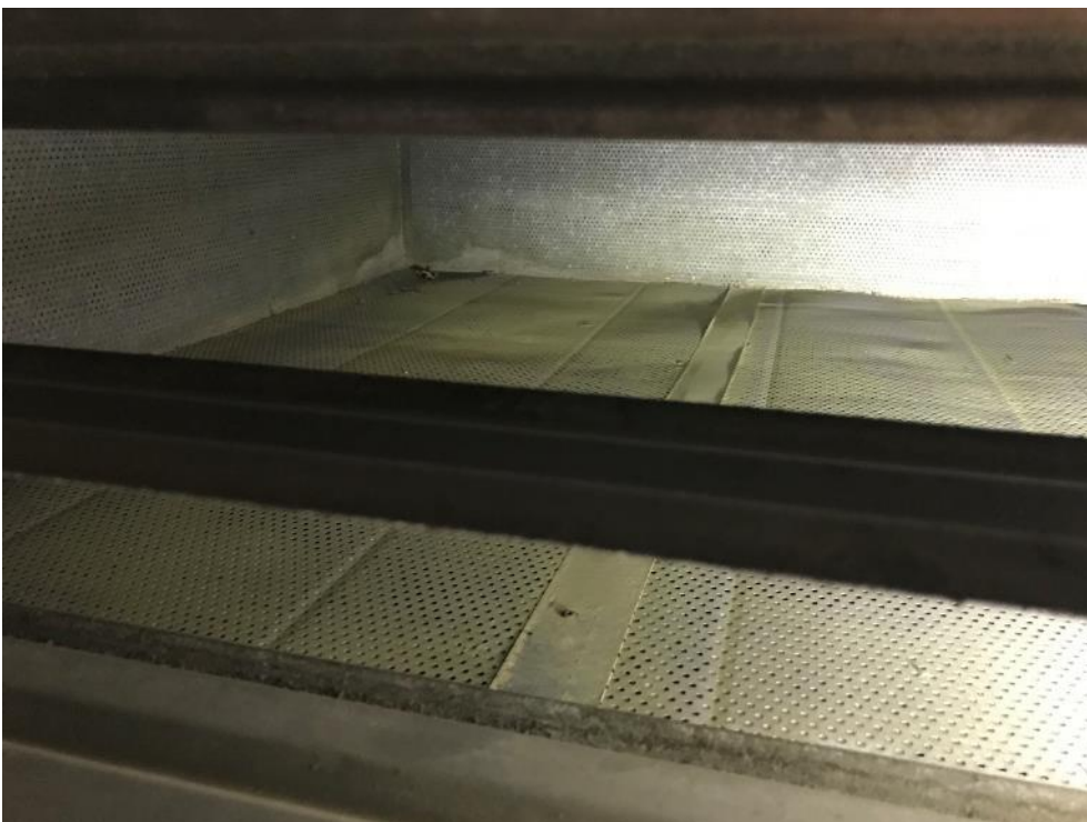
Kuva 5.2. Raitisilmakammion sisäpuoli on tehty reikäpellistä ja pellin alla on vuorivillaa.
