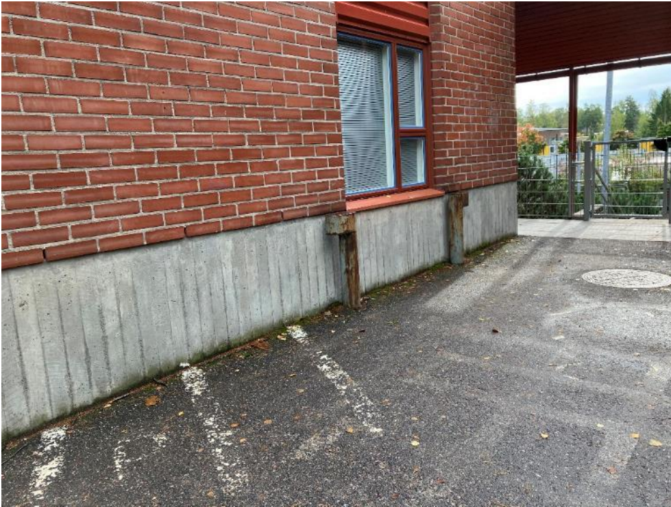
Kuva 4.39. Rakennuksen länsipuolella alustatilan tuuletusputkien kohdalla sokkelin alaosa on märkä ja tuuletusputket ovat ruostuneet. Yleisesti rakennuksen vierustan maanpinnan kaadot ovat heikot ja hulevedet eivät ohjaudu poispäin seinustoilta.
