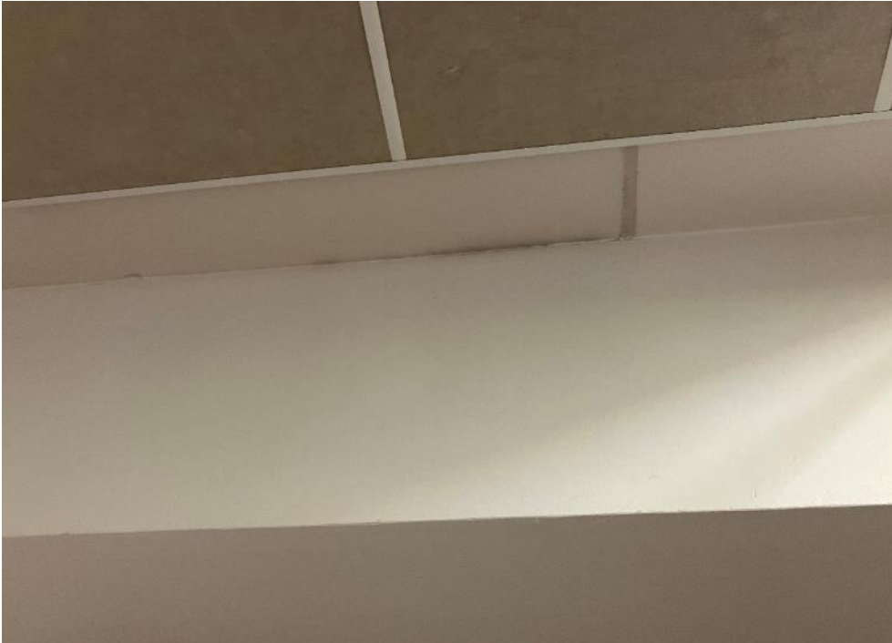
Kuva 4.1. Tilassa 206 katon saumaus on auennut ja tummunut.
