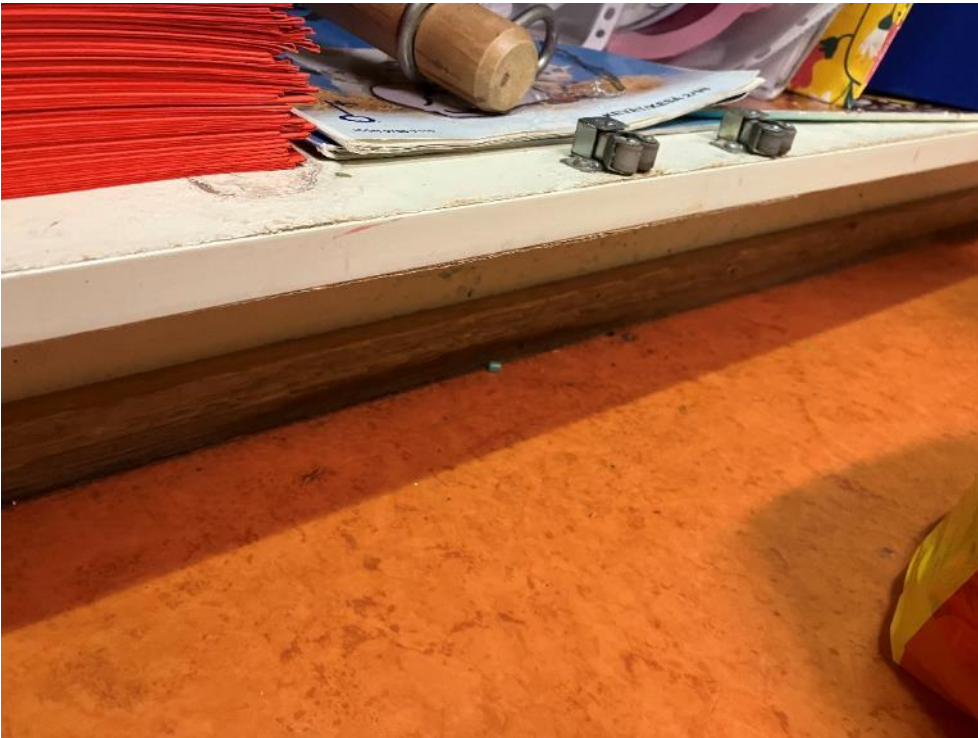
Kuva 4.4. Tilassa 212 allaskaapin levyrakenteet ovat huonossa kunnossa.
