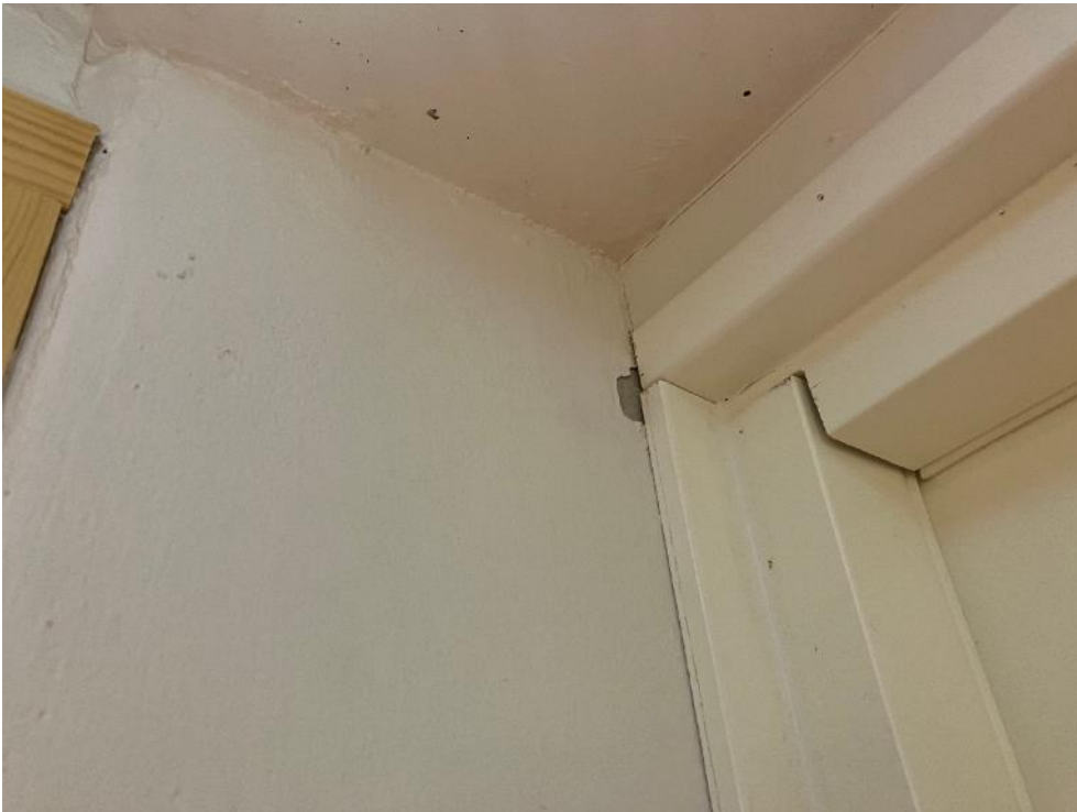
Kuva 4.10. Tilassa 201 seinämaalissa on vaurioita ja irtoilevaa maalia.
