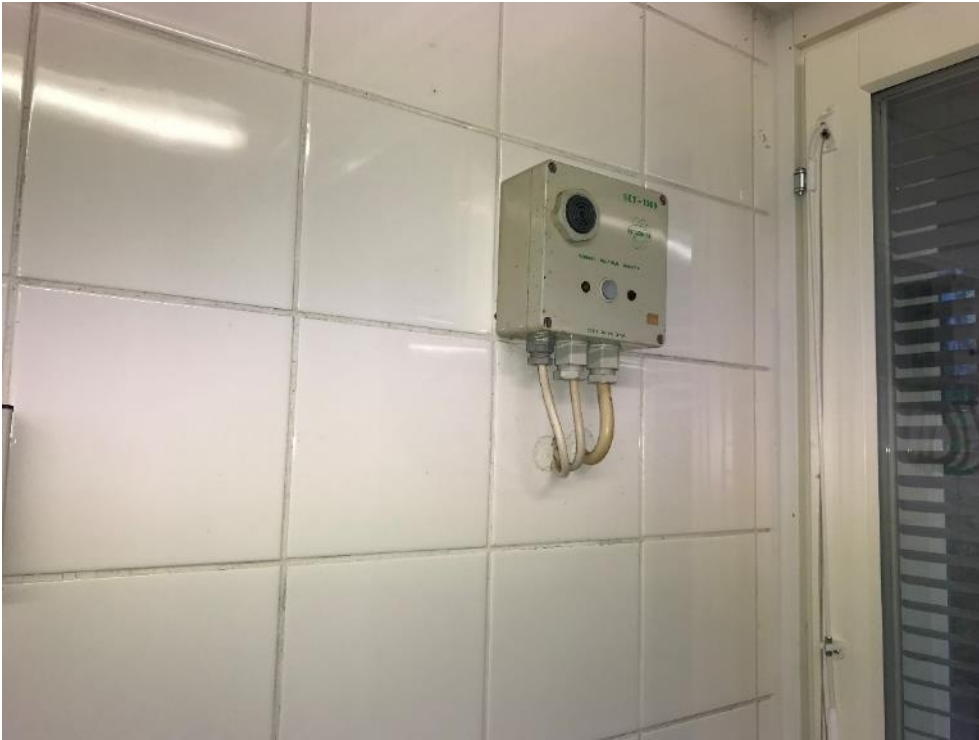
Kuva 5.7. Rasvanerotuskaivon hälytyskeskuksen toiminta on epävarmaa.
