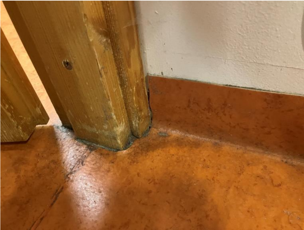
Kuva 4.23. Tilassa 116 muovimaton ja oven liitos on huono.
