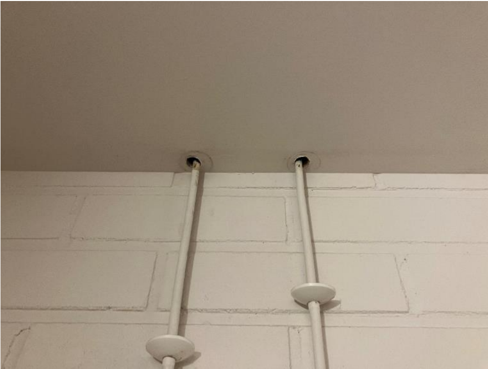
Kuva 4.25. Tilassa 116 katon läpiviennit ovat epätiivtiit, koska mansetit eivät pysy ylhäällä.
