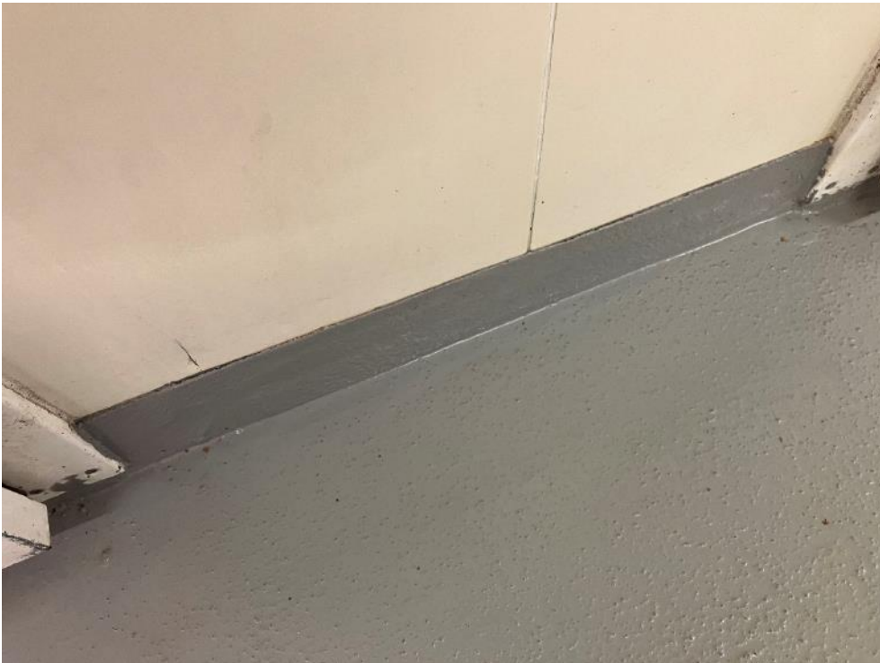
Kuva 4.20. Tilassa 121 massalattian ylösnoston ja kylmähuoneen seinän liitos ei ole tiivis.
