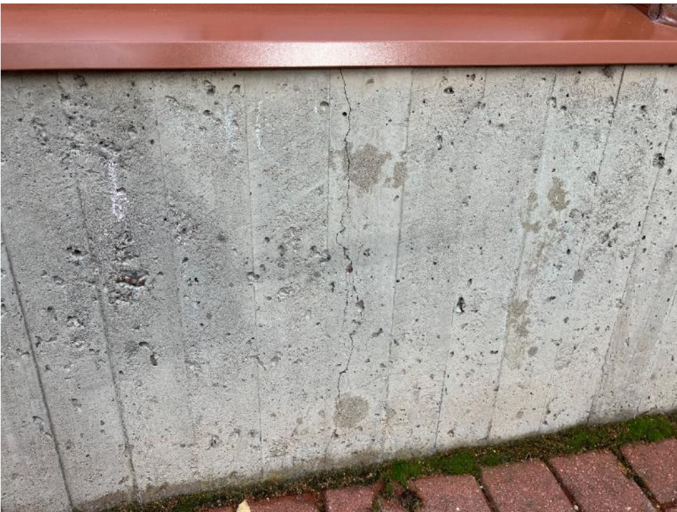
Kuva 4.38. Perusmuurissa paikoin halkeamia.
