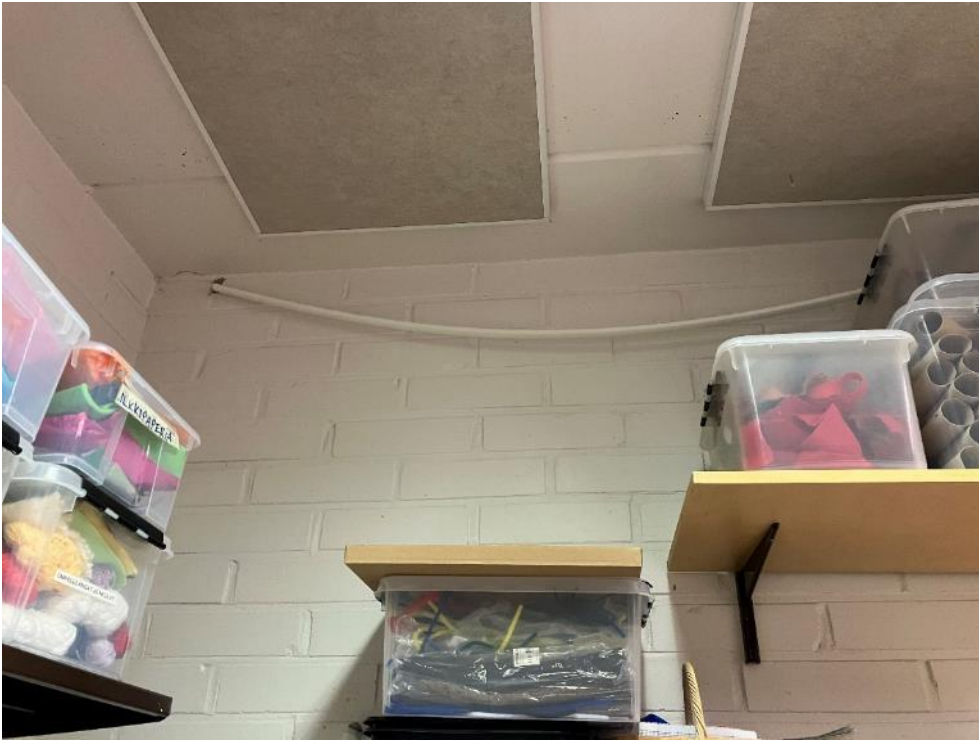
Kuva 4.5. Tilassa 212 on irronnut kaapelikouru.
