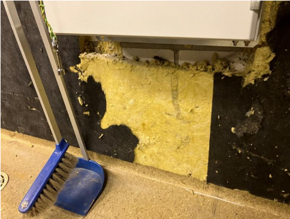
Kuva 4.31. Ilmanvaihtokonehuoneessa on runsaasti sulkemattomia mineraalivillapintoja.
