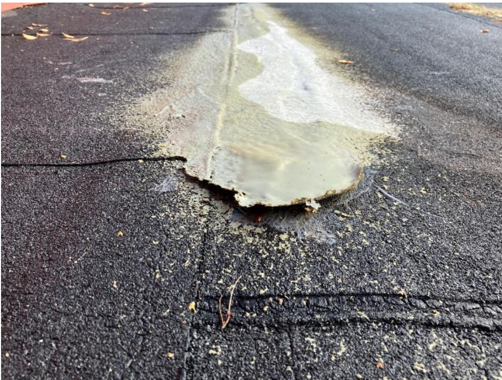
Kuva 4.32. Vesikatolla on useita irtoavia vanhoja paikkauksia.
