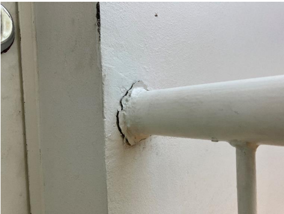
Kuva 4.30. Tilassa 213 portaiden yläpään turvakaiteen kiinnitys on puutteellinen.
