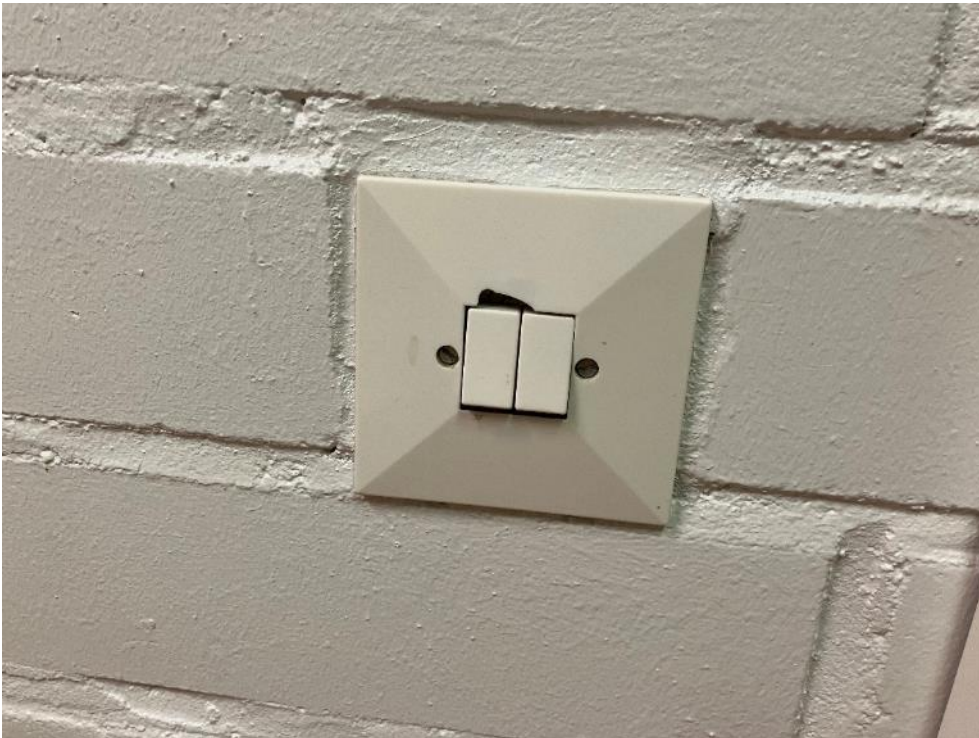
Kuva 4.6. Tilassa 212 on viallinen valokatkaisin.
