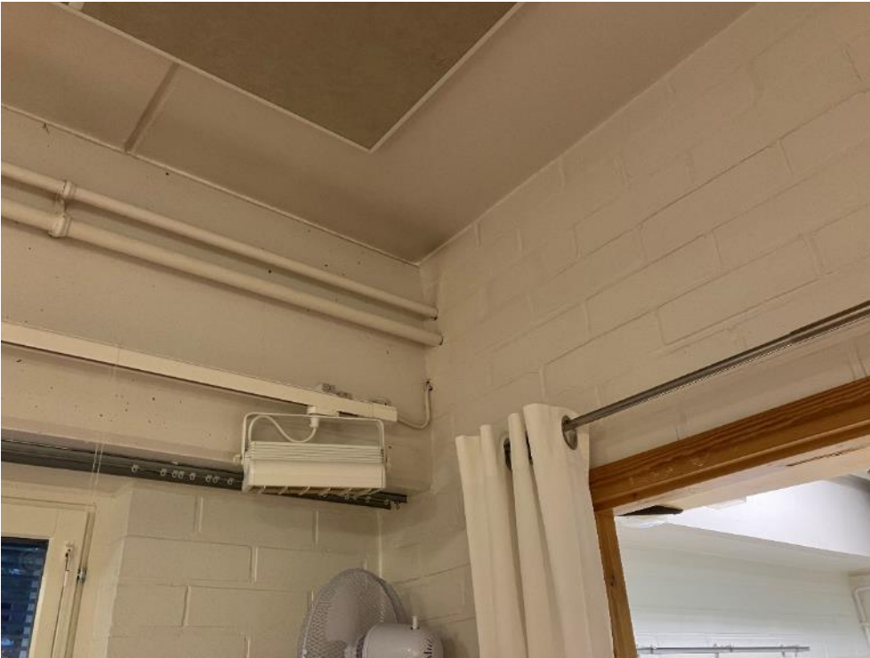
Kuva 4.3. Tilassa 205 on tiivistämättömiä seinän läpivientejä.
