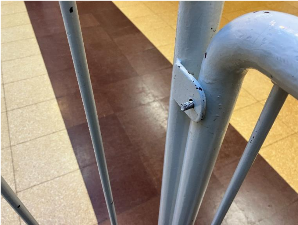
Kuva 4.29. Tilassa 213 portaille vievän portin lukitus on puutteellinen puuttuvan pultin vuoksi.
