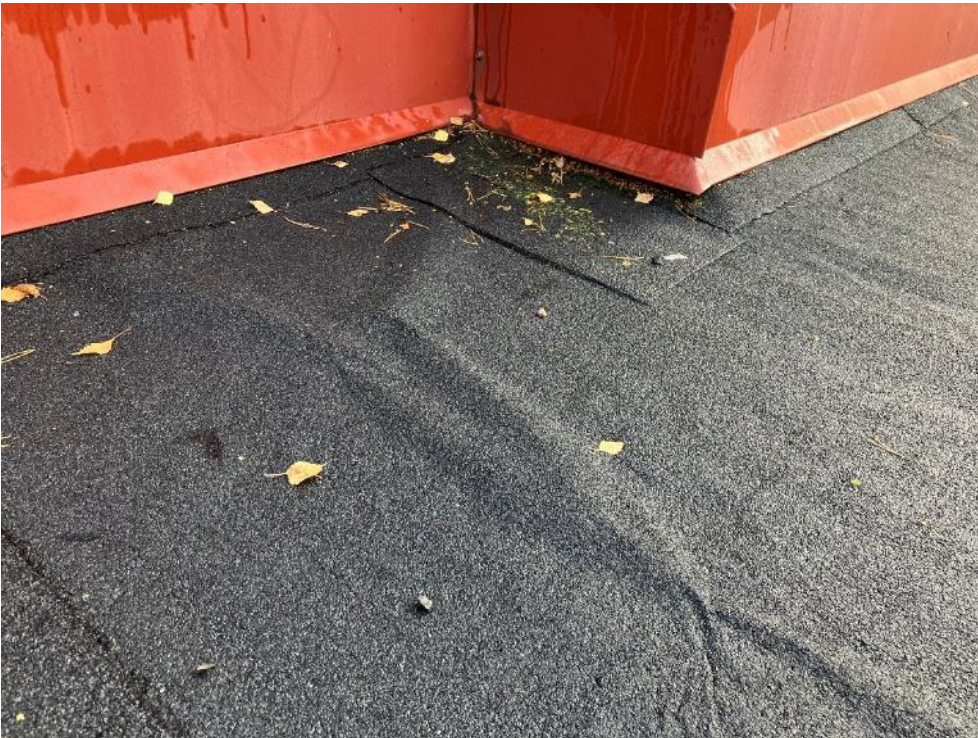
Kuva 4.34. Kattohuovan tartunta on puutteellinen ja sen alla on ilmataskuja.
