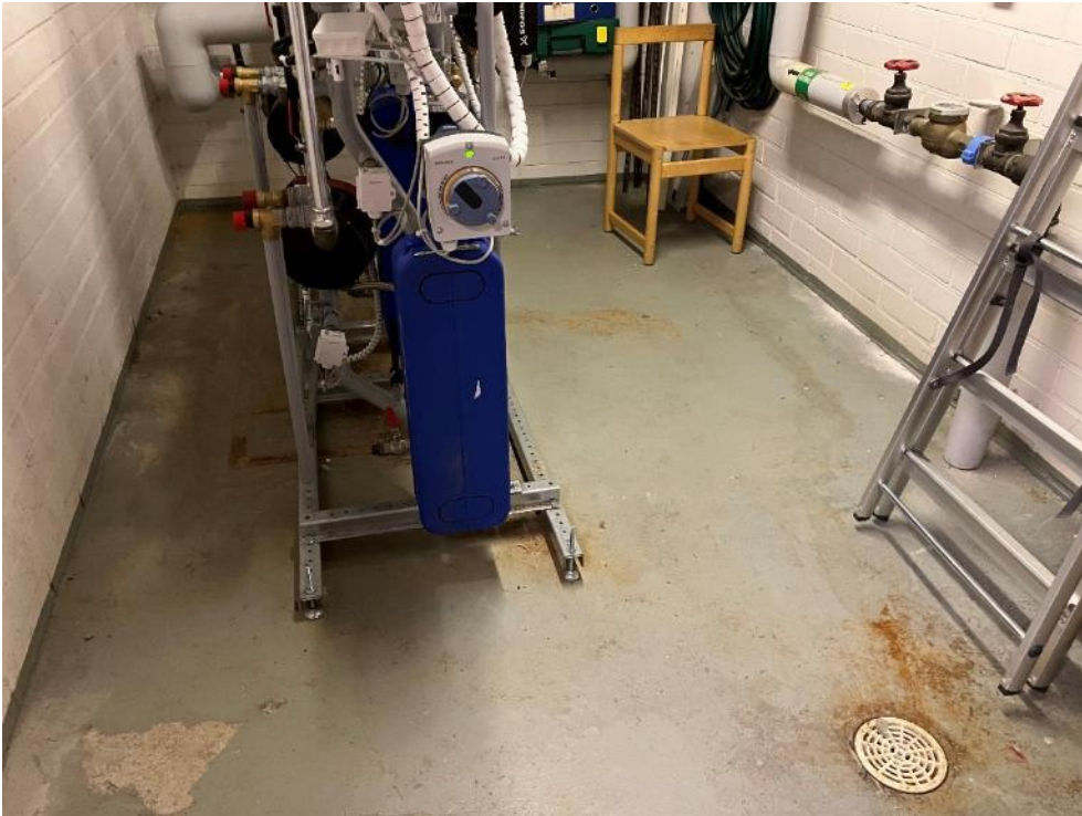
Kuva 4.27. Tilassa 118 lattianpinnoite on huonossa kunnossa ja irtoilee.
