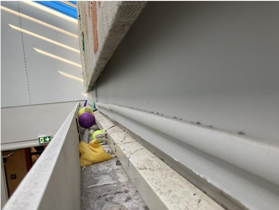
Kuva 5.10. Monitoimitilassa 213 on pölyä ja roskia tason päällä.
