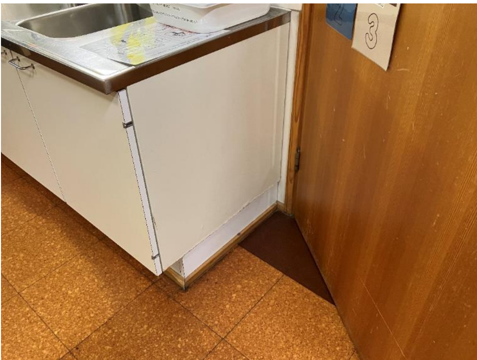
Kuva 4.2. Tilassa 205 maali irtoaa allaskaapin levyrakenteista ja lattialistoissa on tummentumia. Tilan lattiapäällysteenä on alkuperäinen korkkimatto.
