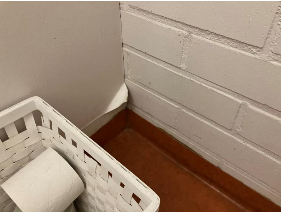
Kuva 4.24. Tilassa 116 seinätapetti on irtoamassa. Lisäksi lattian muovimaton ylösnoston ja seinän liitokset ovat paikoin epätiiviit.
