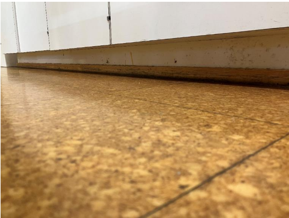
Kuva 4.8. Tilassa 208 lattialistat ovat huonossa kunnossa.
