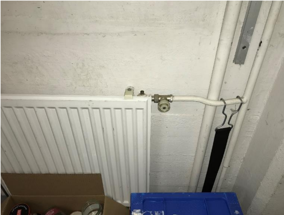
Kuva 5.9. Keittiön eteisen lämmityspatterin termostaatti on rikki.
