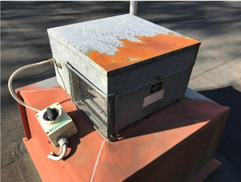
Kuva 5.6. Keittiön huippuimurin turvakytkimellä ei ole sääsuoja.
