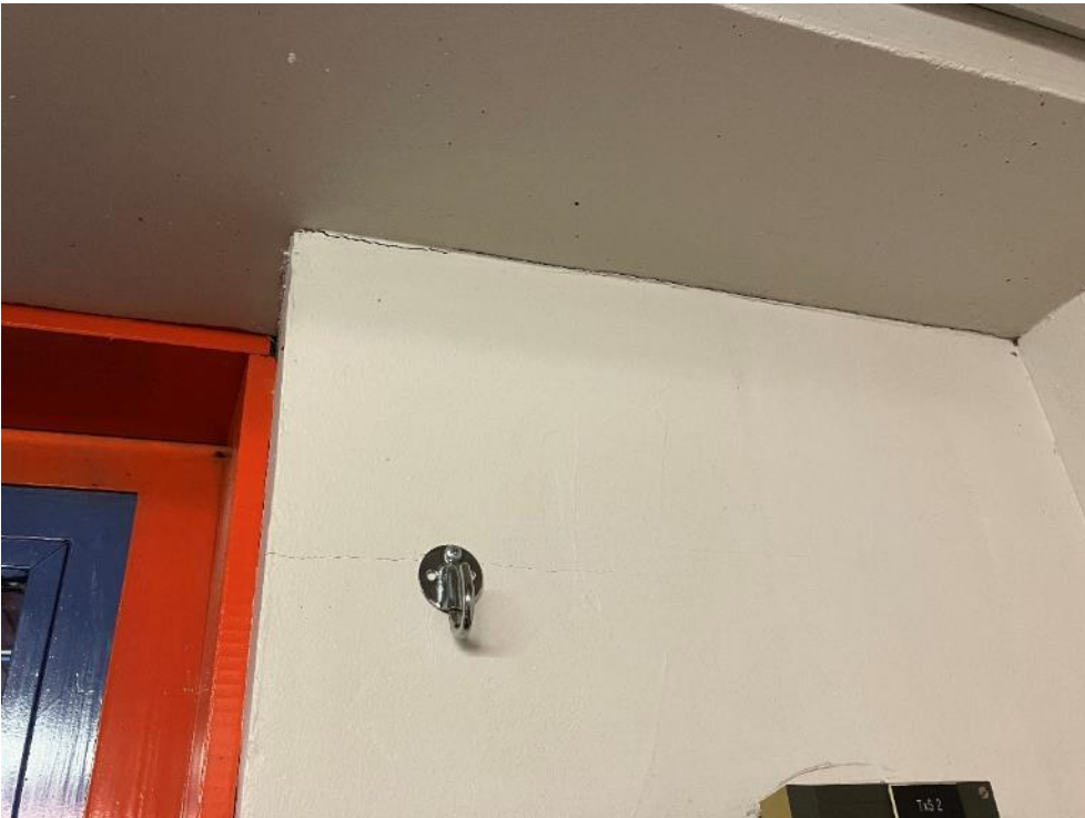
Kuva 4.12. Tilassa 214 seinän ja katon liitos on ratkennut ja maalipinnassa on halkeamia.
