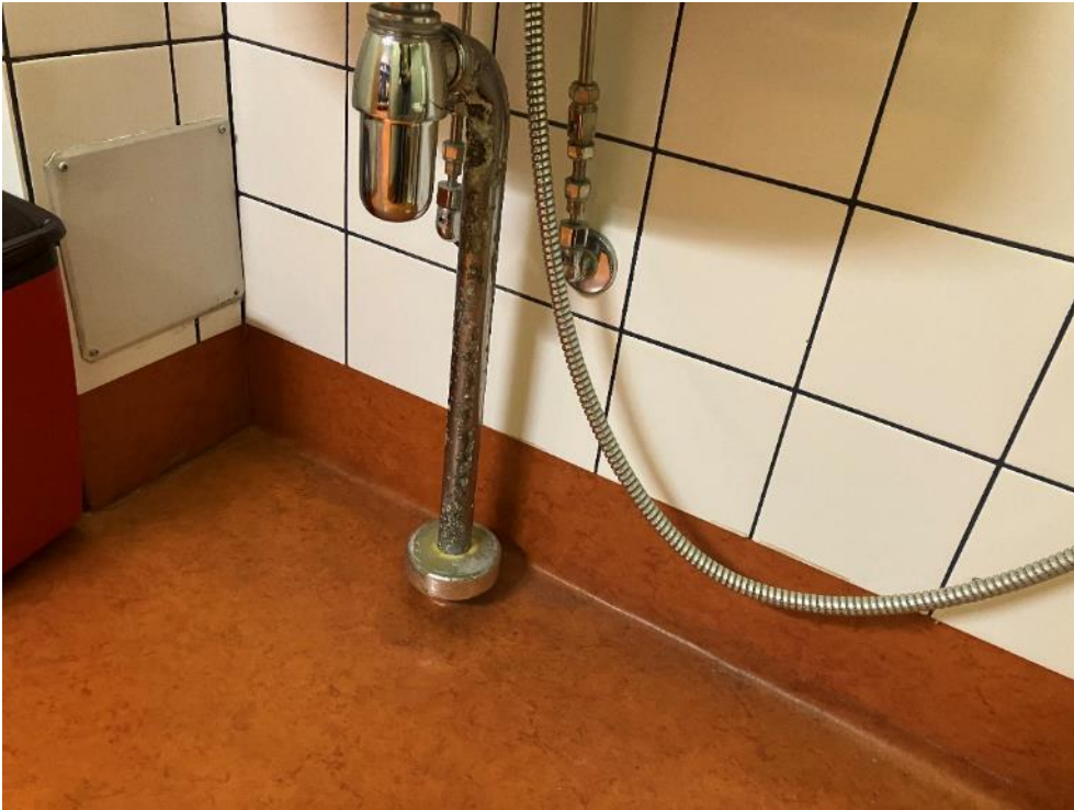
Kuva 4.13. Tilassa 223 lavuaarin poistoputki on huonossa kunnossa.
