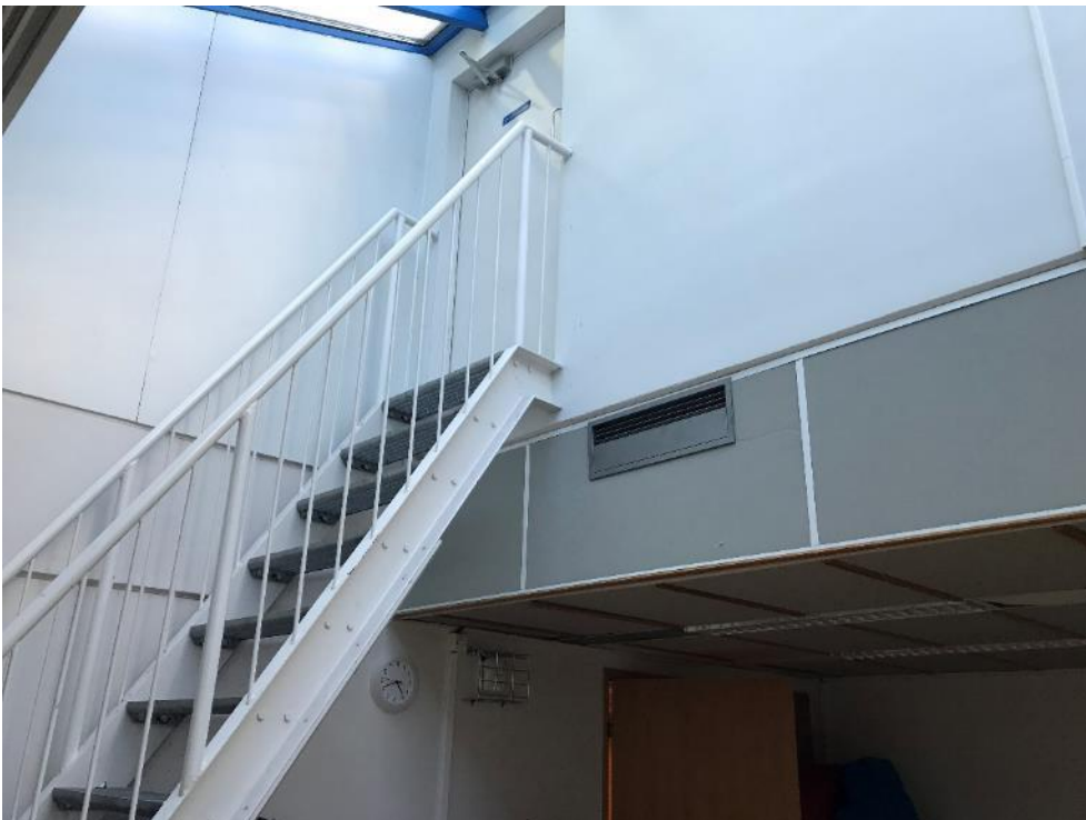
Kuva 5.4. Liikuntasalin tuloilma ei pääse huoneen perälle.
