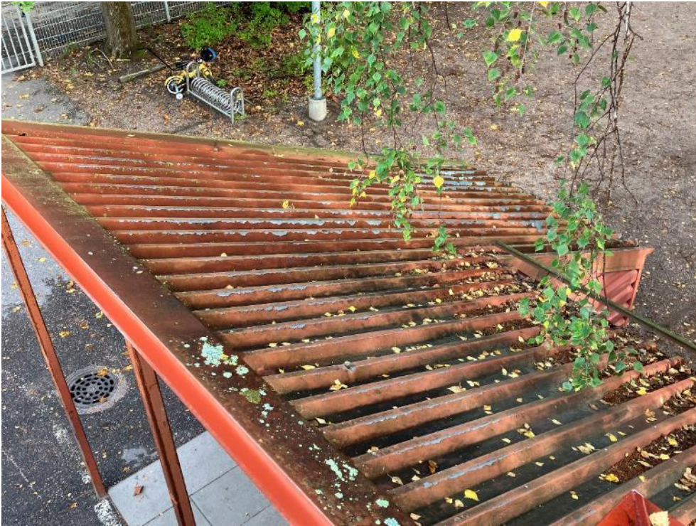
Kuva 4.35. Katoksen peltikate on huonossa kunnossa.
