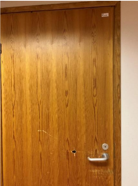
Kuva 4.26. Tilassa 112 ovesa on reikä.
