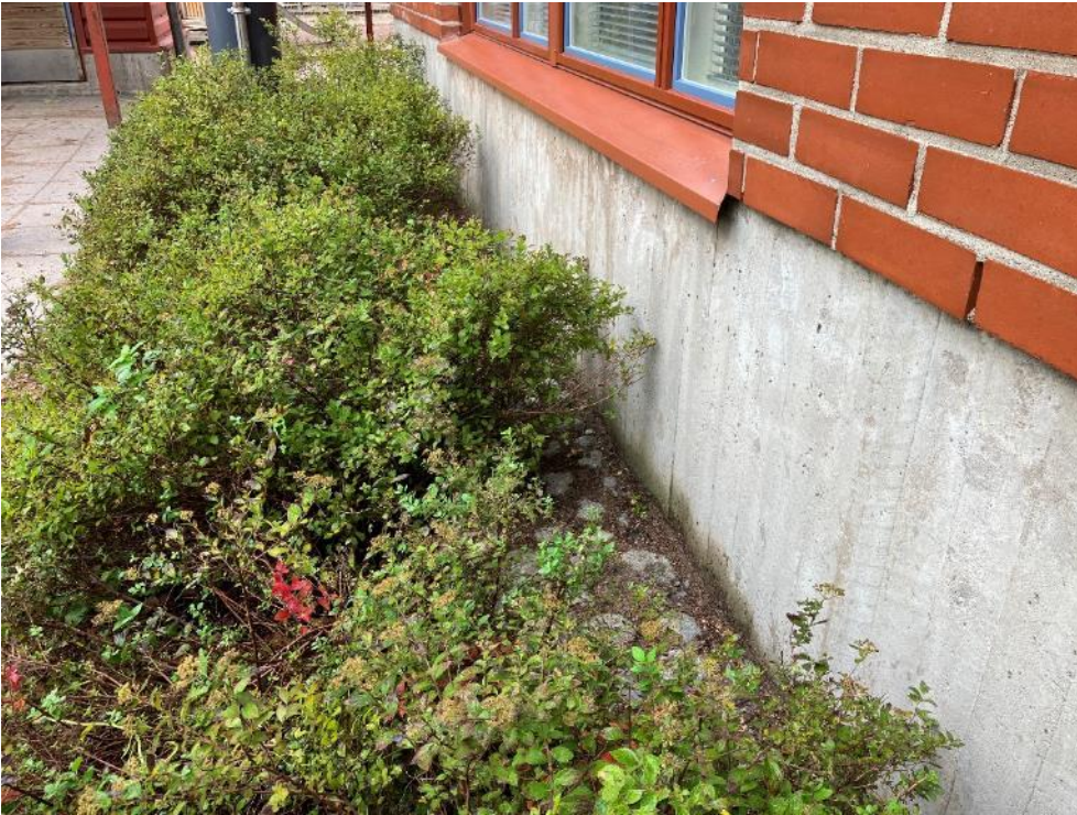
Kuva 4.37. Tilan 131 ikkunan edessä on pensas noin 50 cm etäisyydellä seinästä.
