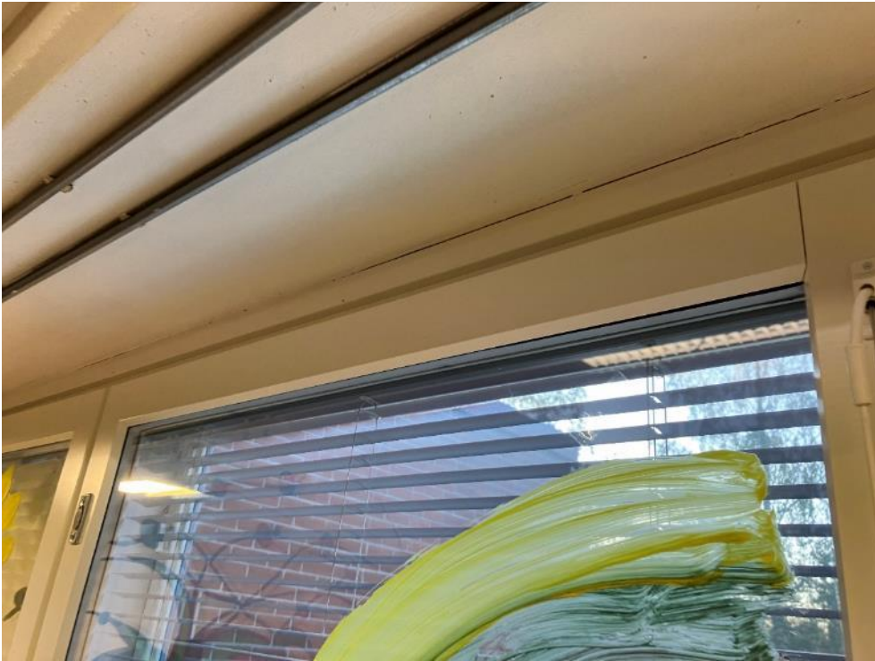
Kuva 4.9. Tilassa 209 ikkunakarmien yläreunan pintatiiviste on ratkennut.
