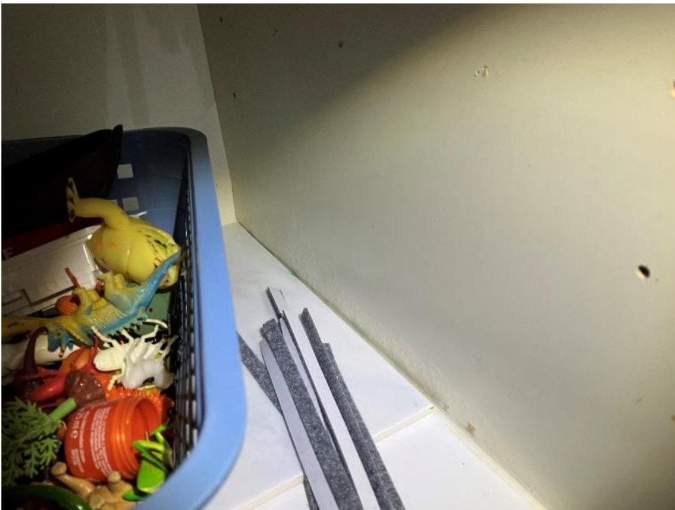
Kuva 4.16. Tilassa 220 allaskaapin sisäpuolella on vanhoja kastumisjälkiä ja maali irtoilee.
