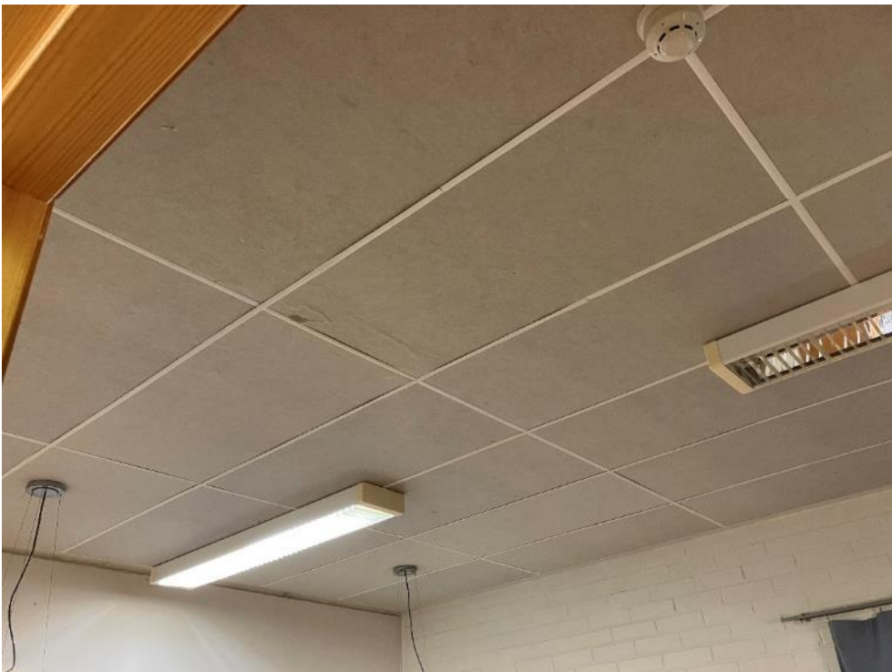
Kuva 4.28. Tilassa 208 on pintavaurioita ja lieviä värjäytymiä alakaton akustiikkalevyissä.
