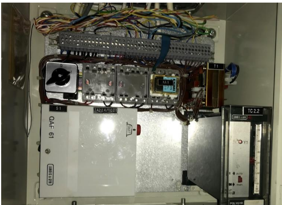
Kuva 6.2. TK02 ilmanvaihtokoneen säädin on vuodelta 1984.
