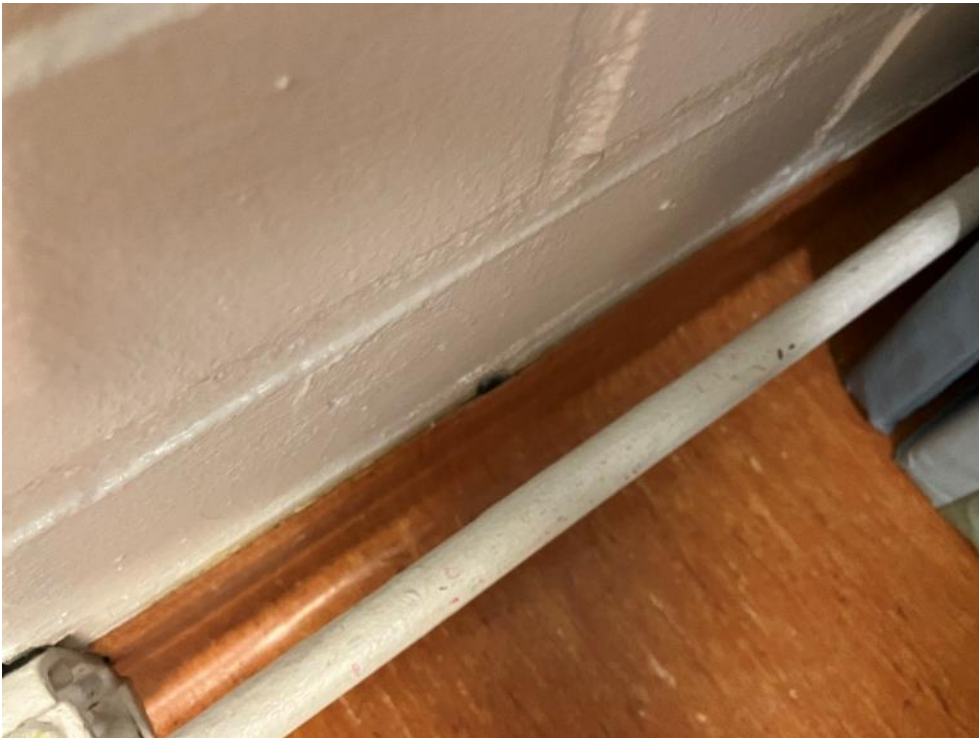
Kuva 4.18. Tilassa 103 lattiamaton ylösnosto tiiliulkoseinää vasten ei ole tiivis. Tilan lattiapäällysteenä on alkuperäinen muovimatto.
