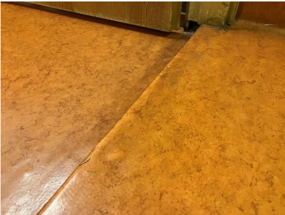
Kuva 4.14. Tilassa 223 lattian muovimatossa on reikiä. Tilan lattiapäällysteenä on alkuperäinen muovimatto.
