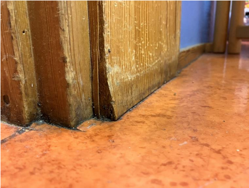
Kuva 4.15. Tilassa 223 oven ovikarmin ja ovilistojen alaosissa vanhoja kastumisjälkiä.
