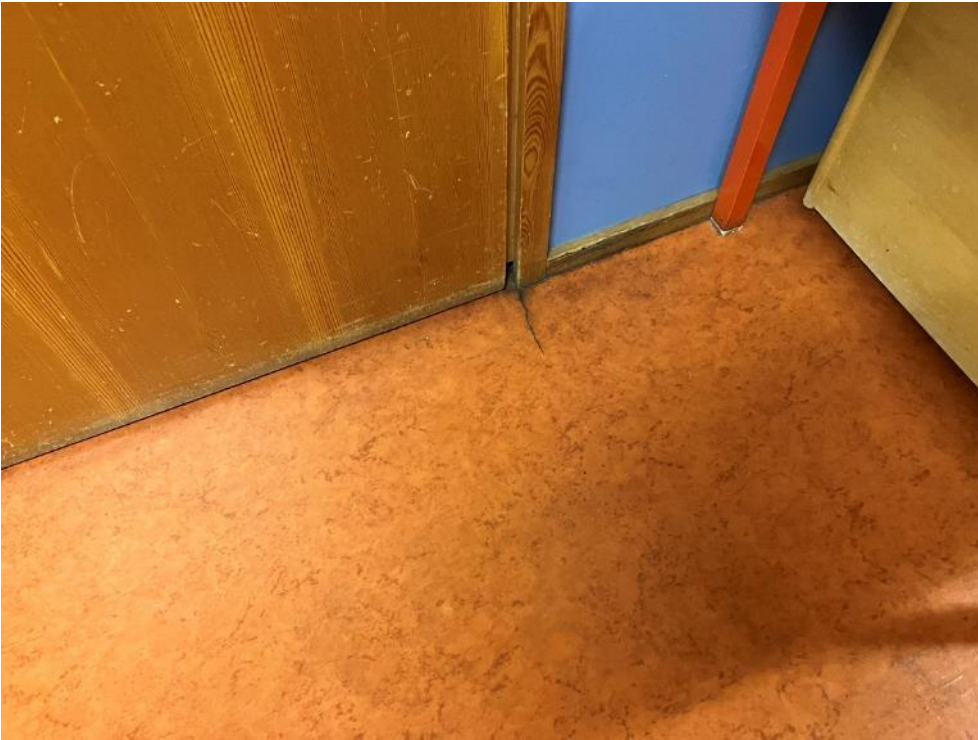
Kuva 4.11. Tilassa 213 lattiamatossa on repeämiä ja lattialistoissa tummumia.
