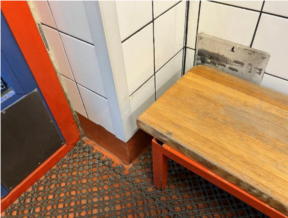
Kuva 4.7. Tilassa 200 ulko-oven karmin sisäpuolen tiivisteet ovat huonossa kunnossa. Lisäksi lattian muovimatossa on reikiä.
