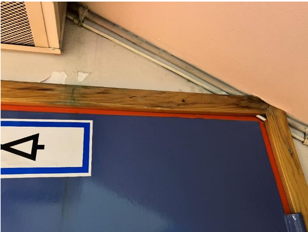
Kuva 4.22. Tilassa 120 ovilistat ovat huonossa kunnossa ja seinässä on irtoilevaa maalia.
