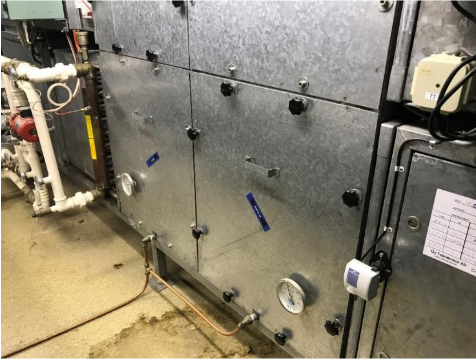
Kuva 5.1. Lämmöntalteenoton viemäroinneistä puuttuu takaimusuojat.
