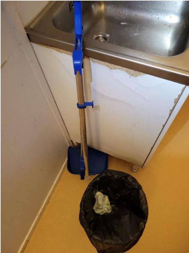
Kuva 4.5. Tilan 117 kaapin sivulevyssä kosteusvaurio.
