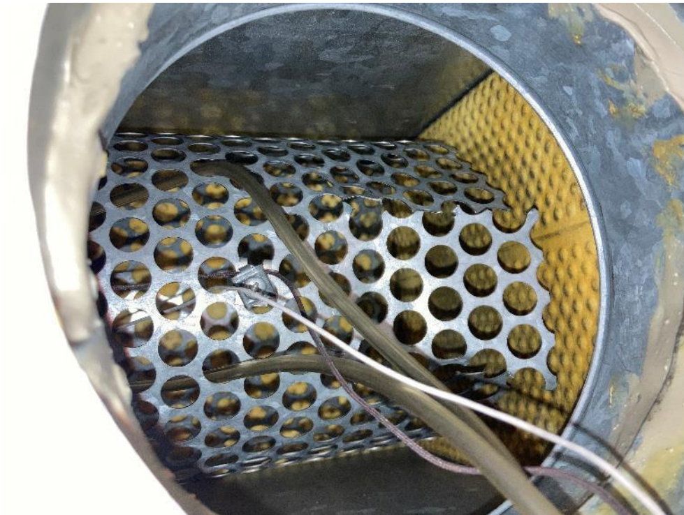
Kuva 5.3. Ilmanvaihdon tuloilmapäätelaitteiden kokoojakammioissa on käytetty äänenvaimennus materiaalina lasivillaa.
