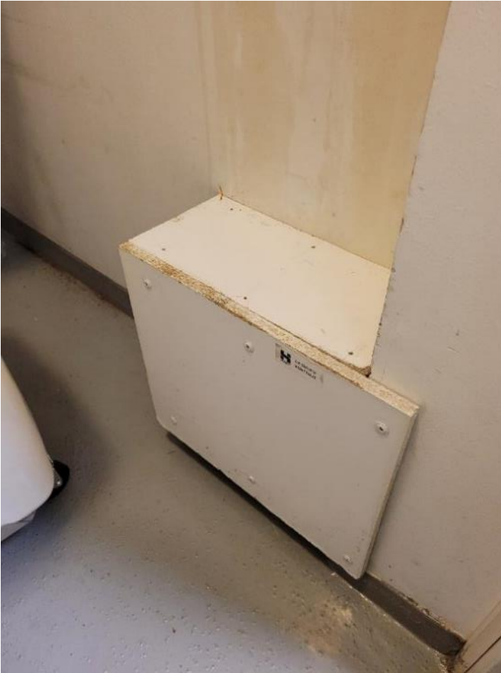
Kuva 4.11. Tilan 126 kotelon sisällä ilmavuoto.
