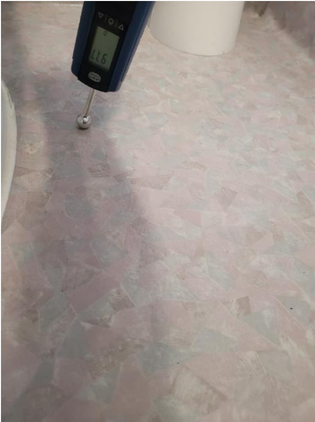
Kuva 4.15. Tilan 141 lattiassa kohonneita lukemia.
