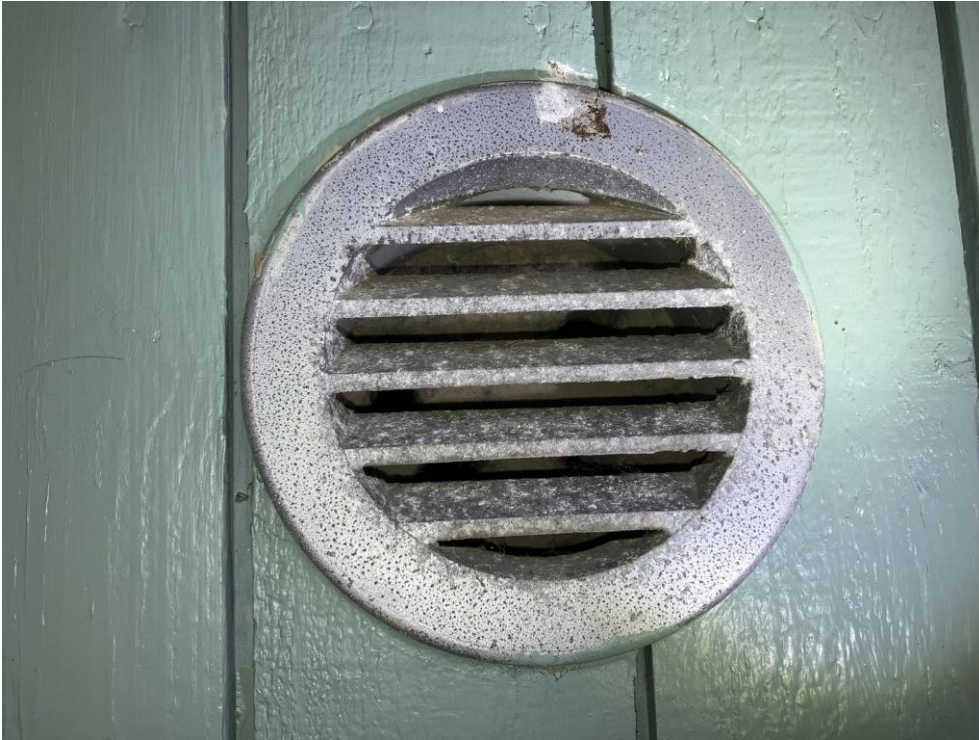
Kuva 5.4. Keittiön tuulikapin 123 korvausilmaventtiili tukossa.
