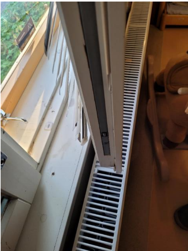
Kuva 4.2. Tilan 103 ikkunatiivisteestä puuttuu pala.
