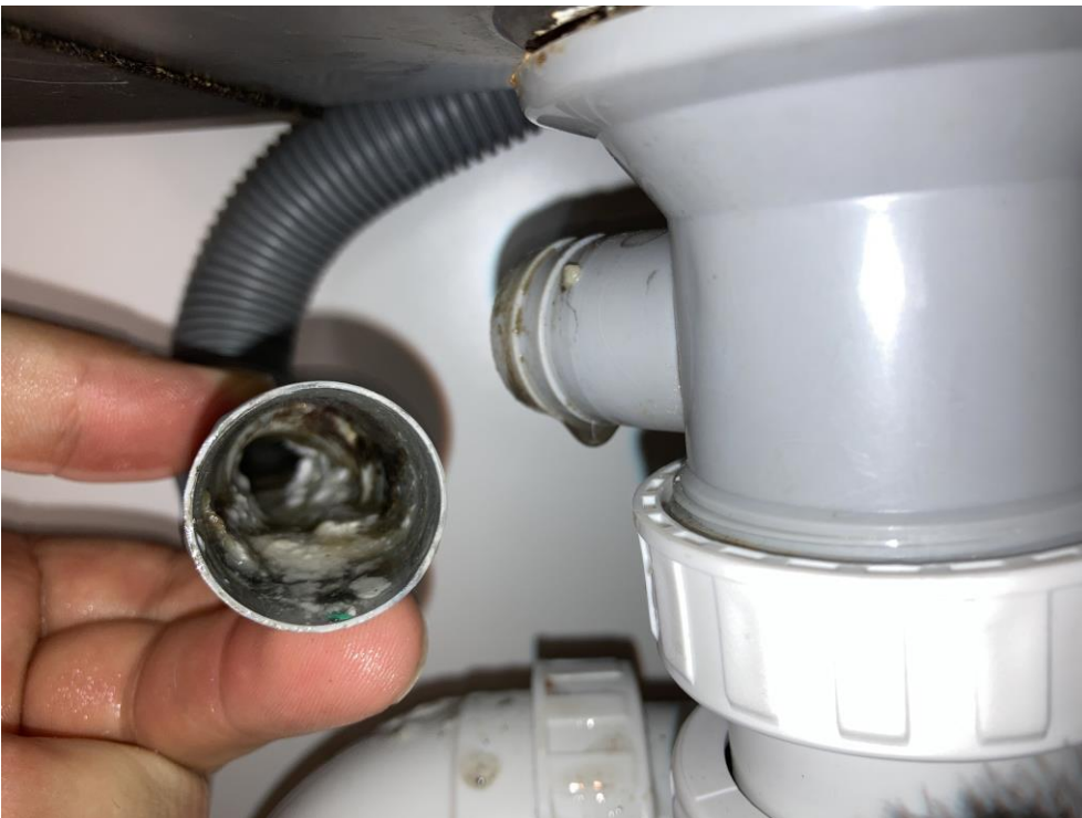
Kuva 5.9. Pesualtaiden ylivirtausputkissa on likaa, joka haisee.
