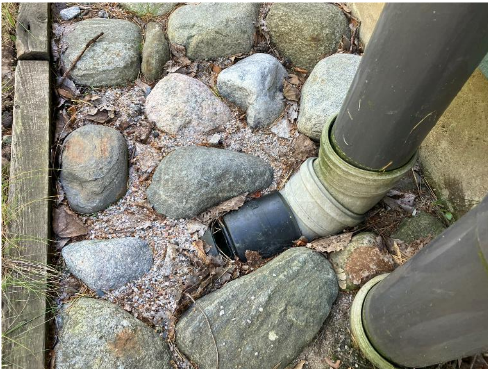
Kuva 5.11. Sadevesiputki on halki ja maa aines pääsee putken sisään.
