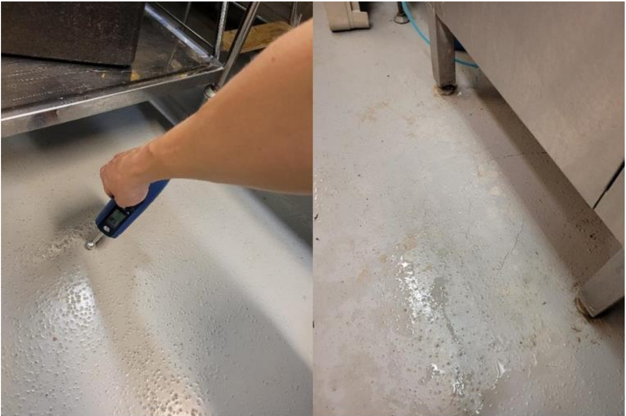
Kuva 4.9. Tilan 125 lattiassa kohonneita lukemia ja pinnoite halkeillut.
