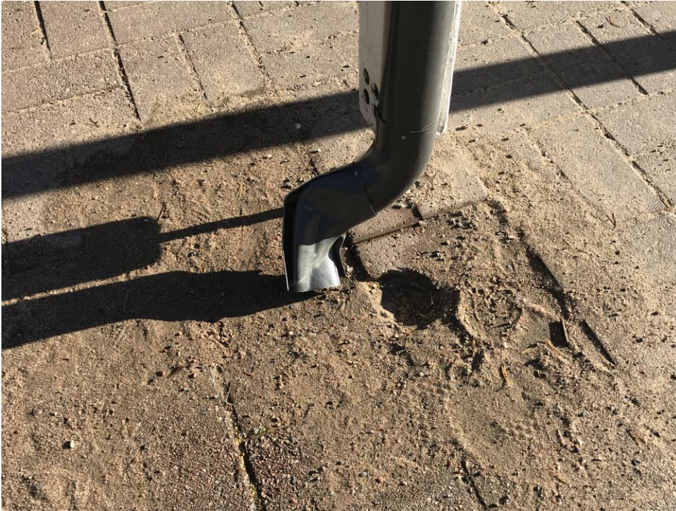
Kuva 5.10. Sadevesien syöksytorvi irti alapäästä.
