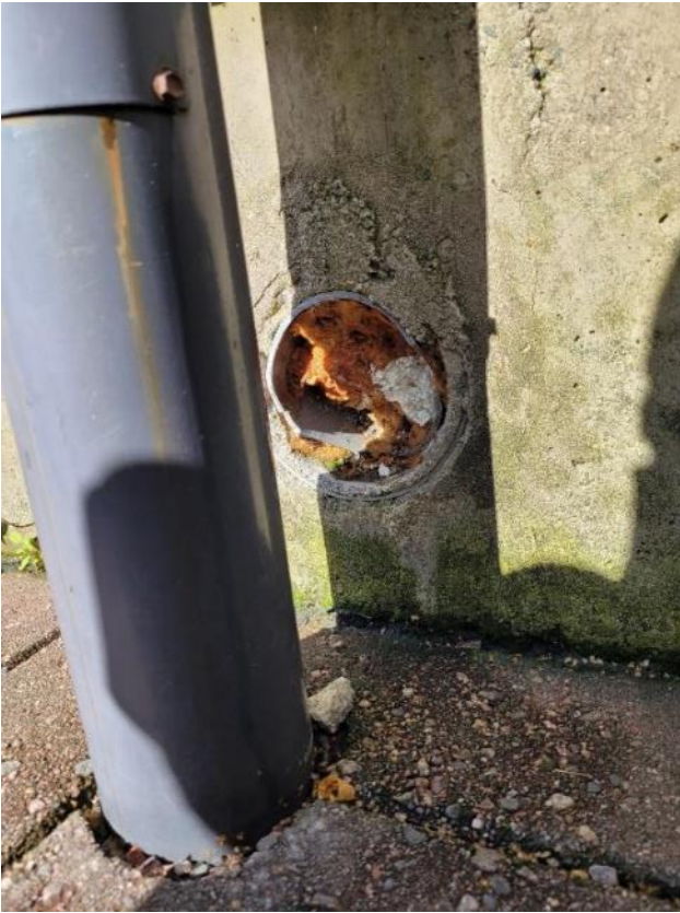
Kuva 4.23. Tilan 147 ulkoseinässä vanhan sadevesilinjan läpivienti sokkelissa paikkaamatta.
