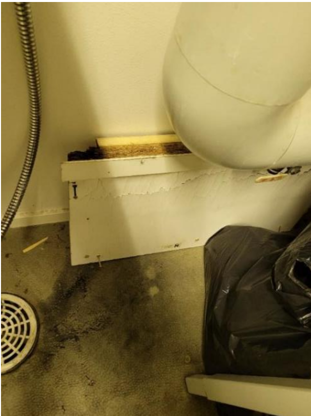
Kuva 4.20. Tilassa 158 mikrobivaurioitunutta materiaalia.
