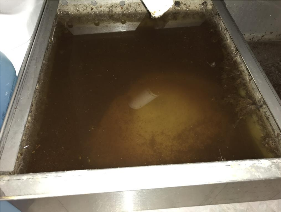
Kuva 5.8. Siivoushuoneen pesualtaan nukkasuodatusallas likainen ja haisee.
