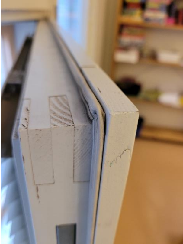
Kuva 4.1. Tilan 103 ikkunatiivisteet kuluneet.
