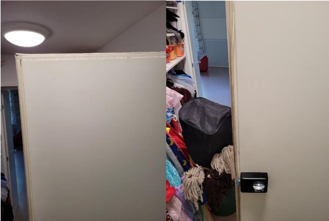
Kuva 4.19. Tila 158 oven tiiviste puuttuu yläreunasta ja repsottaa lukon kohdalta.
