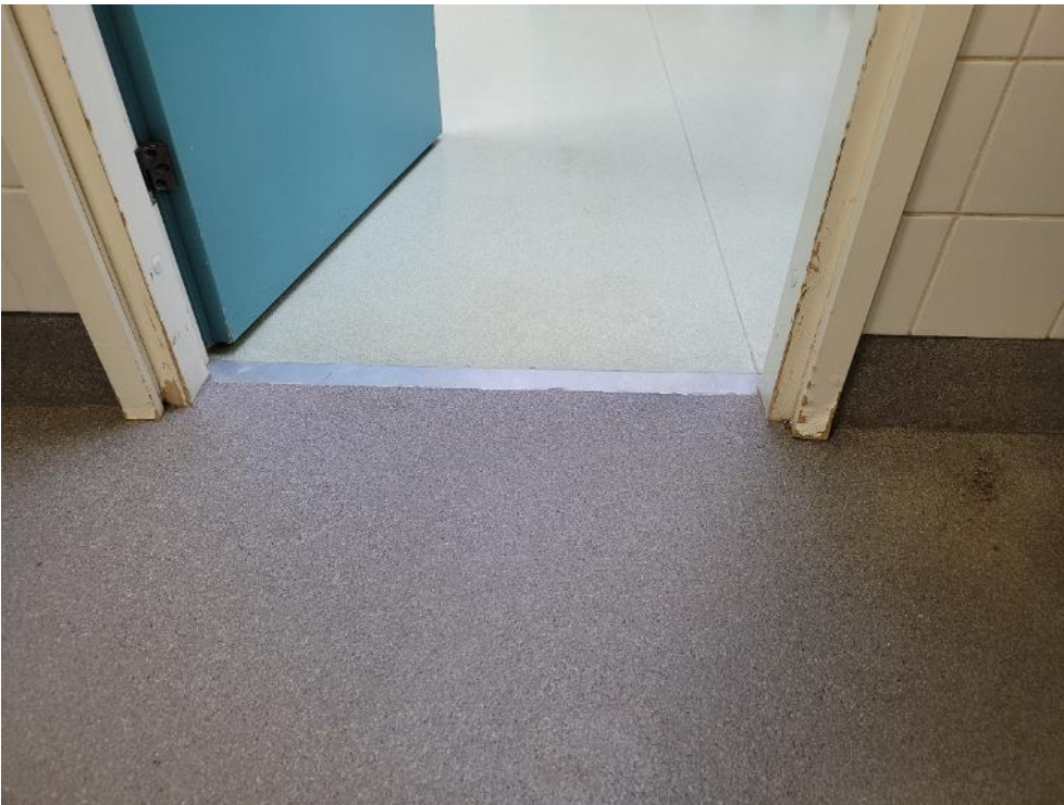
Kuva 4.18. Tilan 157 oven vuorilistojen alapäissä kosteusvaurio.
