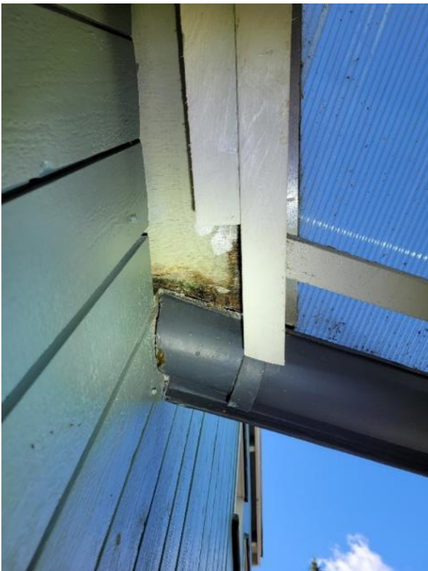
Kuva 4.22. Tilan 131 edessä valokatoksen vanerissa kosteusvaurio.
