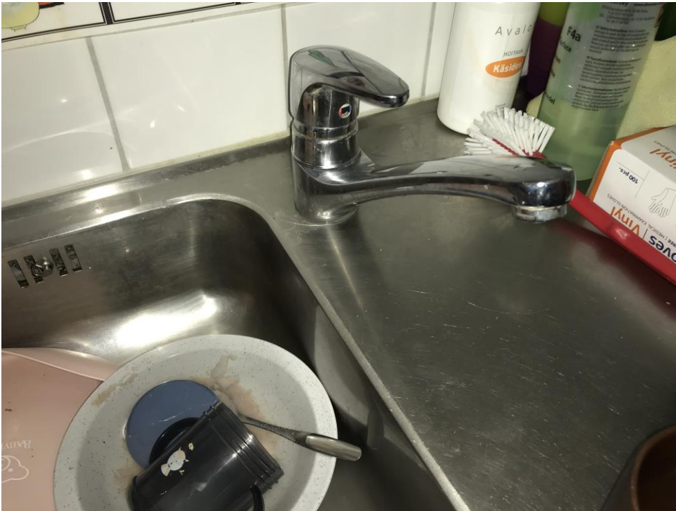
Kuva 5.6. Usean allashanan sivuliikerajoitin on väärä ja vesi pääsee valumaan pöydälle.
