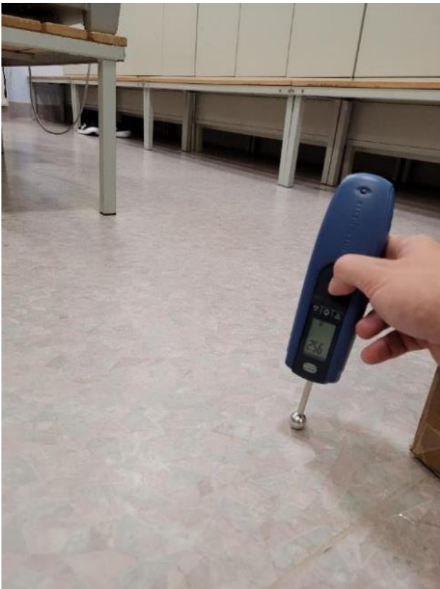
Kuva 4.16. Tilan 142 lattiassa kohonneita lukemia.
