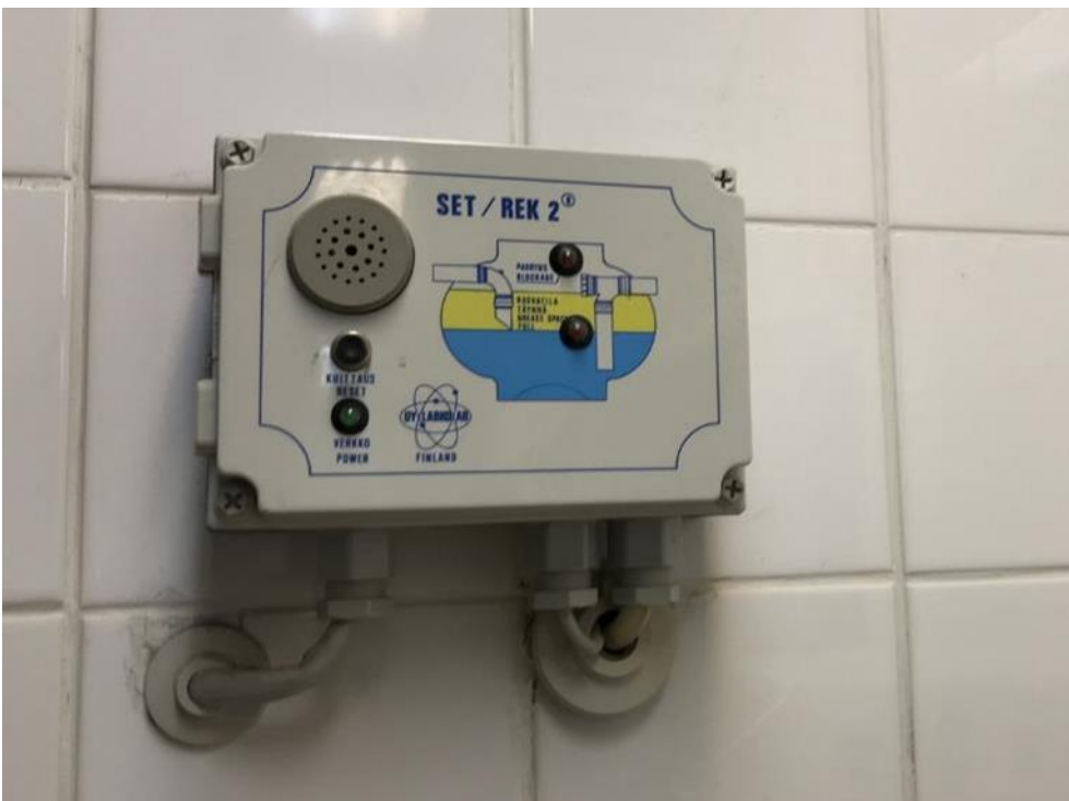
Kuva 5.7. Rasvanerotuskaivon hälytyskeskus on kytketty pois päältä.
