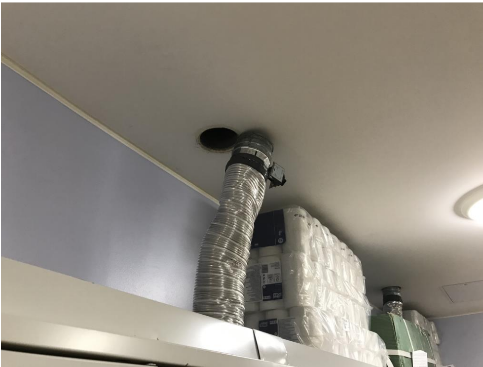
Kuva 5.5. Henkilökunnan pukuhuoneen pukukaappien poistoilmaputki irti.
