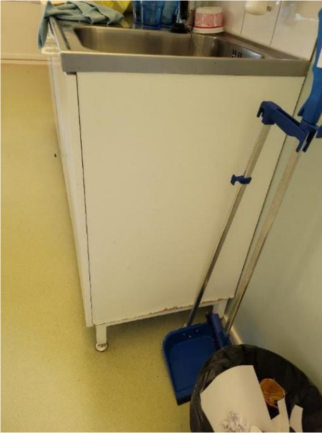
Kuva 4.17. Tilan 153 kaapin sivulevyssä kosteusvaurio.
