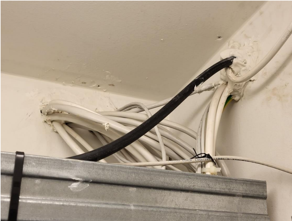
Kuva 4.34. Tila 202 läpivienneissä reikiä.
