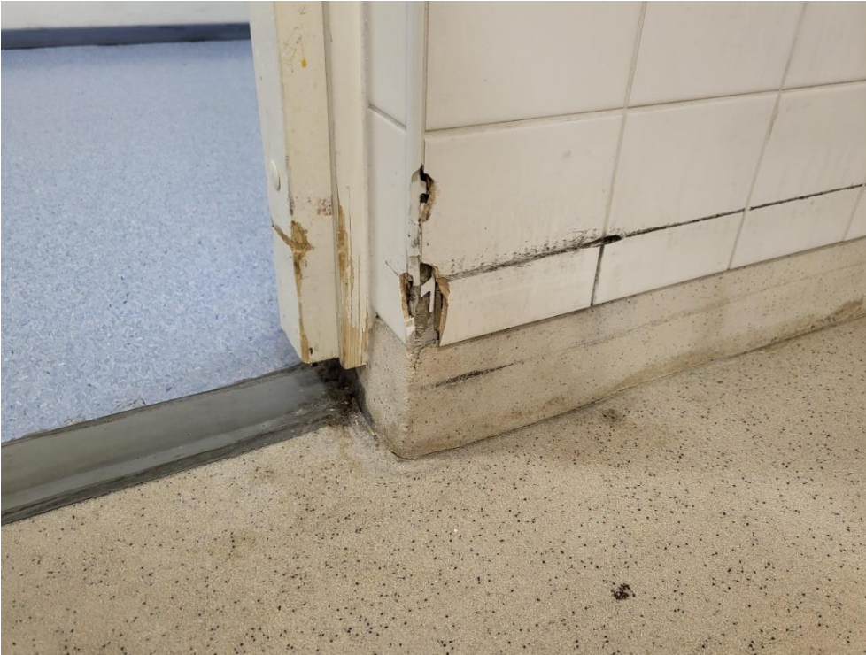
Kuva 4.20. Tila 134 Pesuvesi pääsee rakenteisiin rikkoutuneista ja avonaisista saumoista.
