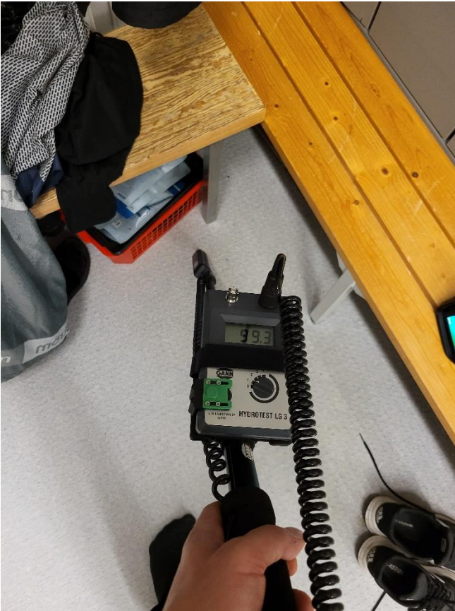
Kuva 4.29. Tila 144 kohonneita lukemia pintakosteusmittarilla lattiassa.
