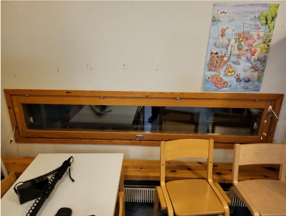
Kuva 4.8. Tila 104 ikkunan aukipitolaite ja sälekaihtimen säätö rikki.
