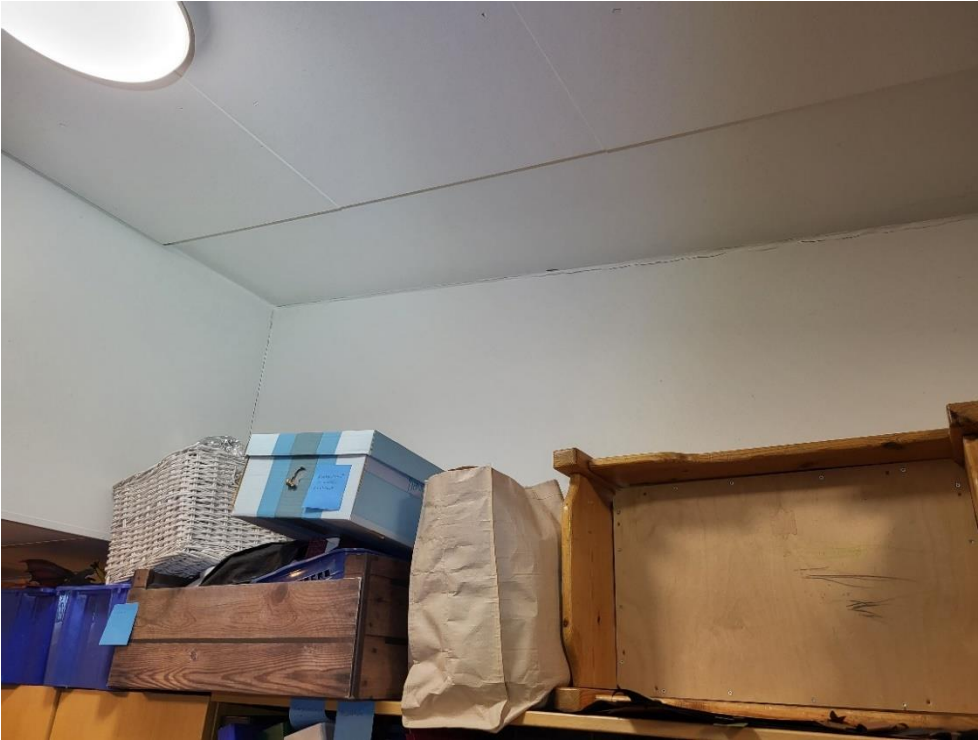
Kuva 4.12. Tila 115 halkeama katonrajassa.
