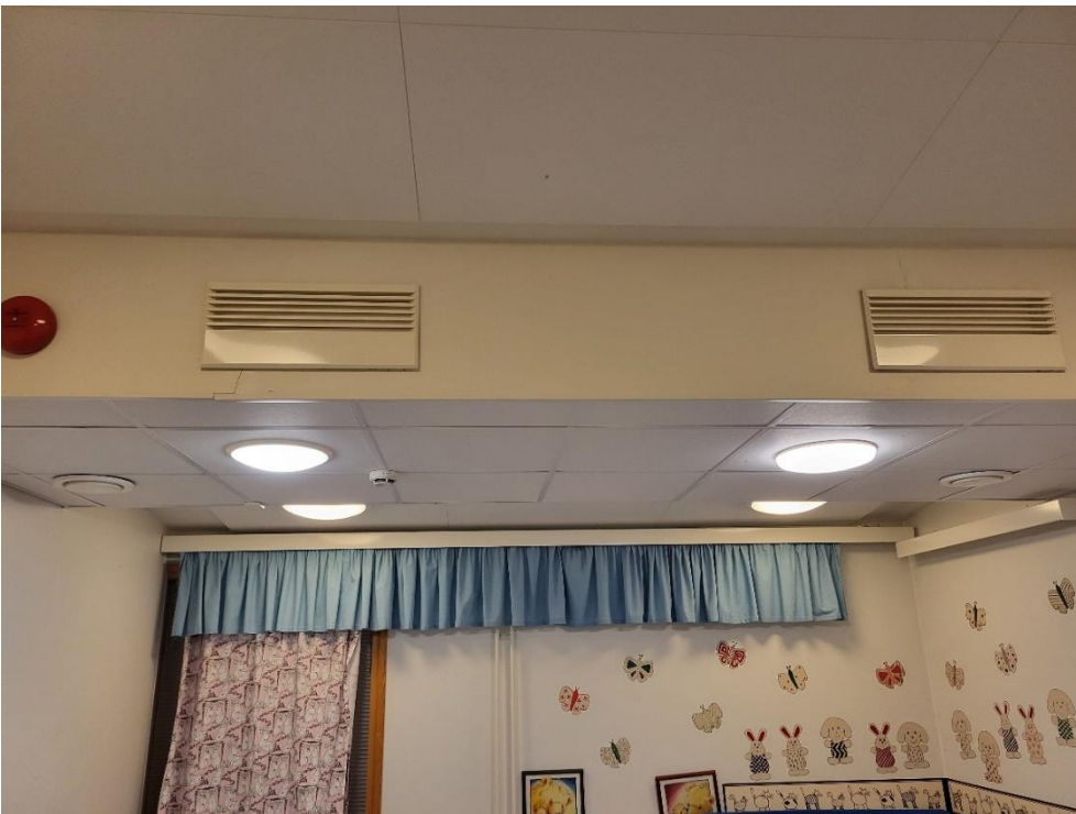
Kuva 4.7. Tila 101 halkeamat tuloilmakanavien vieressä.
