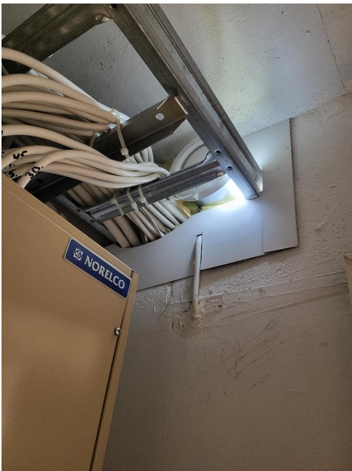
Kuva 4.23. Tila 136 palokatkot puuttuvat läpivienneistä.
