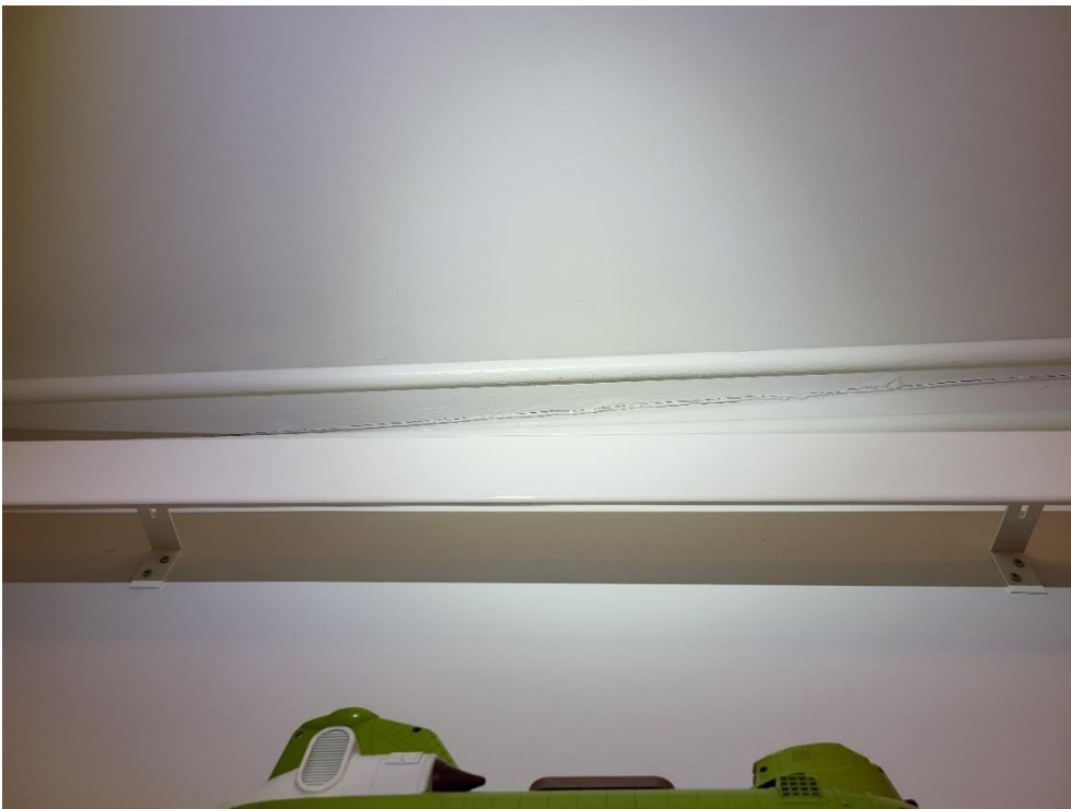
Kuva 4.9. Tila 105 halkeama katonrajassa.
