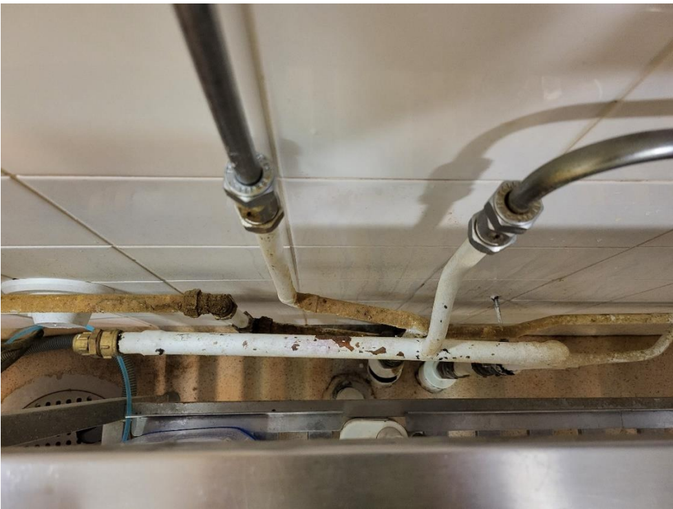
Kuva 4.21. Tila 134 putkien päälle kertynyt likaa.
