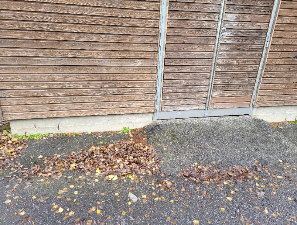
Kuva 4.2. Roskakatoksen sokkelin teräkset näkyvissä.
