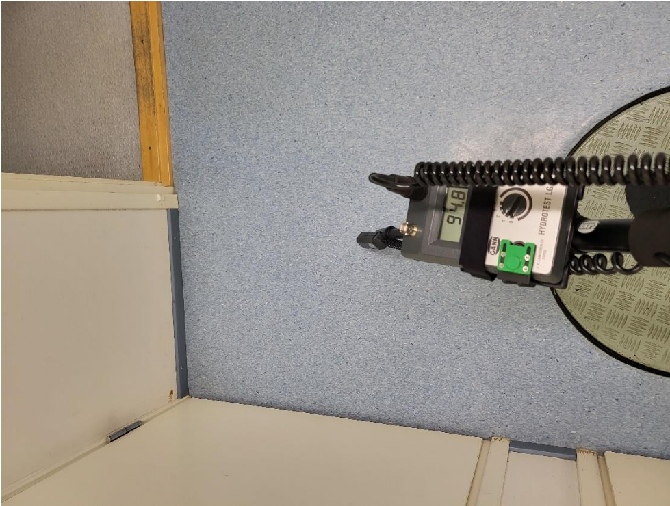
Kuva 4.24. Tila 138 kohonneita lukemia pintakosteusmittarilla lattiassa.
