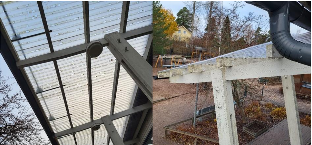
Kuva 4.39. Tilan 116 edessä valokate täynnä reikiä ja rungon huoltomaalaus.
