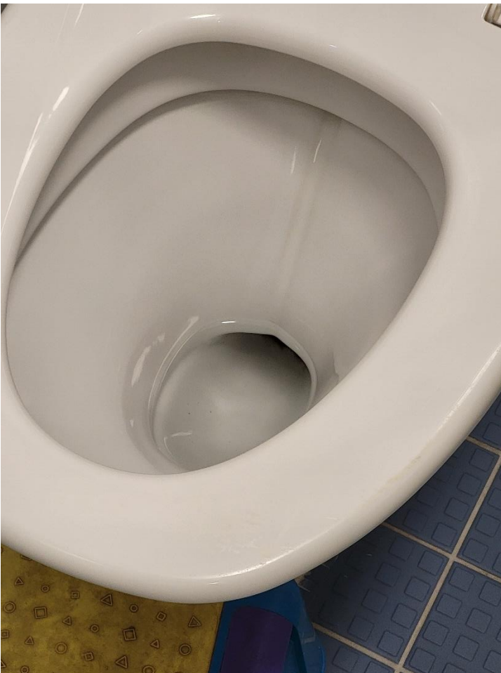
Kuva 4.15. Tila 128 vasemmanpuoleinen wc-istuin vuotaa hieman.
