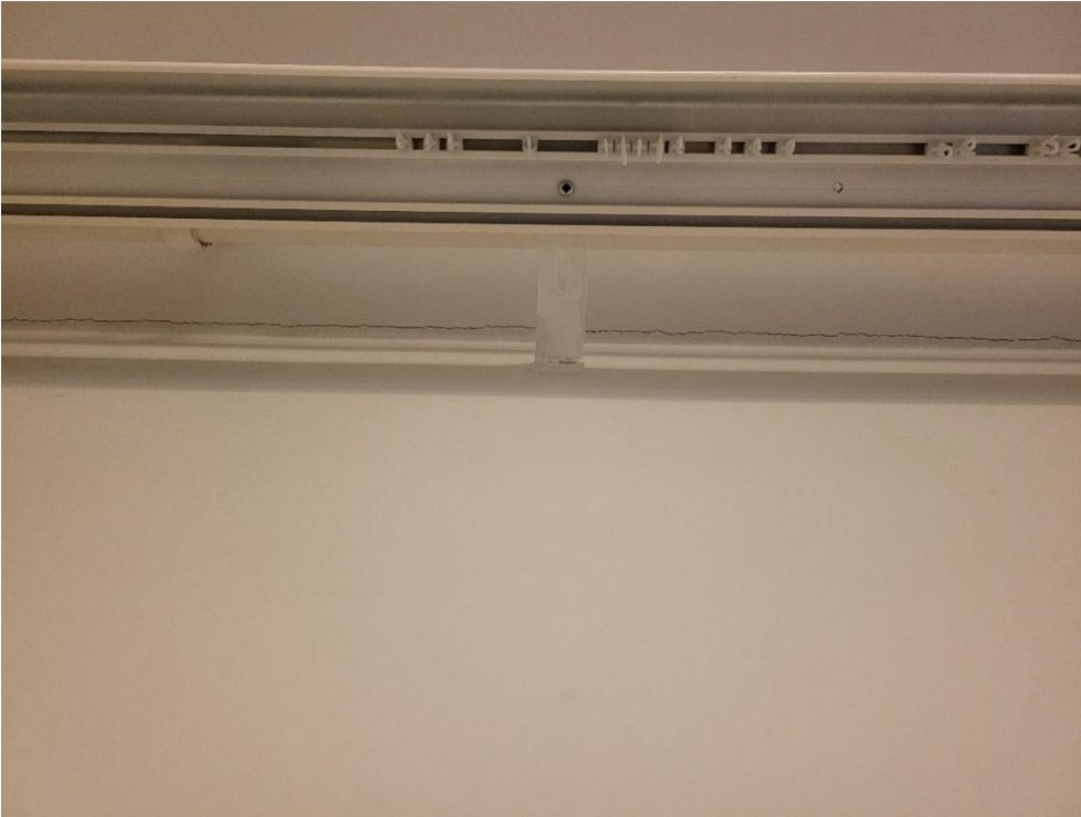
Kuva 4.14. Tila 127 halkeama ulkoseinällä katonrajassa.
