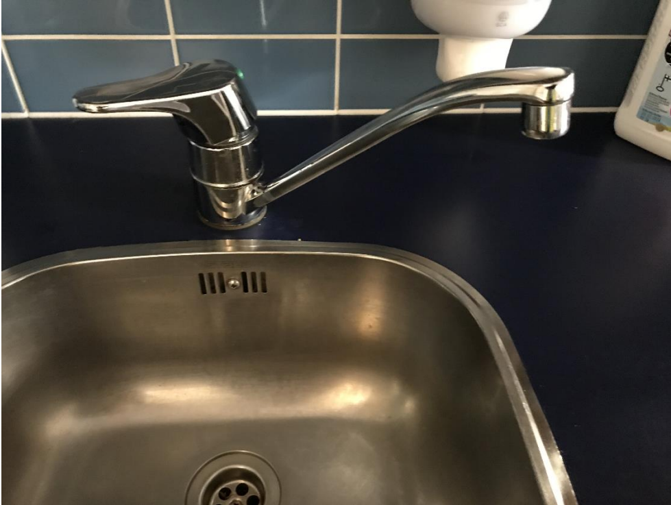
Kuva 5.5. Usean allashanan sivuliikerajoitin on väärä ja vesi pääsee pöydälle.
