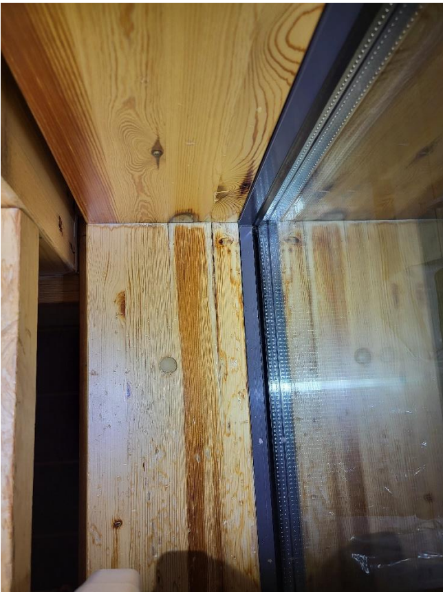
Kuva 4.11. Tila 113 ikkunan karmi saanut vettä aikaisemmin.
