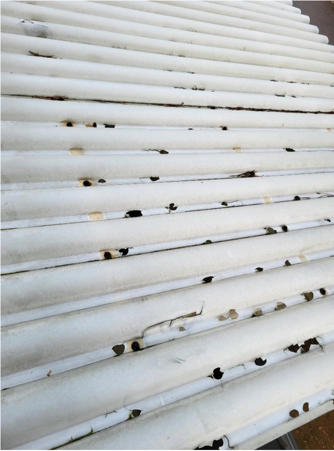
Kuva 4.38. Tilan 113 edessä valokatteessa reikiä.
