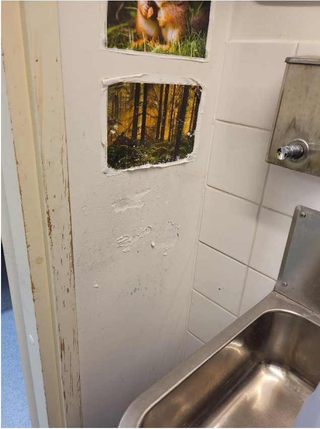
Kuva 4.26. Tila 139 seinässä ja karmissa kulumia.
