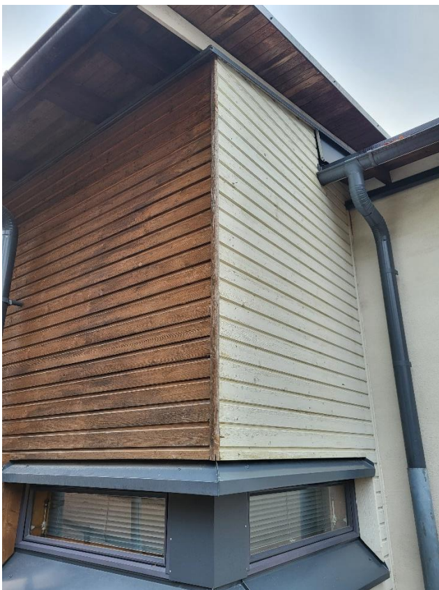
Kuva 4.41. Tilan 131 ulkopuoli naulat nousseet ja huoltomaalaus tehtävä.
