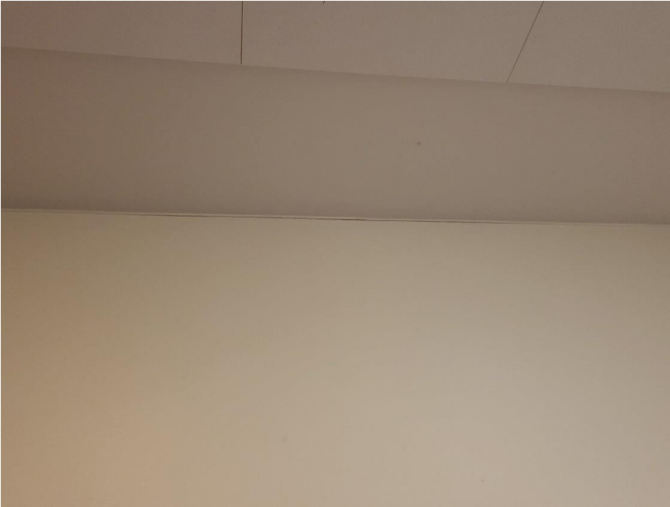
Kuva 4.16. Tila 131 halkeama katonrajassa.
