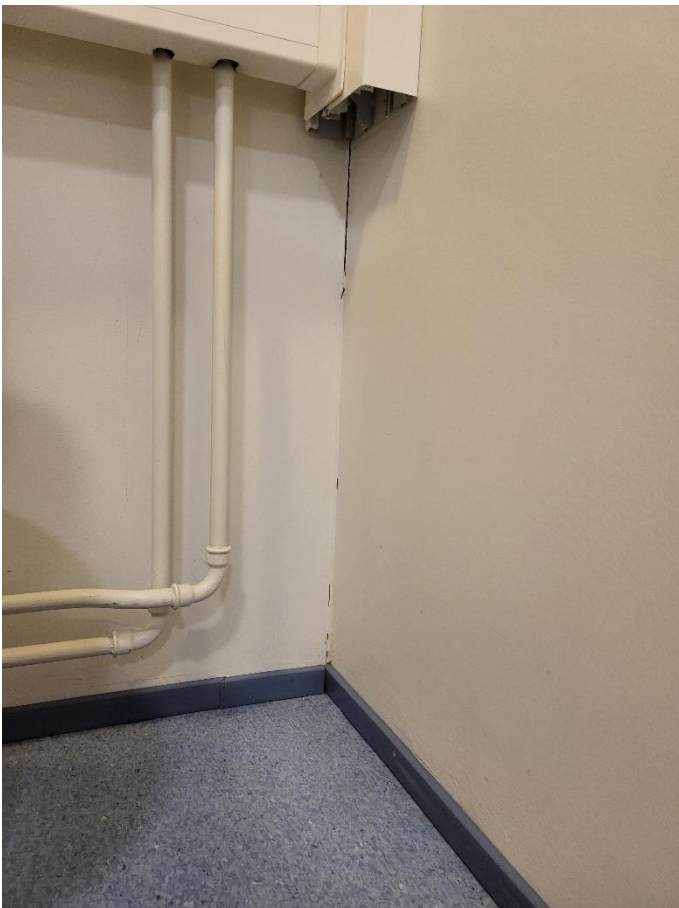
Kuva 4.13. Tila 125 halkeama nurkassa.
