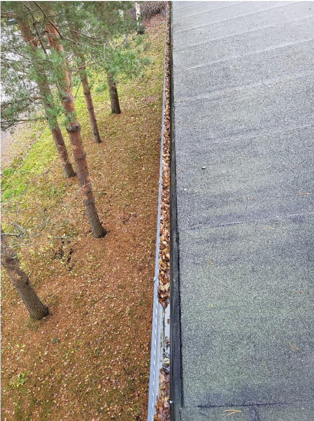
Kuva 4.4. Rännit täynnä lehtiä ja havuja.
