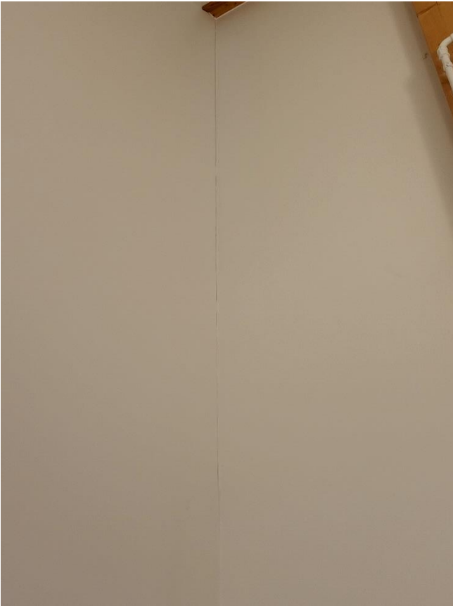
Kuva 4.10. Tila 109 halkeama nurkassa.
