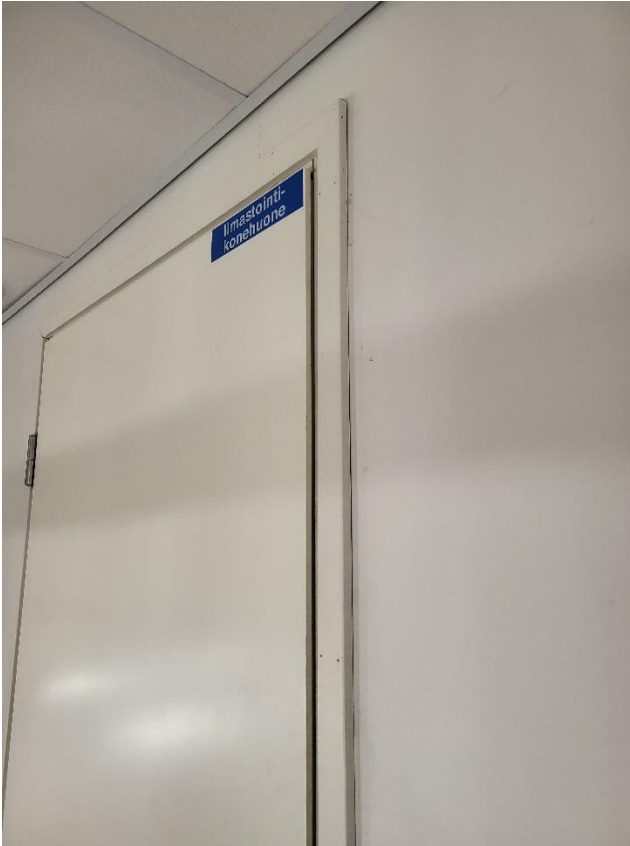
Kuva 4.42. Tilan 203 ovi ei tiivisty yläreunasta.
