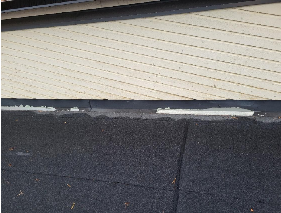
Kuva 4.44. Vesikatto rintapellin pinnoite irronnut.
