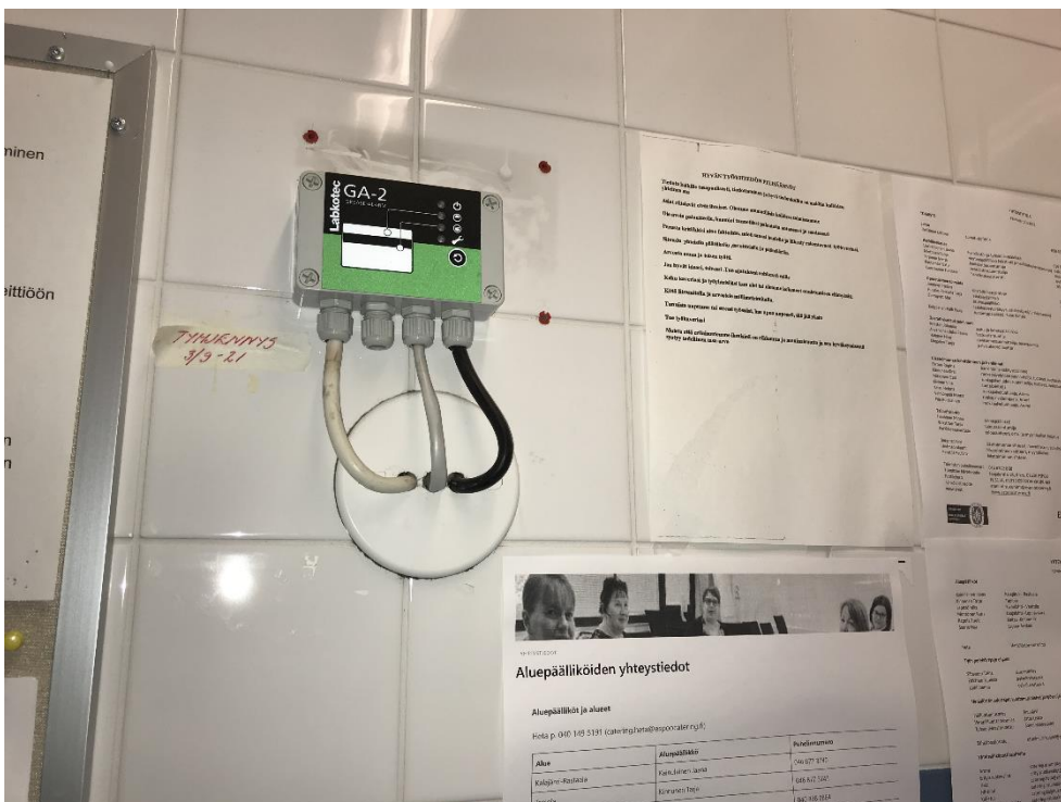
Kuva 5.6. Rasvanerotuskaivon hälytyskeskus on kytketty pois päältä jatkuvien hälytysten takia.
