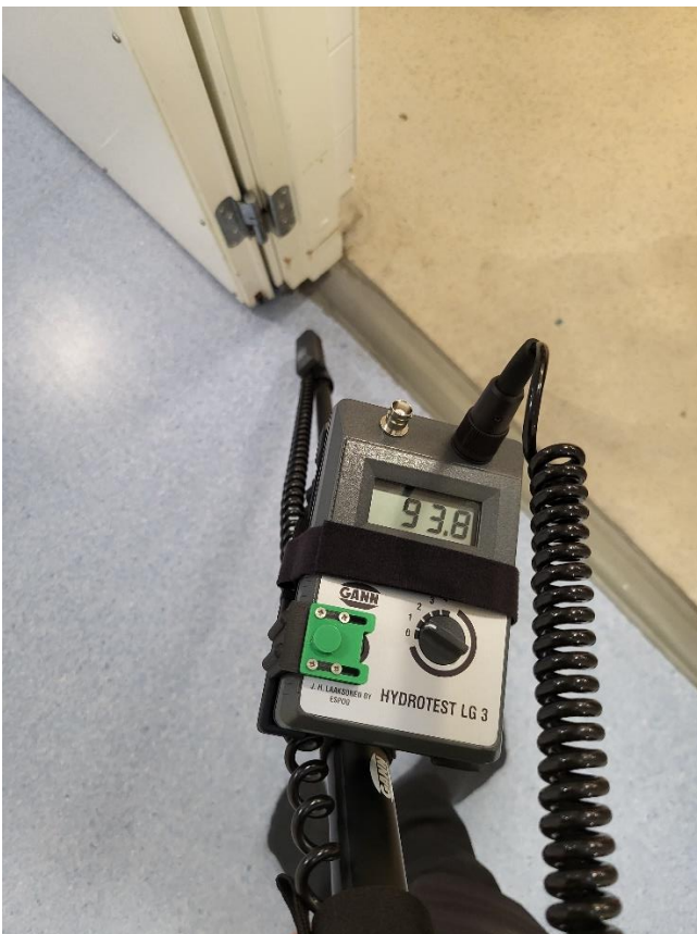
Kuva 4.19. Tila 133 keittiön ovi kohonneita lukemia pintakosteusmittarilla lattiassa.
