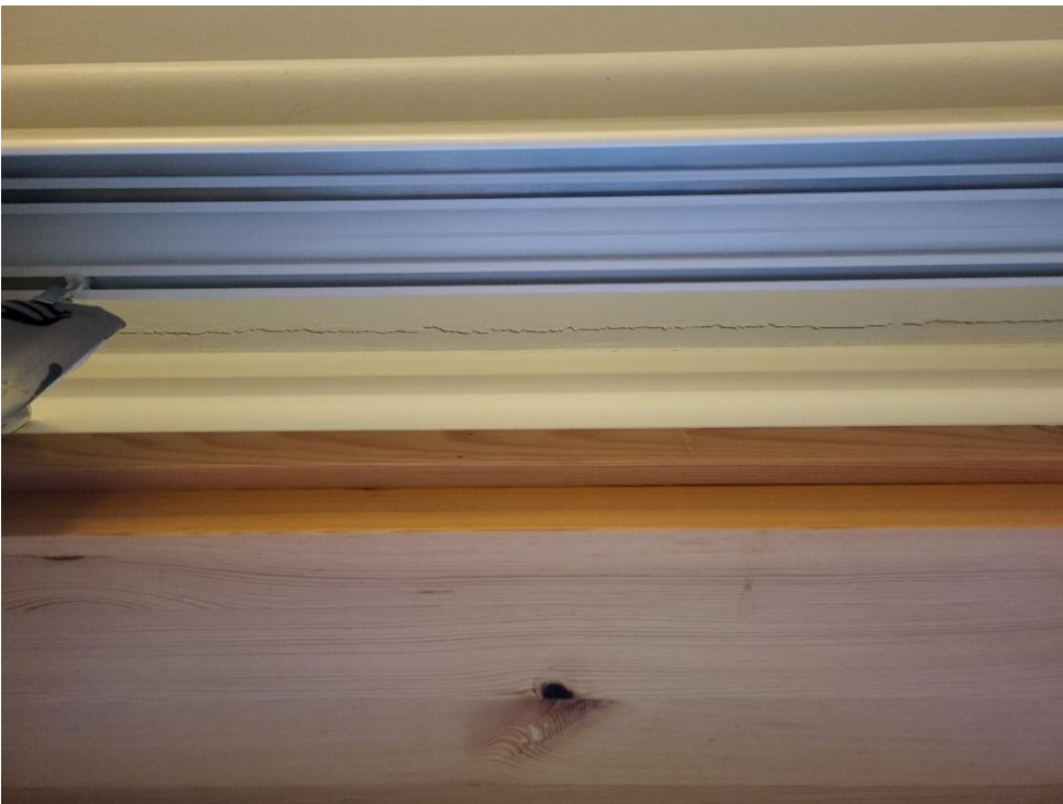
Kuva 4.17. Tila 131 halkeama ulkoseinällä katonrajassa.
