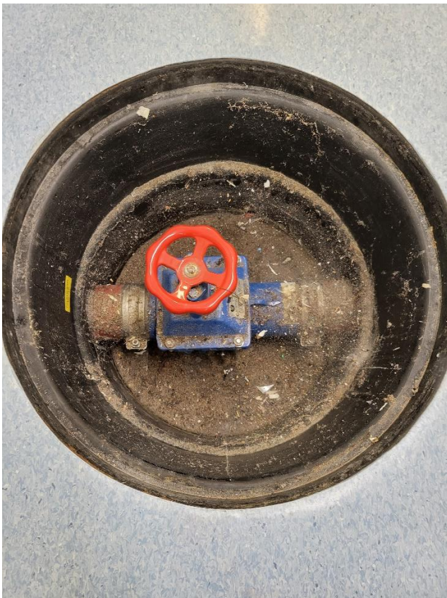
Kuva 4.25. Tila 138 sulkukaivo likainen.
