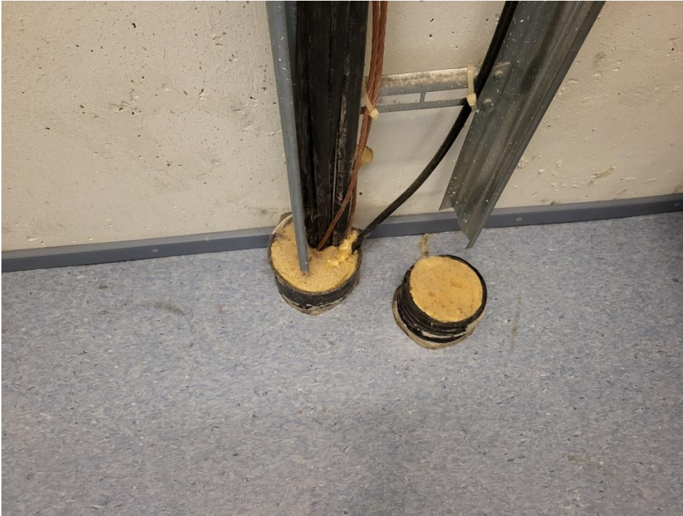
Kuva 4.22. Tila 136 Läpiviennit alapohjaan palokatkot puuttuvat.
