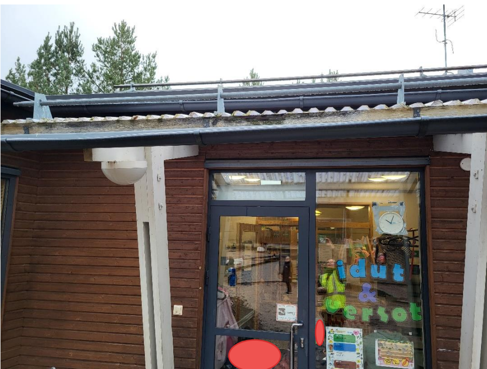
Kuva 4.37. Tilan 108 edessä valokatteessa reikiä ja runko kosteusvaurioitunut.
