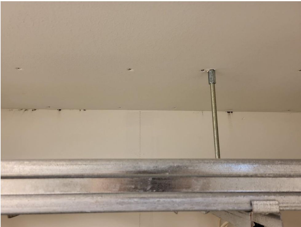
Kuva 4.35. Tila 204 katonrajassa ilmavuotoja.
