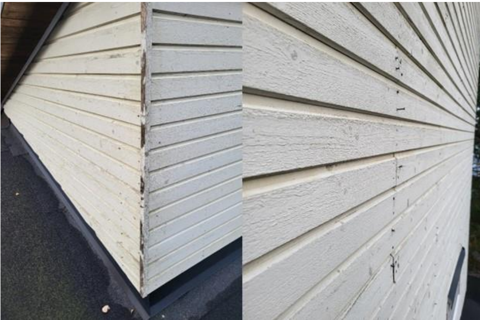
Kuva 4.43. Julkisivun ulkovuorauspanelointien naulat nousseet ja huoltomaalaus.
