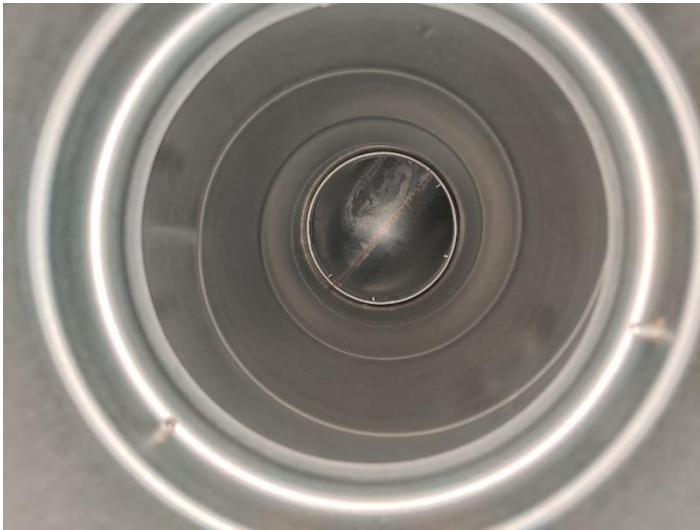
Kuva 3. Tuloilmakanavissa havaittiin hieman pinttynyttä likaa mutta ei pölyä. Kuva vanhan osan opetustilasta SK1009.
