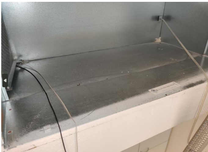
Kuvat 1, 2. Tuloilmapäätteissä havaittiin hieman pinttynyttä likaa mutta ei pölyä. Päätteissä ei havaittu mineraalikuitulähteitä. Kuvat vanhan osan opetustiloista SK1022 ja SK1009
