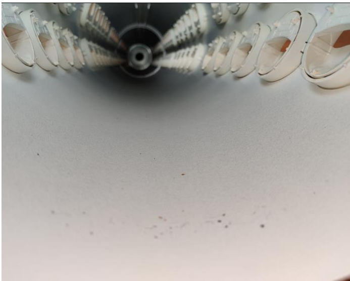
Kuva 4. Tuloilmakanava puhdas, vain hieman irtoroskaa. Kuva laajennusosan tilasta SK1029.
