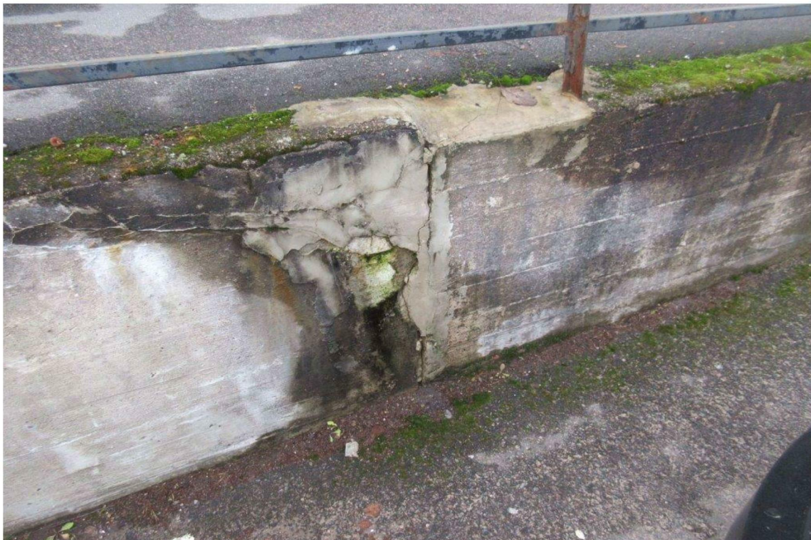
Kuva 6: Itäosalla oleva tukimuuri on vaurioitunut. Tukimuurin yhteydessä olevan tason vedeneristeet uusitaan.
