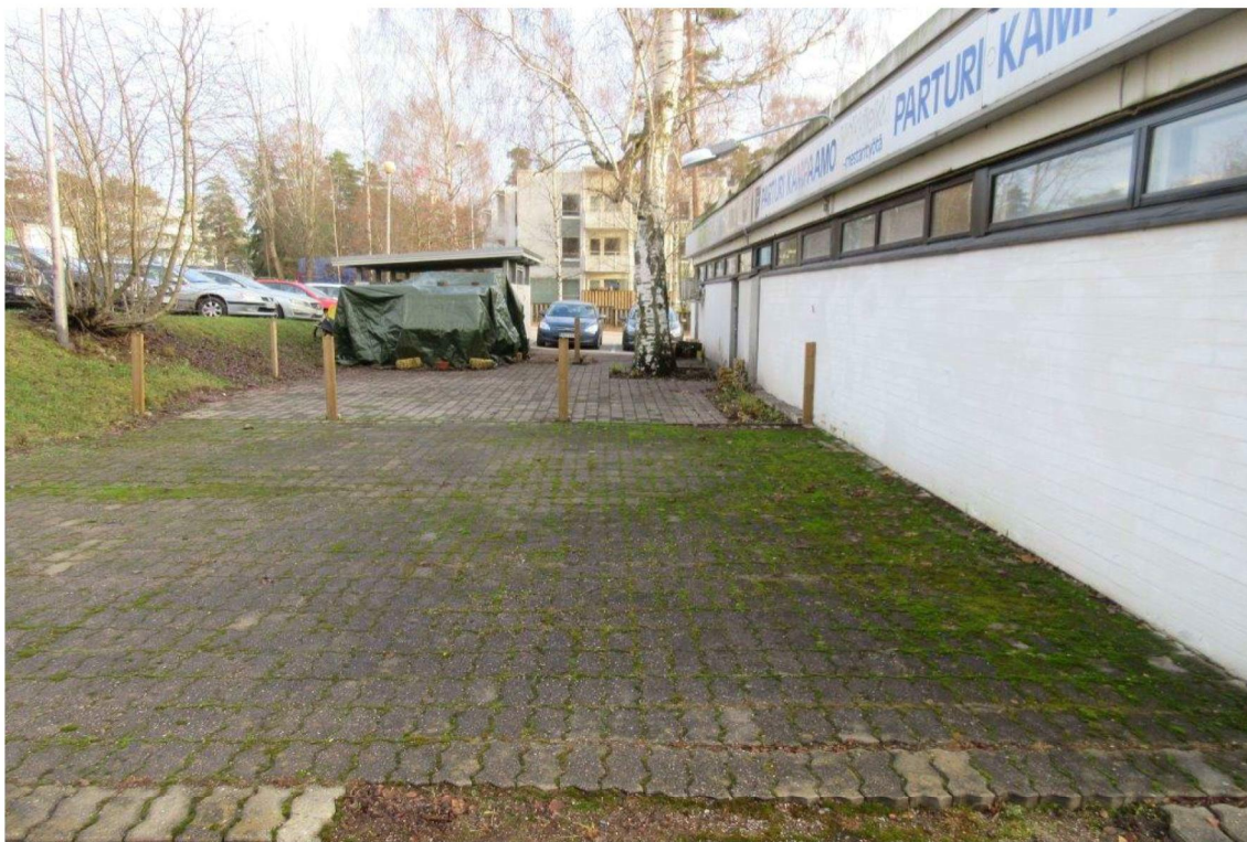
Kuva 1: Pihapinnat kallistavat paikoin rakennusta kohti, mikä lisää rakenteisiin kohdistuvaa kosteusrasitusta.
