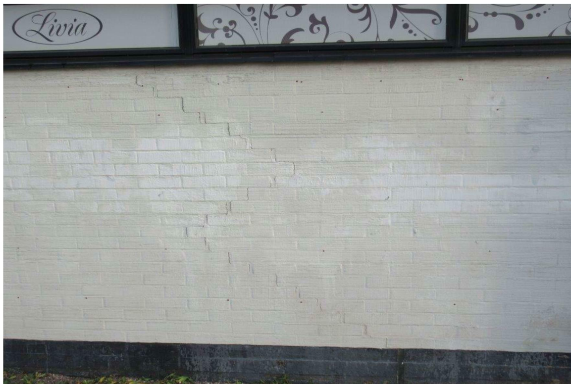
Kuva 2: Länsipuolella ulkoseinässä olevat halkeamat voivat olla viitteitä perustusten painumisesta. Halkeamien leveyttä tulee seurata säännöllisesti.
