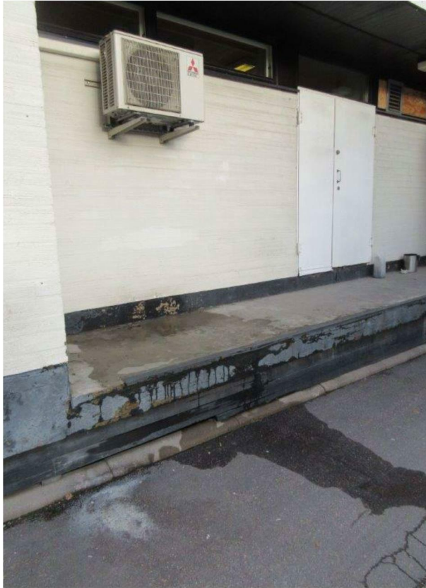
Kuva 3: Eteläseinällä ilmalämpöpumpun ulkoyksikön kondessivedet ovat kasteleet seinärakennetta.
