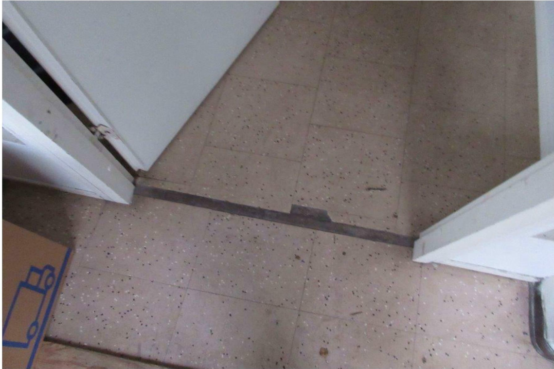
Kuva 9: Esimerkiksi vanhat lattiapinnat ja niiden kiinnitysliimat saattavat sisältää asbestia tai muita haitta-aineita.
