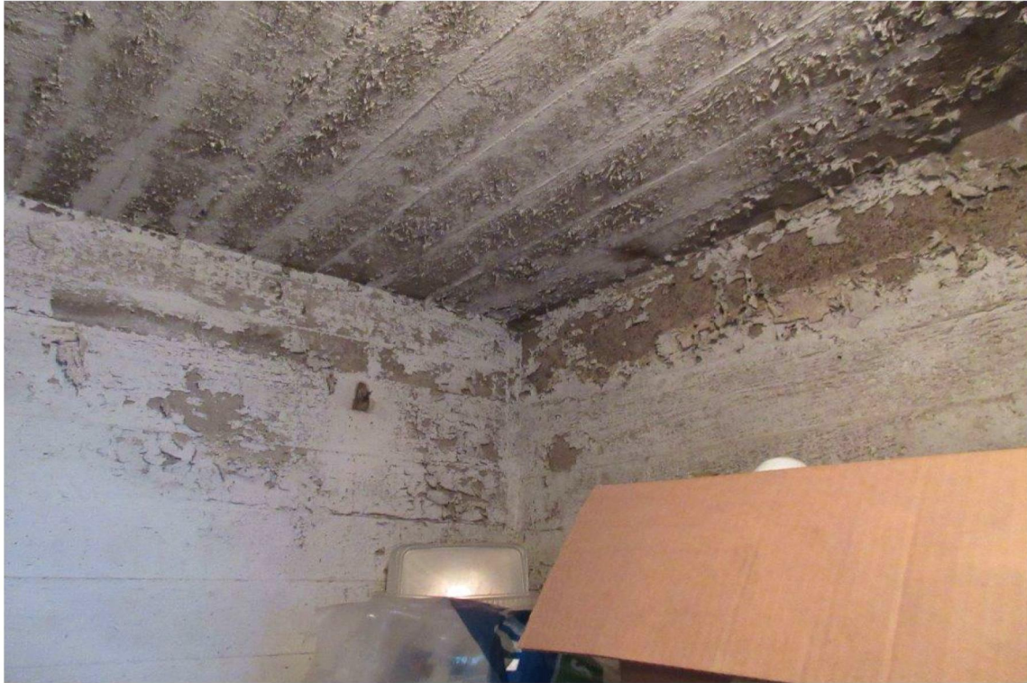
Kuva 5: Kellarin pintarakenteet ovat monin paikoin kosteusvaurioituneet.
