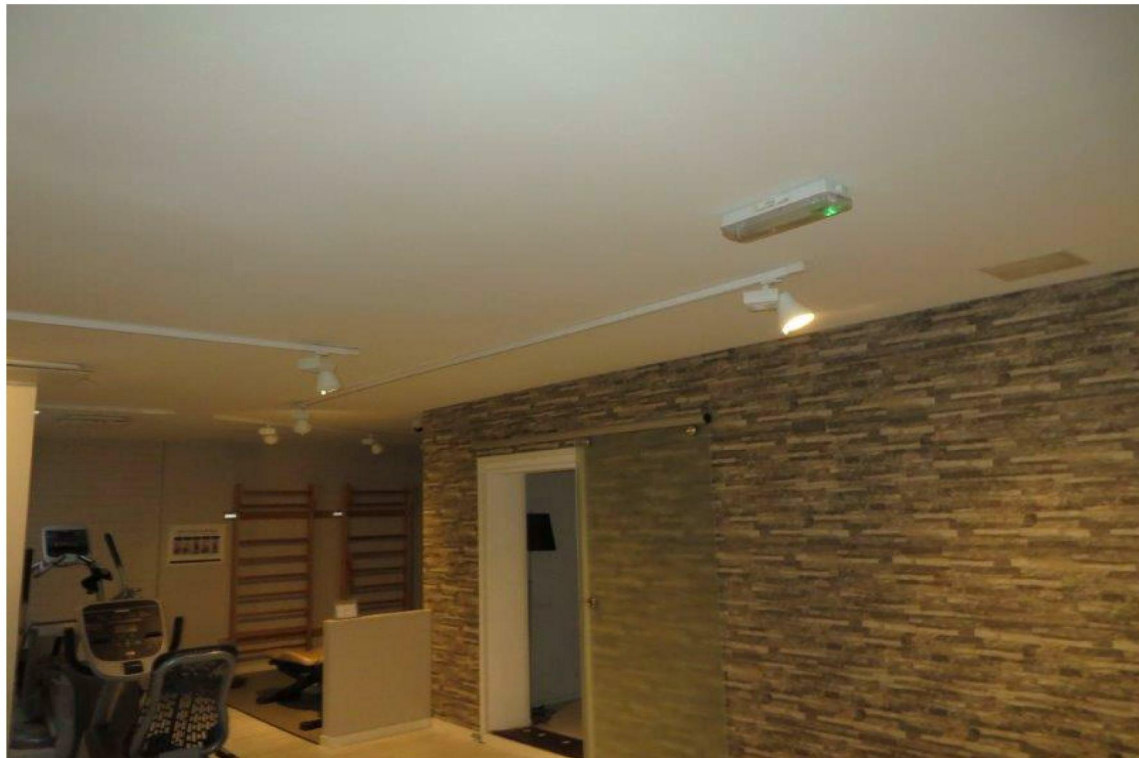
Kuva 6: Livia Clubin liiketilan sähköasennukset on laajasti uusittu vuonna 2012. Tilaan on asennettu myös turvavalaisimia.
