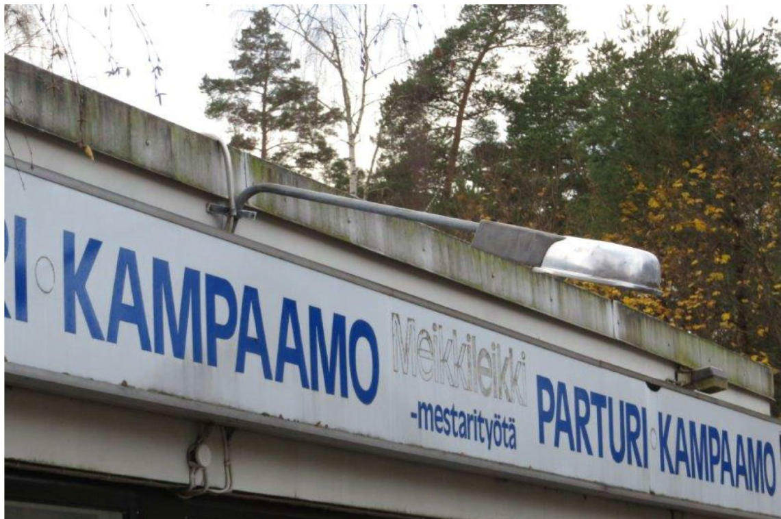
Kuva 8: Julkisivuissa on elohopealamppuvalaisimia, jotka tulee lammputdirektiivin vuoksi uusia. Rakennuksessa on myös välttäväkuntoisia mainosvalorakenteita, jotka tulee uusia tai purkaa.
