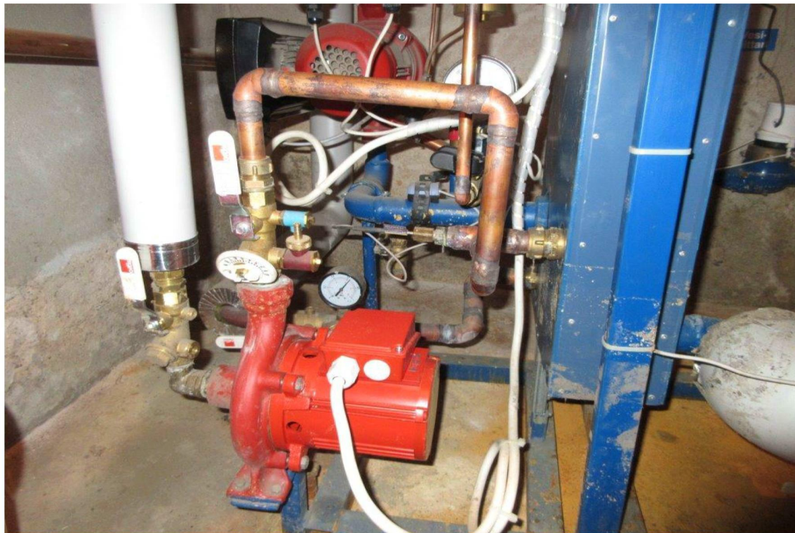
Kuva 1: Kaukolämpökeskus on vuodelta 2009 ja sen oletetaan toimivan normaalein huoltotoimenpitein tarkastelujakson yli.
