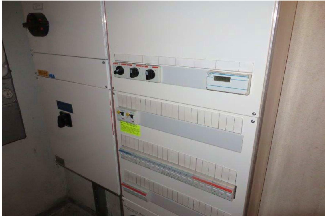
Kuva 1: Rakennukseen on asennettu uusi pääkeskus vuonna 2007.
