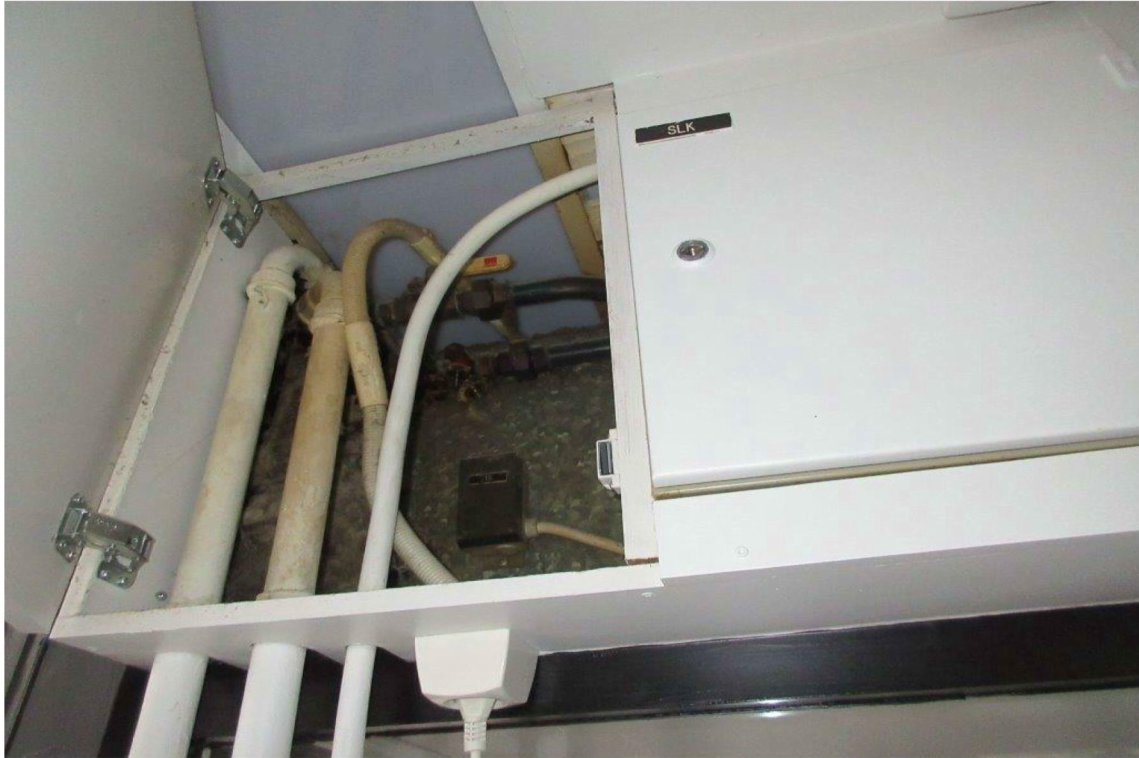
Kuva 5: Ravintolatilán todennäköisesti alkuperäinen tuloilmakone on hankalasti huollettavassa paikassa. Kone ehdotetaan uusittavaksi tarkastelujakson alkupuolella.
