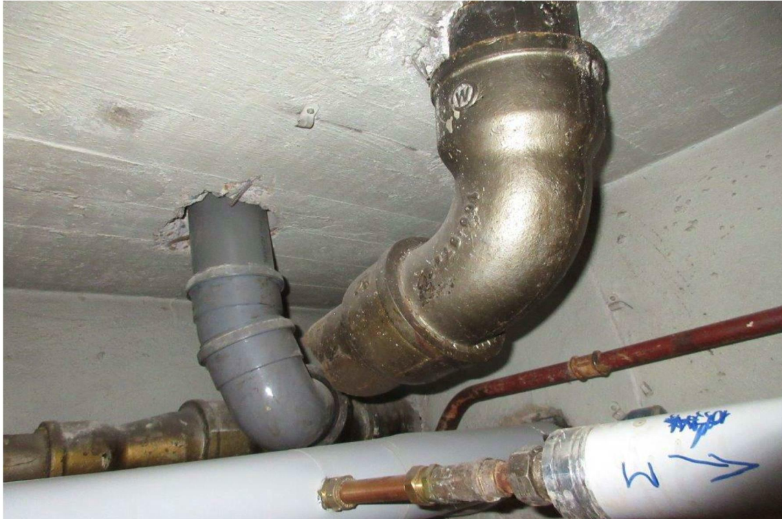
Kuva 3: Alkuperäistä valurautaviemäriä lämmönjakokeskuksen katossa. Joitakin osuuksia on vaihdettu muovisiksi vuokralaisten tilamuutosten yhteydessä.
