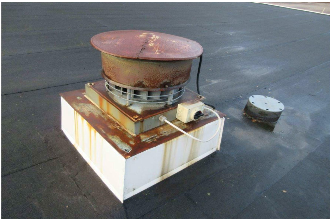
Kuva 6: Vesikatolla on useita pahasti ruostuneita alkuperäisiä poistoilmapuhaltimia, jotka ehdotetaan uusittaviksi tarkastelujakson alkupuolella.
