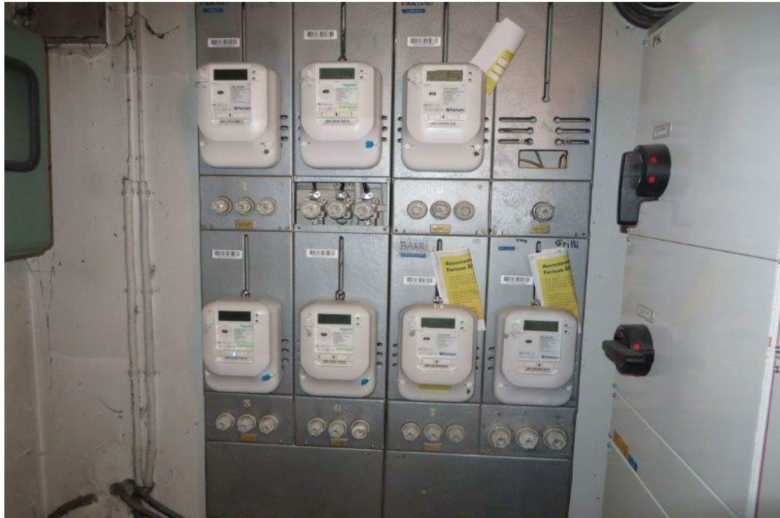
Kuva 3: Mittarikeskus on vuodelta 1962. Siihen on asennettu etäluettavat laskutusmittarit vuonna 2014.
