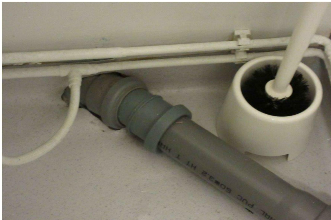
Kuva 8: Uudemmissa märkätiloissa havaittiin puutteellisesti tiivistettyjä lattialäpivientejä.
