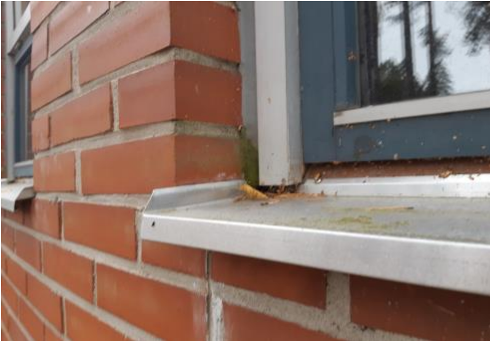
Kuva 4.12. Ikkunapeltien kaato ei ole riittävä.
