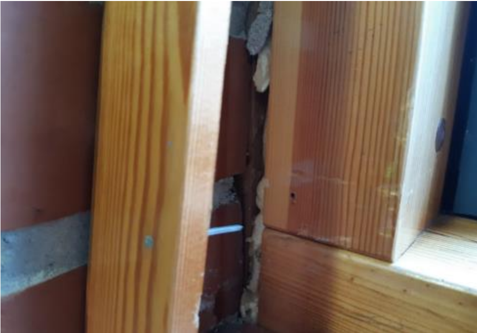
Kuva 4.10. Ikkunakarmi- ja seinäliittymissä on ilmavuotoja.
