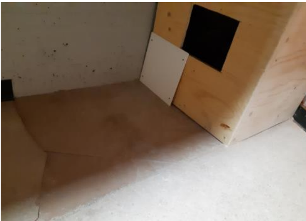
Kuva 4.9. Parven 24 pöydän alla lattiapinnoitetta puuttuu, nurkassa olevan sähkökotelon sisällä on mineraalivillaa näkyvissä ja tarkistusluukun kansi on irti.
