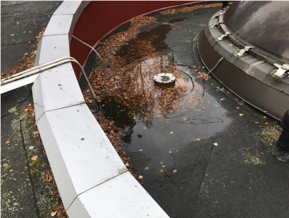
Kuva 5.8. Vesikaton kaivoissa on lehtiä ja muuta roskaa ja vesi seisoo katolla.
