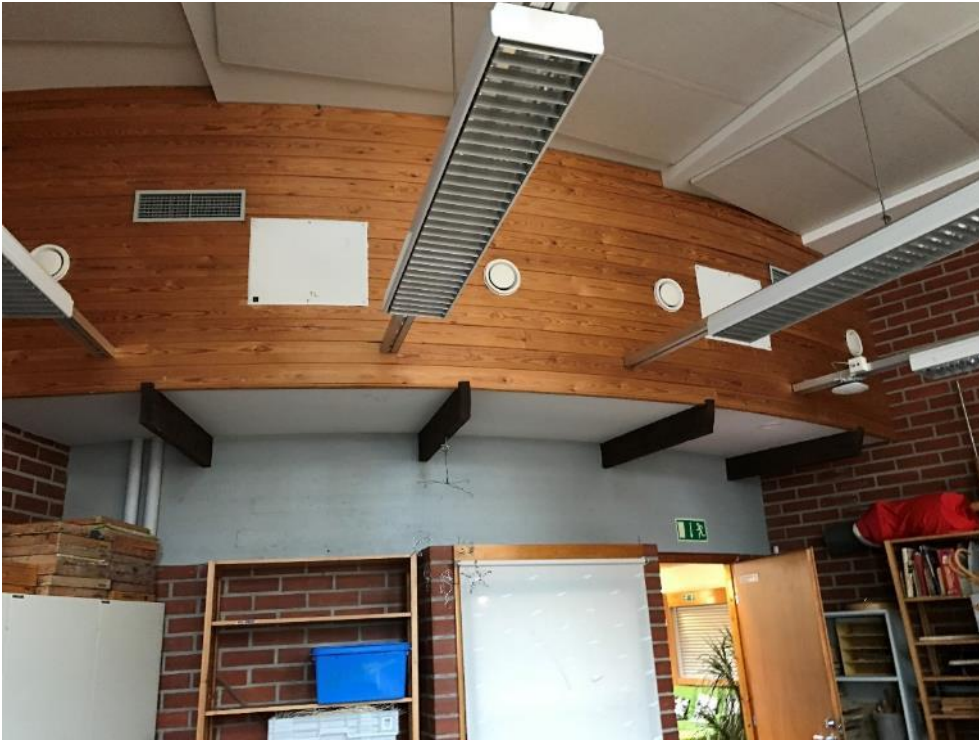
Kuva 5.2. Tuloilmapäätelaitteet ovat vanhoja eikä niissä ole kunnollista säätömahdollisuutta.
