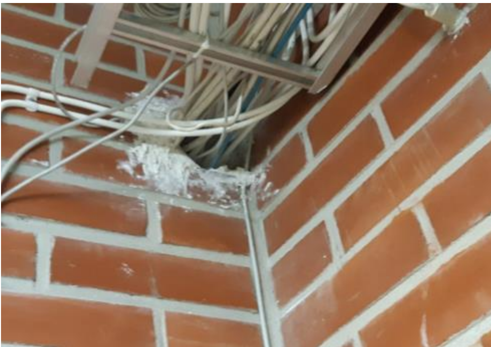
Kuva 4.3. Sähköpääkeskuksessa 11A sähköjohtojen läpiviennin palokatko ei ole tiivis.
