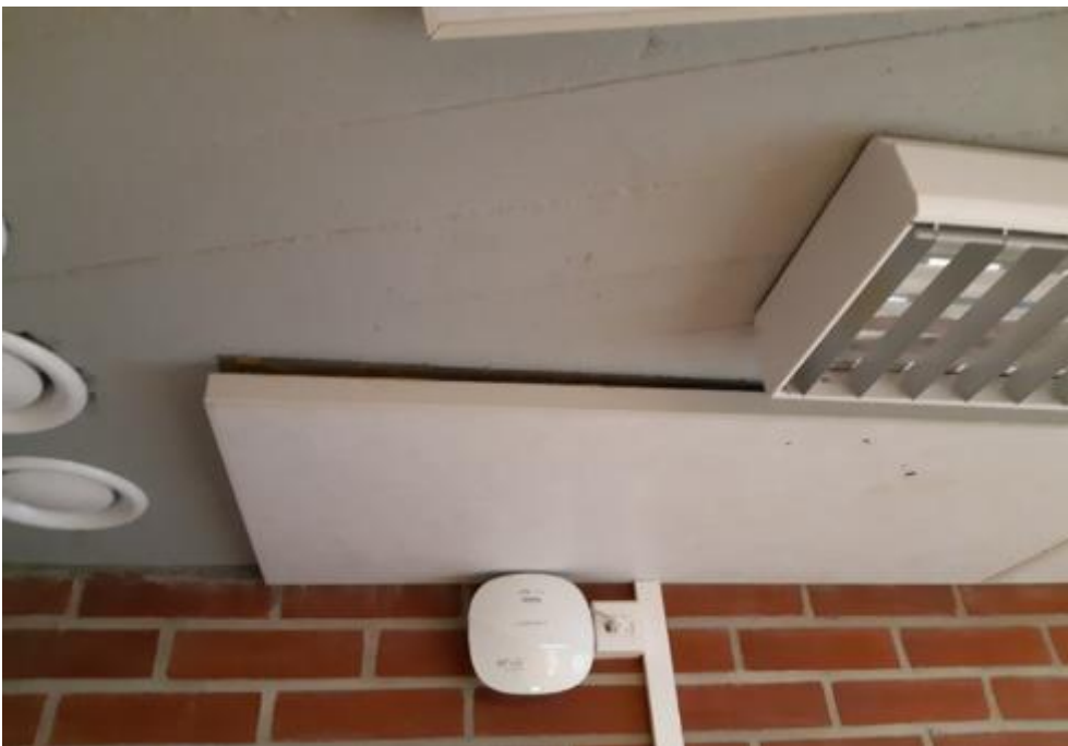
Kuva 4.7. Kokoushuoneen 21 katon akustolevy on irtoamassa.
