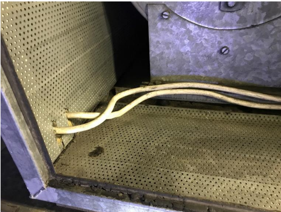
Kuva 5.1. Raitisilmakammion ja ilmanvaihtokoneiden sisäpuoli on tehty reikäpellistä, minkä alla on vuorivillaa.
