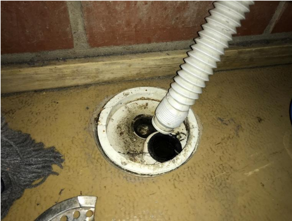
Kuva 5.6. Siivouskomeron lattiakaivosta puuttuu puhdistustulppa.
