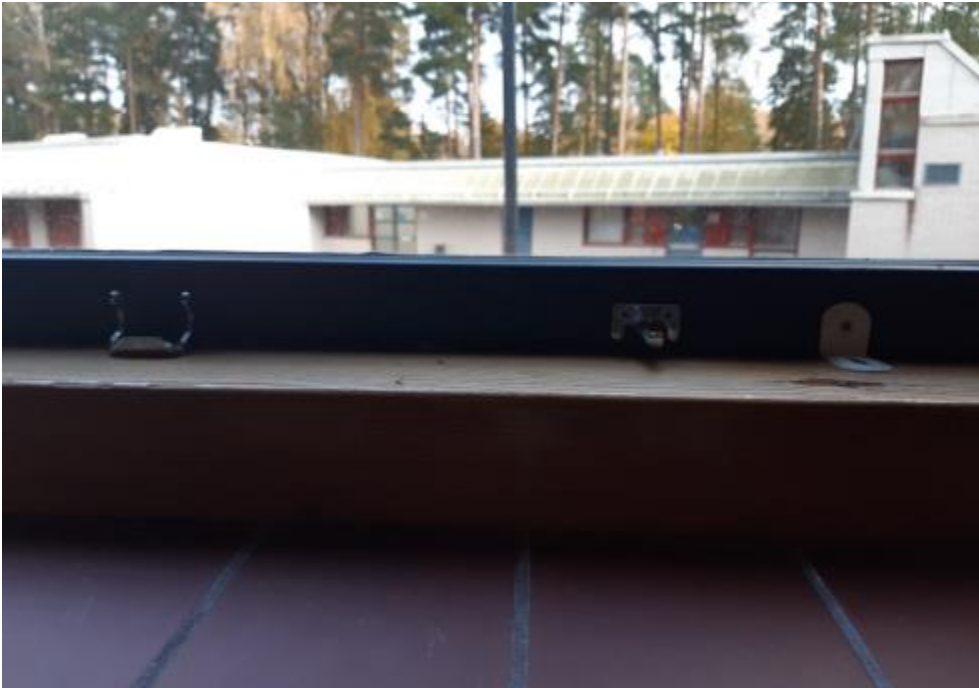
Kuva 4.6. Kokoushuoneen 20 tuuletusikkunan aukipitolaite on rikki.
