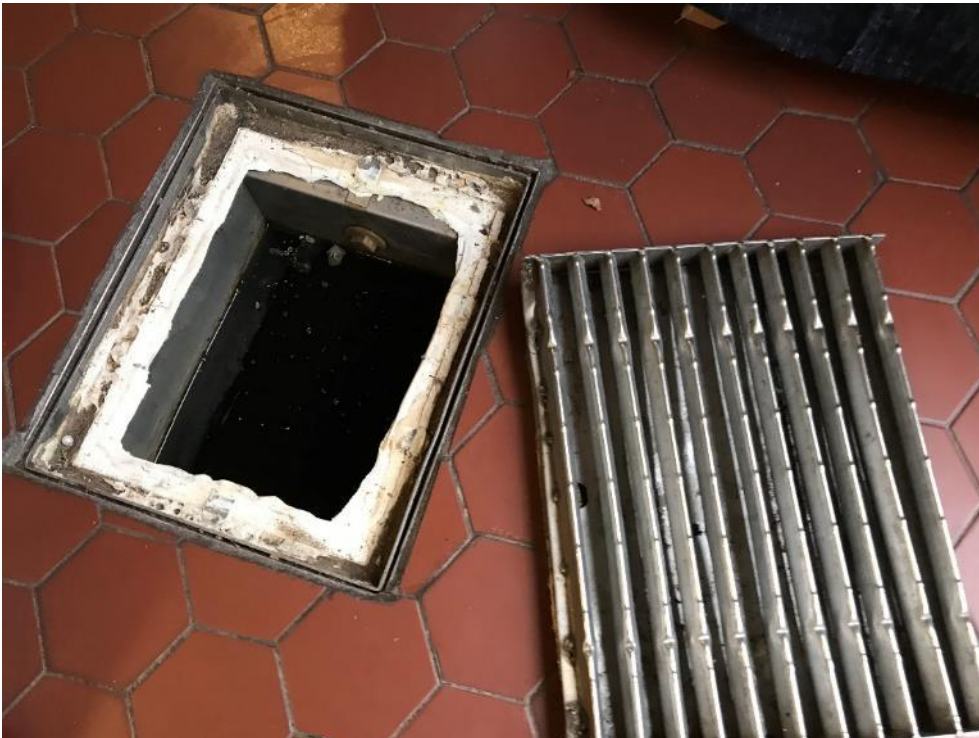
Kuva 5.7. Aulassa on tarpeeton lattiakaivo.
