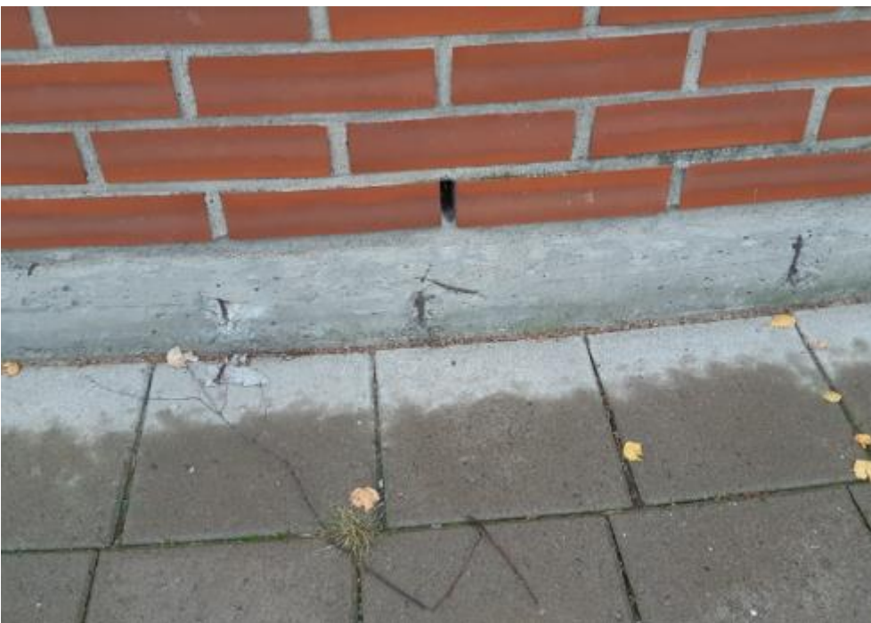
Kuva 4.11. Sokkeliraidoituksia on korkannut esiin.
