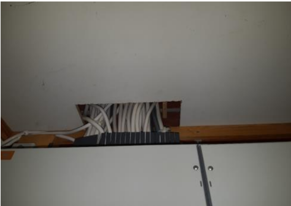
Kuva 4.5. Sähköjakokeskuksen JK1 sähköjohtojen läpivienti on avoin.
