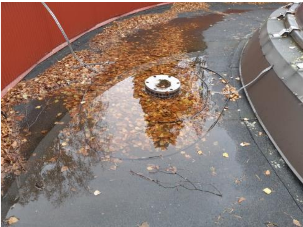
Kuva 4.13. Katolle kertyy puidenlehtiä, jotka tukkivat sadevesikaivoja.
