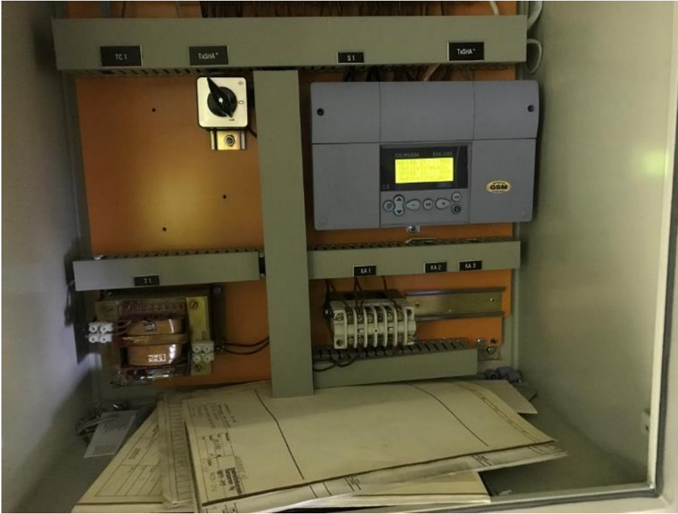
Kuva 6.1. Rakennusautomaation VAK 1 Säädin.
