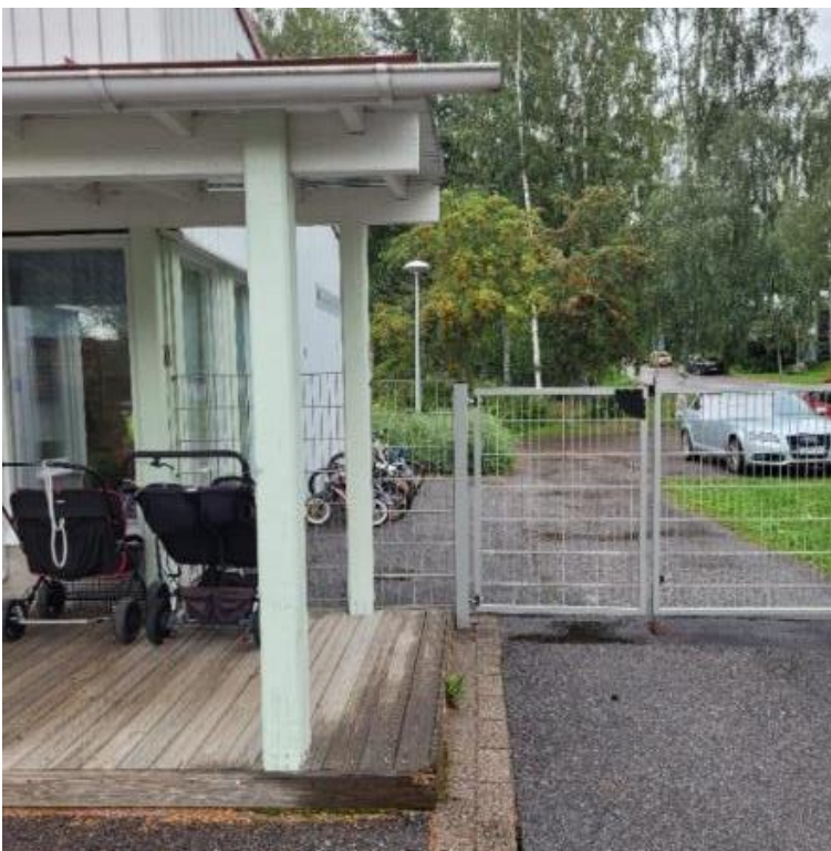
Kuva 4.28. Tilan 101 edessä olevan katoksen sadevedenpoiston johtaminen on puutteellinen. Pystytolpan alaosa altis jatkuvalle kosteusrasitukselle. Puuosat ovat liian lähellä maanpintaa. Vesi roiskuu puuosiin ja syö asfaltin ja kiveyksen välistä maa-ainesta.
