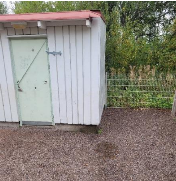
Kuva 4.24. Ulkovarastojen sadevedenpoistojen johtaminen on puutteellinen. Ulkoverhouslaudoitus on alle 30 cm maanpinnasta. Sokkelin jatkuva kosteusrasitus rapauttaa betonia ja altistaa liittyvät puuosat kosteudelle. Sokkelista ei havaittu patolevyä.
