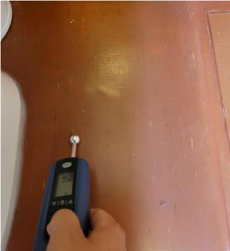
Kuva 4.3. Tilan 113 oikeanpuoleisen wc-istuimen vieressä on kohonneita pintakosteuslukemia.
