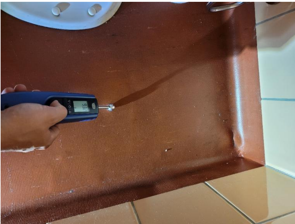
Kuva 4.12. Tilan 122 pienen wc-istuimen vieressä on kohonneita pintakosteuslukemia.
