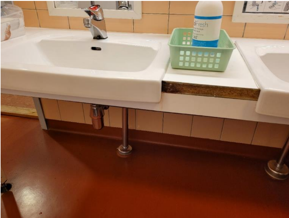
Kuva 4.11. Tilan 122 pesualtaiden pöytälevyssä on vaurioitunutta materiaalia.
