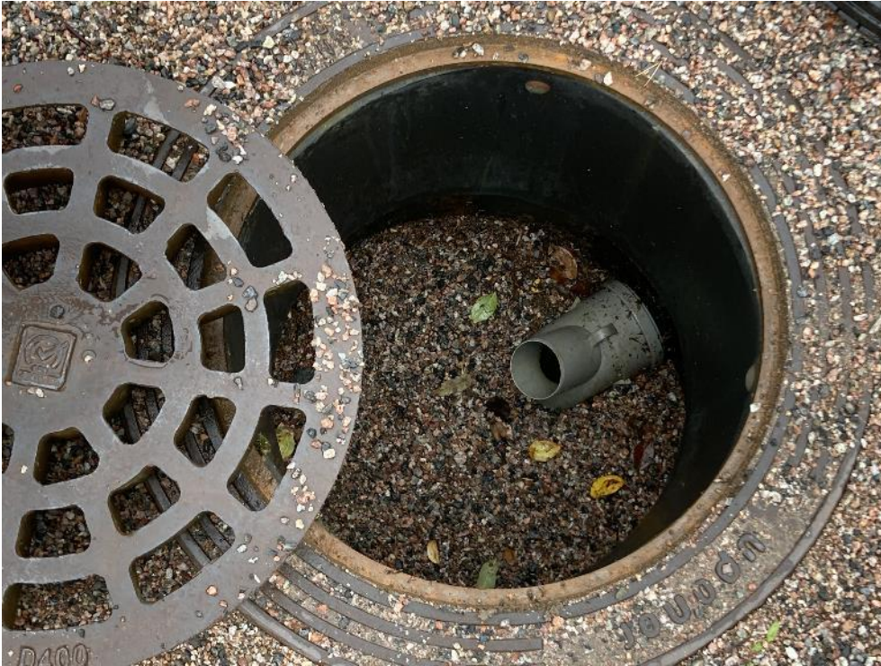
Kuva 5.8. Sadevesikaivoissa on runsaasti hiekkaa.
