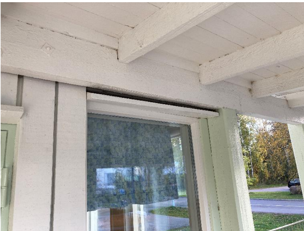
Kuva 4.32. Linnuilla todennäköisesti pesä seinän sisällä kuraateisen 101 kohdilla. Auki olevasta laudanraosta lensi lintuja ulos ja sisään.
