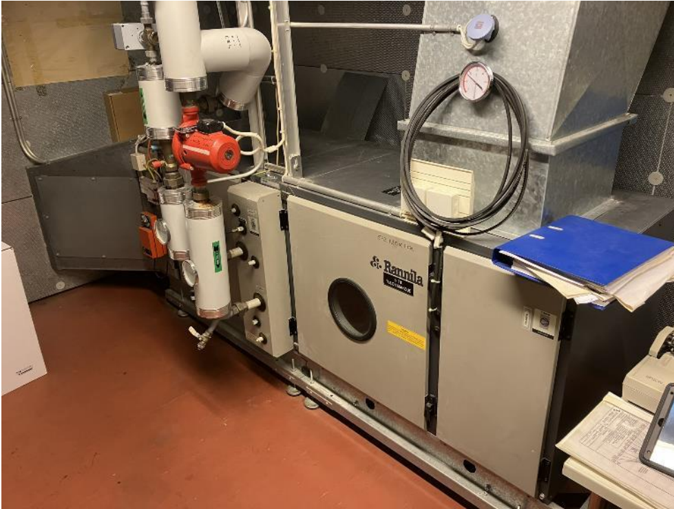
Kuva 5.2. Keittiön TK5 tuloilmakoneesta puuttuu viemäröinti.
