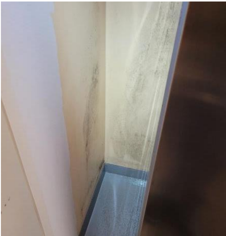
Kuva 4.8. Tilan 120 seinän pinnassa on mikrobivaurio, joka on johtunut kylmäkaapin ja seinän välisestä kondensoitumisesta.
