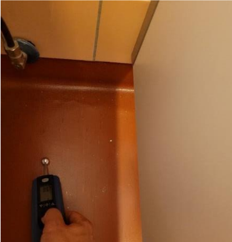
Kuva 4.5. Tilan 113 vasemmanpuoleisen wc-istuin vieressä on kohonneita pintakosteuslukemia.
