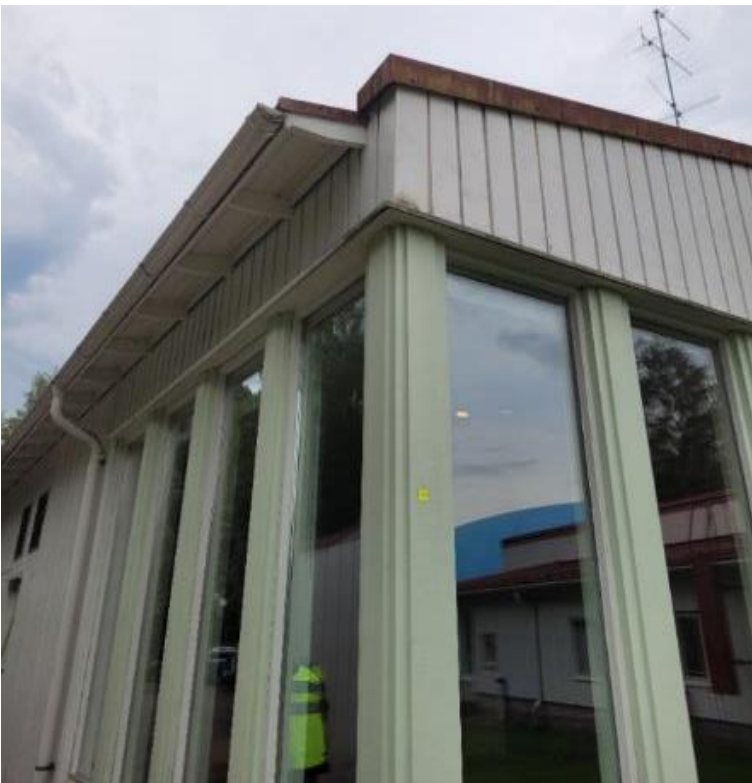
Kuva 4.26. Tilan 137 ulkopuolella räystäspelti tiputtaa vettä alemman pellin kautta puosiin.
