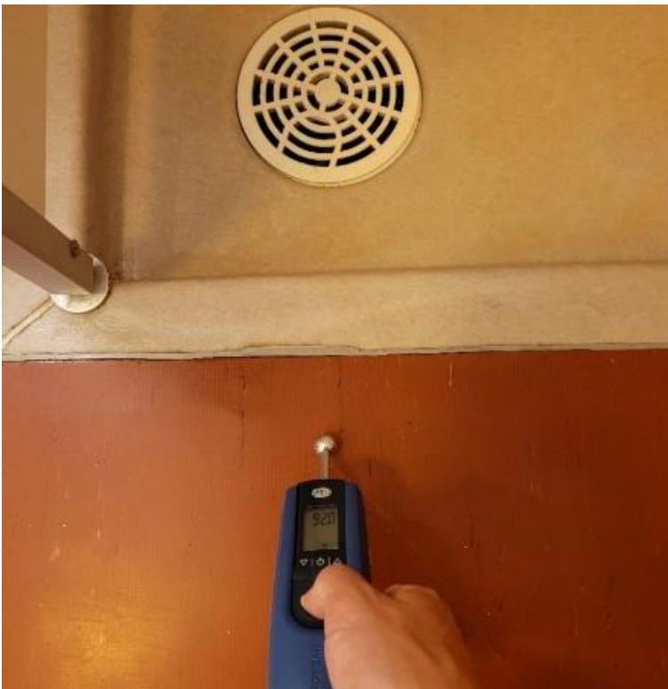
Kuva 4.16. Tilan 140 suihkussa on kohonneita pintakosteuslukemia.
