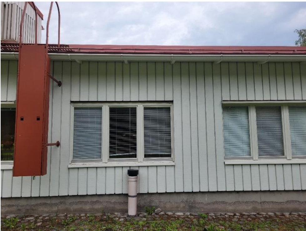
Kuva 4.30. Tilan 147 ikkunan yläpelti puuttuu. Sokkelissa vesi on noussut kapilaarisesti. Sokkelin vedeneriste on puutteellinen.
