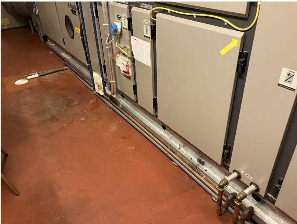
Kuva 5.1. Ilmanvaihtokoneista puuttuvat takaimusuojat.
