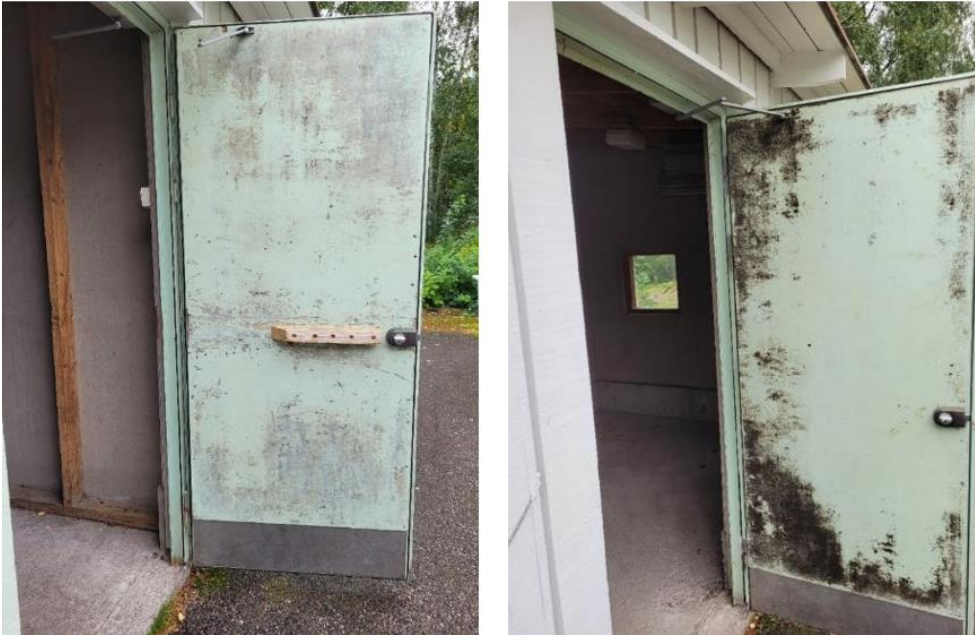
Kuva 4.31. Roskakatoksen vasen ja oikea ovi ovat mikrobivaurioituneet. Vasenta ovea on yritetty puhdistaa.
