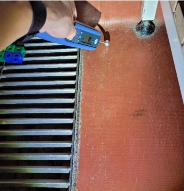
Kuva 4.21. Tilan 152 kurasyöpön vieressä on lattia kostea.
