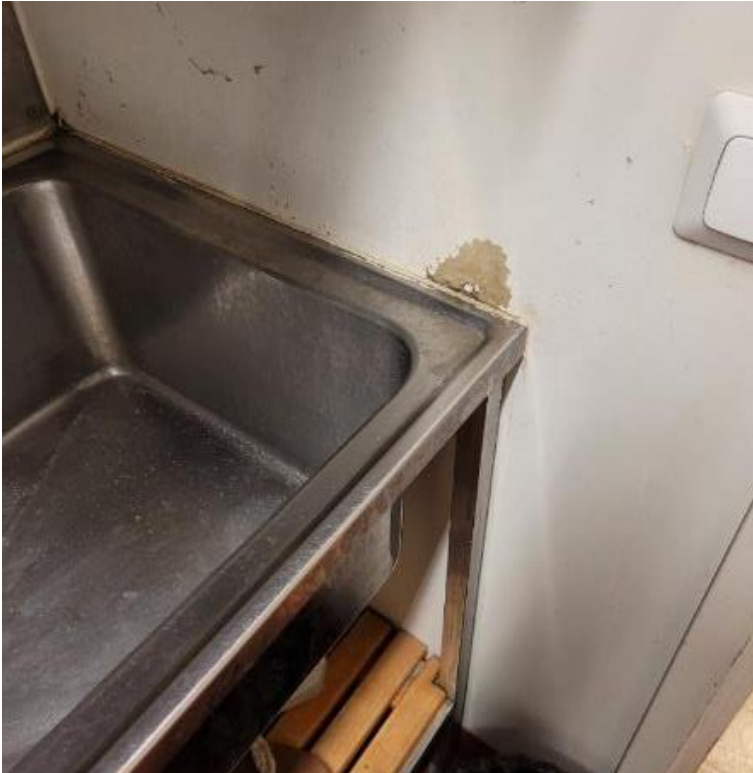
Kuva 4.7. Tilassa 119 roiskevesi kastellut seinää, mutta on nyt kuiva.
