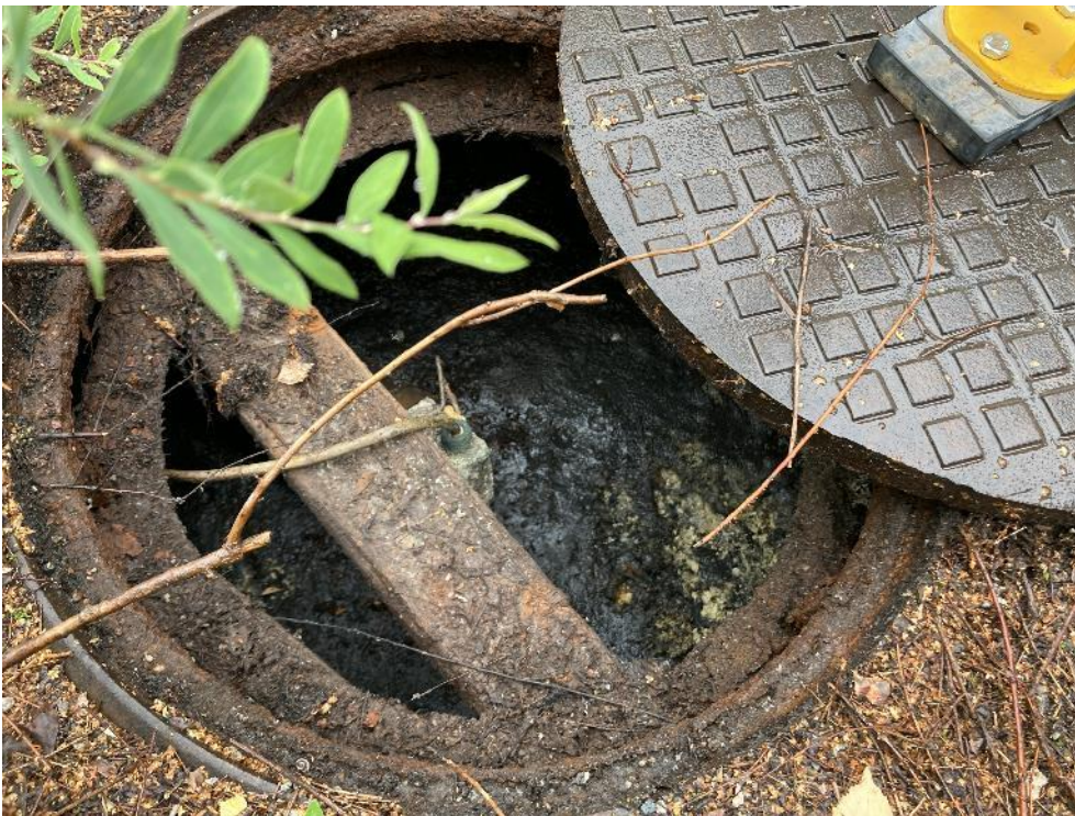
Kuva 5.7. Rasvanerotuskaivo on täynnä.
