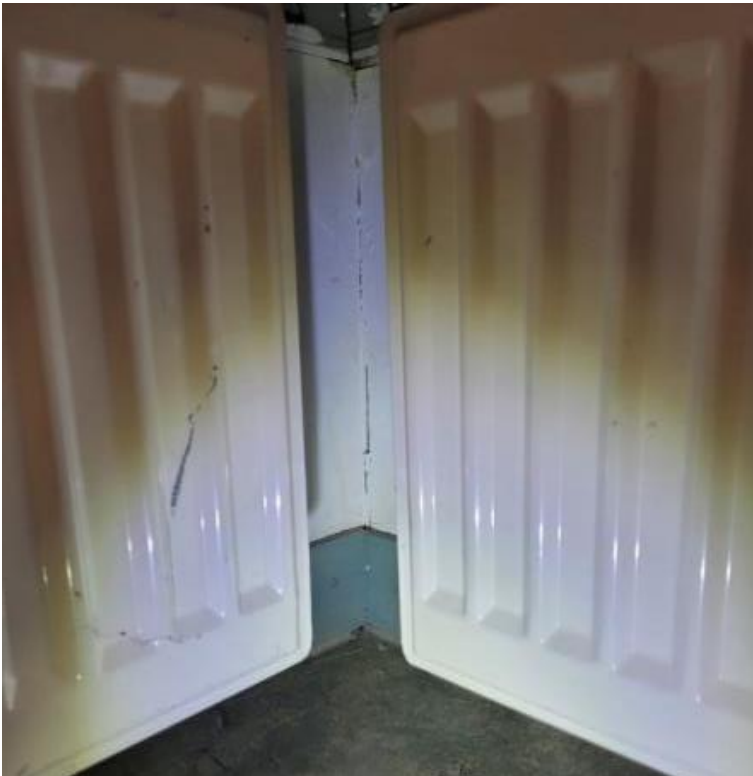
Kuva 4.20. Tilan 149 ulkonurkka on ratkennut ikkunan alta.
