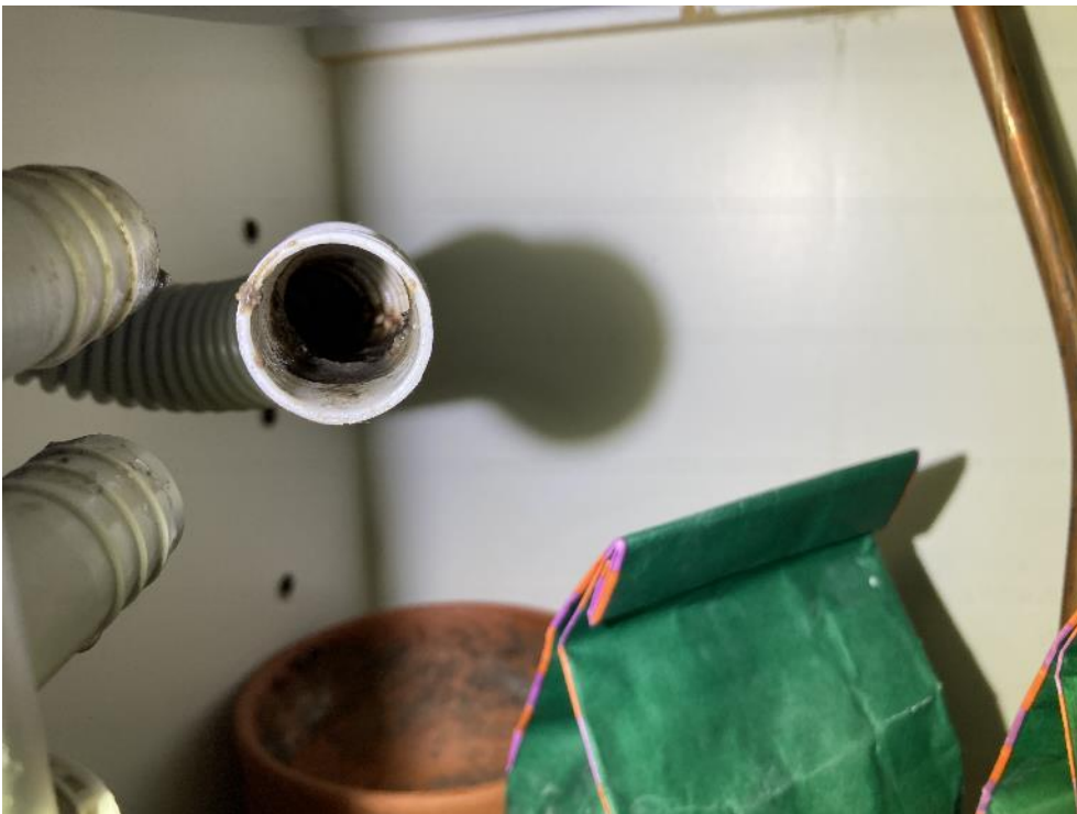
Kuva 5.5. Ryhmähuoneessa 109 on tunkkaista hajua, joka tulee pesualtaan likaisesta ylivuotoputkesta.
