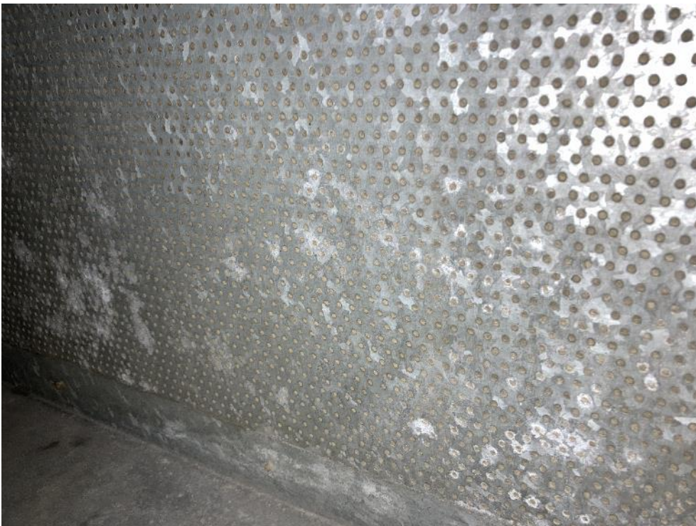
Kuva 5.3. Raitisilmakammio on reikäpeltiä, minkä alla on suojaamatonta villaa.
