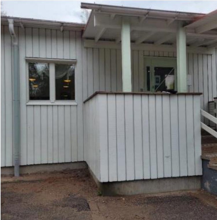
Kuva 4.27. Tilan 152 sisäänkäynnin katoksen sadevedenpoiston johtaminen on puutteellinen. Sokkelin jatkuva kosteusrasitus rapauttaa betonia ja altistaa liittyvät puuosat kosteudelle. Vesi on syönyt maa-ainesta kiveyksen ja asfaltin välistä.
