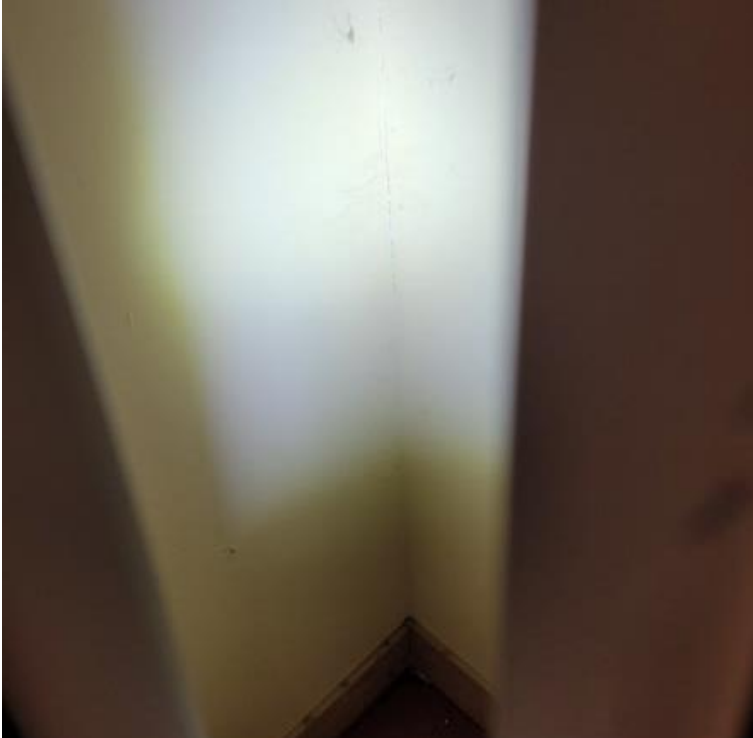
Kuva 4.1. Tilan 110 oikea ulkonurkka on ratkennut.
