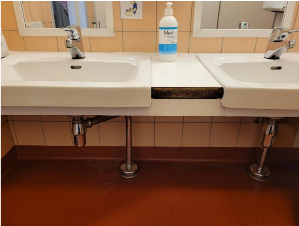
Kuva 4.15. Tilan 140 pesualtaiden pöytälevyssä on vaurioitunutta materiaalia.
