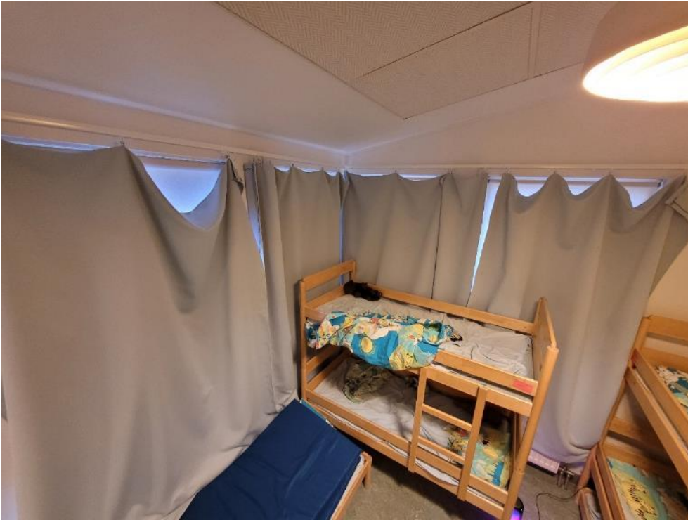
Kuva 4.23. Tilassa 156 verhot ja sängyt ovat ikkunoiden edessä estäen ilmankierron ikkunaseinille. Talvella kylmät rakenteet kondensoivat sisäilman kosteuden sisäpinnoille ja kastepiste rakenteessa siirtyy lähemmäs höyrynsulkua.
