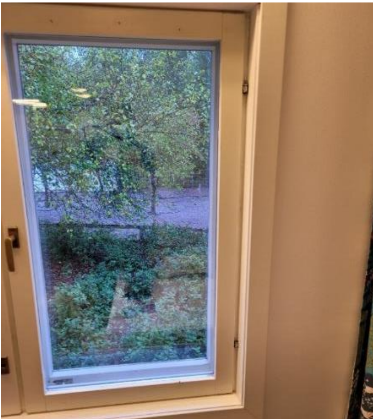
Kuva 4.18. Tila 143 ikkunan saranatpit ovat melkein irti.
