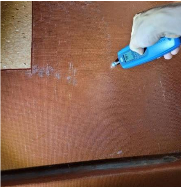
Kuva 4.2. Tilan 111 suihkussa on matto irti alustastaan ja kohonneita pintakosteuslukemia.
