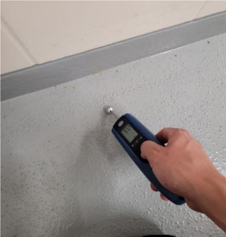
Kuva 4.13. Tilan 123 lattiassa on kylmiön vieressä kohonneita pintakosteuslukemia.
