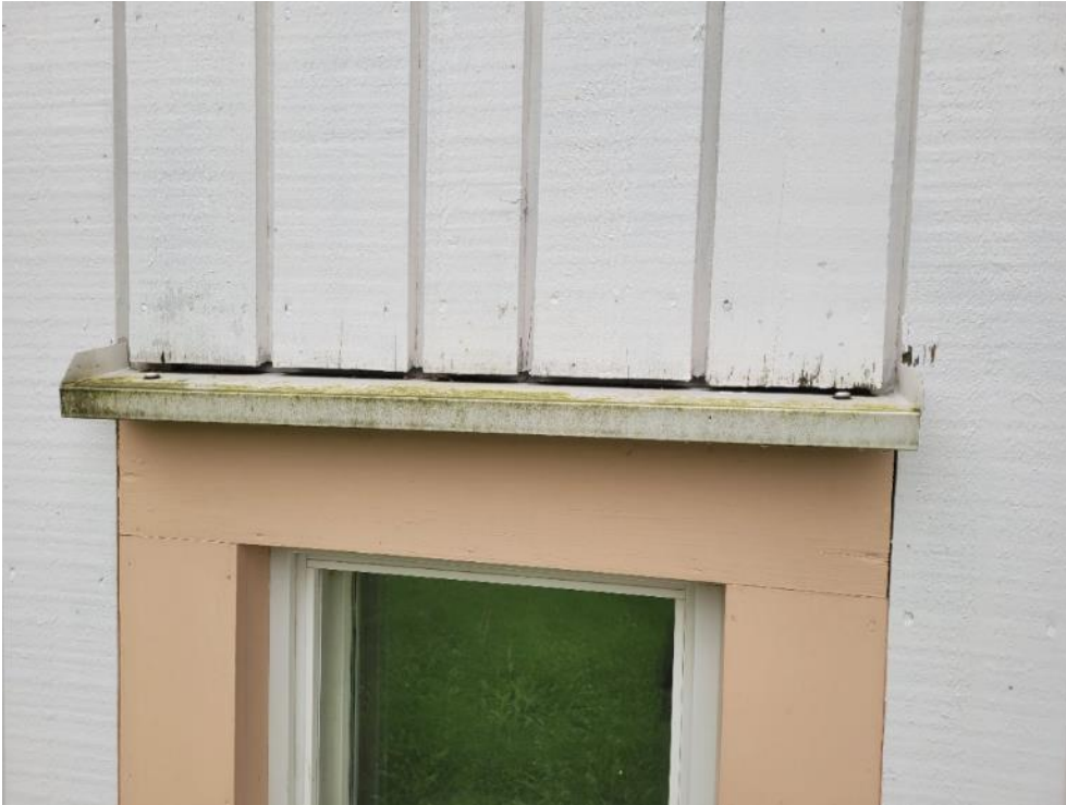
Kuva 4.29. Tilan 137 ikkunan yläpelti on lähes tasainen ja roiskii vettä puuosiin. Pystyлаudoitus tulee liian lähelle peltiä.
