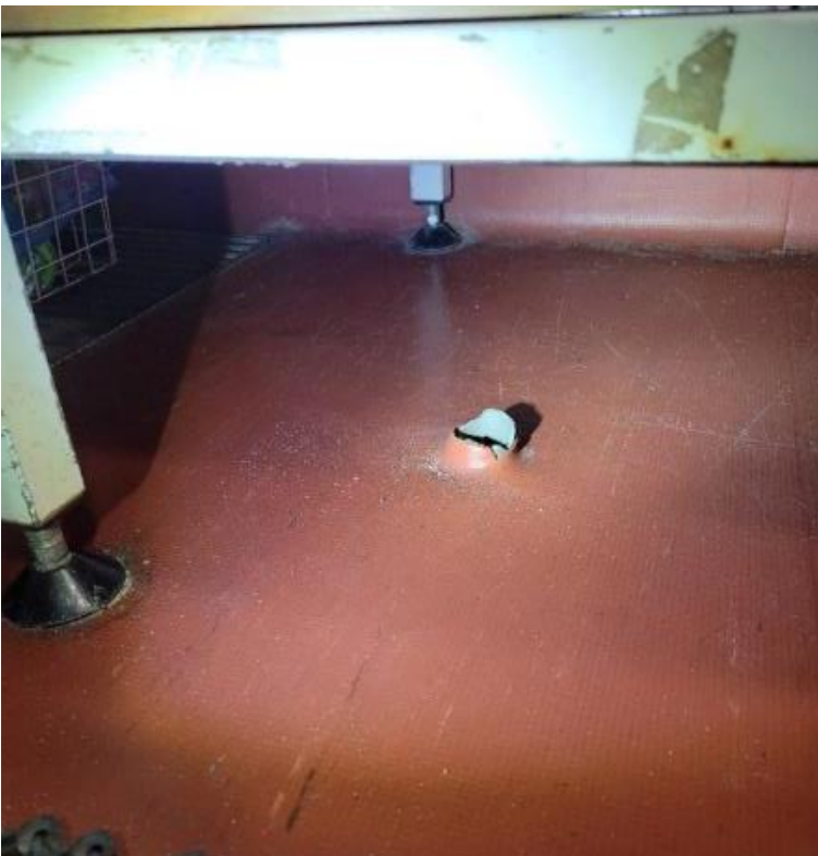
Kuva 4.22. Tilan 152 pesualtaan alla on vanha 32 mm viemäri auki.
