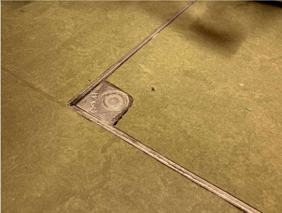
Kuva 5.6. Alapohjajalan luukkua ei saatu avattua, eikä näin ollen tarkastettua.
