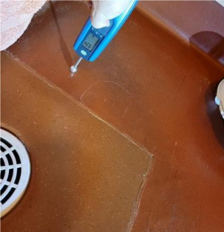
Kuva 4.19. Tilan 151 suihkussa on matto irti alustastaan ja kohonneita pintakosteuslukemia.
