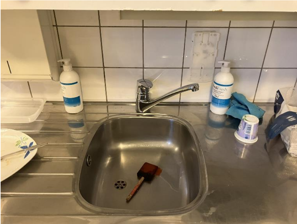
Kuva 5.4. Useasta pesuallashanasta puuttuu sivuliikerajoitin tai se on väärä.
