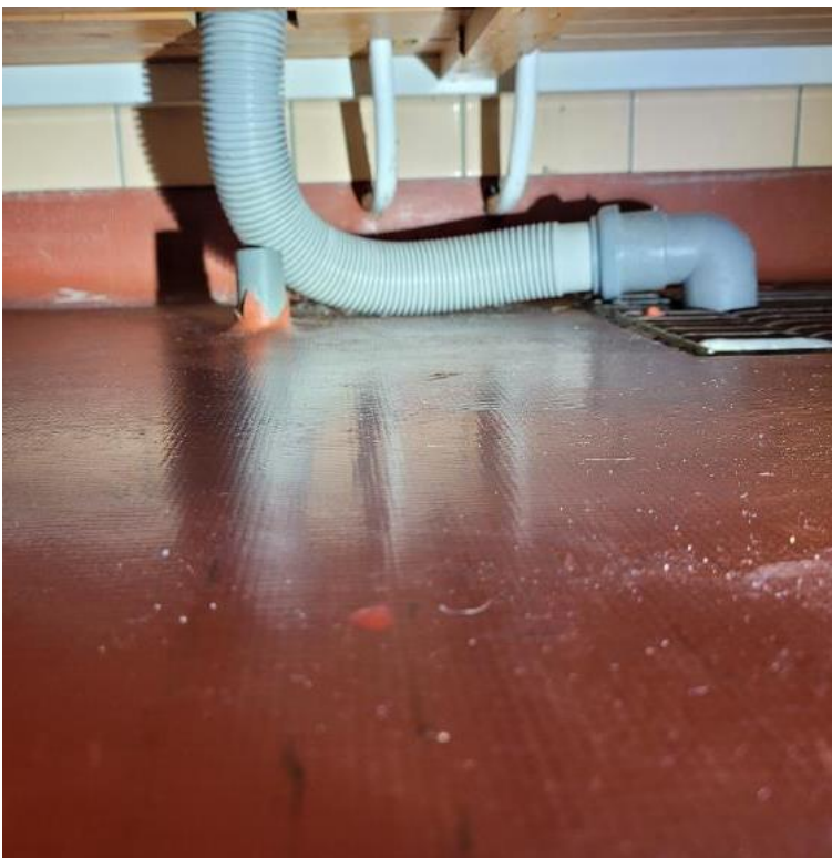
Kuva 4.4. Tilan 113 pesualtaan alla on vanha 32 mm viemäri auki.
