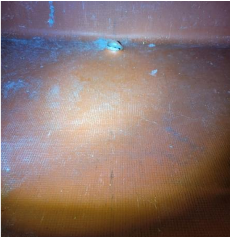
Kuva 4.6. Tilan 119 pesualtaan alla on vanha 32 mm viemäri auki.
