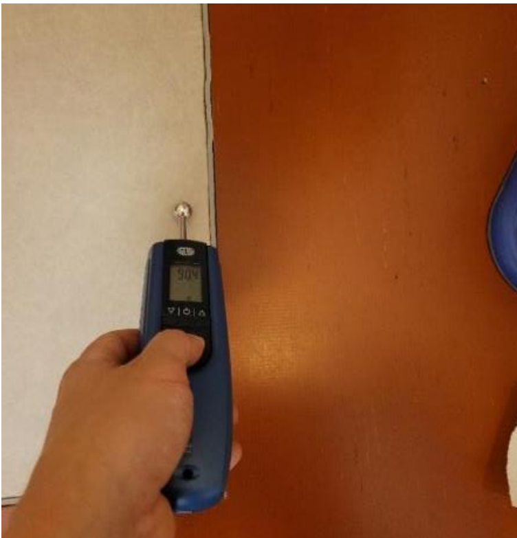
Kuva 4.10. Tilan 122 pesualtaan lattiakaivon ympärillä on kohonneita pintakosteuslukemia.
