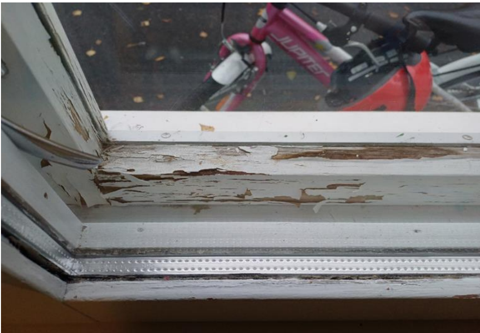
Kuva 4.10. Leikkiätilä 165 varatieikkunan ulkopokassa on vesivaurio.
