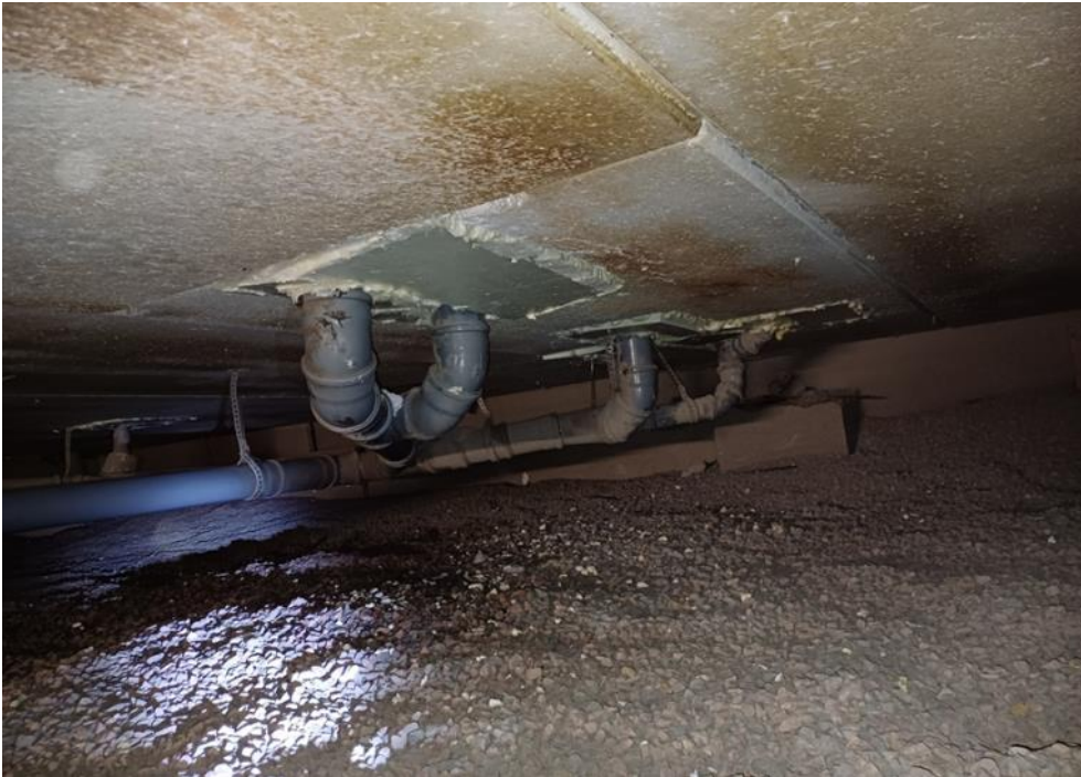
Kuva 4.11. Alapohjan läpivientien palokatkot on puutteelliset.
