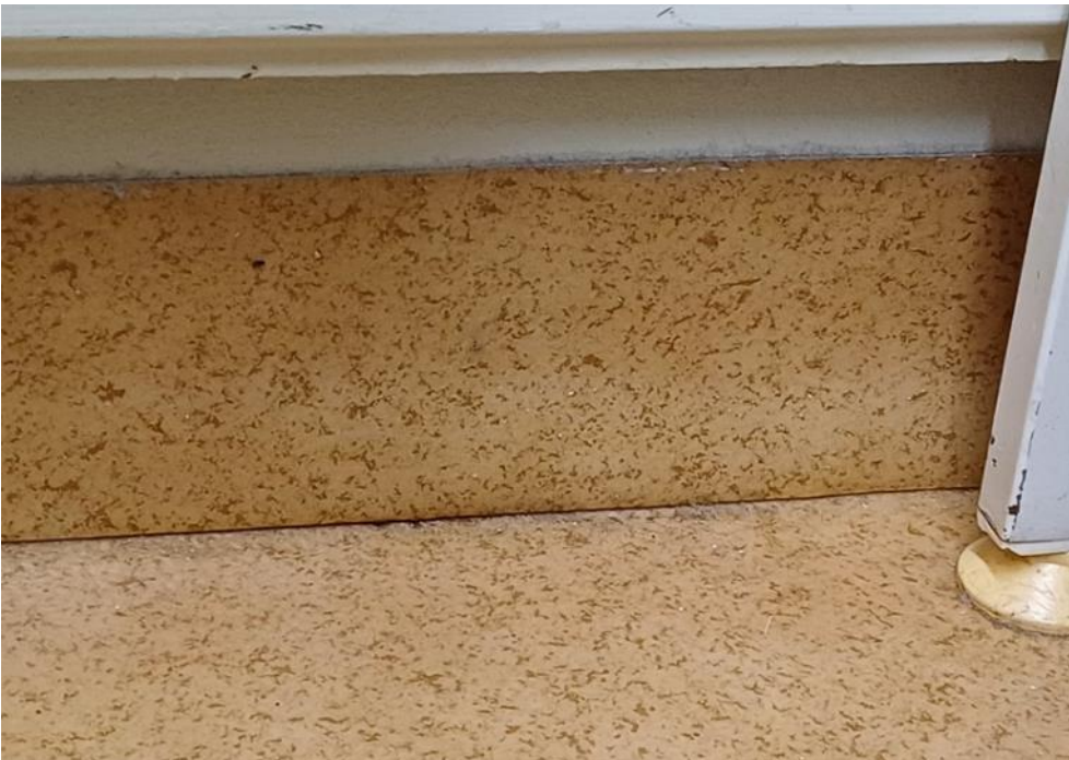
Kuva 4.4. Työtilan 112 ulkoseinän ylös nostetun maton lattia/seinäliittymä ei ole vesitiivis.
