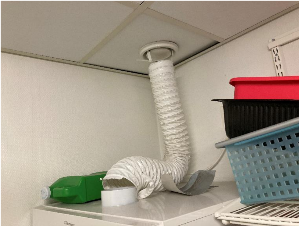
Kuva 5.3. Eteisen kuivauskaapista poistoletku irronnut.
