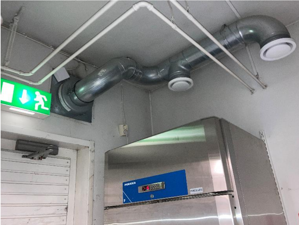
Kuva 5.1 Keittiön eteisen poistopuhaltimen ollessa päällä on keittiö noin 14 pa alipaineinen.
