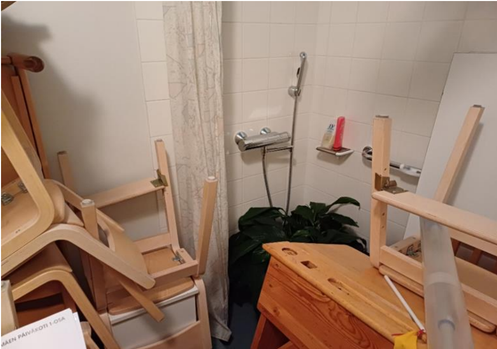
Kuva 4.7. Pesutila 123 on täynnä tavaraa eikä kuivuvaa lattiakaivoa pääse täyttämään.
