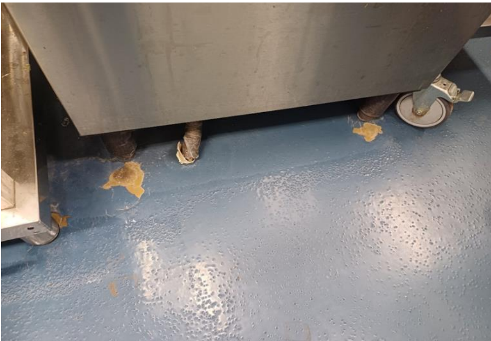
Kuva 4.8. Keittiö 140 ja tekniikkatila 145 lattiapinnoite on irtoillut.
