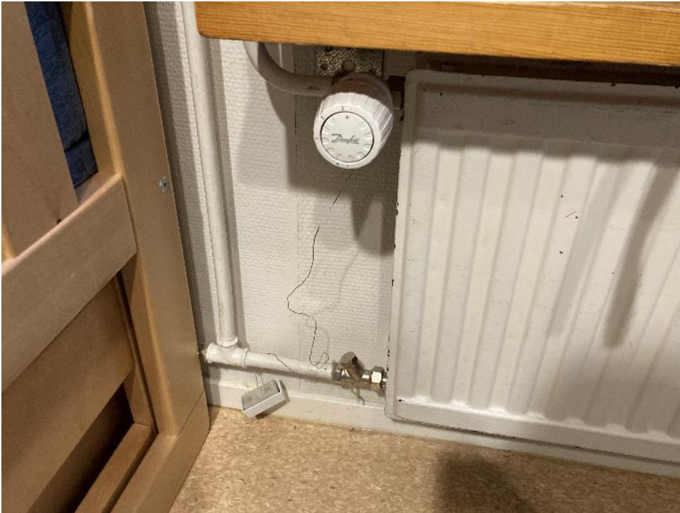
Kuva 5.5. Lämmityspatterin termostaatin erillisanturi irti seinästä.
