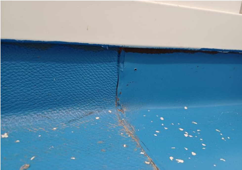
Kuva 4.9. Pesuhuone 133 ja 153 ylös nostetun maton pystysauma ei ole vesitiivis.
