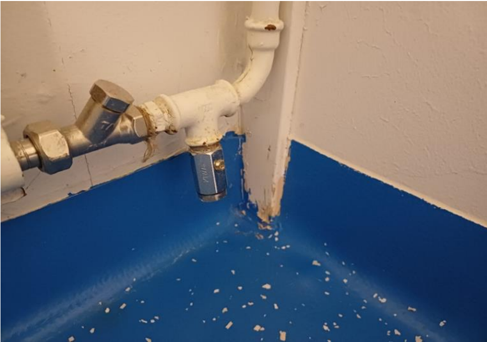
Kuva 4.3. WC 109 maton ylösnosto ei ole tiivis nurkkalistan asennuksen takia.
