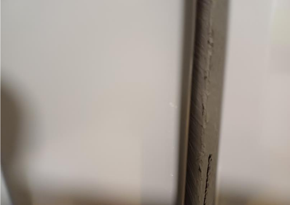
Kuva 4.5. Leikkitila 113 asennettu uusi ovi IV-konehuoneeseen, ovikarmi/seinäliitos ei ole tiivis.
