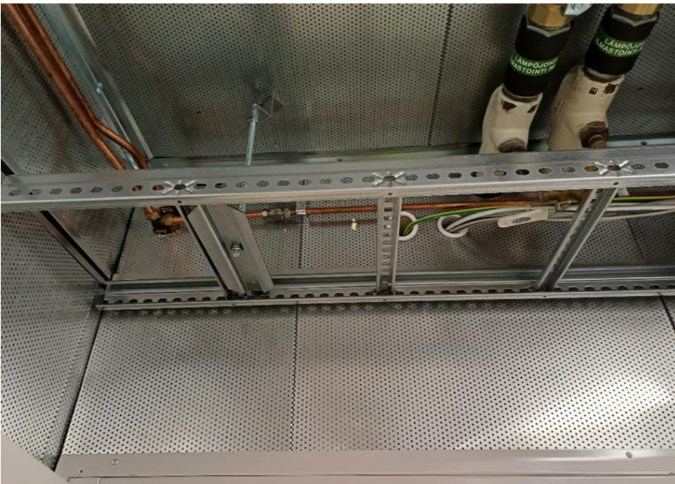
Kuva 4.6. IV-konehuone 122 sähköjohto- ja putkiläpiviennit ei ole tiiviit.
