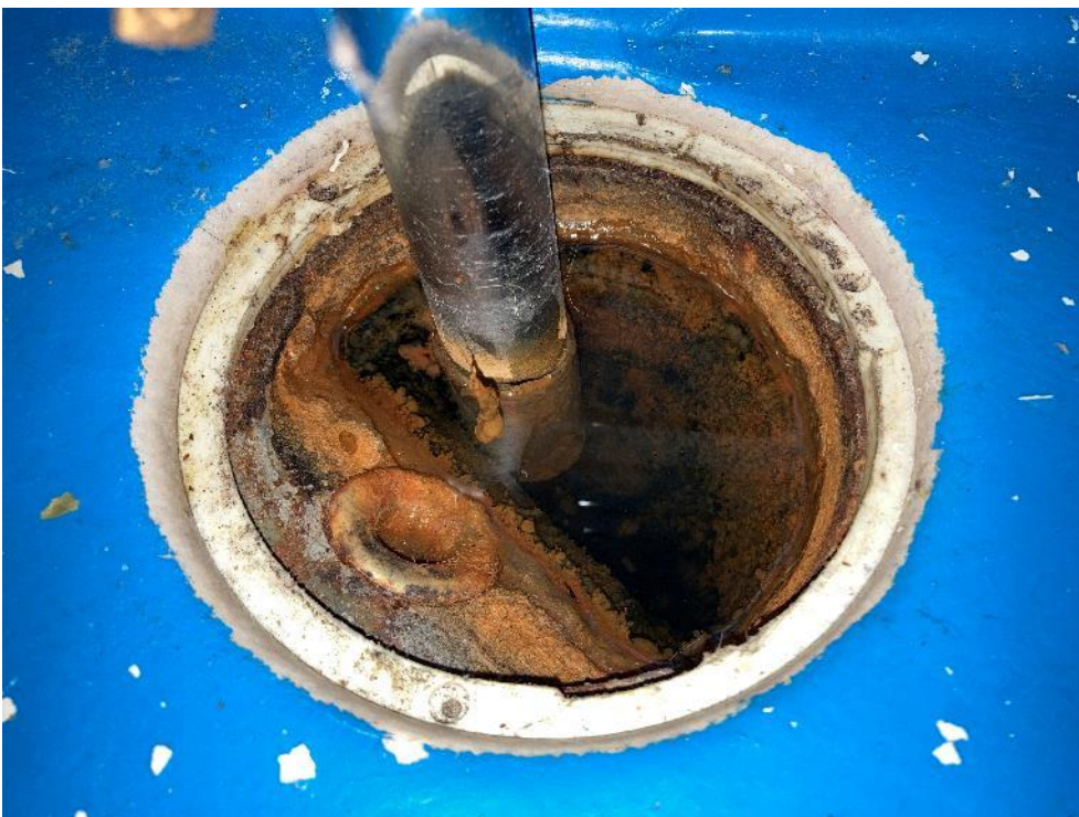
Kuva 5.8. Useat lattiakaivot ovat valurautaisia ja elinkaarensa päässä.
