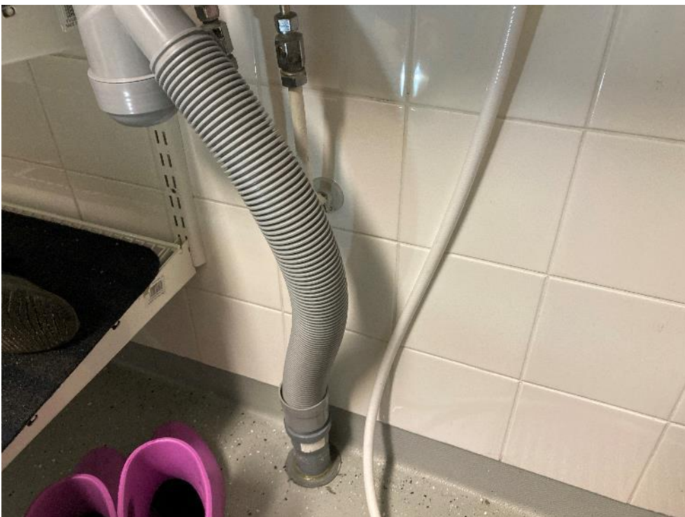
Kuva 5.6. Kuraeteisen 132 pesualtaan kalustekumi on väljä ja päästää viemärinhajua huoneilmaan.
