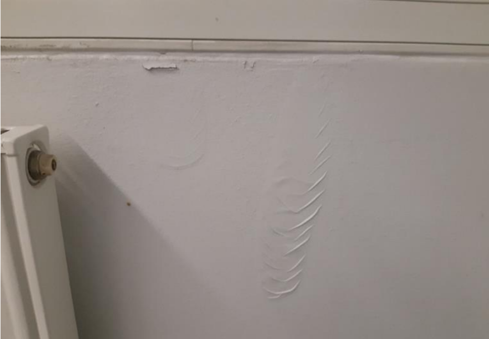
Kuva 4.9. Ulkoseinässä on vanha kosteusjälki tilassa 210.
