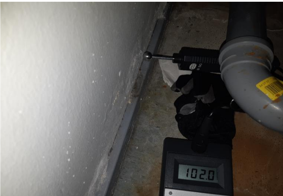
Kuva 4.4. Pesukoneen takana seinän alaosaassa pintakosteusmittarilla mitattuja kohonneita kosteuksia tilassa 154.
