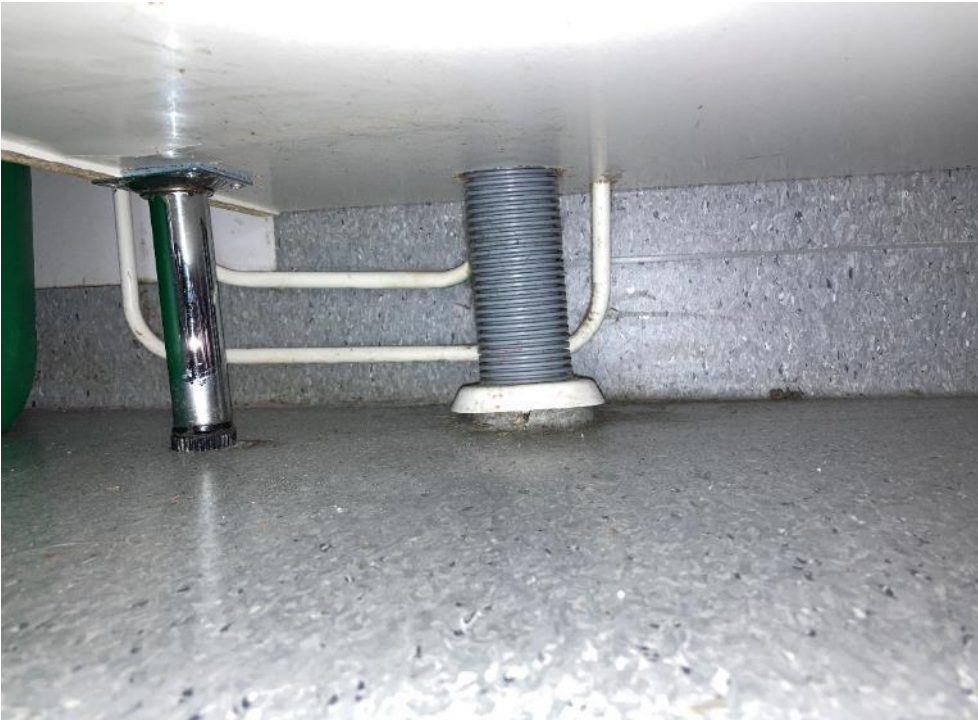
Kuva 5.5. 4310 Parakin luokan 8 viemäritiiviste on väljä.
