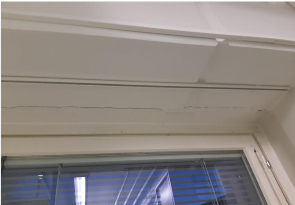
Kuva 4.2. Ikkunapielissä ja ulkoseinien palkkien alapinnoilla on halkeamia.
