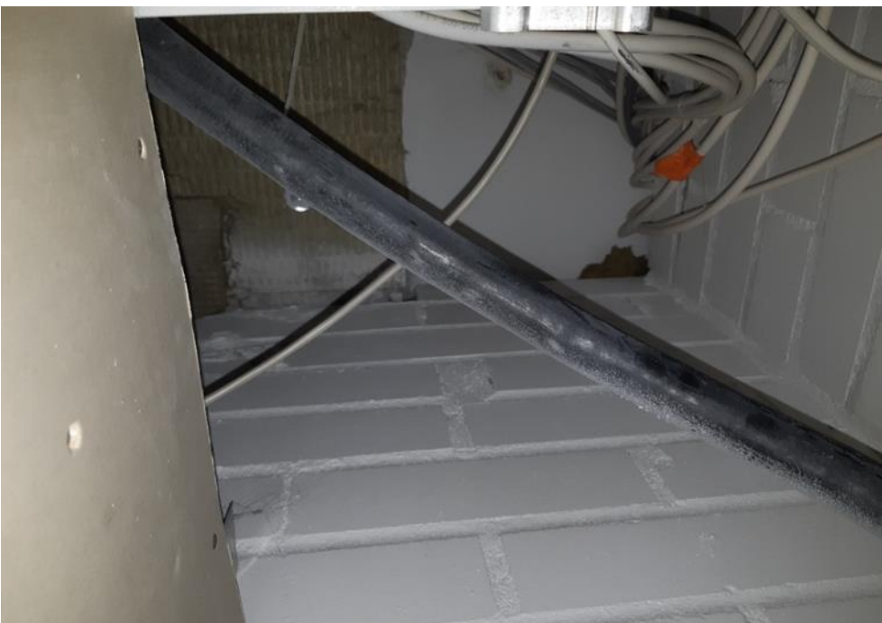
Kuva 4.8. Läpivientejä on tiivistämättä ja pinnoittamatonta mineraalivillaa on näkyvissä tilassa 232.
