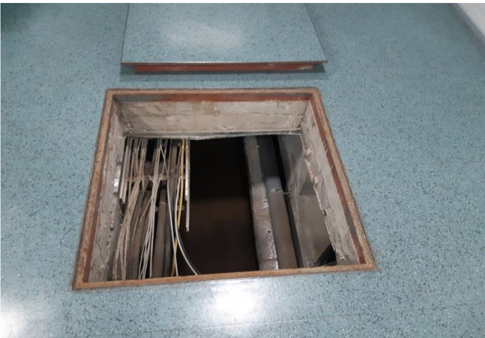
Kuva 4.10. 1.kerroksen C-osan putkikanaalin tarkistusluukut eivät ole kaasutiiviitä ja pohjalla on vettä.
