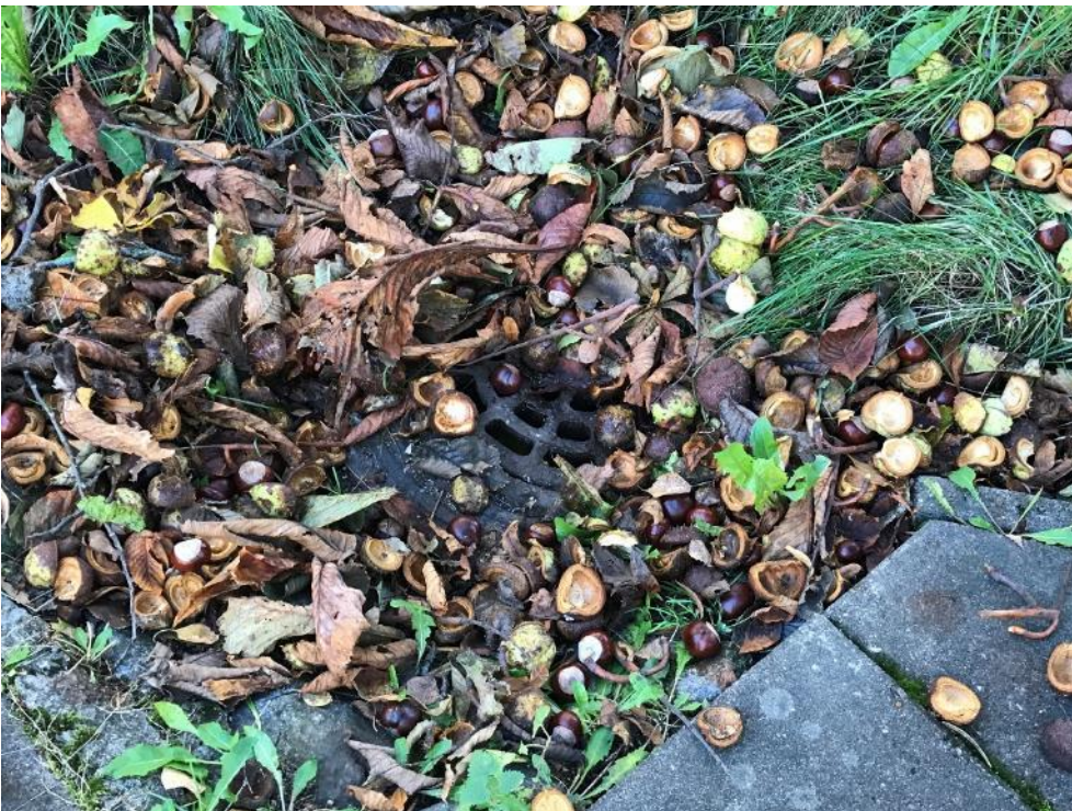
Kuva 5.4. Pihan ritiläkansikaivot ovat peittyneet lehdillä.
