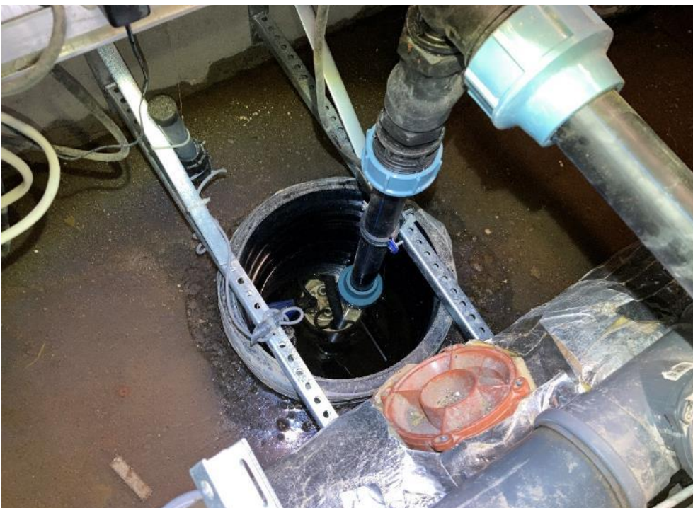
Kuva 5.2. 1. kerroksen C-osan käytävän alla oleva pumppaamo ei toiminut ja lattialla oli vettä.
