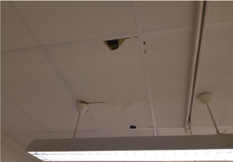
Kuva 4.5. Katon akustointilevyjä on rikki tiloissa 172, 173, 209, 210, 211 ja 215.
