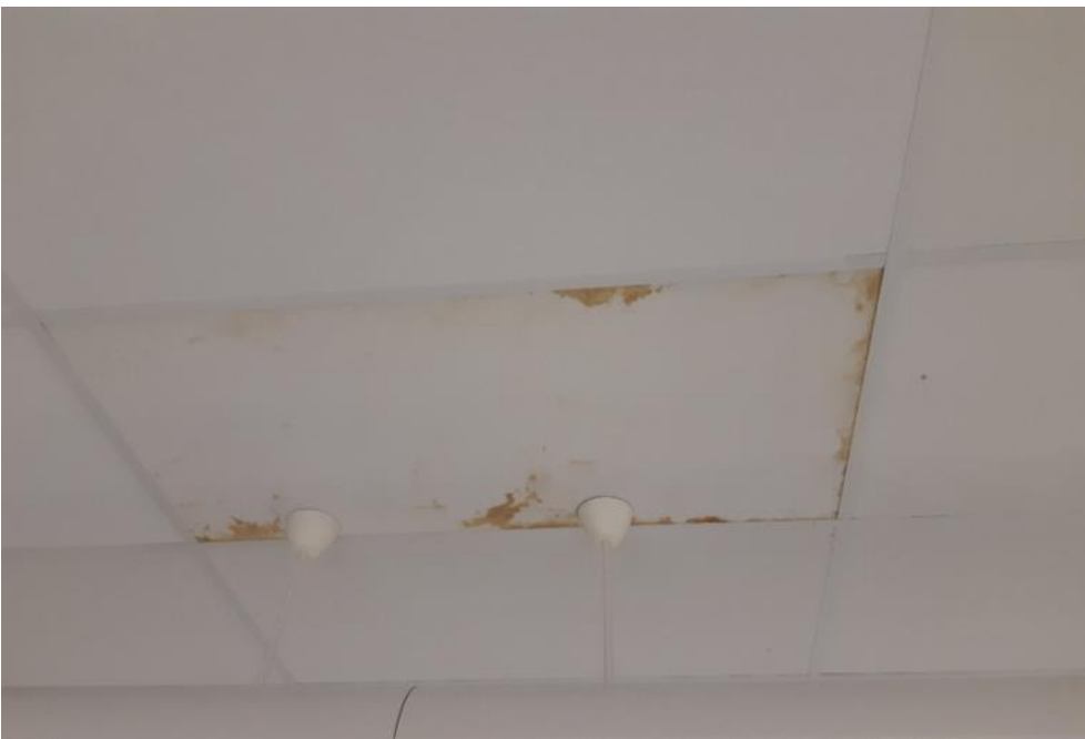
Kuva 4.6. Katon akustointilevyssä on kosteusvauriojälki tilassa 216.
