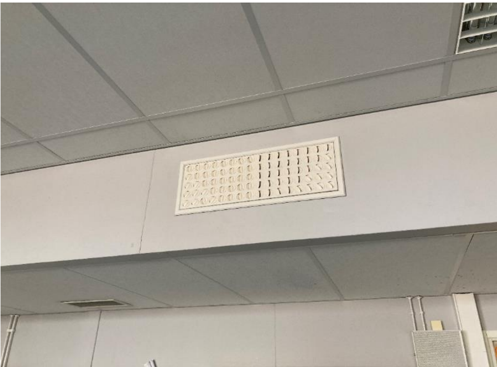
Kuva 5.6. 4310 Parakin luokkahuoneiden tuloilman suuntaus on virheellinen.
