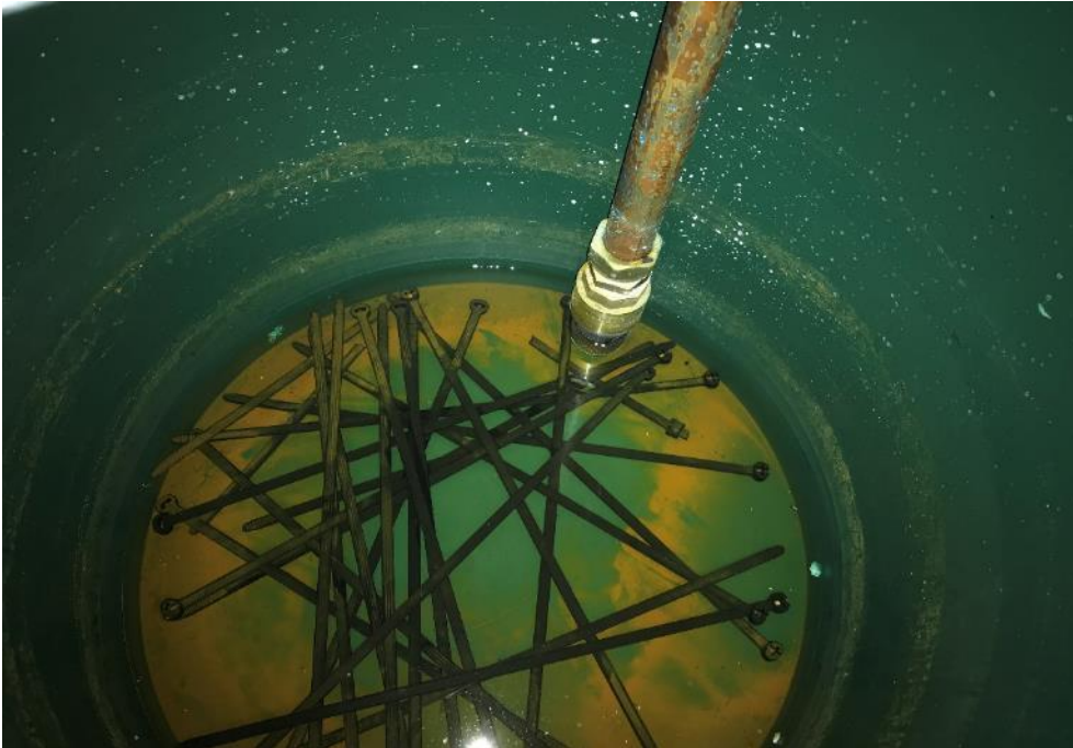
Kuva 5.1. Jäähdytysjärjestelmän glykolin täyttöastia on tyhjä ja pohjalla on nippusiteitä.
