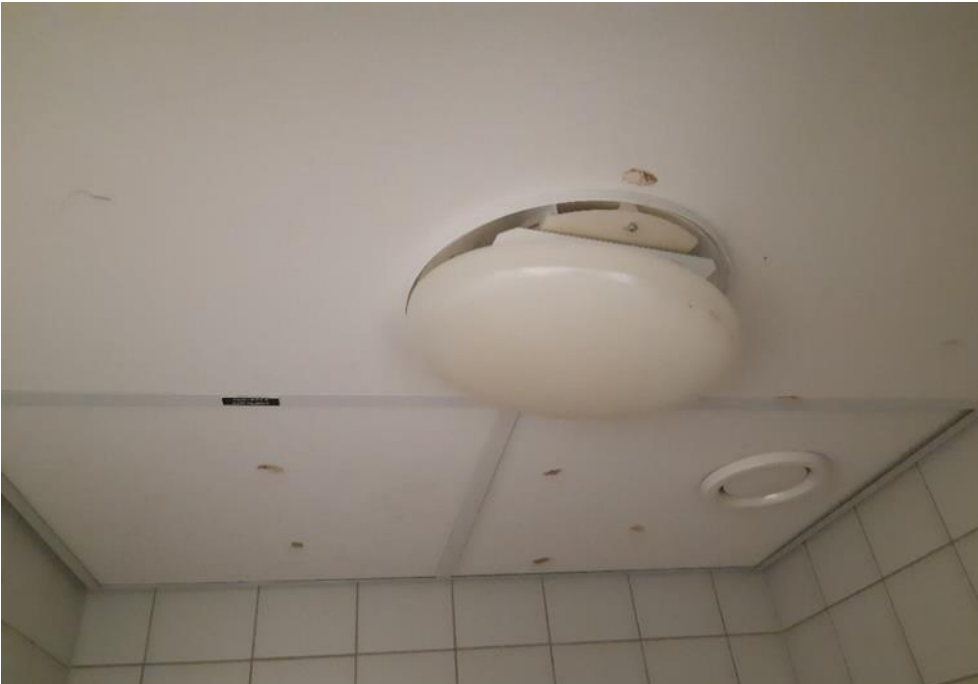
Kuva 4.7. Alakattolevyt ovat likaiset ja valaisimen kupu on irti wc-tilassa 164.
