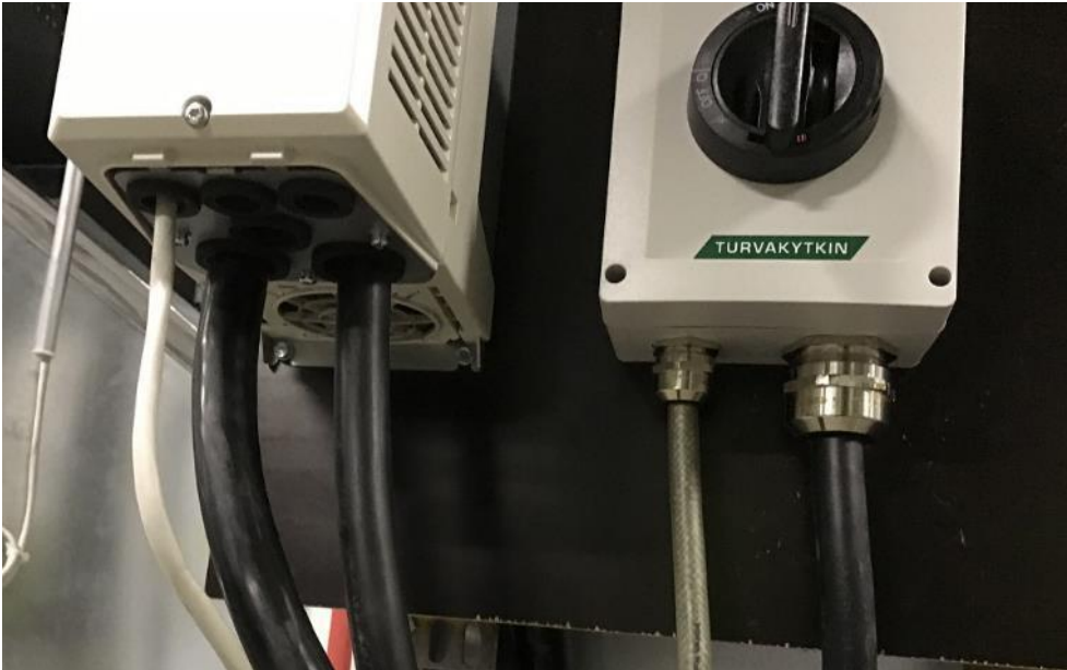
Kuva 6.4. Taajuusmuuttujien EMC-suojaus puutteellinen.
