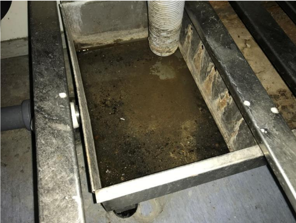
Kuva 5.3. C osan väestönsuojassa olevan siivouskomeron nukkasiihtiallas on likainen.
