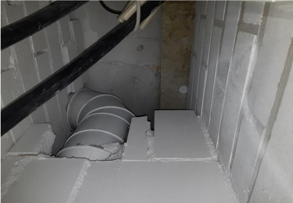
Kuva 4.1. 1. ja 2.kerroksen ryhmäkeskusten rakenteissa on avoimia läpimenoja ja pinnoittamatonta mineraalivillaa näkyvissä.
