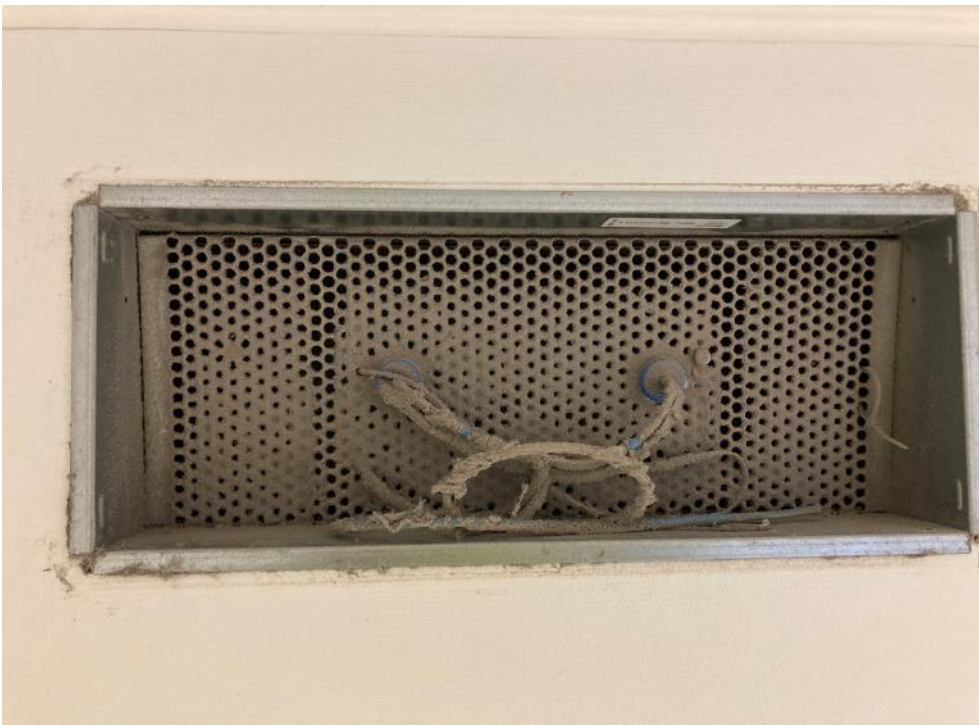
Kuva 5.4. Ilmanvaihdon poistoilmapäättelaitteiden säätöosien reikäpelleissä on pölyä.
