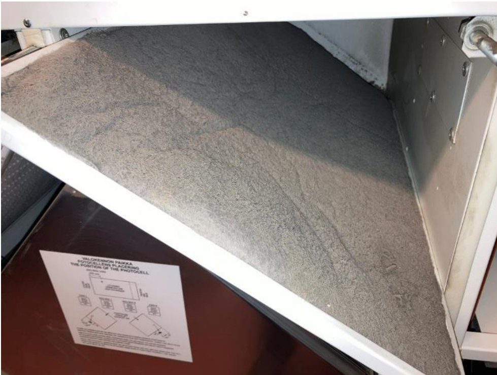
Kuva 5.3. TK02 ilmanvaihtokoneen karkeailmasuodatin on likainen.
