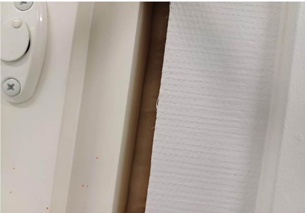
Kuva 4.3. Tilan 113 ikkunakarmi/seinäliitoksen eristetilan uretaanitiivistys on vajaa.
