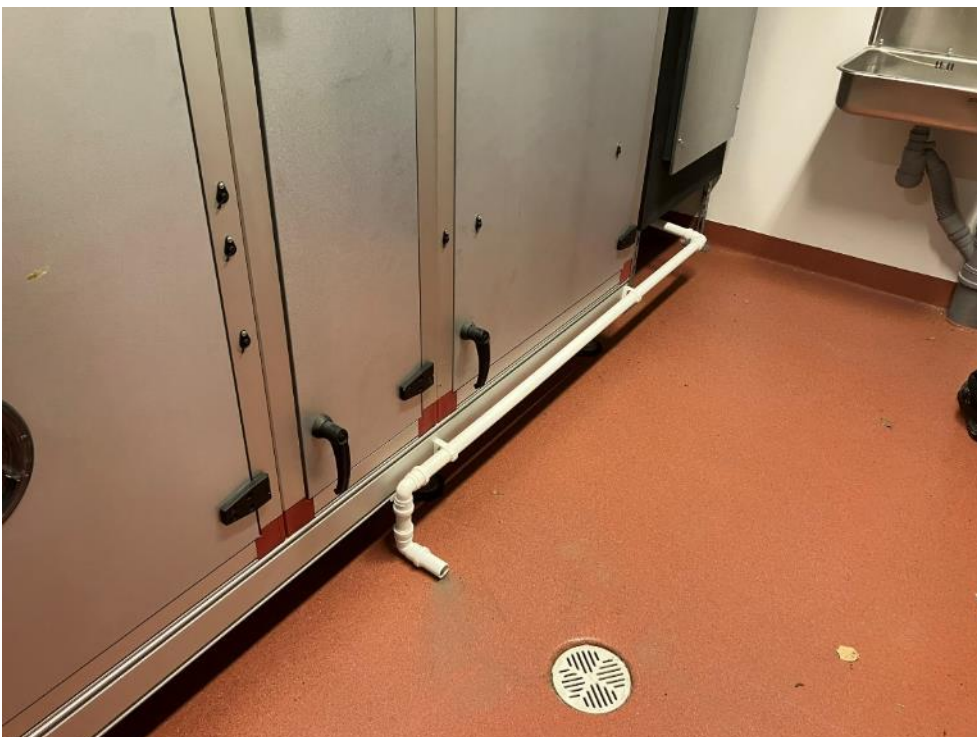
Kuva 5.2. TK01 ilmanvaihtokoneen viemärointiä ei ole vedetty lattiakaivolle asti.
