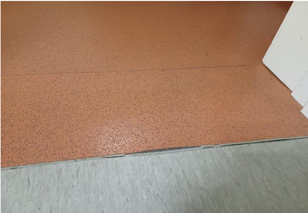
Kuva 4.1. WC-tilojen 123 ja 125 lattiaan mattosaumaukset ovat auenneet.
