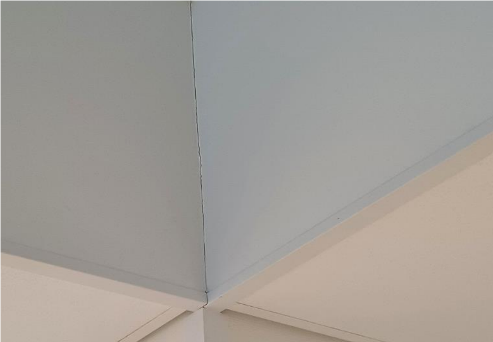
Kuva 4.2. Rakenneliittymien ratkeamia on useissa tiloissa.
