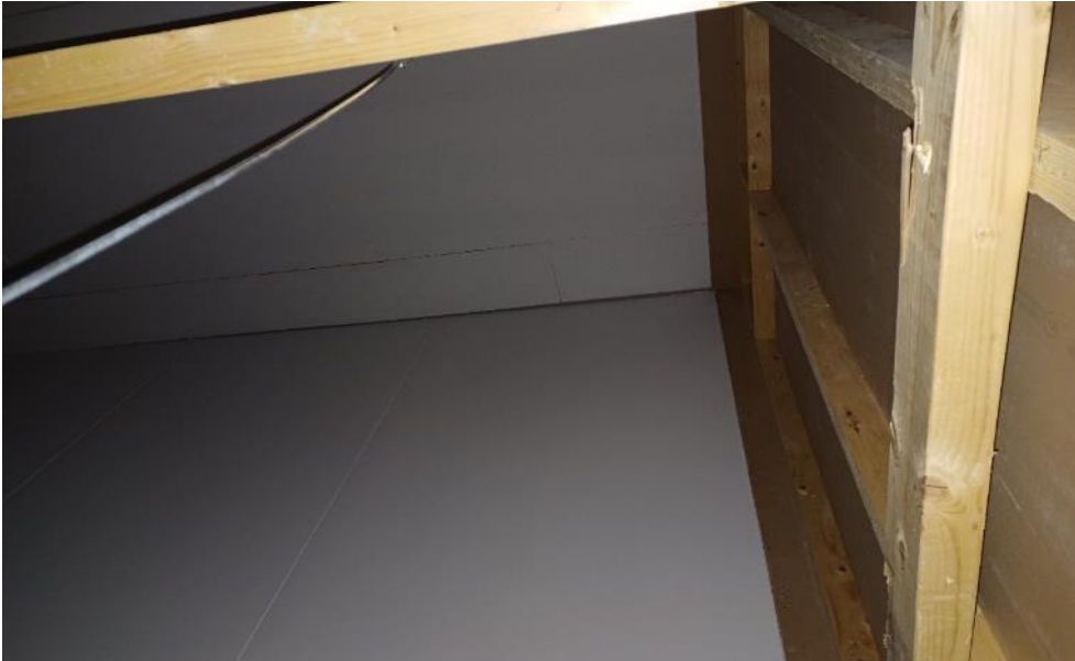
Kuva 4.6. Käytävän alakattojen yläpuolisissa levysaumoissa on ylisuuria rakoja.
