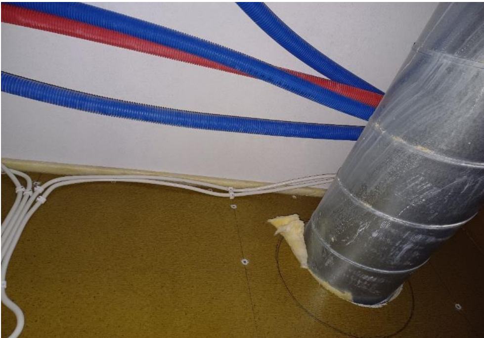
Kuva 4.5. Alakattojen yläpuolisissa läpivienneissä on näkyvissä pinnoittamatonta mineraalivillaa.
