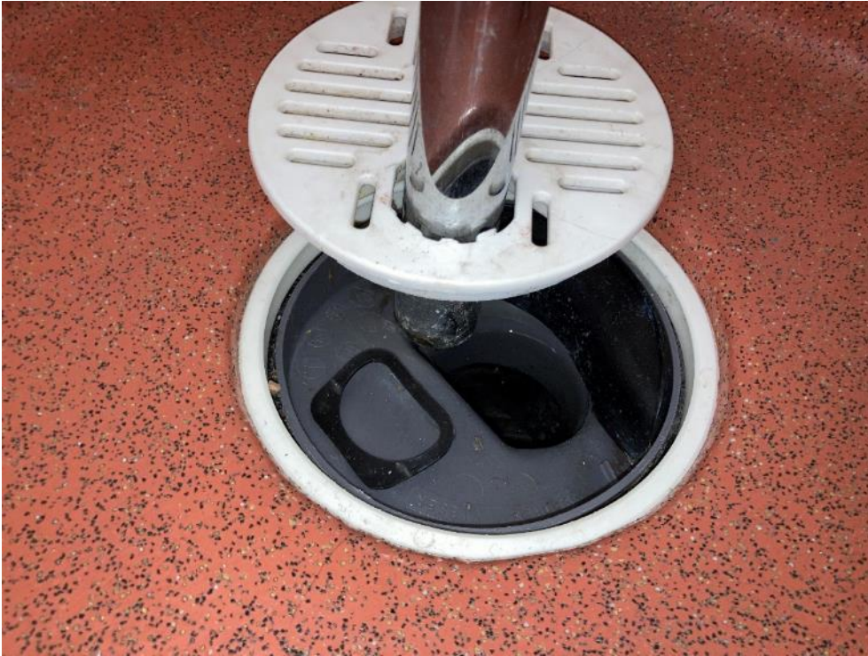
Kuva 5.5. Lattiakaivojen vesilukkojen osat ovat paikoitellen irti WC-tiloissa.
