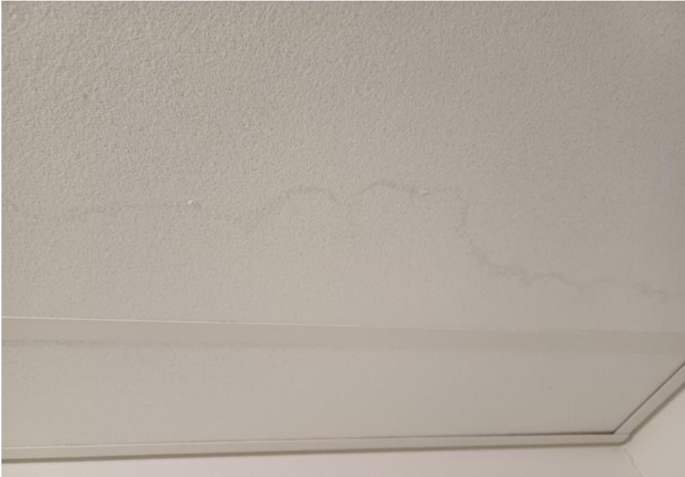
Kuva 4.4. Opettajainhuoneen 103 alas lasketun katon akustointilevyssä on kosteusvauriojälki.
