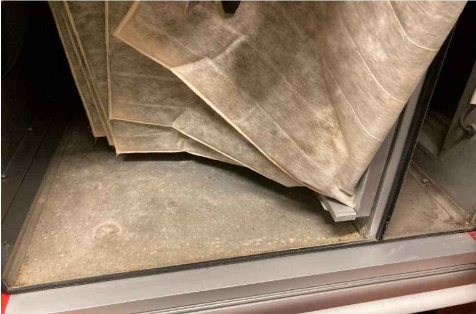
Kuva 5.1. Ilmanvaihtokoneen pohjalla on vanhoja kosteusjälkiä lumen sulamisvesistä. Suodatinkammion pohjalla ei ole viemärointiyhdettä.
