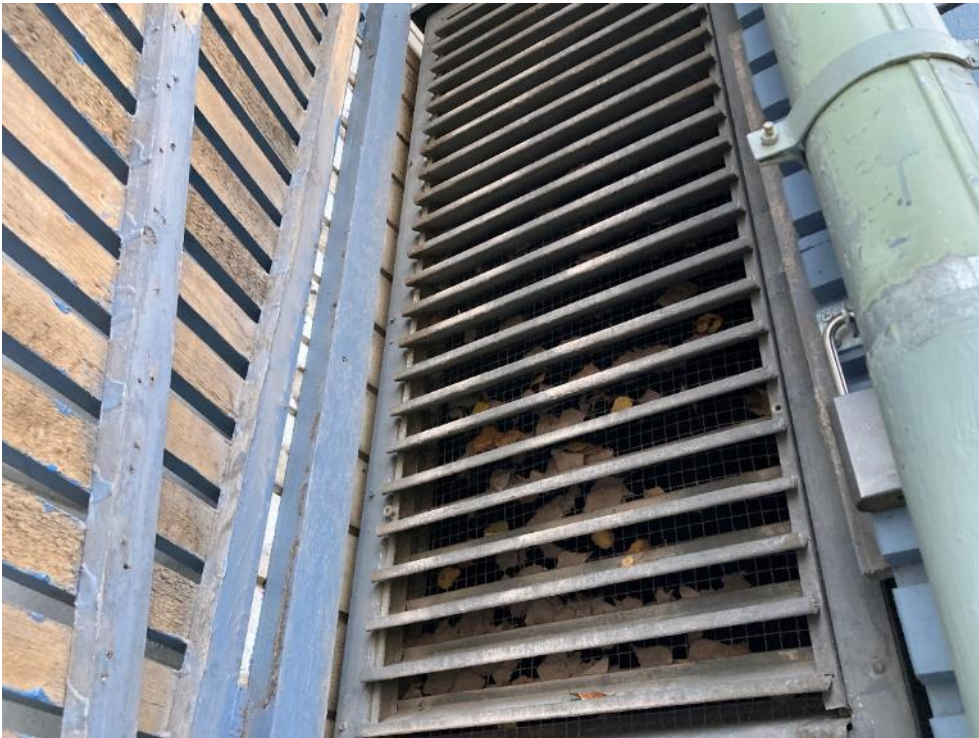
Kuva 5.1. Ilmanvaihdon raitisilmasäleikössä lehtiä.
