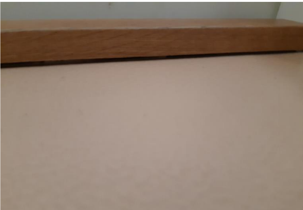
Kuva 4.8. WC-tilojen 147 A ja 147 B tulvakynnykset ovat tiivistämättä.
