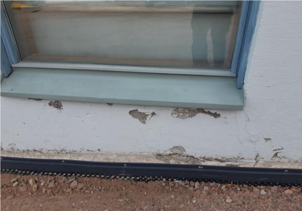
Kuva 4.9. Ulkopuolen betonisokkelissa on rapautumaa.
