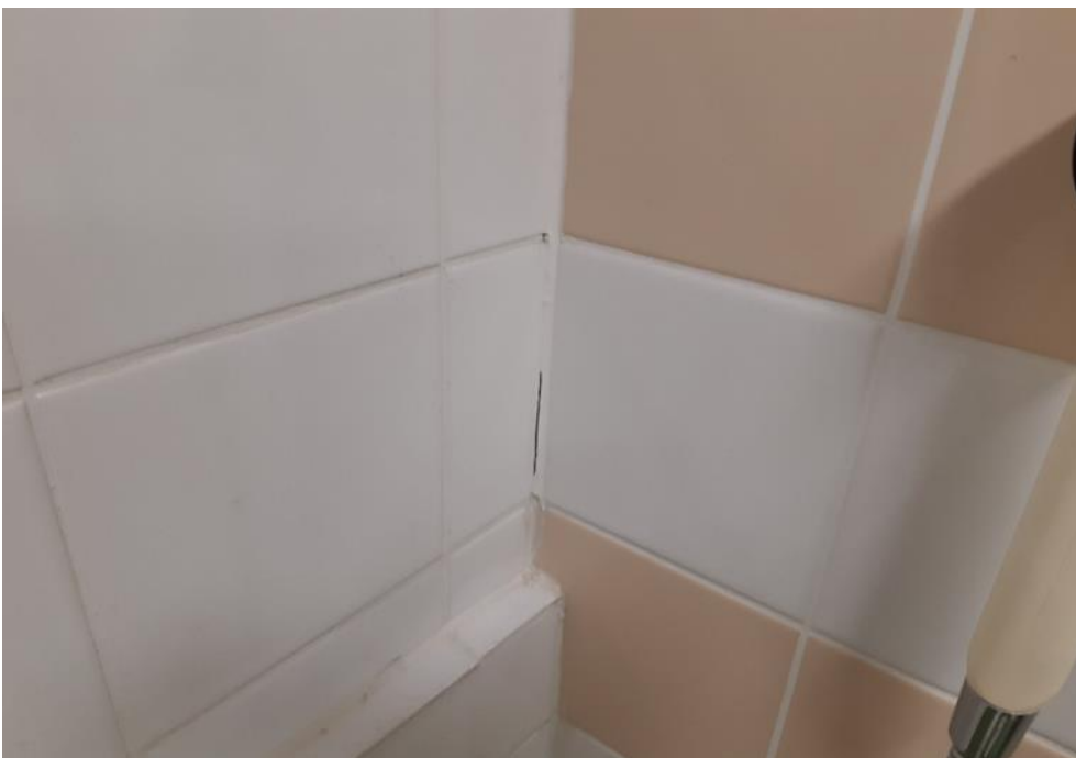
Kuva 4.2. Pesuhuoneen 110 nurkan silikonisauma on auennut.
