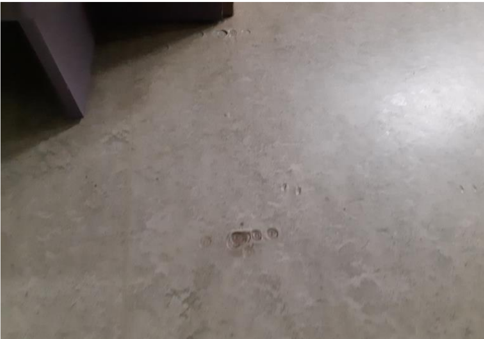
Kuva 4.4. Aulan 102 lattiapinnassa on vaurioita.
