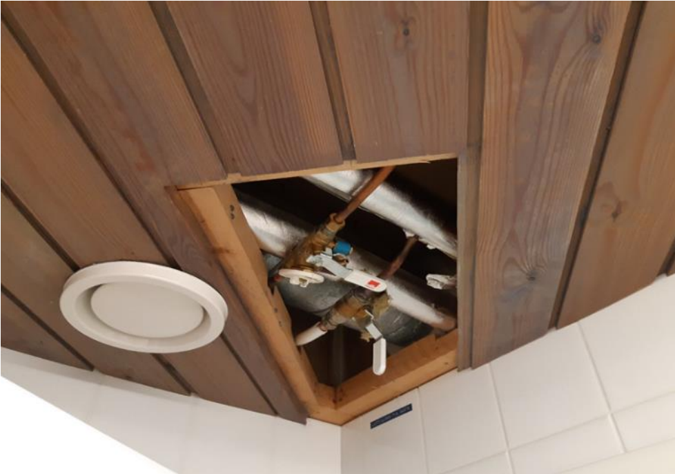
Kuva 4.3. Vesileikkitilan 107 katossa olevan tarkistusluukun kansi puuttuu.
