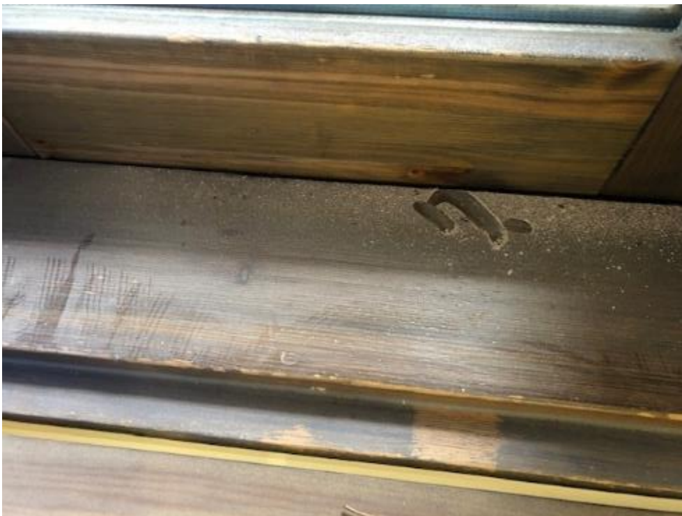
Kuva 4.6. Lepohuoneen 114 tuuletusikkunoiden väliin on kulkeutunut pihatyömaalta kallioporauksen hienojakoista kivipölyä.
