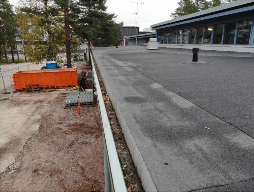
Kuva 4.11. Sadevesikouruissa on lehtiä.
