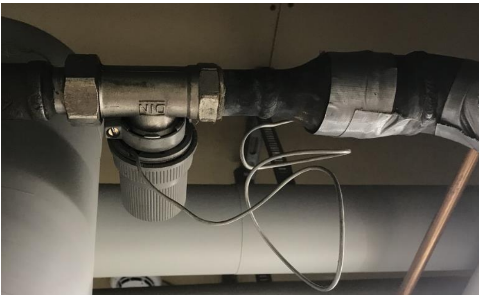
Kuva 6.2. TK01 ilmanvaihtokoneen lämmityspatterin ohituksen termostaattiventtiili on suljettu.
