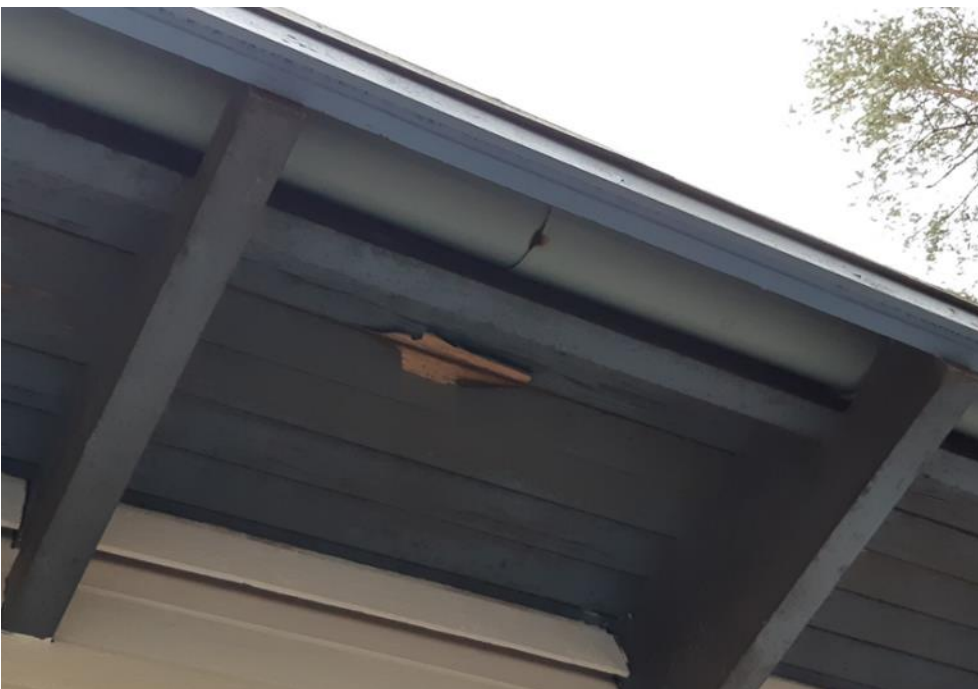
Kuva 4.10. Räystäiden alapinnoilta on maalia irti.
