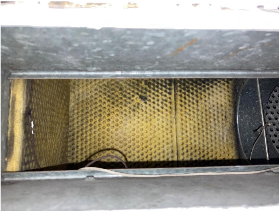
Kuva 5.2. Ilmanvaihdon päätelaitteiden tasauslaatikoissa paikoitellen pinnoittamatonta äänenvaimennusmateriaalina toimivaa lasivillaa.
