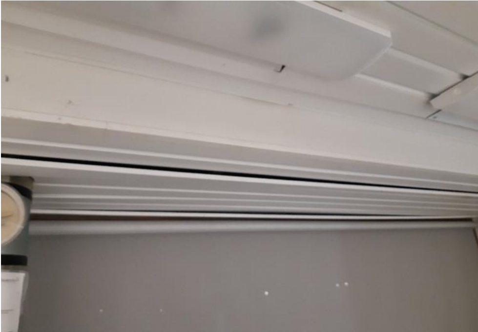
Kuva 4.1. Keittiön 116 kattosäleitä on irti.
