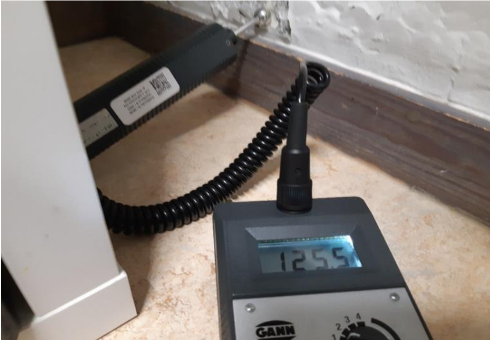
Kuva 4.5. Leikkitiilan103 ulkoseinän alareunassa on pintakosteusmittarilla mitattuna kohonneita kosteuksia.
