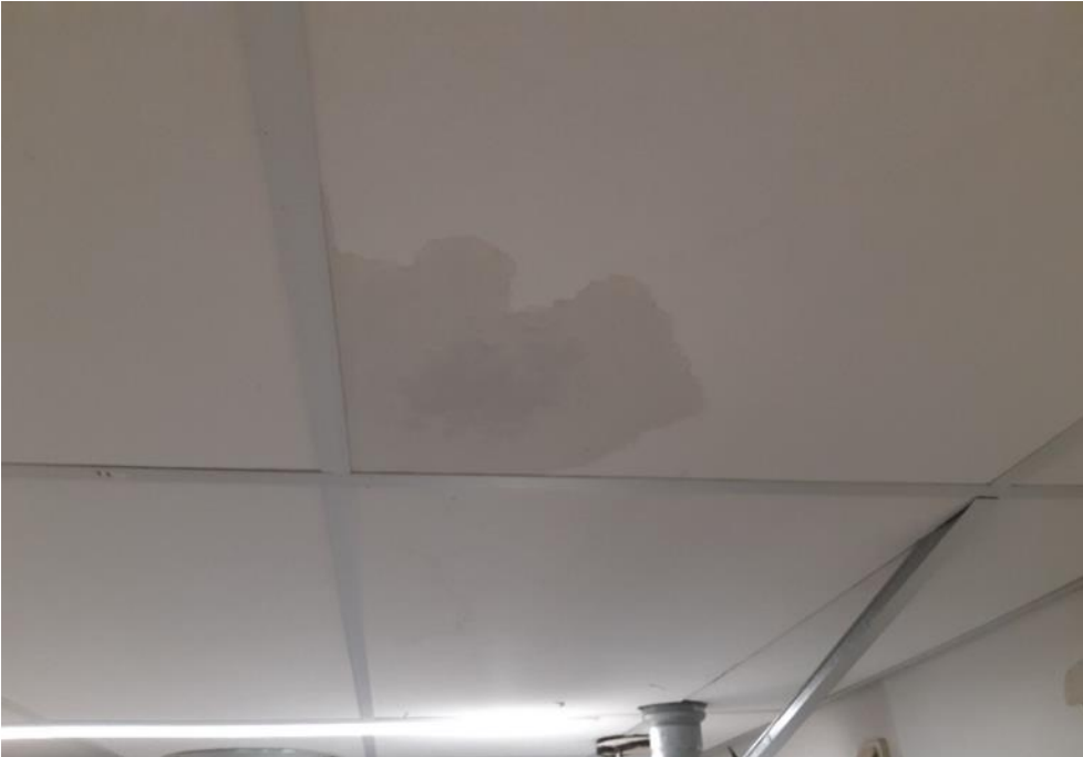
Kuva 4.7. Eteisen 140 alakaton akustolevy on märkä.
