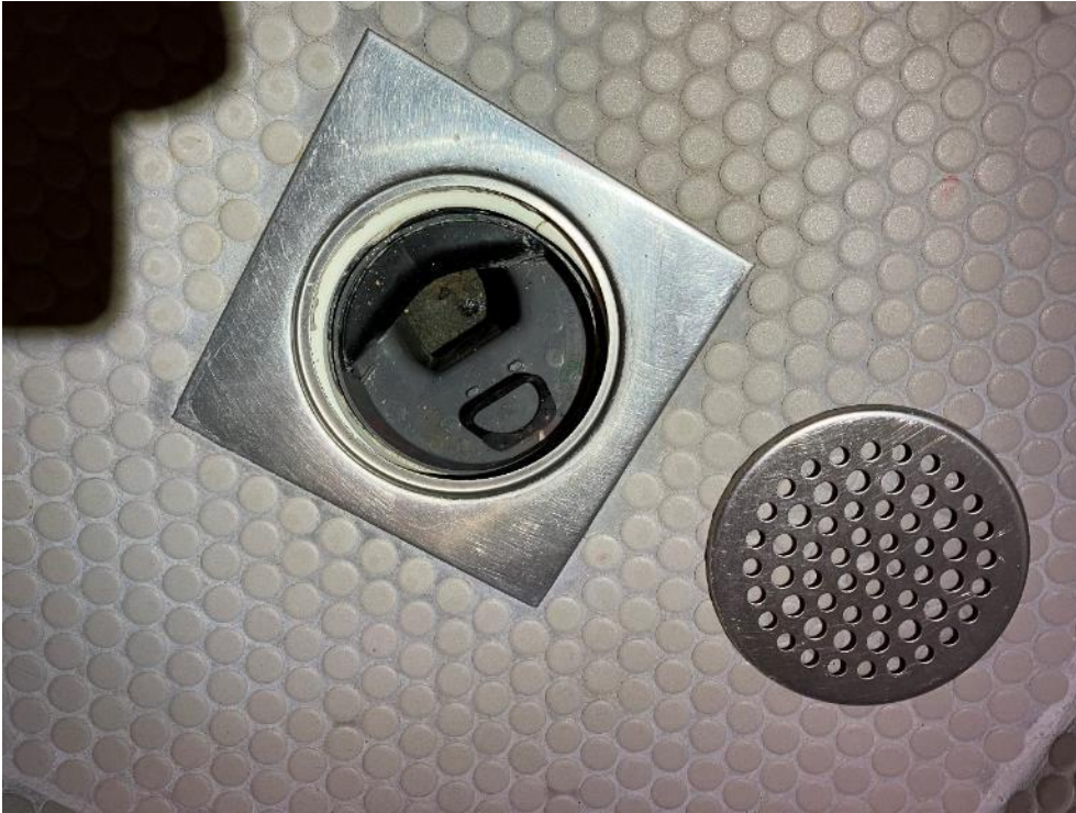
Kuva 4.28. Tilan 226 lattiakaivon hajulukko on kuiva ja huonosti kiinni.
