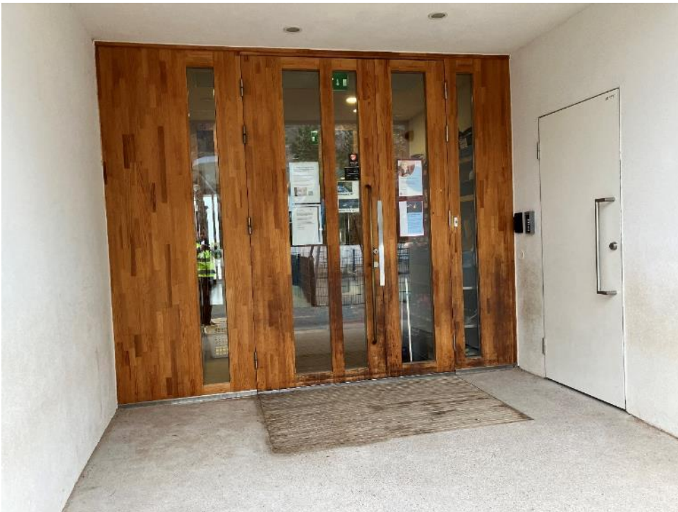
Kuva 4.5. B-sisäänkäynnin ovi on kulunut.
