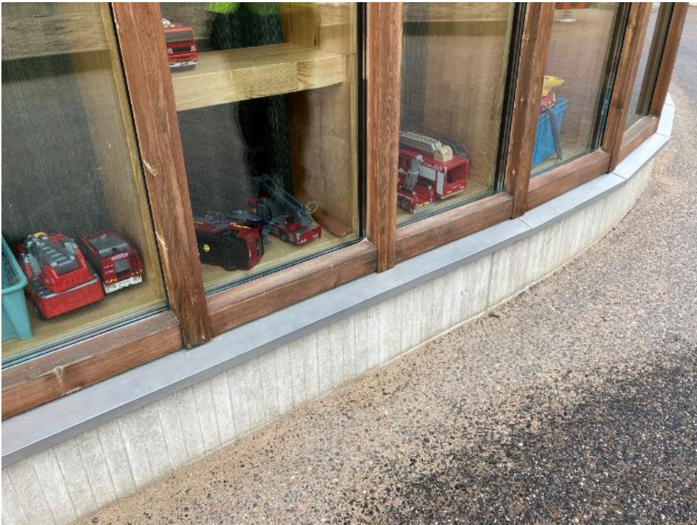
Kuva 4.13. Ulkona ikkunoiden puuosat ovat huollon tarpeessa.
