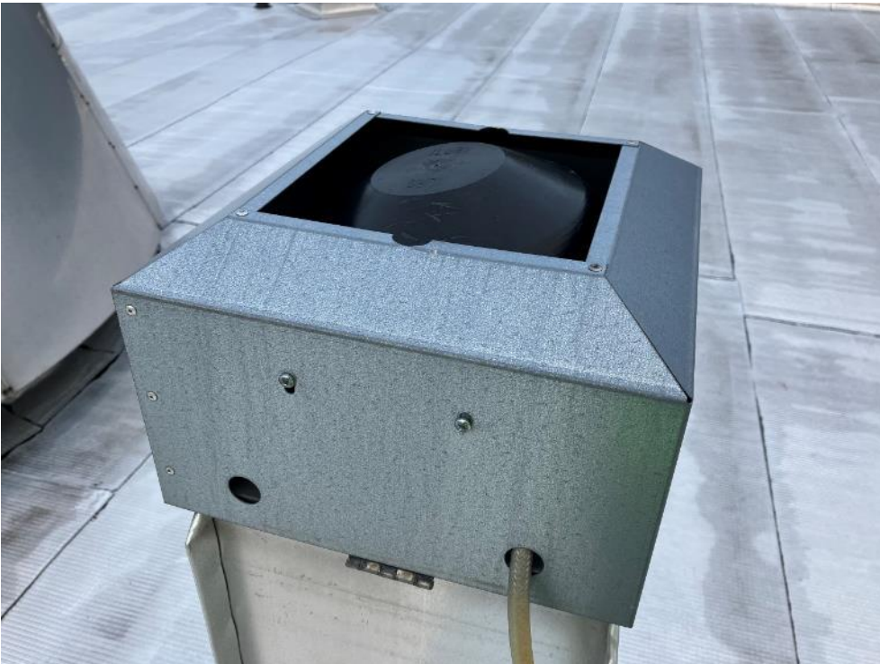
Kuva 4.17. PK4-PF1 Huippumurin suojahattu ei ole kunnolla kiinni ja heiluu.
