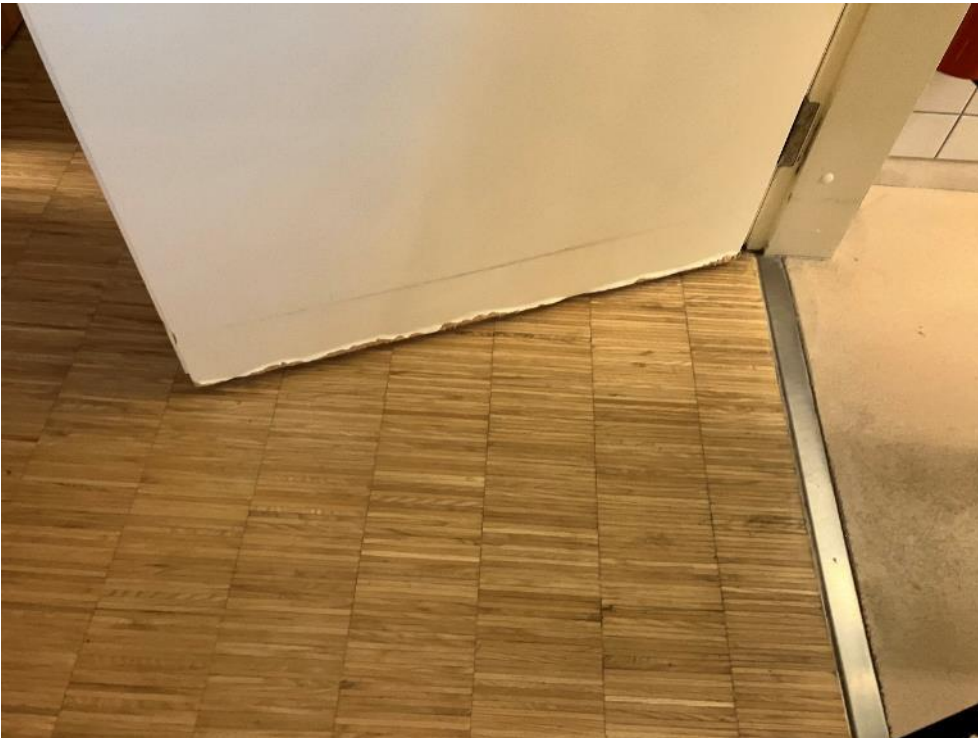
Kuva 4.35. Tilan 255 ovi on turvonnut alareunasta.
