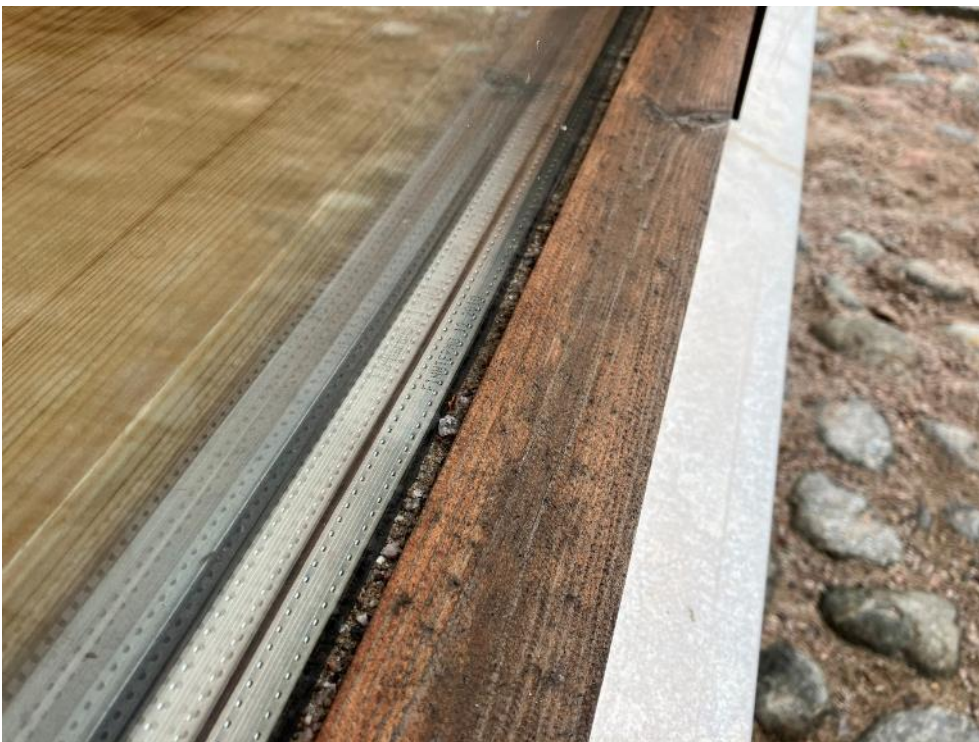
Kuva 4.11. Ikkunan puuosan ja lasin välissä on hiekkaa useassa kohdassa.
