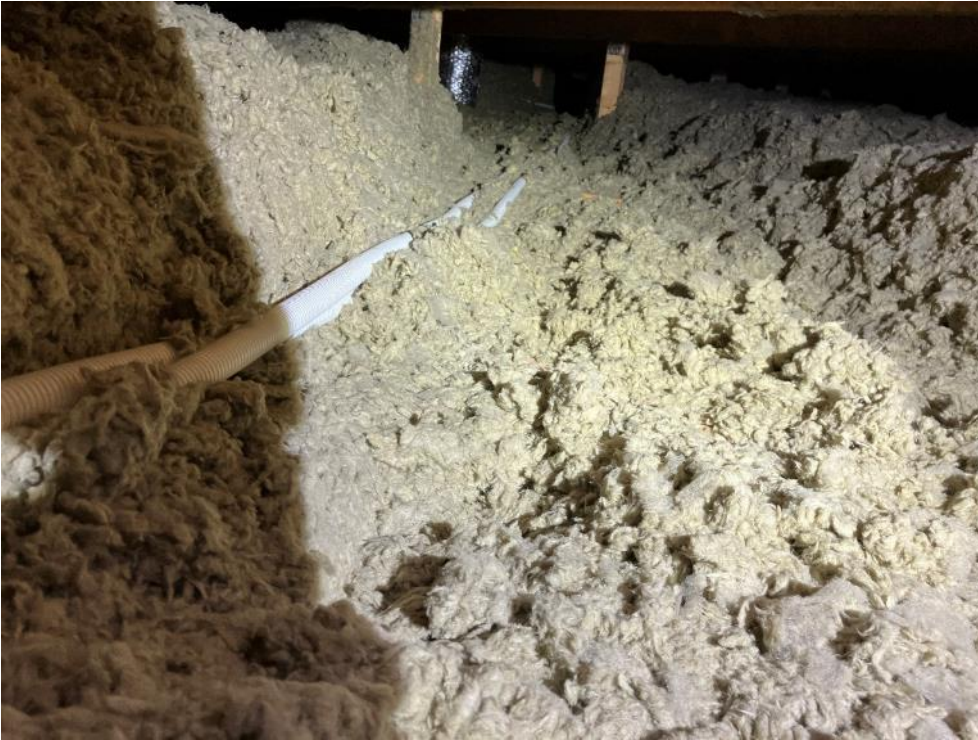
Kuva 4.22. Yläpohjassa on puhallusvillassa ura sähkövetojen kohdalla.
