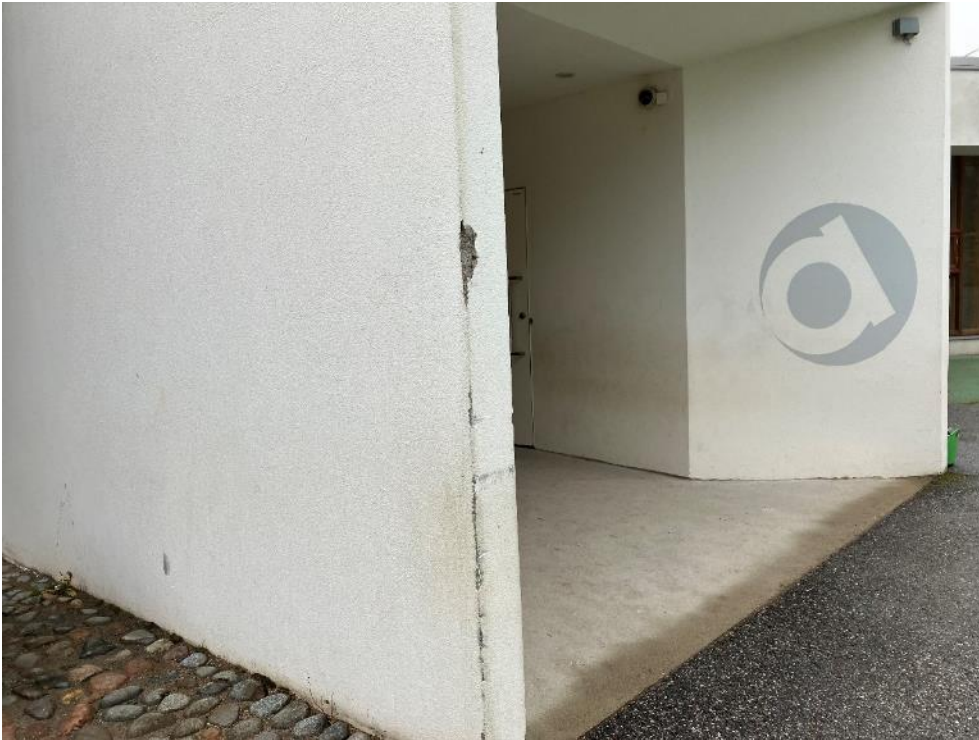
Kuva 4.2. A-sisäänkäynnin seinäelementistä on lohjennut pala.
