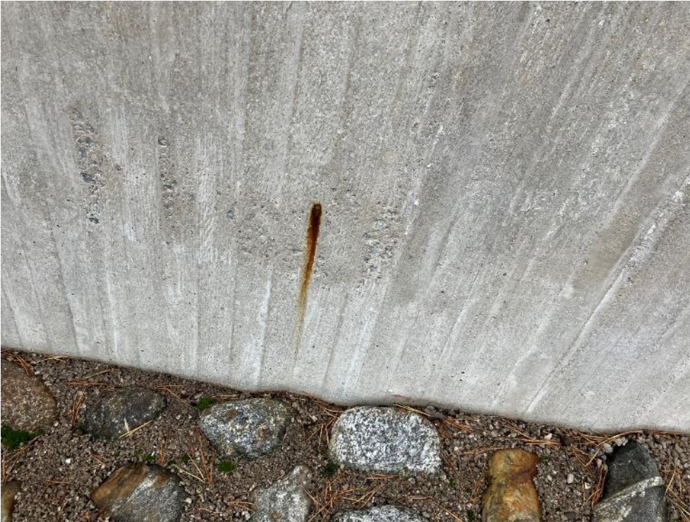
Kuva 4.16. Eteläpäädyssä raudoitus on liian pinnassa.
