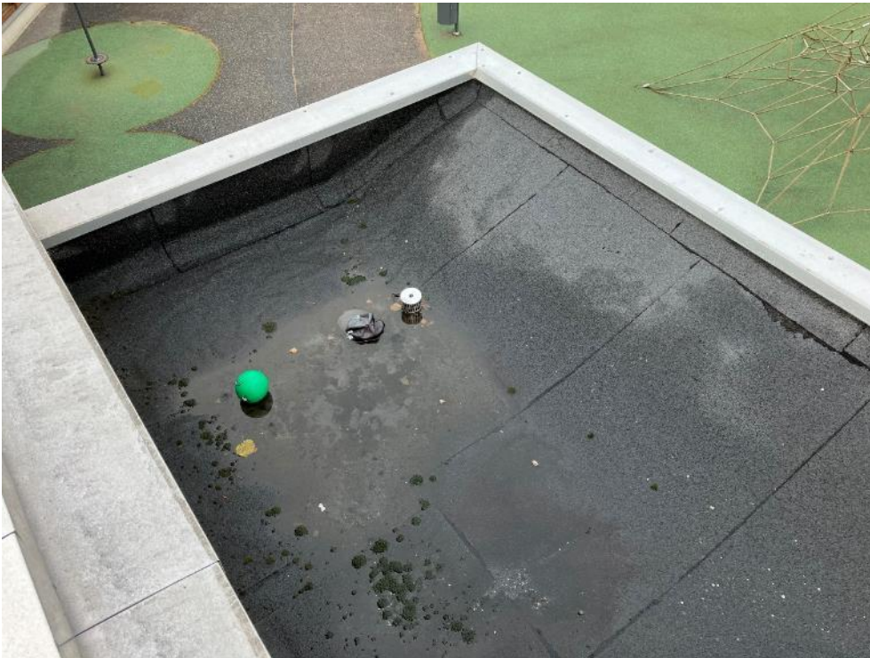
Kuva 4.1. A-sisäänkäynnin katon roskasihti on puhdistamatta ja tavaraa on katolla.
