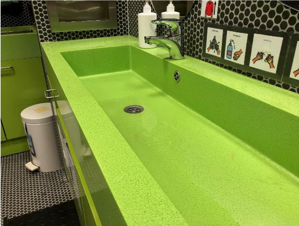
Kuva 4.30. Tilan 230 pesuallas vetää huonosti.
