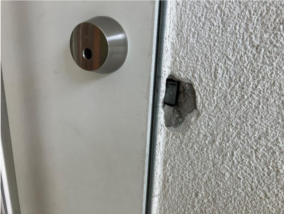
Kuva 4.12. Tilan 218 varaston lukon kielen kohdalta on lohjennut seinästä pala.
