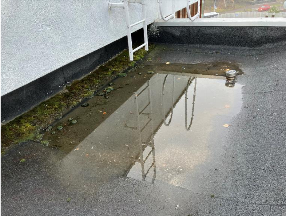
Kuva 4.8. C-sisäänkäynnin katon roskasihti on puhdistamatta ja katolla on sammalta.
