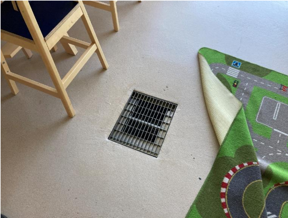
Kuva 5.2. Huoneen 245 lattiakaivossa seisahtanutta ja likaista haisevaa vettä.
