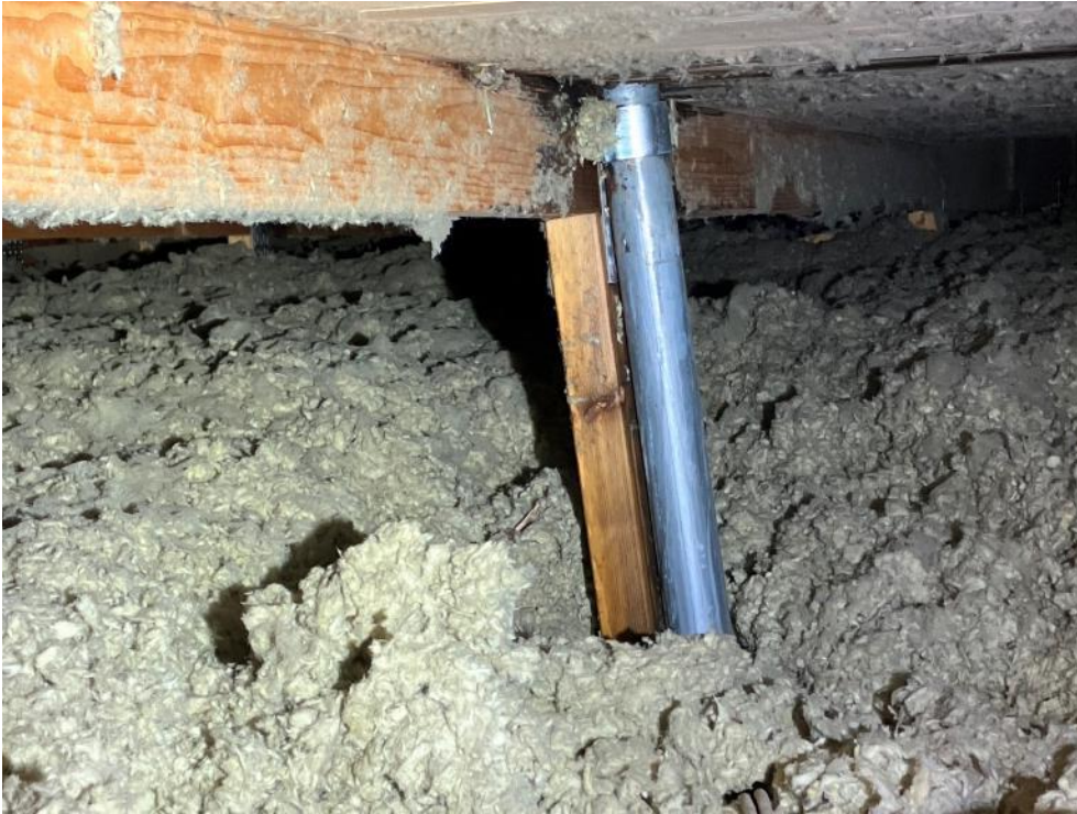
Kuva 4.14. Antennitolpan läpivienti vuotaa.
