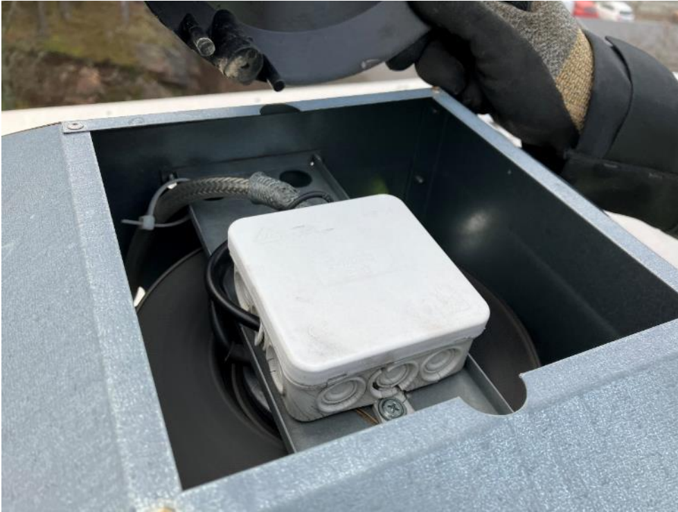
Kuva 4.18. PK11-PF1 Huippuimurin suojakansi on irti.
