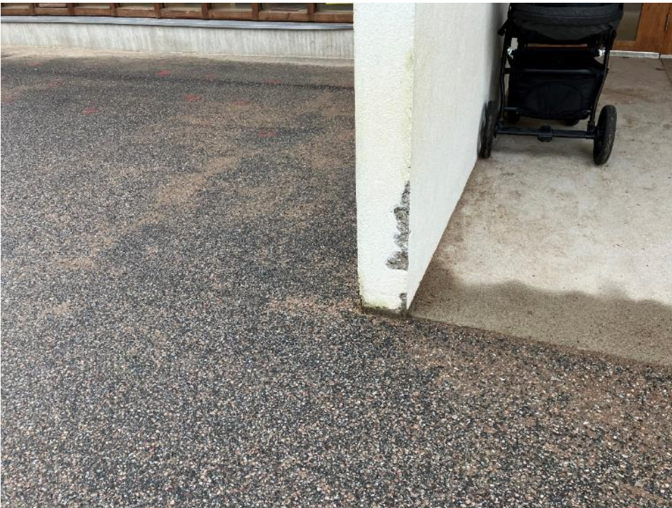
Kuva 4.7. C-sisäänkäynnin seinäelementistä on lohjennut pala.
