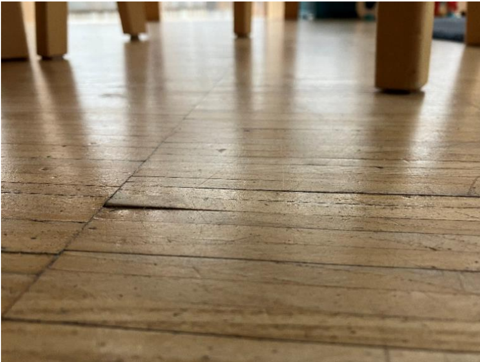
Kuva 4.39. Tilan 201 lattia on huollon tarpeessa.
