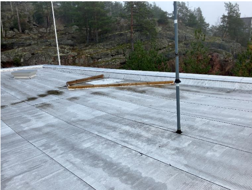
Kuva 4.21. Vesikatolla on ylimääräinen rakennelma.
