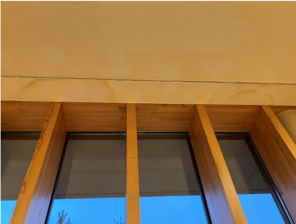
Kuva 4.27. Tilan 225 katossa on vesivuotojälkiä.
