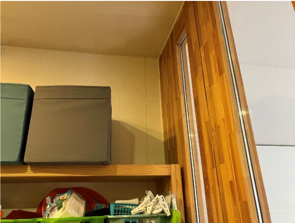
Kuva 4.23. Tilan 204 seinässä on halkeama.
