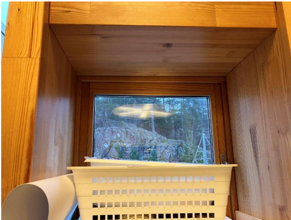
Kuva 4.25. Tilan 214 tuuletusikkuna on vinossa.
