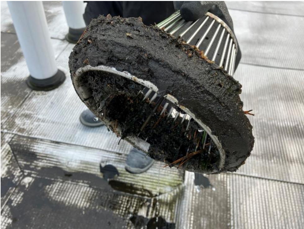
Kuva 4.19. Sadevesiritilöitä ei ole huollettu säännöllisesti.
