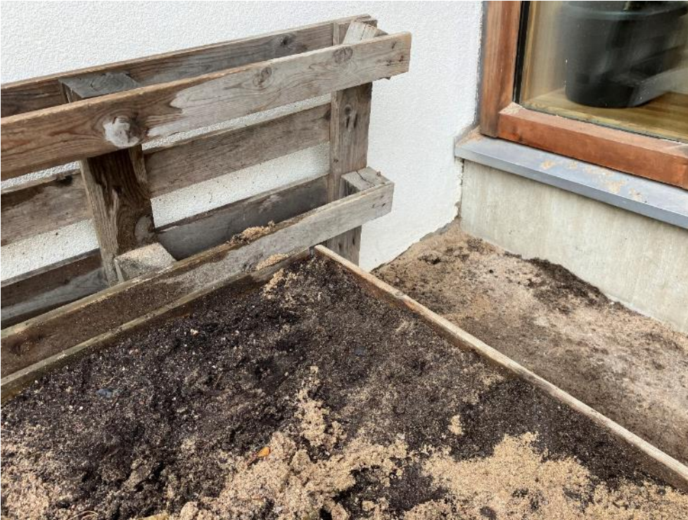
Kuva 4.6. B-sisäänkäynnin sokkelin vieressä on hiekkaa ja multaa.
