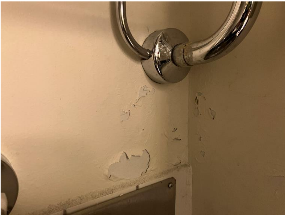
Kuva 4.37. Tilan 256 seinä on kastunut, mutta on nyt kuiva
