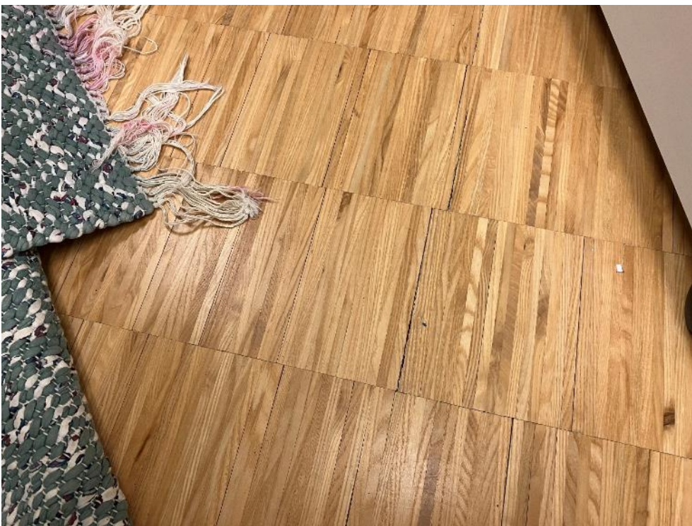
Kuva 4.33. Tilan 247 parkettilattiassa on rakoja.
