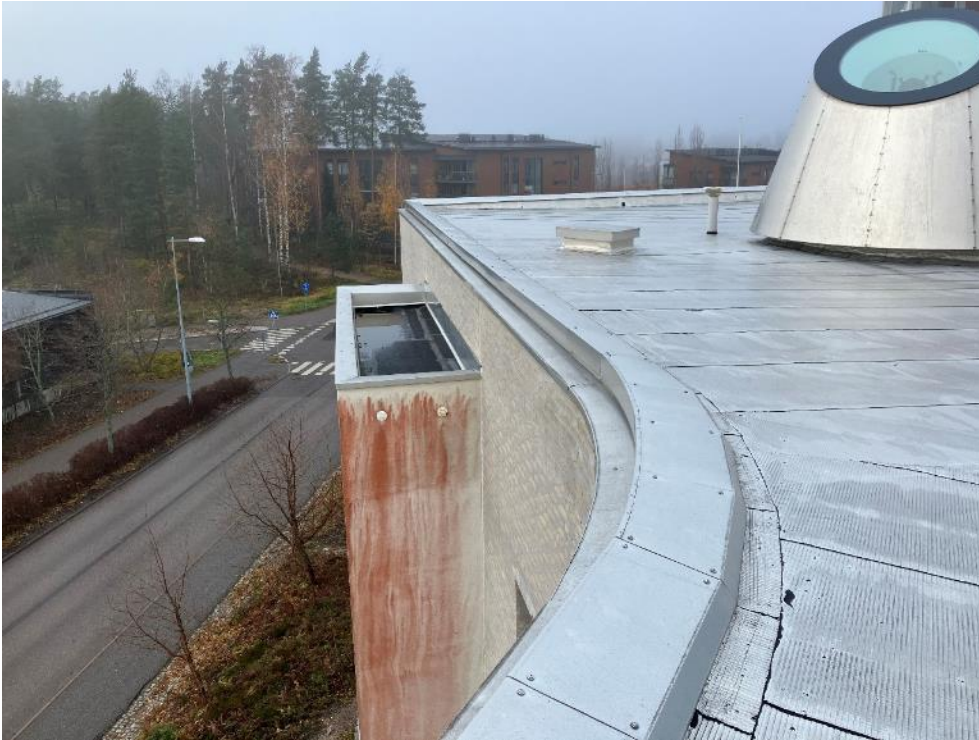
Kuva 4.20. Tilan 239 erkkerin vesikatolla vesi seisoo.
