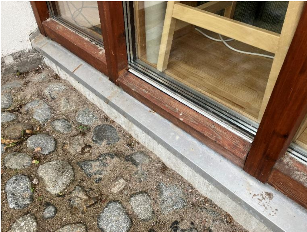
Kuva 4.9. Tilan 201 ulkopuolella ikkunan puuosa on irti.
