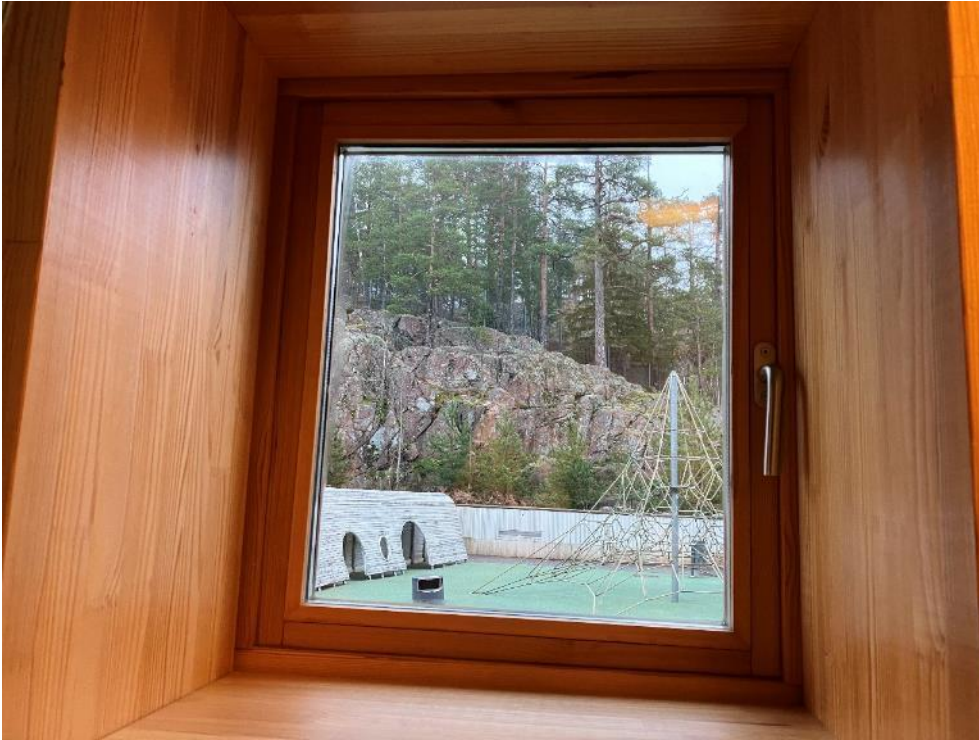
Kuva 4.26. Tilan 215 tuuletusikkuna on vinossa.
