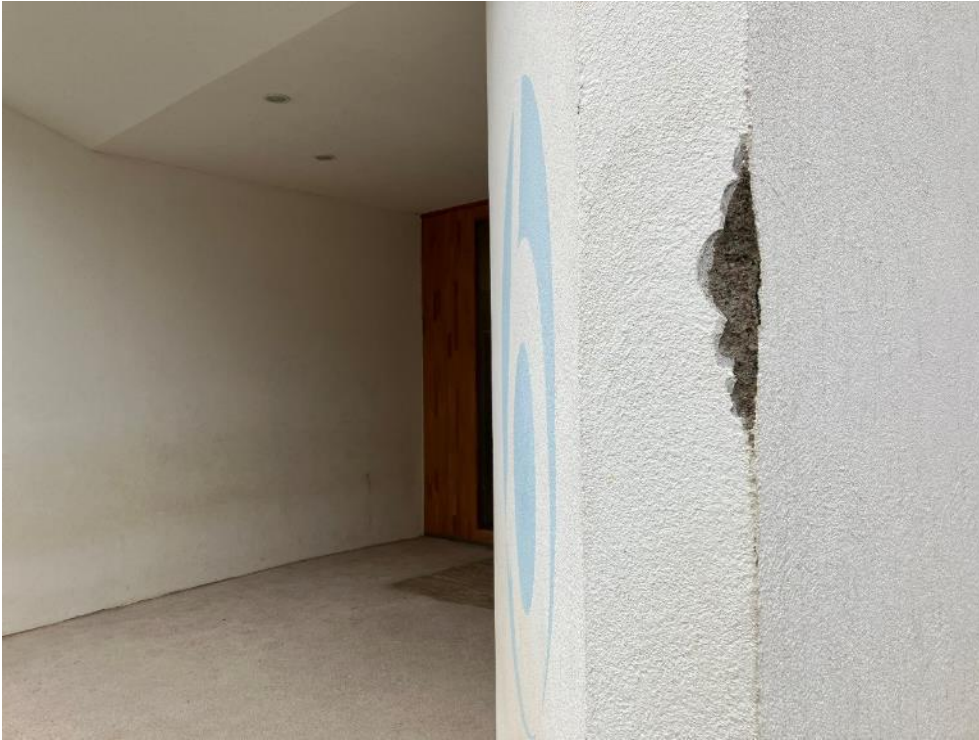
Kuva 4.4. B-sisäänkäynnin seinäelementistä on lohjennut pala.
