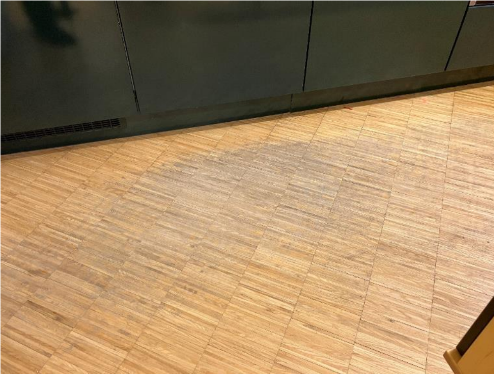
Kuva 4.34. Tilan 248 keittiön edustan lattia on kulunut.
