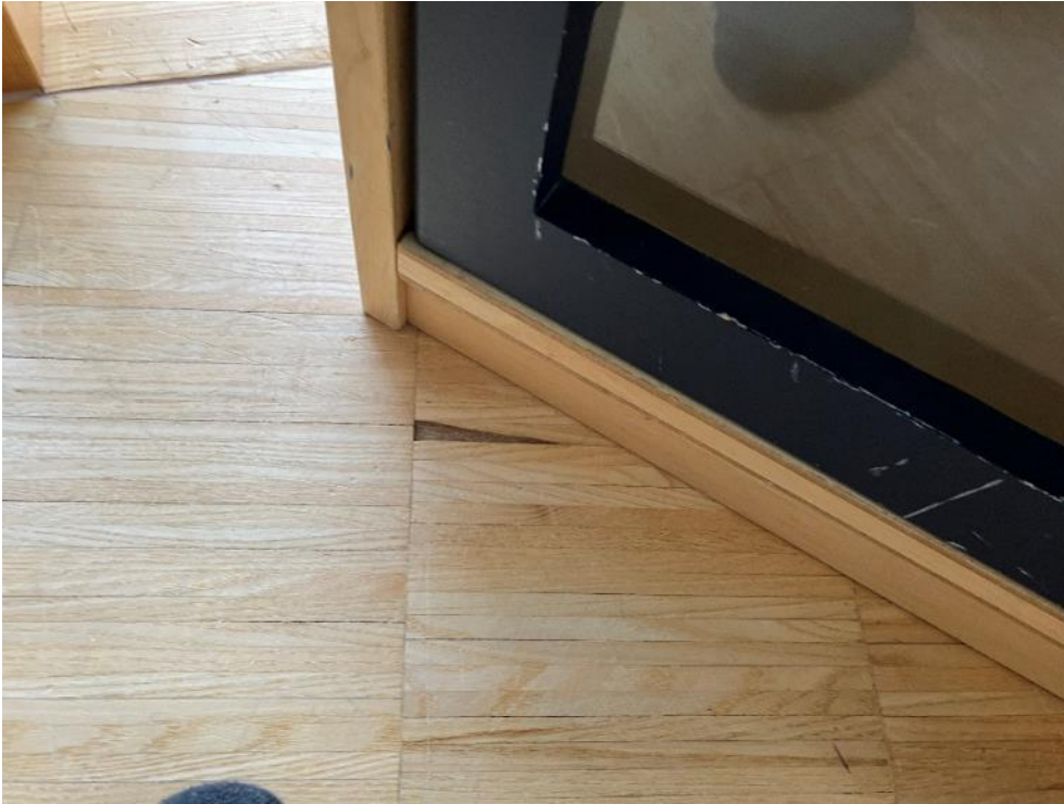
Kuva 4.38. Tilan 201 lattia on huollon tarpeessa.
