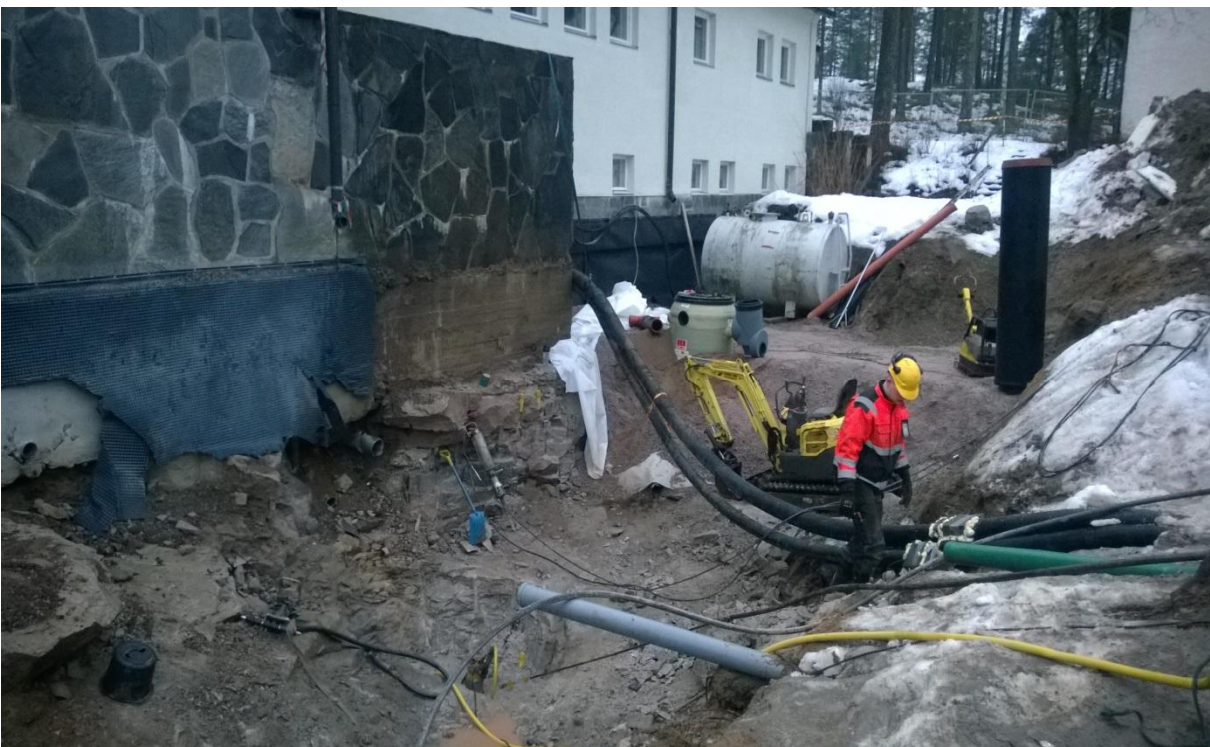
Kuva 8. Rakennuksen alta tulevan sadevesiputken alla kallio on rikkonaista, ja raoista tihkui öljyä. Pumppaamo ja hiekan-/öljynerotin asennettiin tälle alueelle. Taustalla näkyy asennettu uusi keittiön rasvakaivo.
