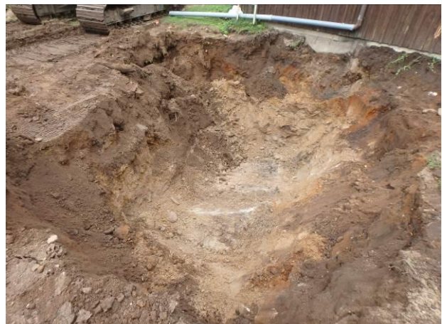
Valokuva 4. Kallio poistetun öljysäiliön alla.
