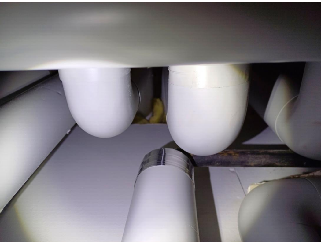
Kuva 4.4. IV-konehuone läpiviennit viereisiin tiloihin ei ole tiiviit.
