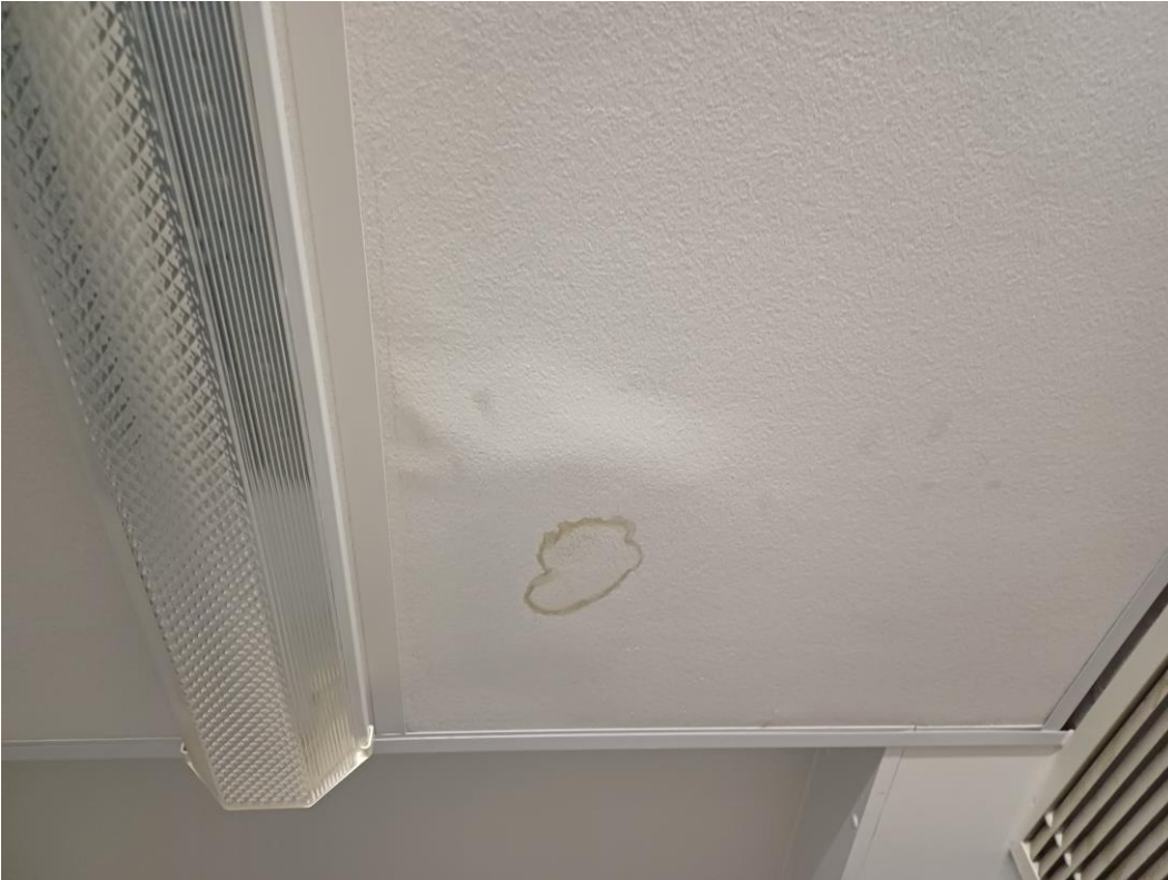
Kuva 4.3. Pukuhuoneen 109 katon akustointilevyssä on kosteusjälki.
