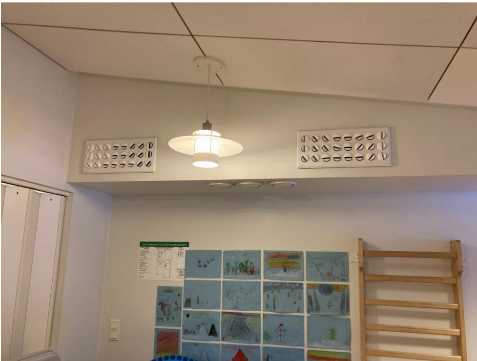
Kuva 5.1. Ilmanvaihdon päätelaitteet eivät ole suunnattu oikein, tuloilma ei huuhtelee koko tilaa.
