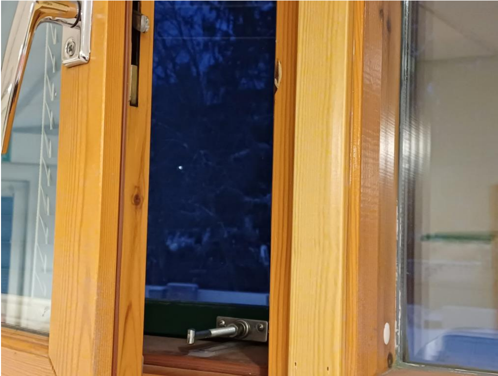
Kuva 4.7. Osa tuuletusikkunoiden aukipitolaitteista on irronnut kiinnikkeistä estäen ikkunan tiiviin sulkeutumisen.
