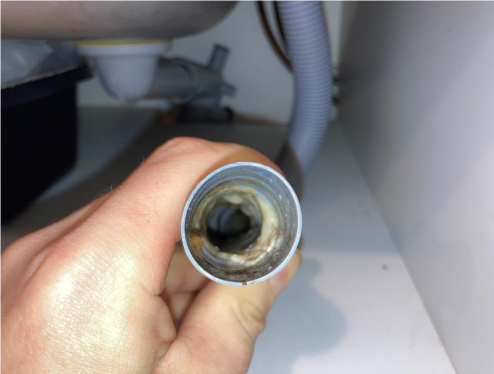
Kuva 5.2. Ylivuotoputkistossa ja viemäröinnissä tunkkaista voimakasta hajua, ruuanjämää jne. Tarkastuksen yhteydessä huuhdeltu putkistosta suurimmat liat pois.
