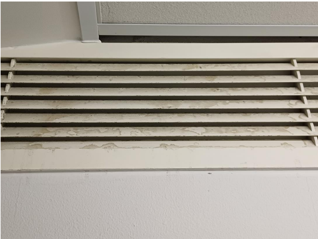
Kuva 4.2. Väliseiniin asennetut siirtoilmaritilät ovat likaisia.
