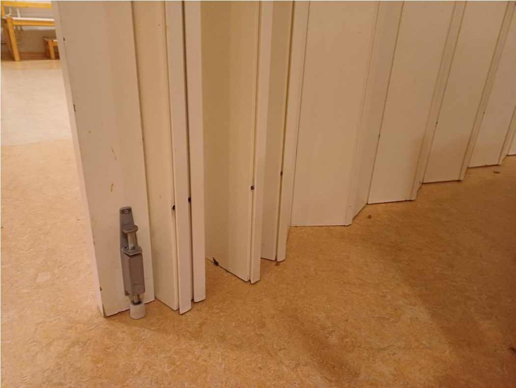
Kuva 4.5. Leikkitilan 117 paljeovi laahaa osittain lattiaa vasten.
