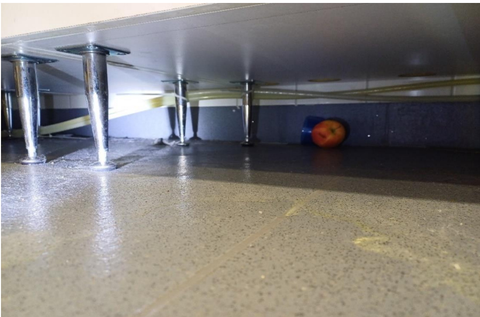
Kuva 4.2. Keittiön 1.02 kaappien alustan siivous on puutteellista.
