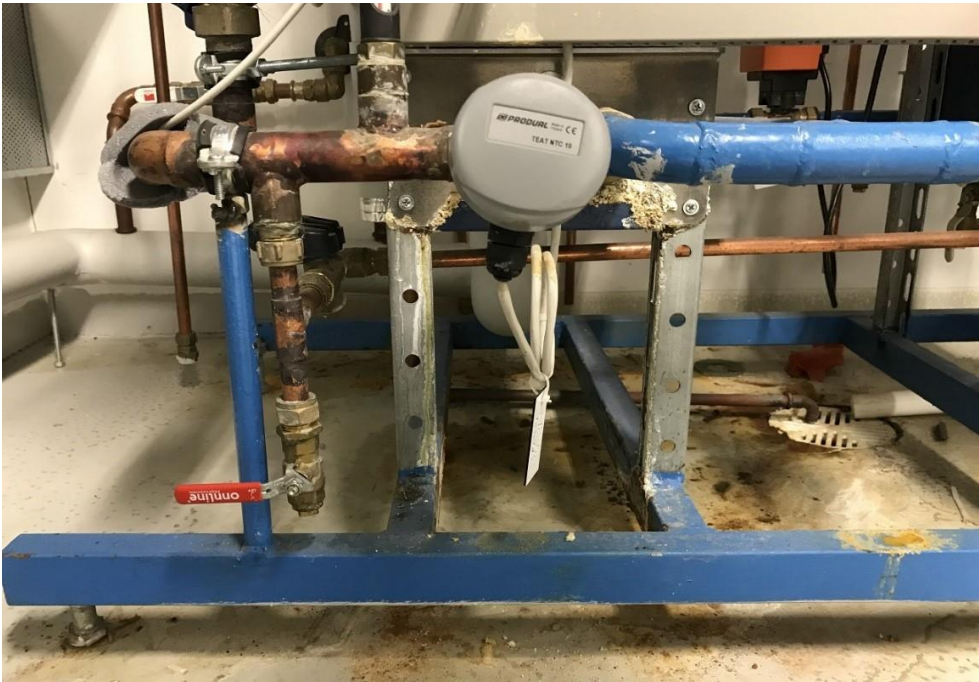
Kuva 6.1. Käyttövesi lämmönvaihdin vuotaa vettä.
