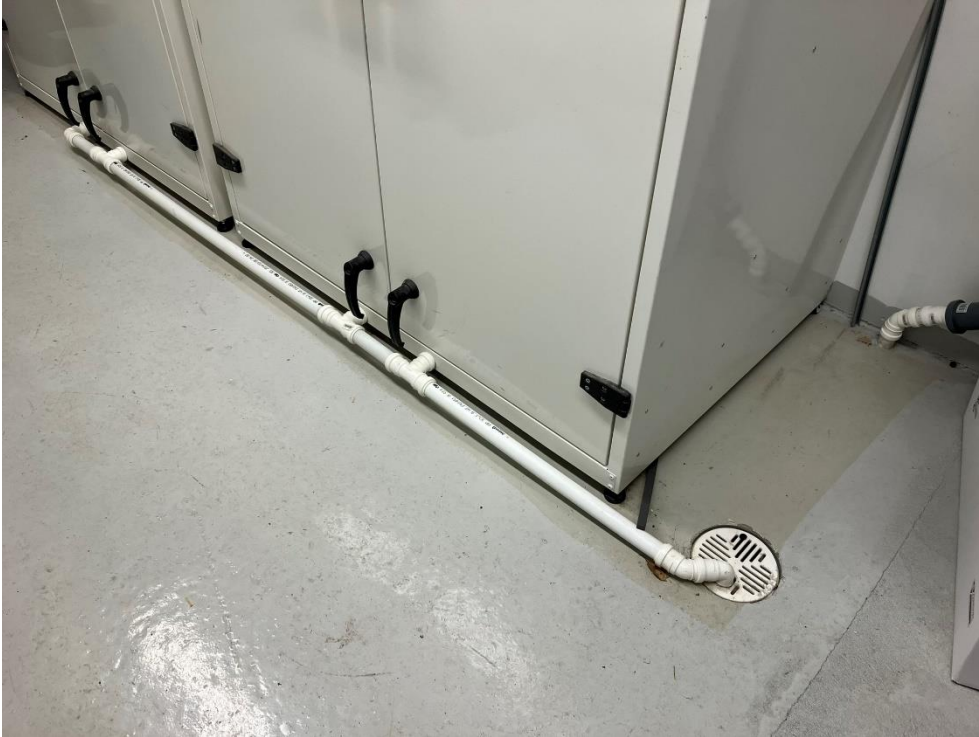
Kuva 5.1. Kaikkien ilmanvaihtokoneiden viemäröinneistä puuttuvat takaimusuojat.
