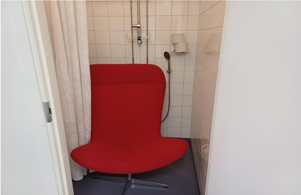
Kuva 4.3. Pesuhuoneen 1.04 lattiakaivon päällä on tavaraa. Lattiakaivo on päässyt kuivumaan, aiheuttaen viemärinhajua.
