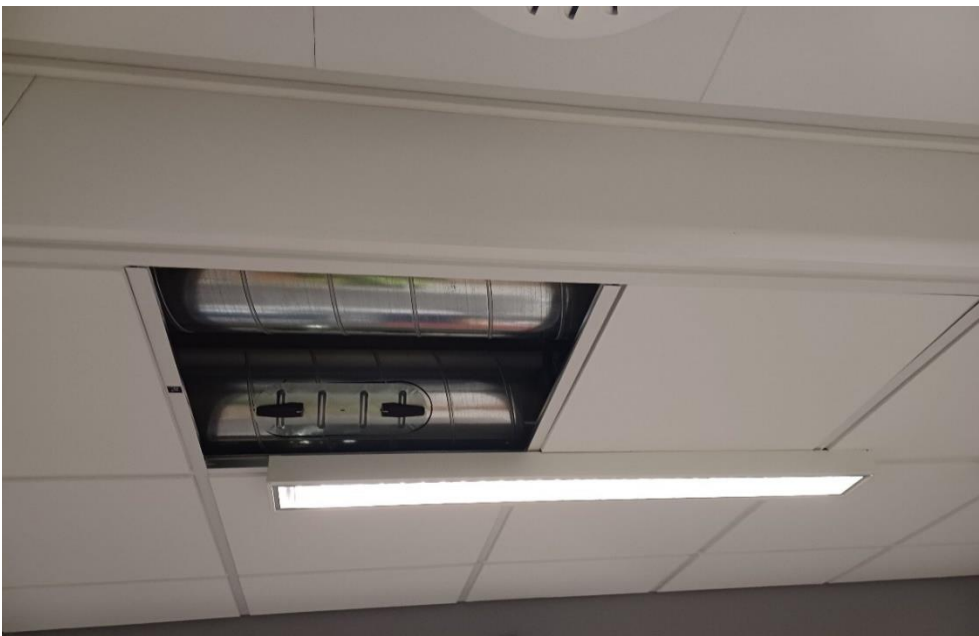
Kuva 4.6. Pienryhmätilan 1.18 alakatosta puuttuu alakattolevy.
