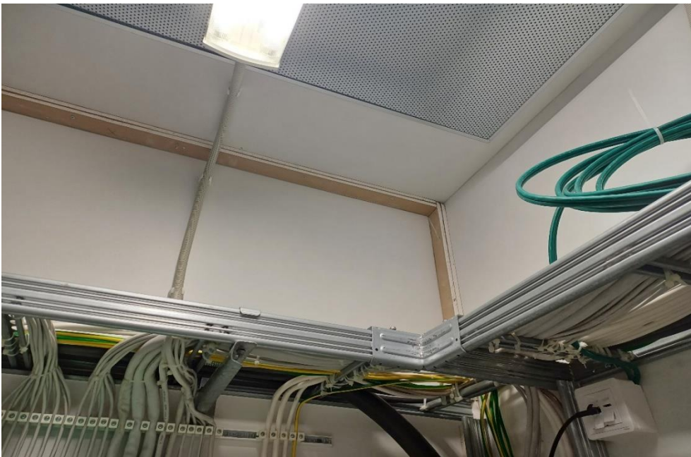
Kuva 4.1. Teknisen tilan 1.01 läpivientien ja rakenneliittymien tiiveys viereiseen tilaan on epävarmaa.
