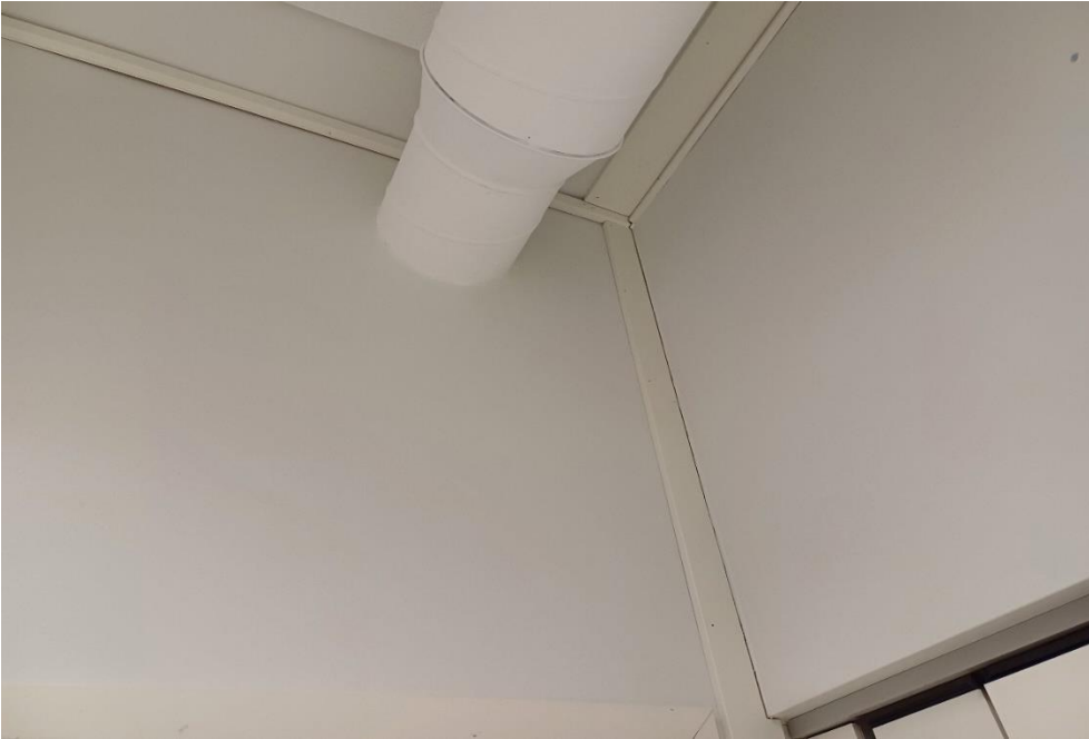
Kuva 4.11. Rakenneliittymien tiiveys listoituksien alla on epävarmaa.
