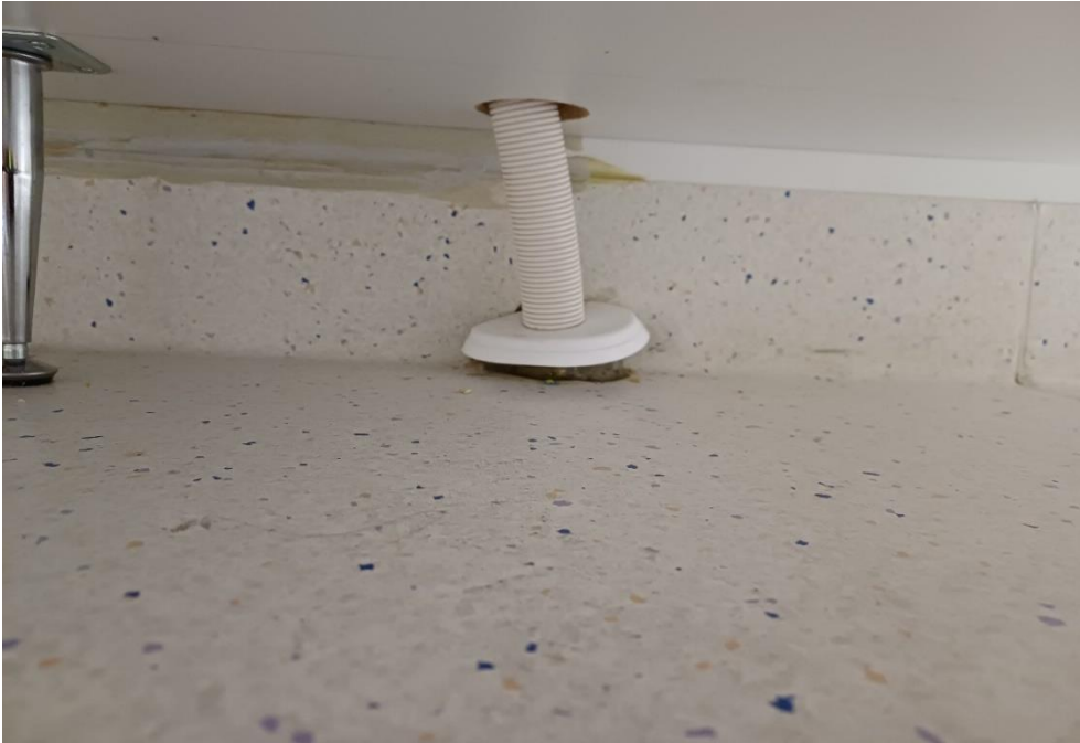
Kuva 4.5. Pienryhmätilan 1.13 pesualtaan viemäriliitos ei ole tiivis.
