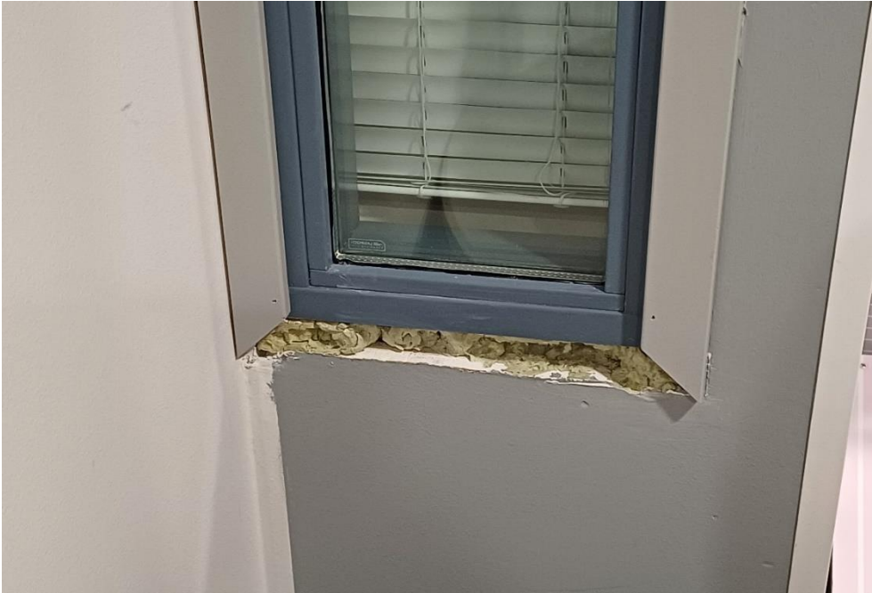
Kuva 4.7. Käytävän 1.19 sisäikkunasta puuttuu alalista.
