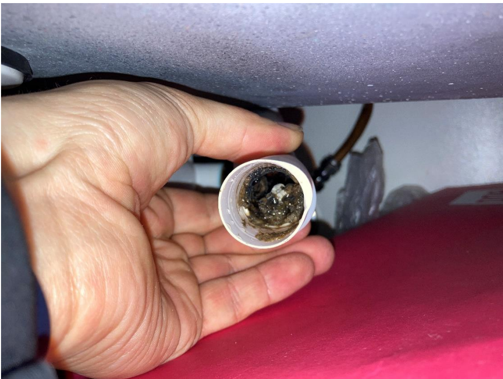
Kuva 5.2. Pesualtaiden ylivuotoputket paikoitellen likaisia ja päästävät viemäriin kertyneen lian hajua sisätiloihin.
