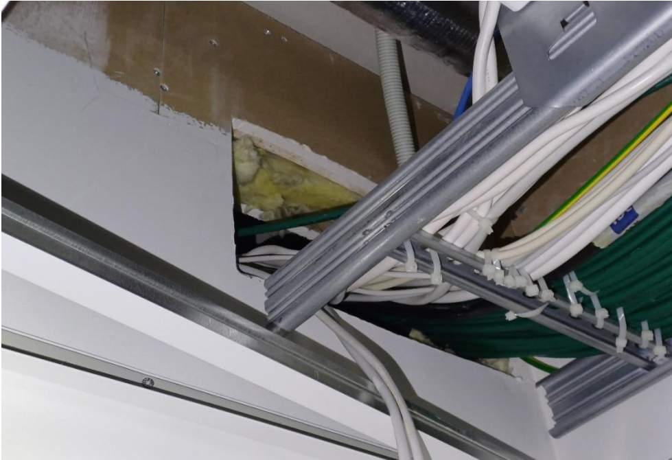
Kuva 4.9. Teknisen tilan 1.25 alakattolevyjä pois paikoiltaan, eikä läpiviennit ole tiiviit.
