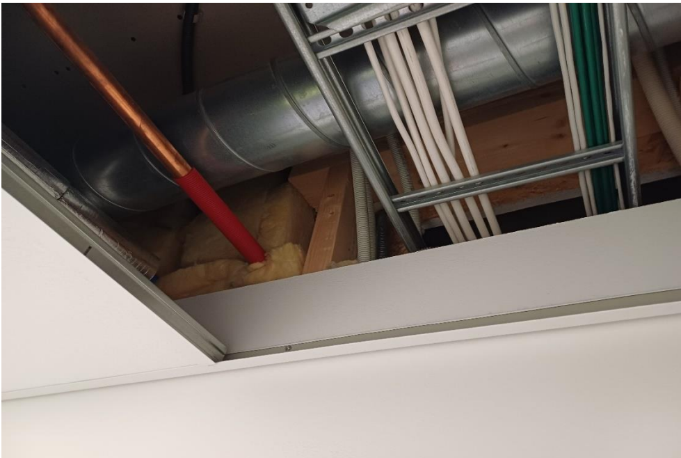
Kuva 4.10. Tuulikaapin 1.30 alakatosta puuttuu alakattolevyjä, eikä läpiviennit ole tiiviit.
