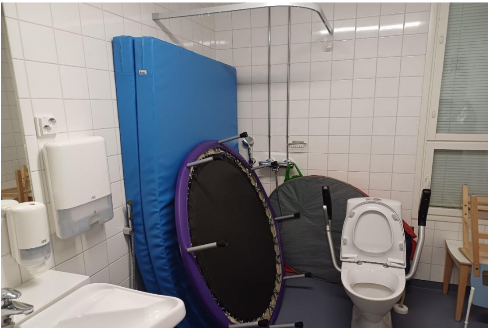
Kuva 4.8. Sosiaalitallassa 1.24 suihkunurkassa on tavaraa, eikä lattiakaivoa pääse täyttämään.
