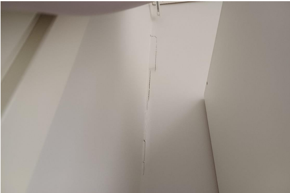
Kuva 4.4. Pienryhmätilan 1.11 nurkassa rakenneliittymän ratkeama.
