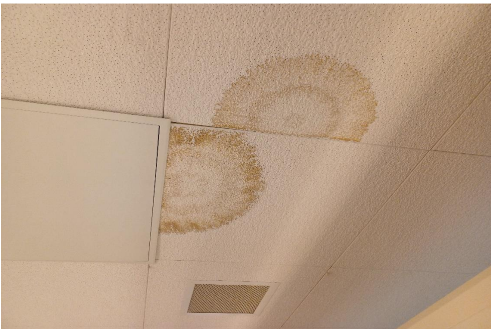
Kuva 4.2. Alas laskettujen kattojen levyelementeissä on näkyvissä useampia vanhoja kosteusvauriojälkiä.
