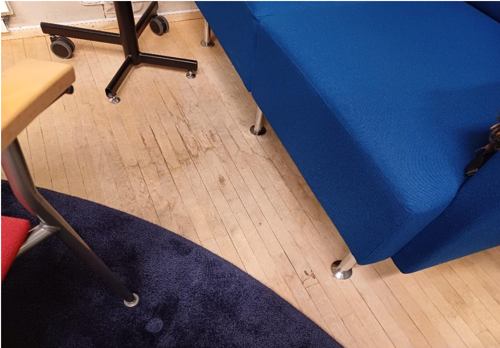
Kuva 4.1. Työtila Koivun 146 lattiaparketissa on näkyvissä vanhoja kosteusvauriojälkiä.
