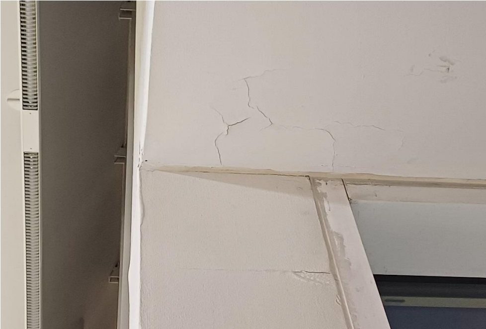
Kuva 4.3. Musiikkiosaston seinissä on rakennehalkeamia ja rakenneliittymien ilmavuotoja.
