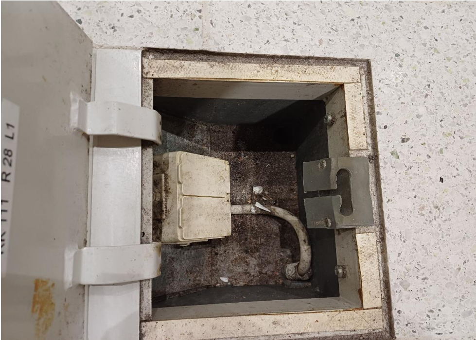
Kuva 4.5. Lattioihin asennetut sähkökotelot on epäsiistejä ja sähköputkien päät on tiivistämättä.
