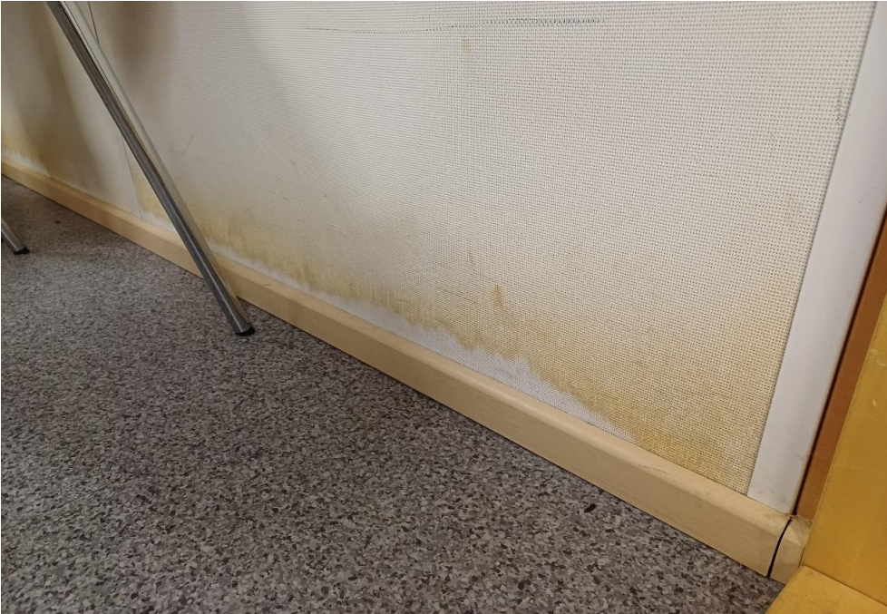
Kuva 4.7. Kellarikerros kokoustila 13 seinälevytyksen alareunassa on näkyvissä vanhoja kosteusvauriojälkiä.
