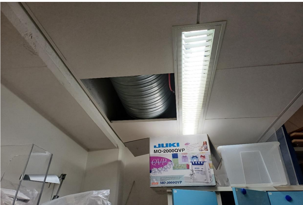
Kuva 4.8. Kellarikerros varastotila 015.1 alakatossa puuttuu levyelementti.
