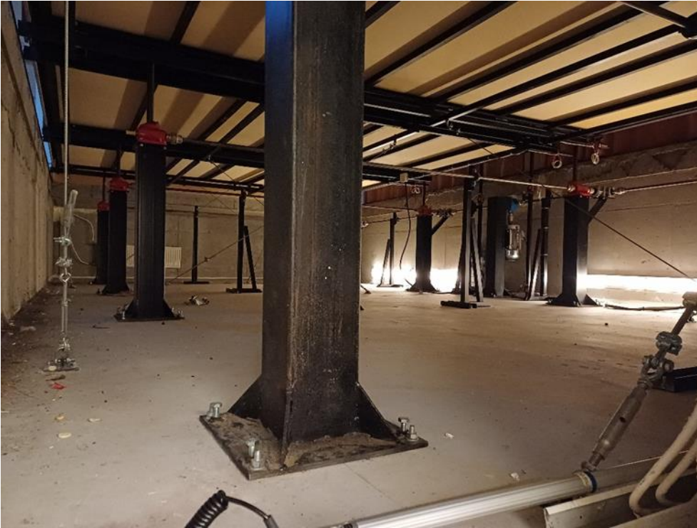
Kuva 4.9. 175 Liikuntasalin ylös nostettavan näyttämölavan alusta on likainen.
