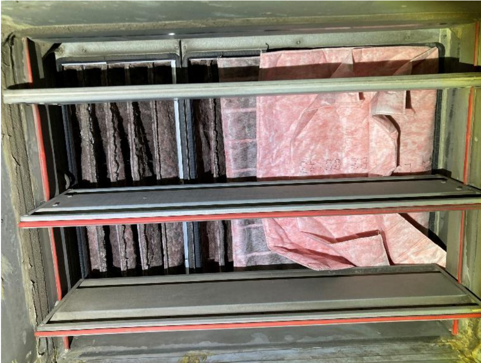
Kuva 5.4. Ruokalan ilmanvaihtokoneen suodattimet on asennettu väärin. Suodattimien asennus heikentää läpivirtaavaa ilmaa.
