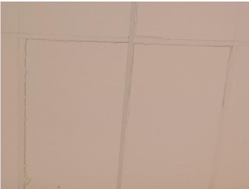
Kuva 4.14. 232 Kokoushuoneen katon akustointilevyissä on vesivuotojälkiä.
