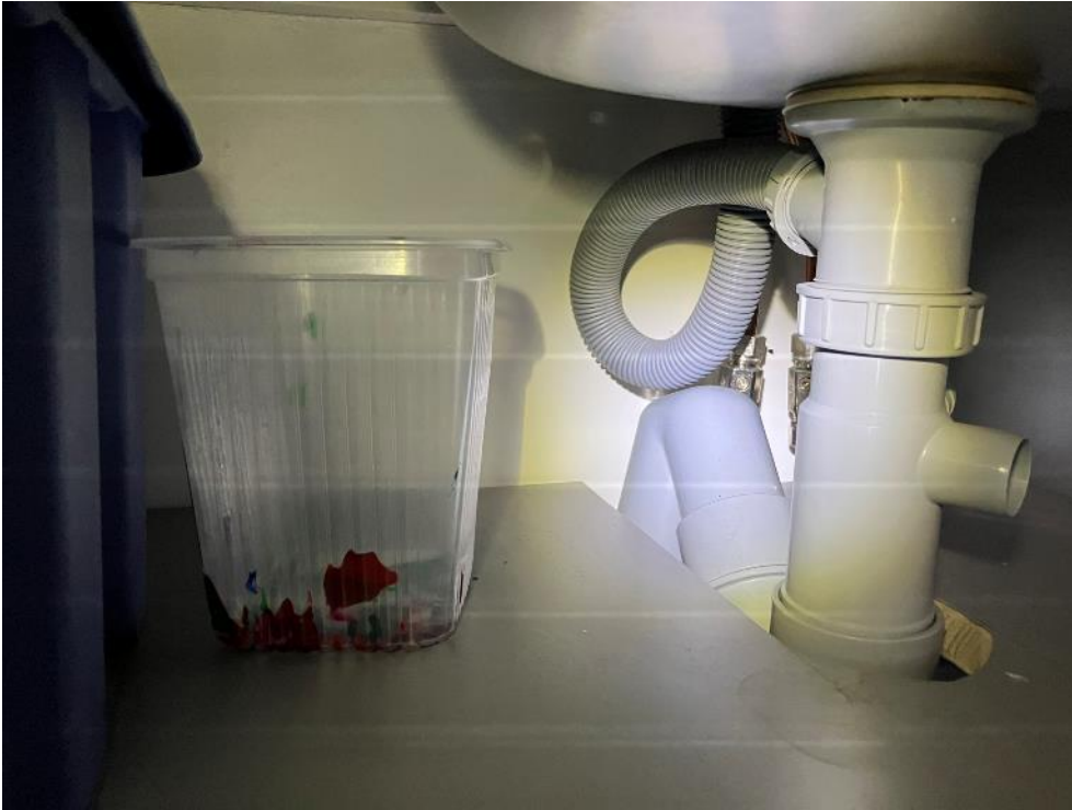
Kuva 5.6. Pesualtaan ylivuotoputki on liian pitkä ja mutkalla.
