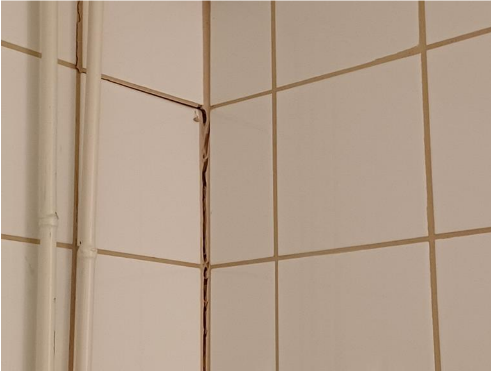
Kuva 4.15. 238 wc-tilan seinälaatoituksen silikonisauma on revennyt auki.
