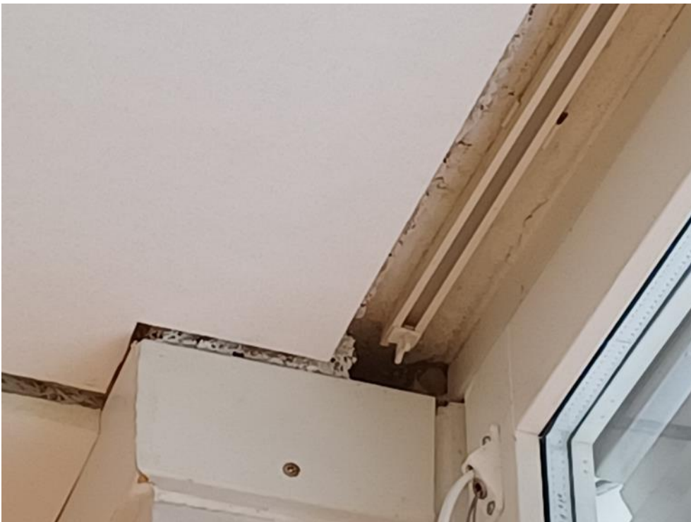
Kuva 4.12. 217 tilan ulkoseinän yläosassa on ilmavuotoja.
