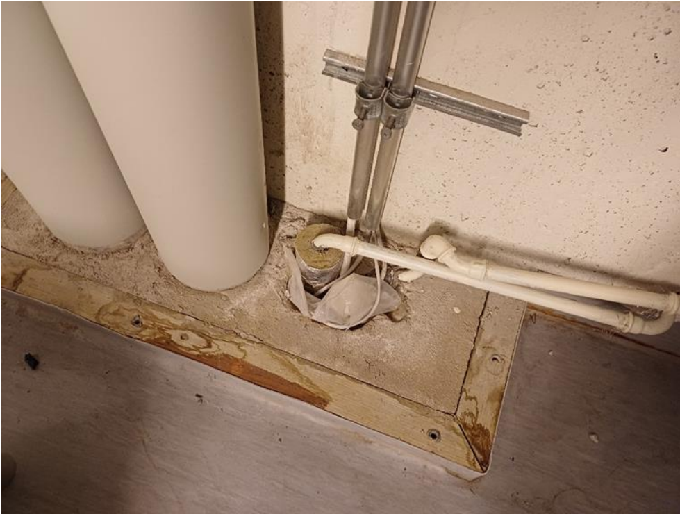
Kuva 4.19. 301 IV-konehuoneen läpivienti ei ole tiivis.
