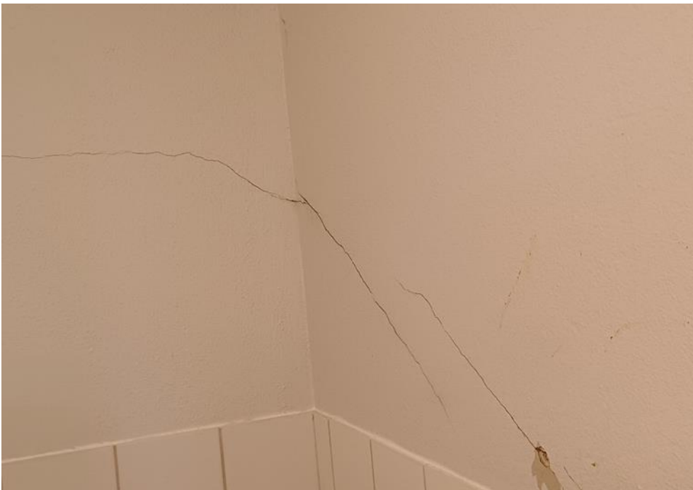
Kuva 4.2. 105 tilassa on seinähalkeamia.
