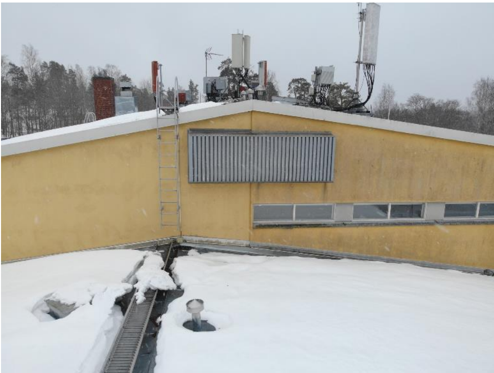
Kuva 5.1. Vanhan puolen luokkatiloja, keittiötä ja ruokalaa palvelevien ilmanvaihtokoneiden TK 5 ja TK7-9 yhteiseen raitisilmakammioon pääsee lumi sisään lumisuojaosaleiköstä huolimatta.
