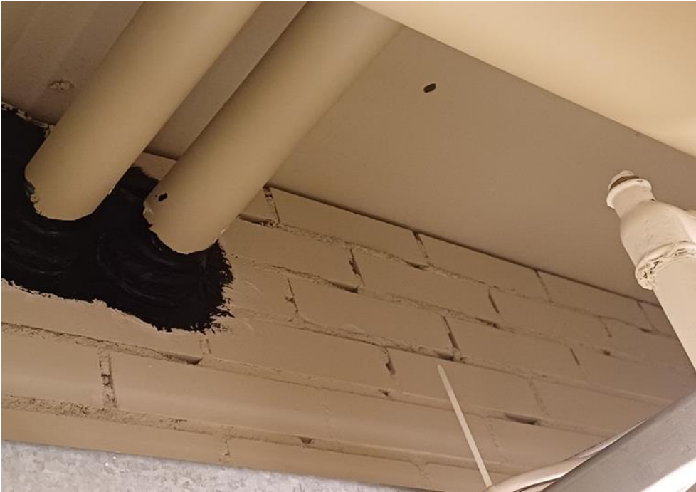
Kuva 4.3. 118 Lämmönjakuhuoneen seinän yläosa ei ole tiivis viereisiin tiloihin.
