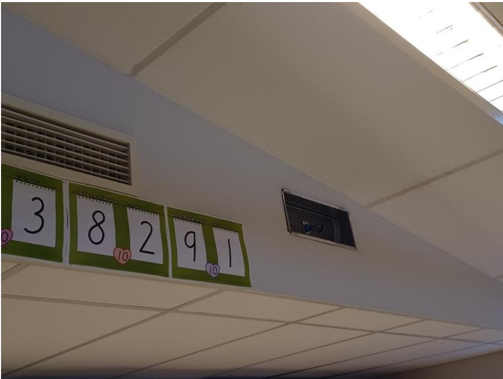
Kuva 4.16. 245 tilan IV-päätelaitteen säleikkö puuttuu.
