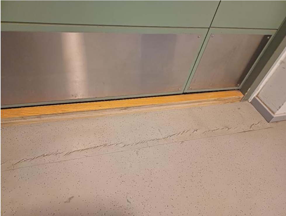
Kuva 4.17. 248 Porrashuoneen ulko-oven kohdalta lattiapinnoite on repeillyt.
