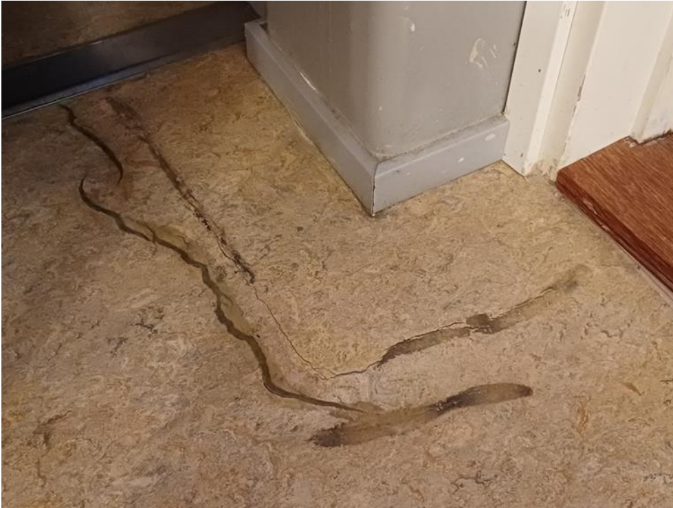
Kuva 4.11. 202 Ruokailutilan lattia on painunut alas ja lattiapinnoite on repeillyt pilarianturoiden kohdilta.
