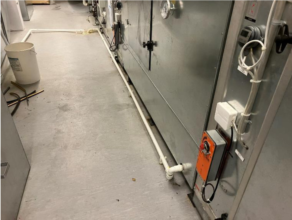
Kuva 5.2. Ilmanvaihtokoneiden viemäröinneistä puuttuvat takaimusuojat.
