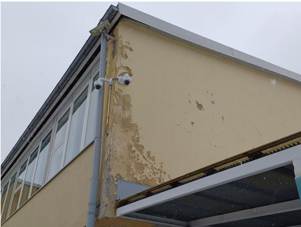
Kuva 4.22. Julkisivun pintarappaus rapautuu useista kohdista.
