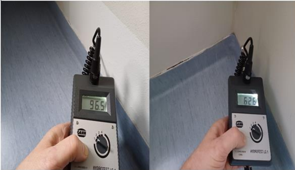
Kuva 4.5. 128 tilan lattiassa havaittiin kohonneita pintakosteusilmaisimen vertailulukemia.
