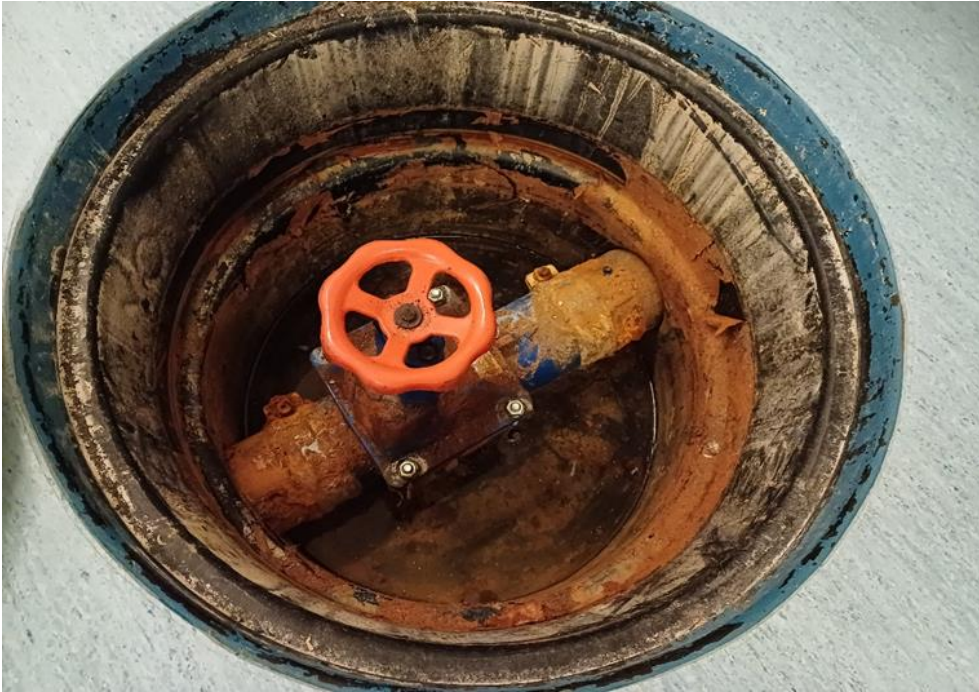
Kuva 4.1. K07 tilan sulkuventtiilikaivon pohjalla on vettä.
