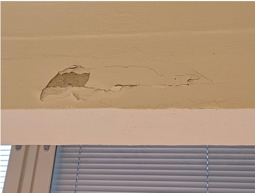
Kuva 4.18. 253 tilan maali ja tasoite irtoilee alustastaan.
