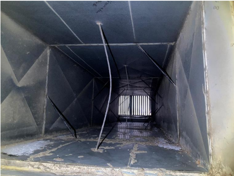
Kuva 5.3. Mediateekin 231 yläpuolella olevan raitisilmakammioon sulanut lumi vuotaa kammion liitoksista alapuolella olevan tilaan. Kuva ilmanvaihtokanavasta.
