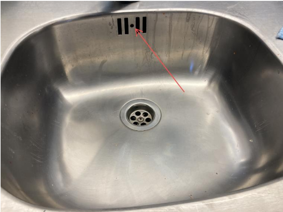
Kuva 5.7. Luokassa 239 pesuallashanan ylivuotoputken kiinnitys on puutteellinen. Pultti, joka pitää ylivuotoputken vastakappaletta paikallaan on hävinnyt.
