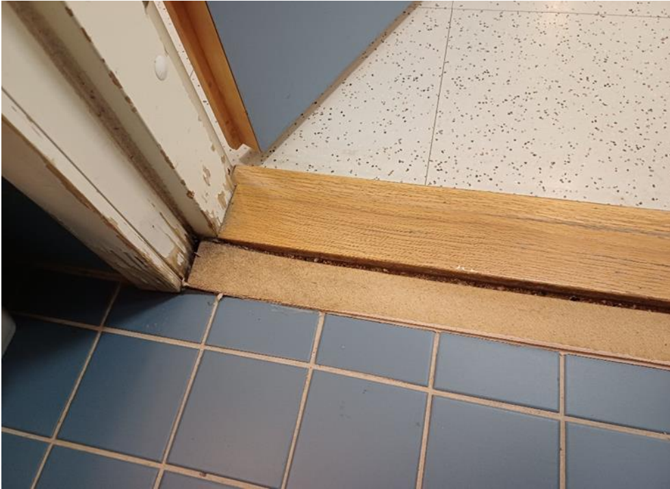
Kuva 4.7. 162 tilan kynnyksestä puuttuu puuosa.
