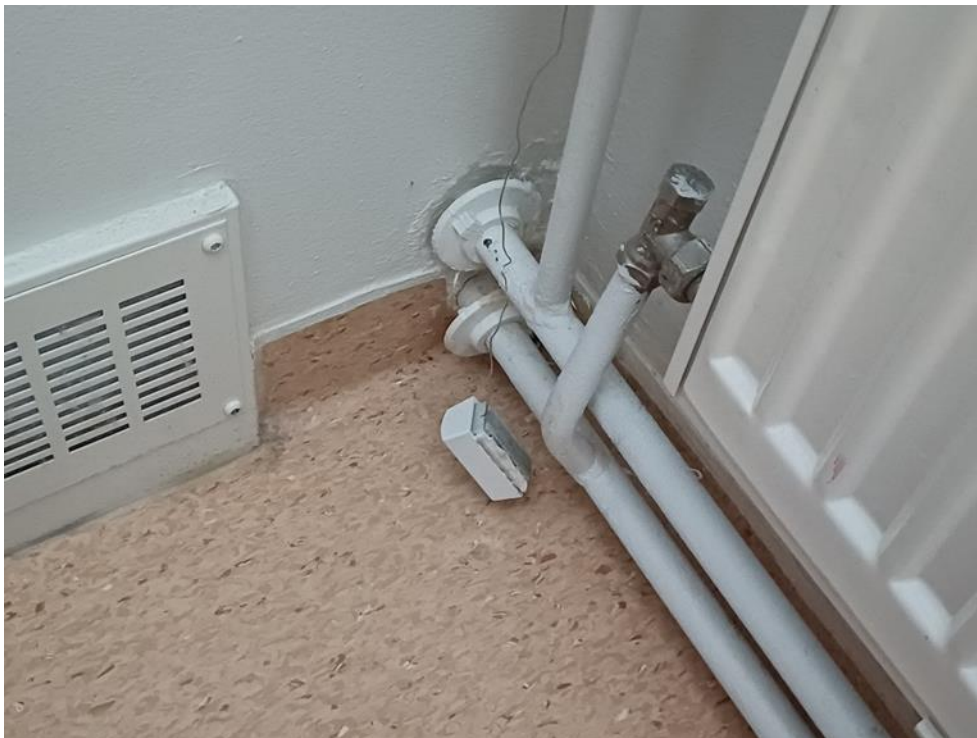
Kuva 4.10. 1.kerroksen alueella on useita lämpöpattereiden erillistermostaatteja irti seinästä.
