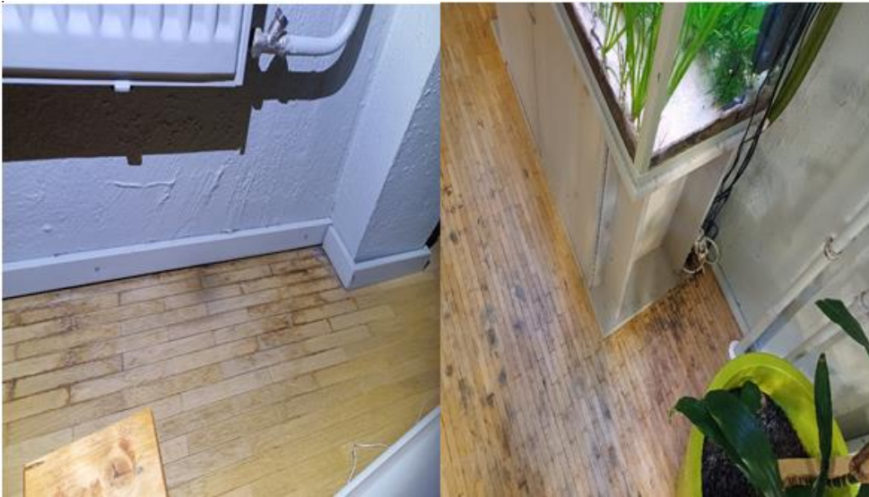
Kuva 4.13. 231 Mediakeskuksen seinäpilarissa ja pilarin kohdalla parketissa on vanhoja vesivuotojälkiä. Akvaarion kohdalla parketissa on vanhoja vesivuotojälkiä.
