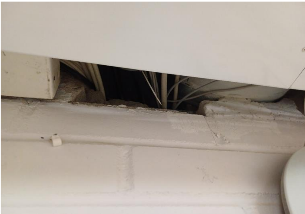
Kuva 4.6. 150 tilan IV- ja sähköläpiviennit eivät ole tiiviit.
