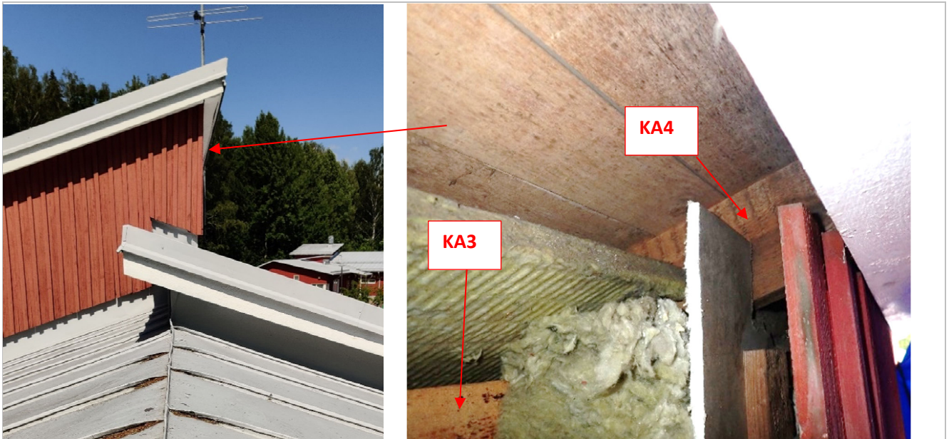
Kuva 8. Korkeamman lappeen räystäällä esiintyy mikrobiperäistä hajua. Yläpohjan puurakenteista (sekundaaripalkeista) kerättiin materiaalinäytteet kloorianisoliaalyysiin ( KA3 , KA4 ). Kummassakin näytteessä esiintyi kloorianisoleja, mikä osaltaan selittää poikkeavan hajun.
