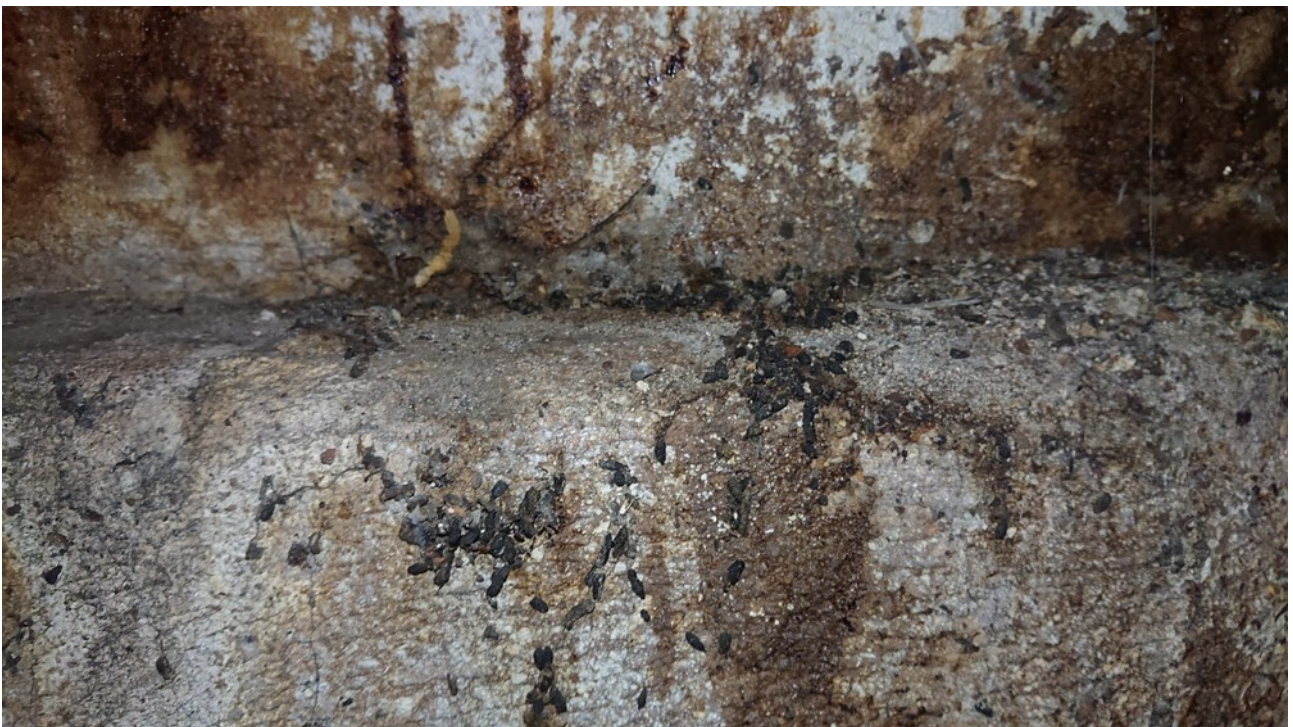
Kuva 6-1. Lepakoiden papanoita päärakennuksen vintin piipun tyvellä.
