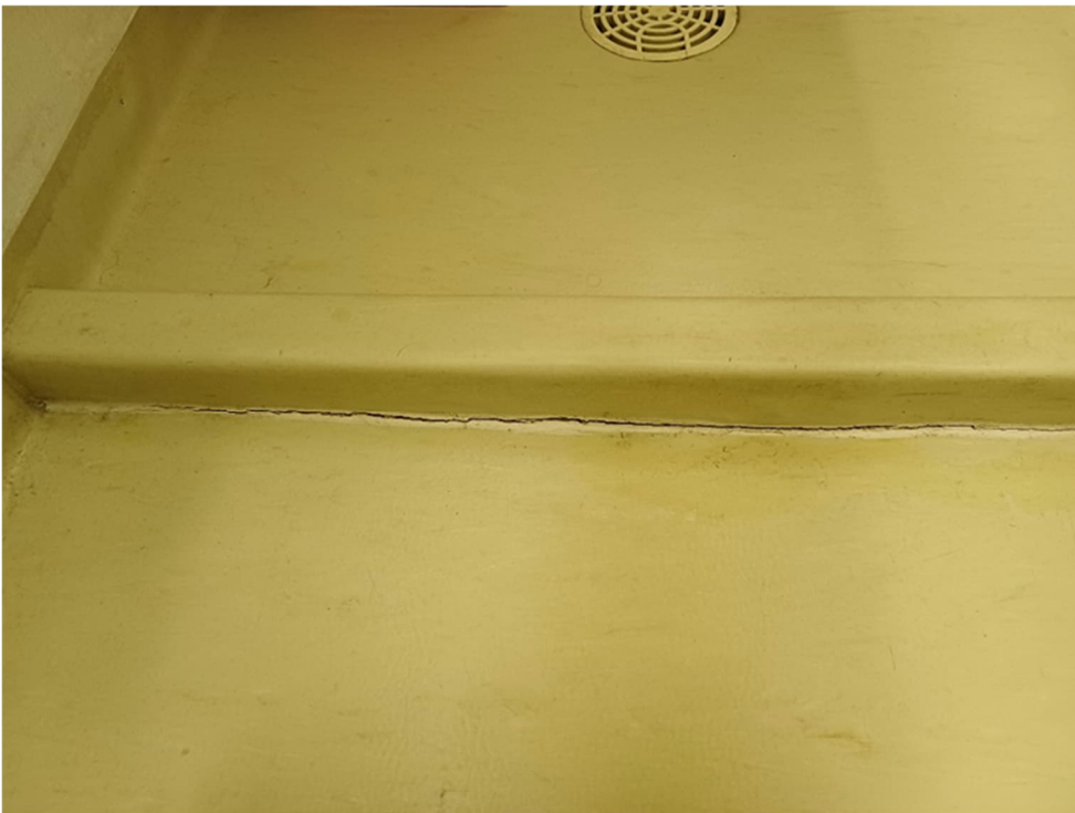
Kuva 4.1. 01 wc-tila lattiapinnoitteen hitsaussauma on auennut.
