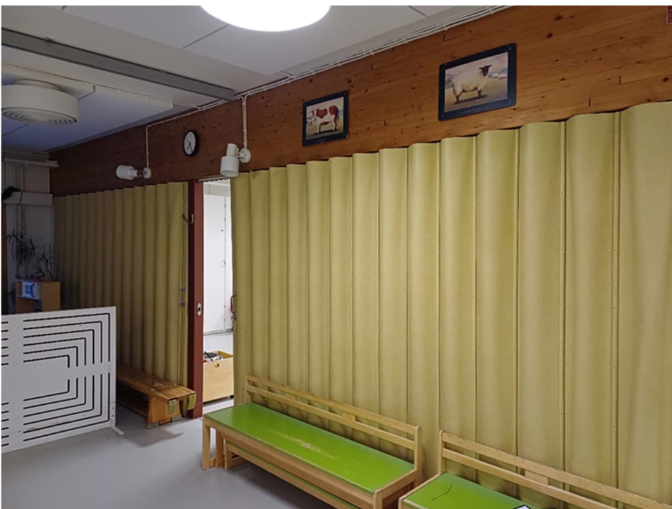
Kuva 4.5. Päiväkodin tiloissa on useita vanhoja vinyylipintaisia paljeovia, jotka saattavat heikentää sisäilman laatua.
