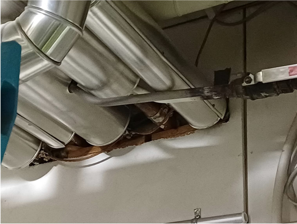
Kuva 4.2. 02 tekninen tila läpiviennit viereisiin tiloihin ei ole tiiviitä.
