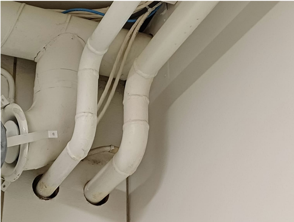
Kuva 4.3. 19 aula vesijohtojen läpiviennit ei ole tiiviitä.
