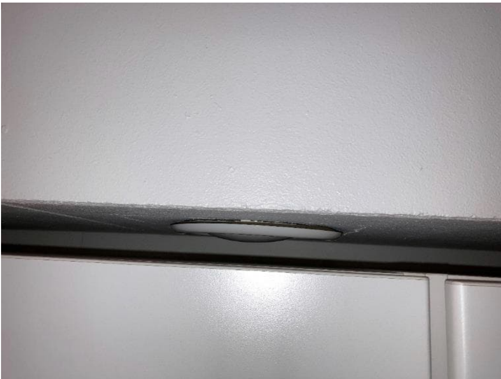
Kuva 5.5. Poistoilmaventtiileihin ei pääsyä, koska kaappi on asennettu liian lähelle kattoa.
