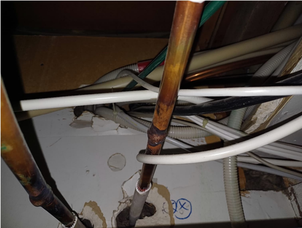
Kuva 4.6. Alakattojen yläpuoliset läpiviennit ei ole tiiviitä.
