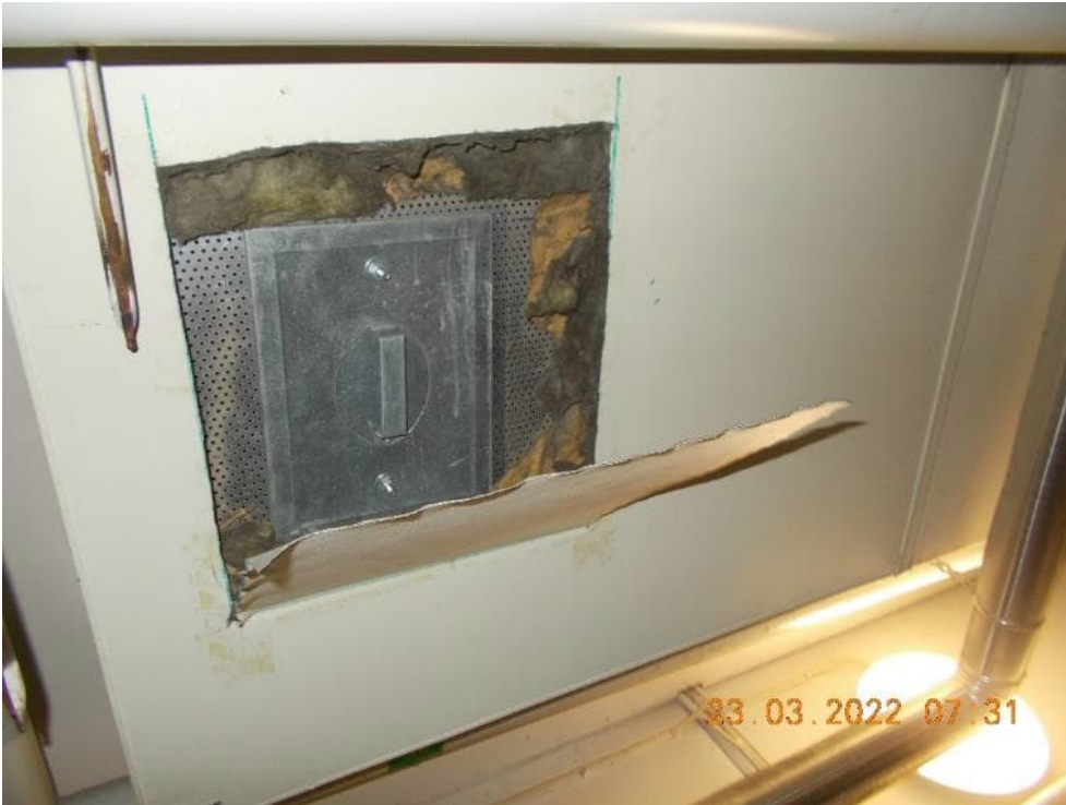
Kuva 5.2. Lämmönjakohuoneen eristetyin kanavan reikäpeltiä ja vuorivillaa.
