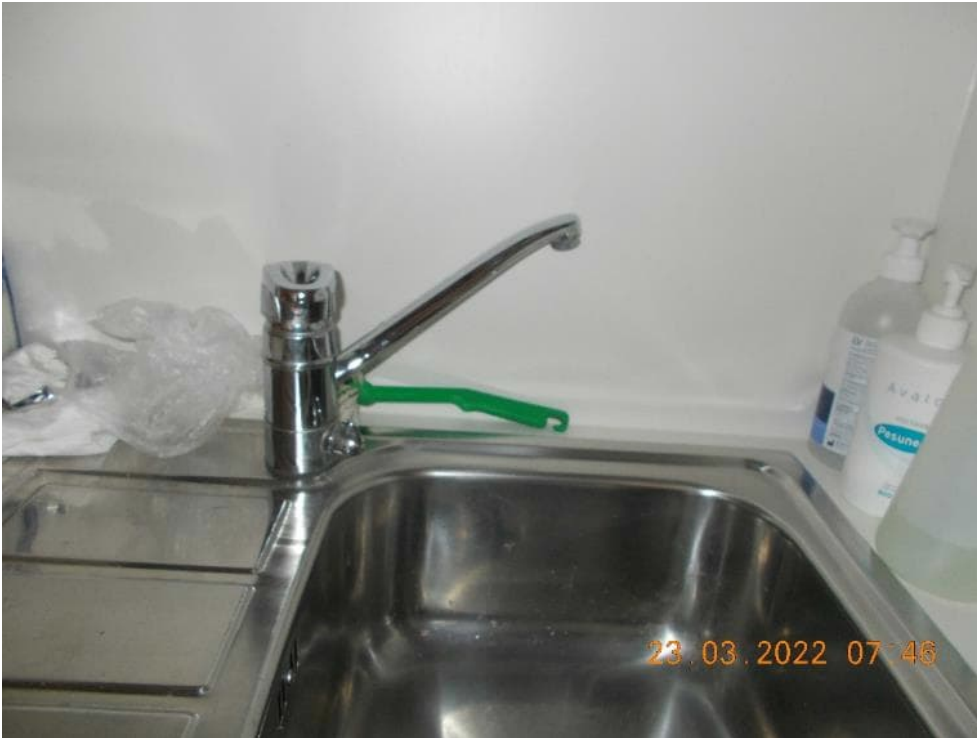
Kuva 5.4. Useasta allashanasta puuttuu sivuliikerajoitin.
