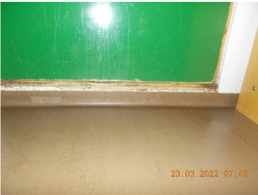
Kuva 5.3. WC tilan ovirako puuttuu.
