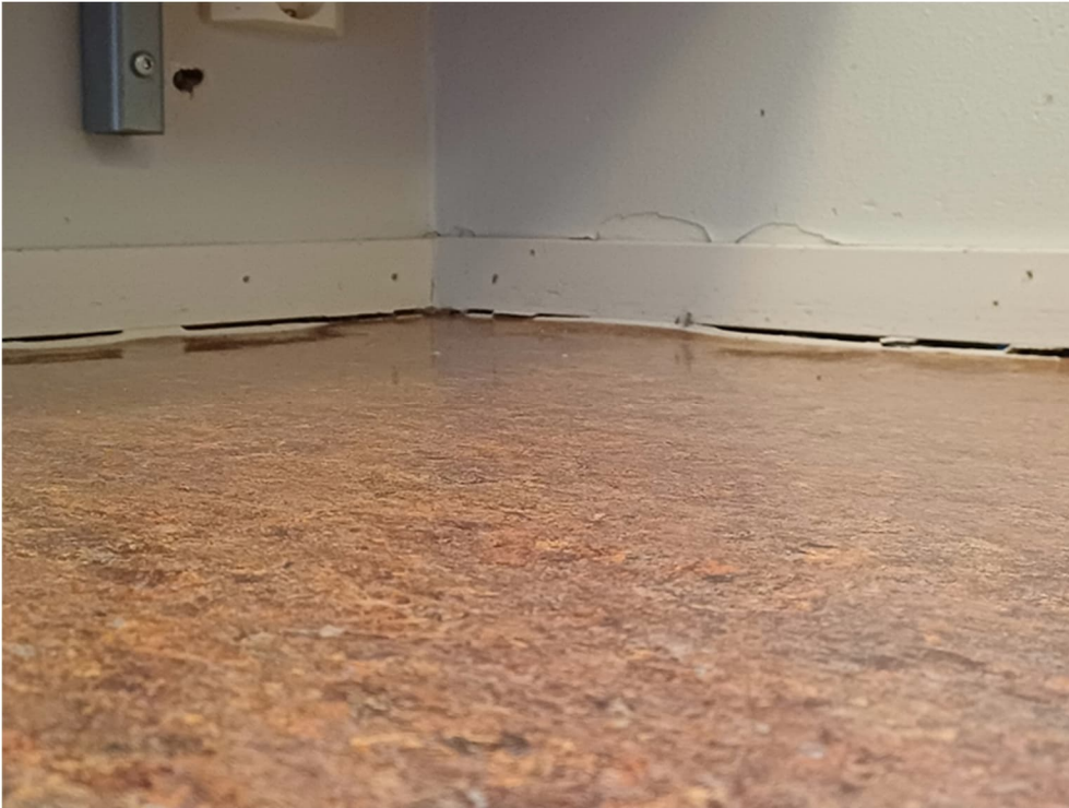
Kuva 4.3. 120 pienryhmähuone, lattia on painunut alas nurkan kohdalla.
