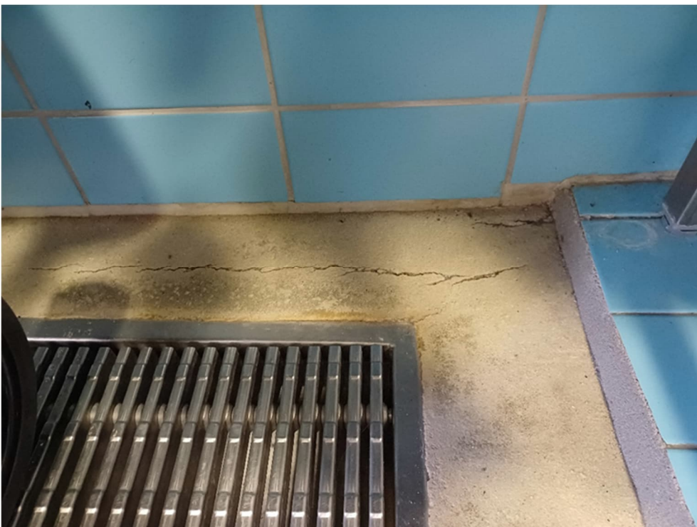
Kuva 4.2. 118 kuraeteinen, lattiapinnoite halkeilee hiekanerotuskaivon vieressä.
