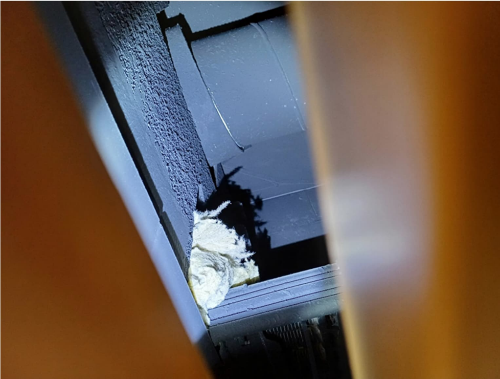
Kuva 4.9. Alakattojen yläpuolisissa läpivientien tiivistyksissä on käytetty mineraalivillaa.
