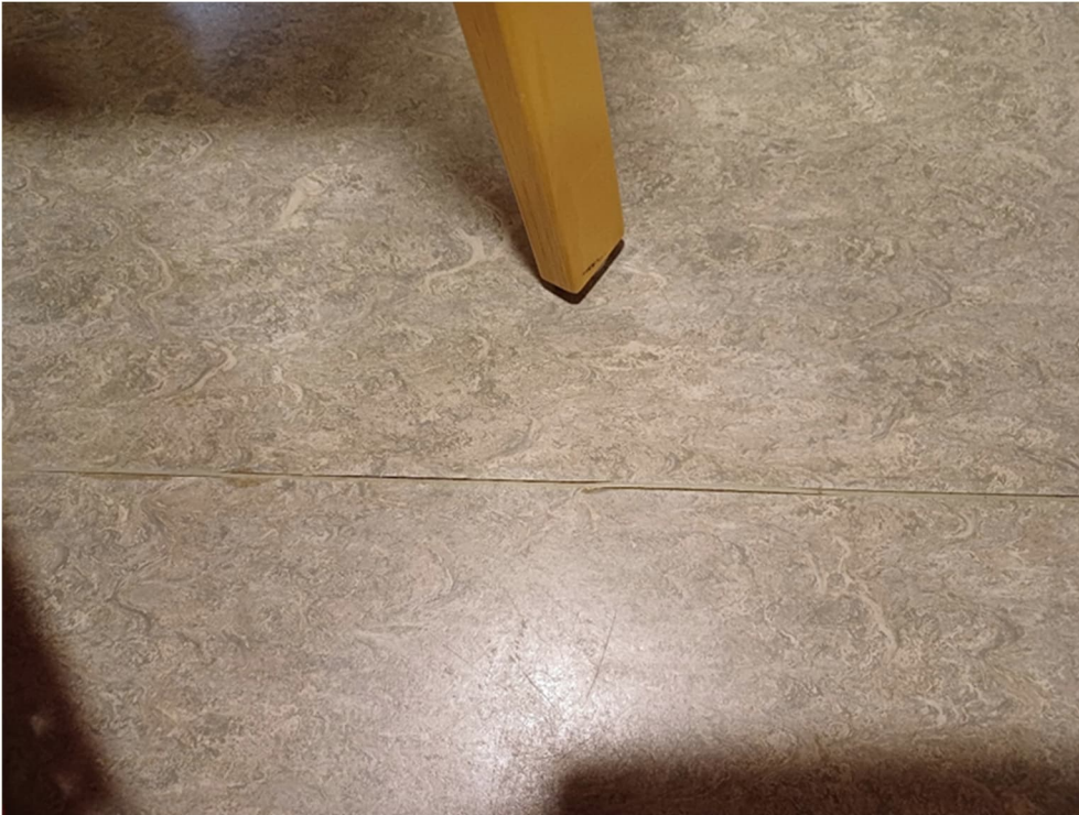
Kuva 4.7. Käytävätiloissa on osa lattiapinnoitteen hitsaussaumoista auennut.
