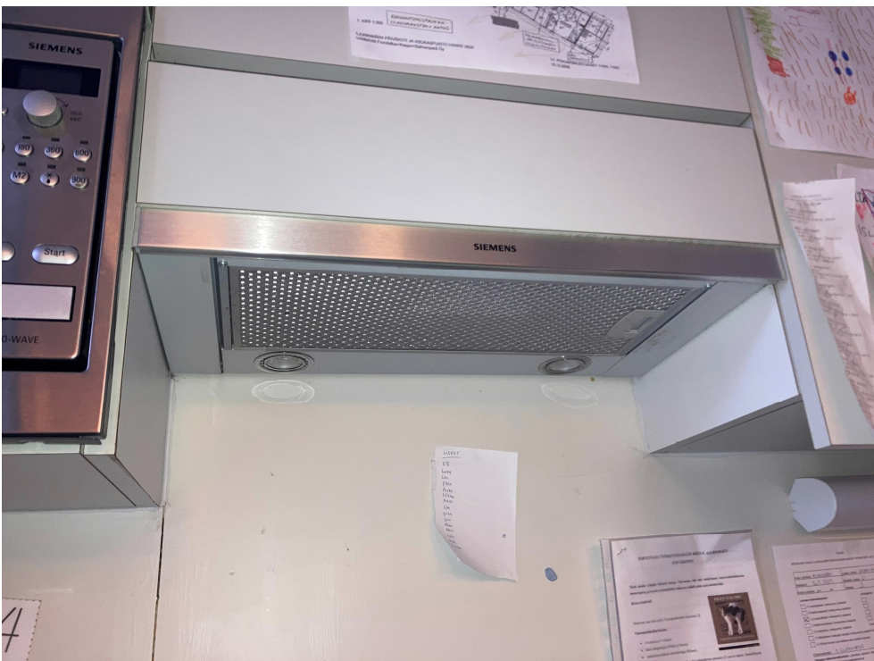
Kuva 5.3. 144 Apukeittiön rasvasuodatinverkko pölyyntynyt.
