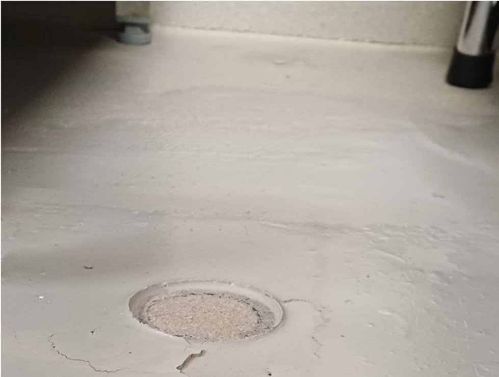
Kuva 4.5. 135 keittiö, lattiapinnoite on osittain uusittu, uusi lattiapinnoite irtoilee paikoittain.
