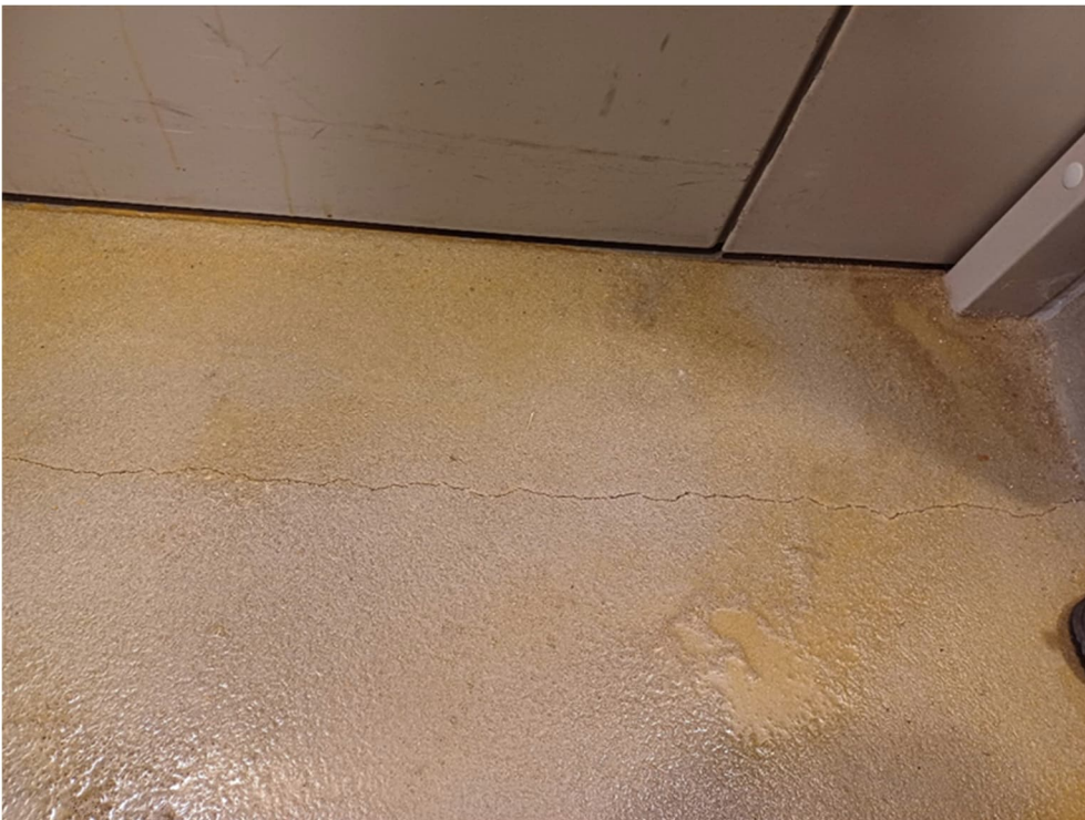
Kuva 4.6. 136 keittiön tuulikaappi, lattiapinnoite on ratkennut ulko-oven edestä.
