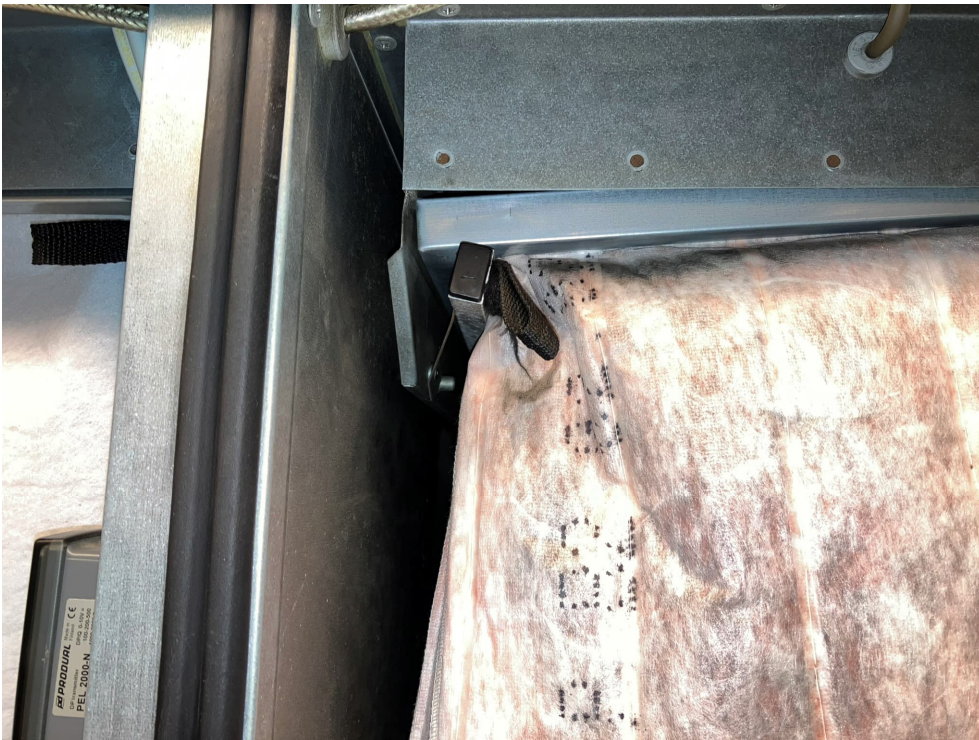
Kuva 5.1. Ilmanvaihtokoneen TK4 tuloilmasuodattimen kiinnike rikki.
