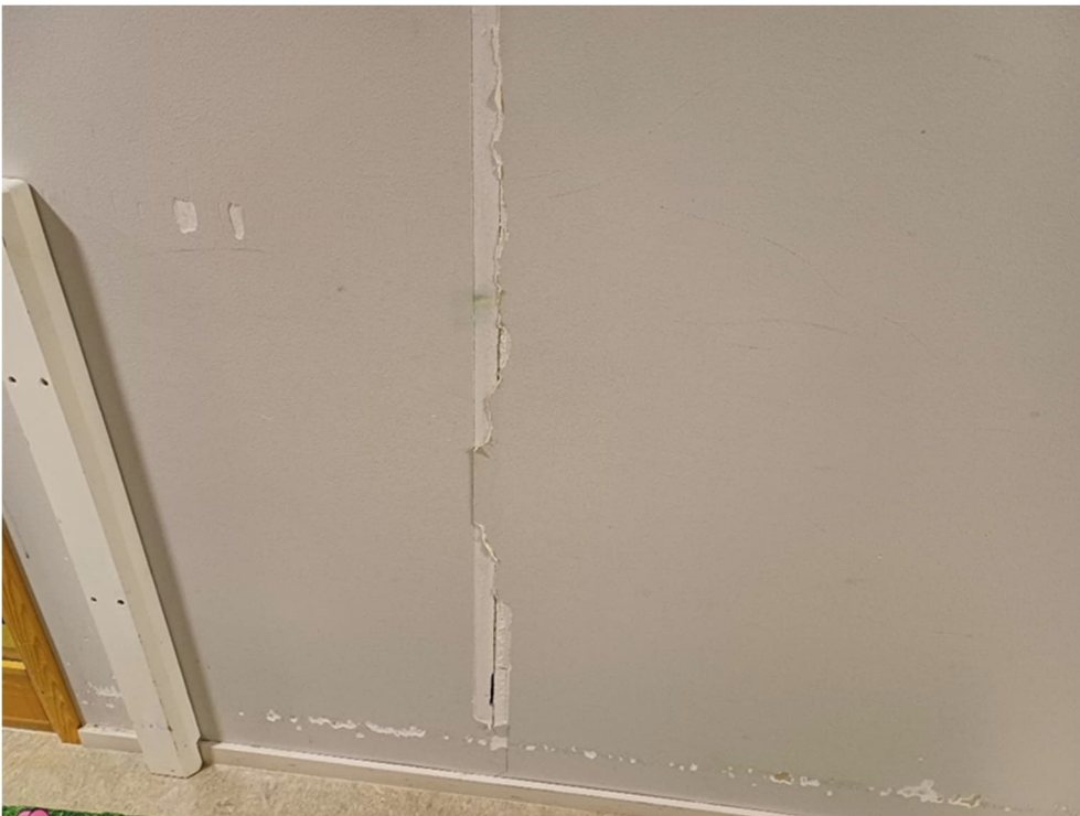
Kuva 4.4. 124 käytävä, seinälevytyksessä ratkeama liikuntasauman kohdalla.
