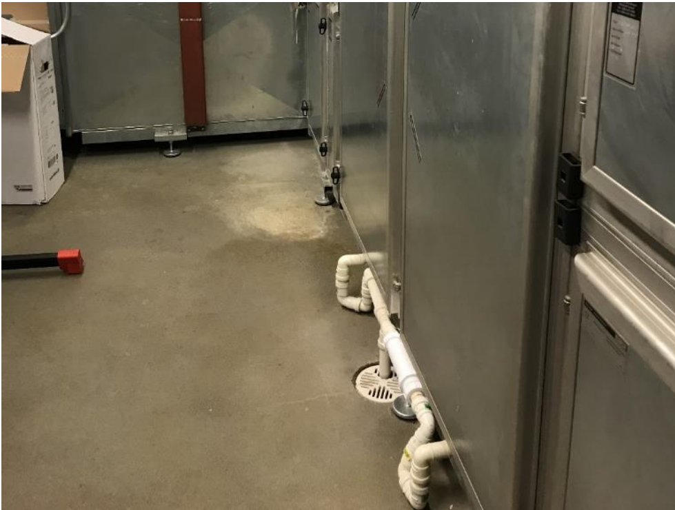
Kuva 5.1. Ilmanvaihtokoneen viemäroinnin haarasta puuttuu takaimusuoja.
