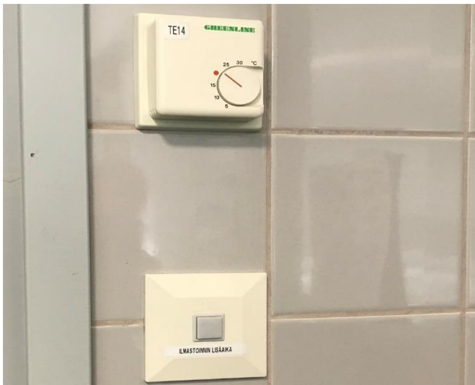
Kuva 6.2. Lattialämmityksen termostaatti ja ilmastoinnin lisäaikakytkin.
