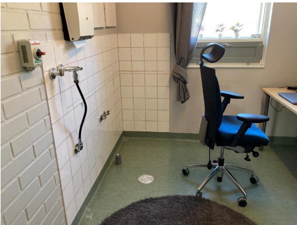
Kuva 5.9. Kodinhoitohuone 14 otettu toimistokäyttöön, huoneessa on lattiakaivo, mikä tulee muistaa täyttää.
