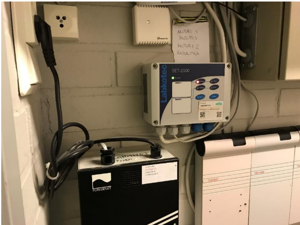
Kuva 5.11. Rasvanerotuskaivon padotusanturissa on hälytys päällä.
