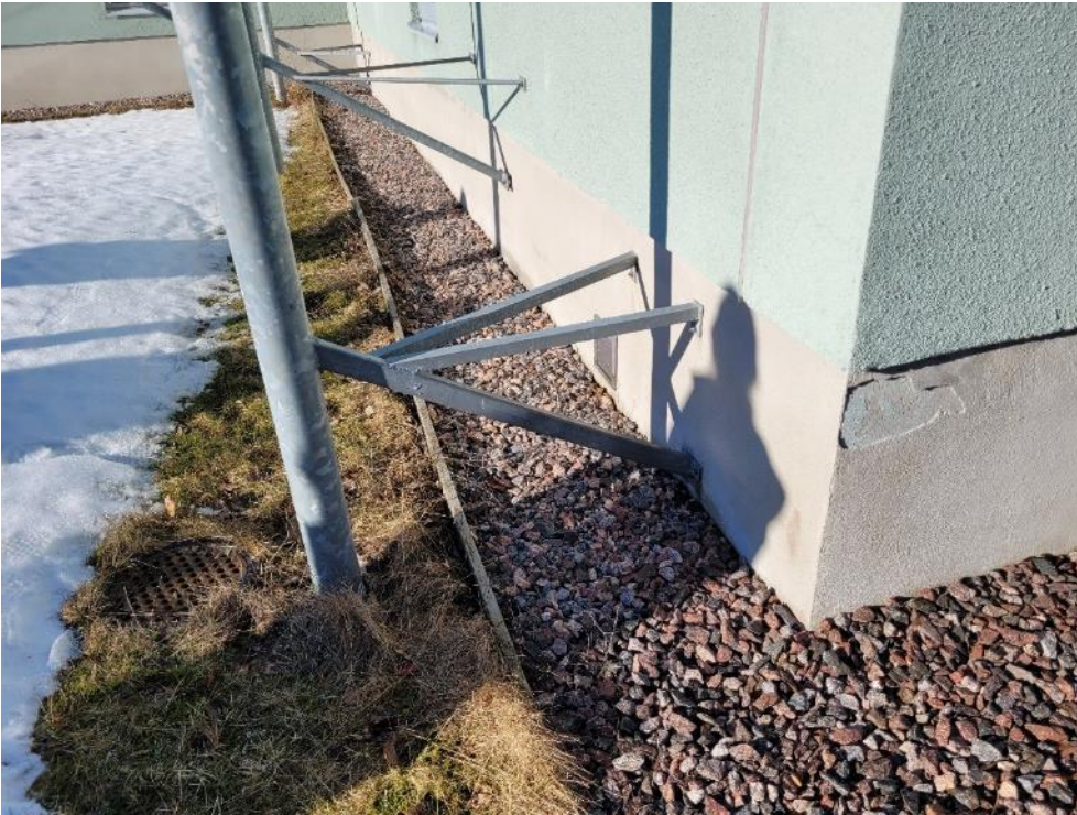
Kuva 4.13. Sokkelissa (tilan 38 kohdalla) on rappausvaurio.
