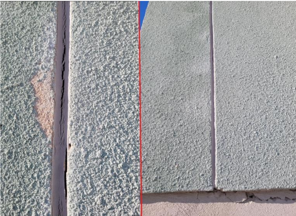
Kuva 4.14. Elementtisaumoja on uusimisen tarpeessa. (Kuva ulkonurkalta tilan 20 kohdalla).
