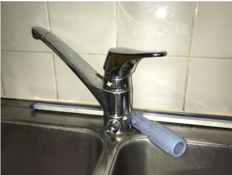
Kuva 5.7. Sivuliikerajoittimia puuttuu muutamista pesuallashanoista.
