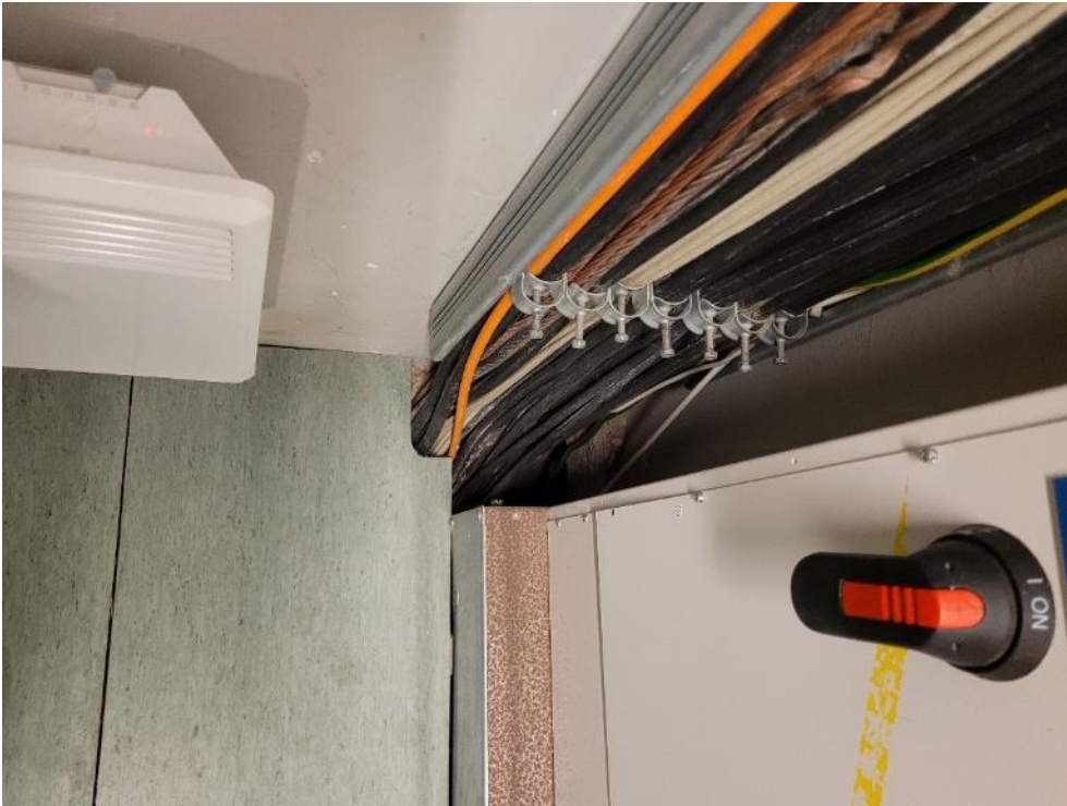
Kuva 4.11. Sähköpääkeskuksessa 31 on läpivientejä alapohjaan auki.
