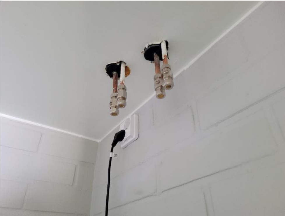
Kuva 4.7. Tilassa 23 on tiivistämättömiä läpivientejä.
