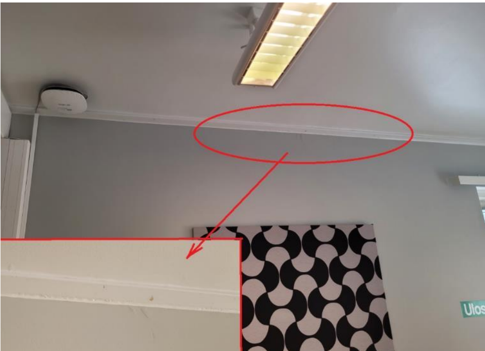
Kuva 4.8. Tilassa 38 seinä-kattorajassa on maalikuplia ja tahmainen sauma.
