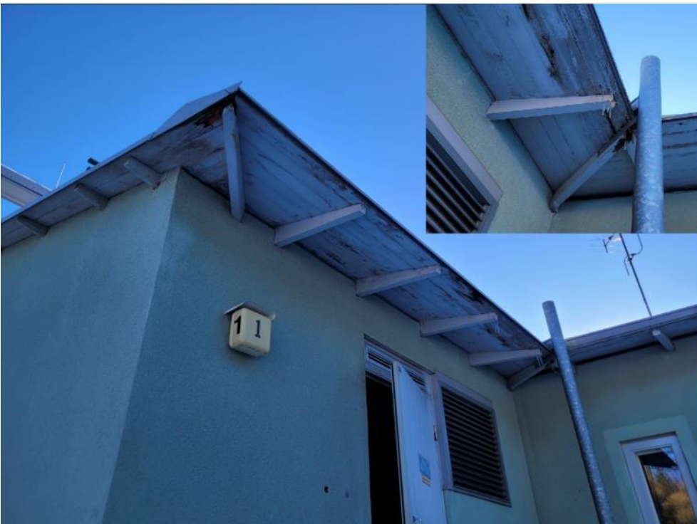
Kuva 4.16. Räystäslaudoituksessa on lahovauriota. (Kuva teknisten tilojen edustalta).
