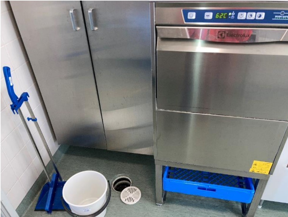
Kuva 5.8. Keittiön 22 pesuallas on siivouskaapin sisällä ja lattiakaivo on kuivana kaapin edessä.
