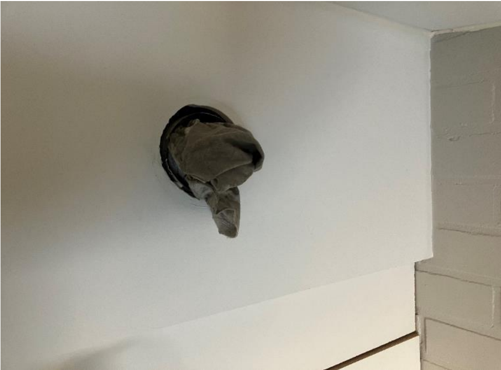
Kuva 5.2. Poistoilmanvaihtokanavaan on työnnetty t-paita huoneessa 13.
