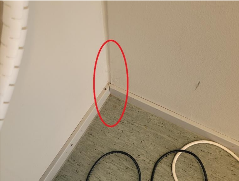
Kuva 4.9. Tilan 38 ulkoseinänurkassa pintakosteusmittari näyttää kohonnutta vertailukosteusarvoa.
