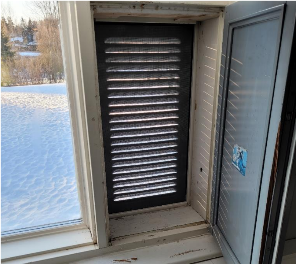
Kuva 4.5. Tilassa 19 tuuletusikkunalla on vesivuotojälkiä.
