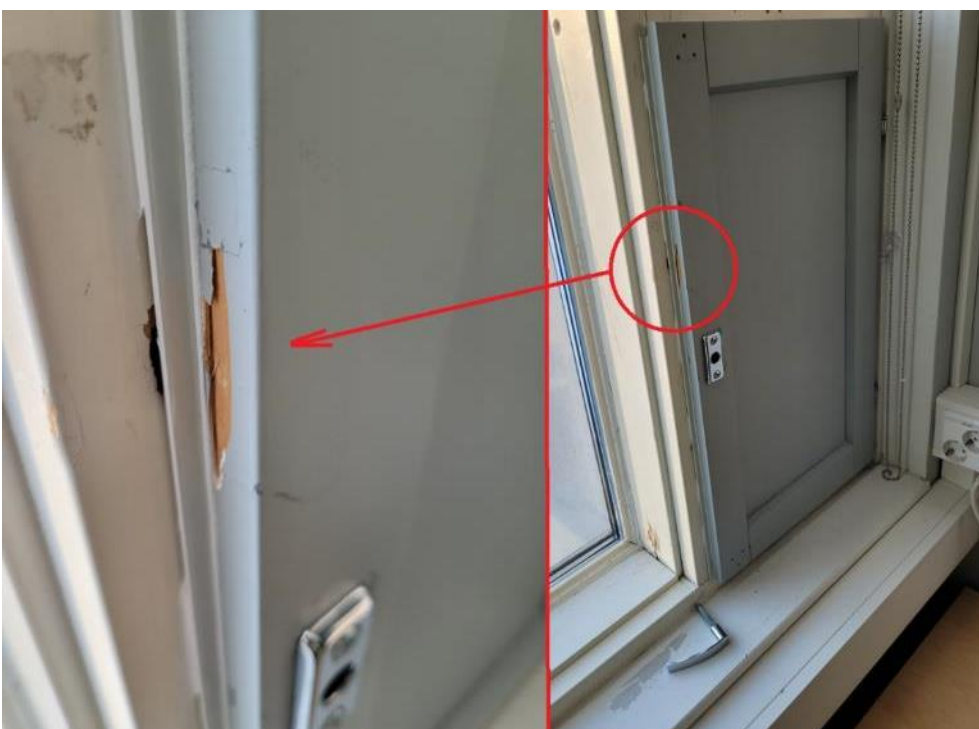
Kuva 4.6. Tilan 20 tuuletusikkunalla on ilmavuoto, ja avausmekanismi ei toimi kunnolla.
