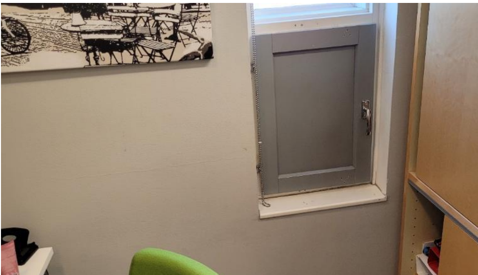
Kuva 4.2. Tilassa 01 tuuletusikkunaluukun alareunassa on ilmavuotoa.
