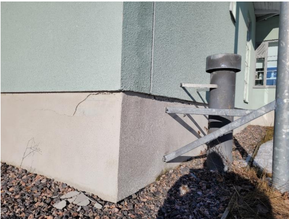
Kuva 4.12. Sokkelissa (tilan 20 kohdalla) on rappausvaurio.
