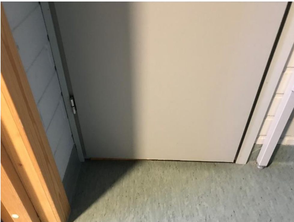
Kuva 5.5. Korvausilmareitit puutteelliset muutamassa tilassa.
