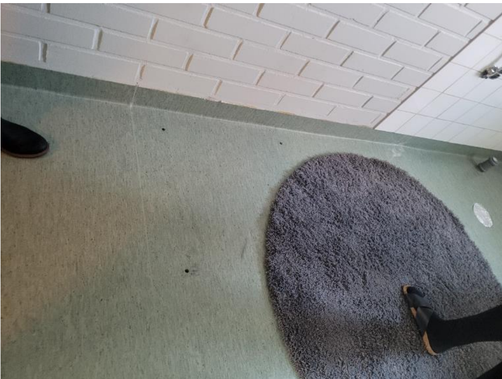
Kuva 4.4. Tilassa 14 lattiassa on paikkaamattomia asennusreikiä.
