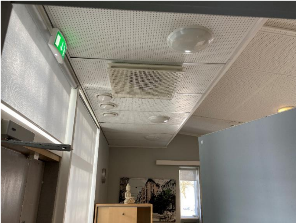
Kuva 5.4. Työhuoneen 01 tuloilma ei ole suunnattu oikein, tuloilma ei huuhtelee koko tilaa.
