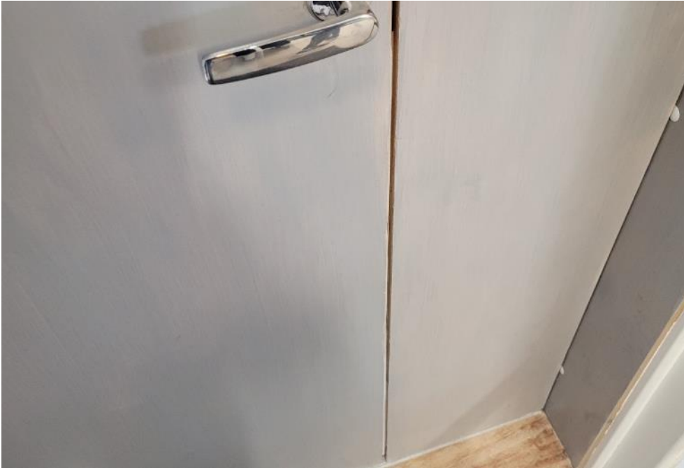
Kuva 4.1. Tilan 01 ulko-ovivälissä on ilmavuotoa.
