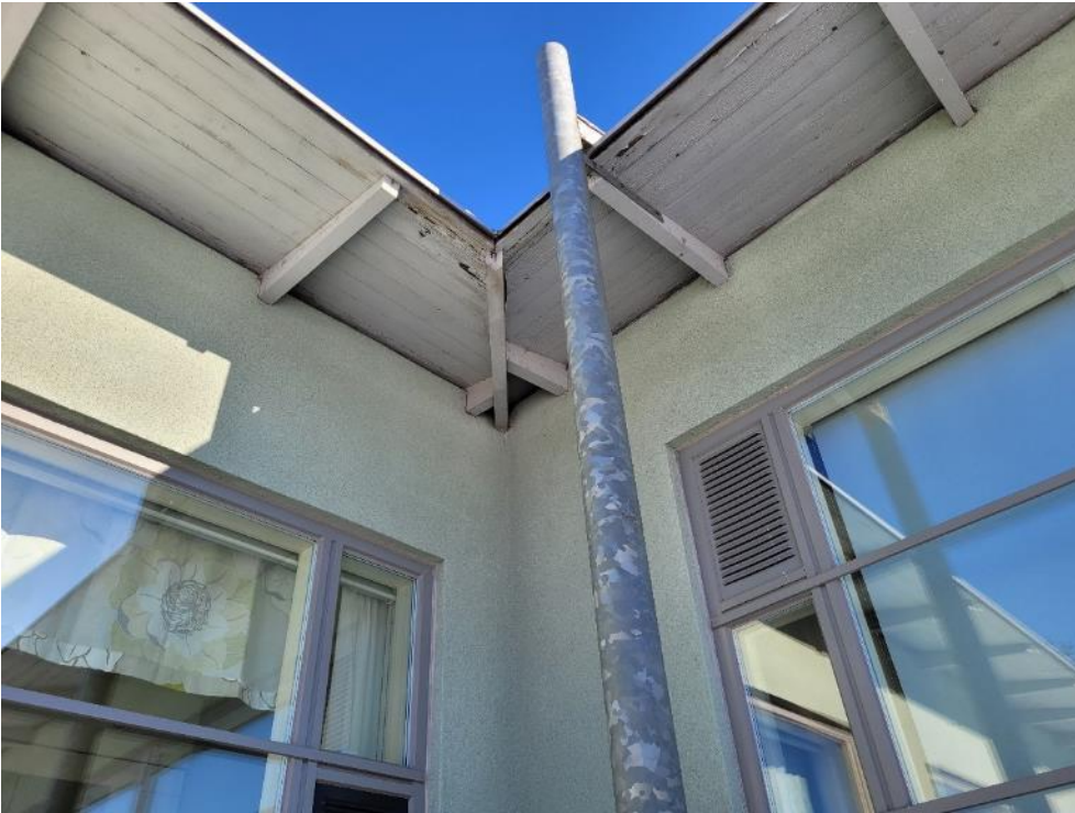
Kuva 4.15. Räystäslaudoituksessa on lahovauriota. (Kuva tilojen 13 ja 17 kulmakohdasta).
