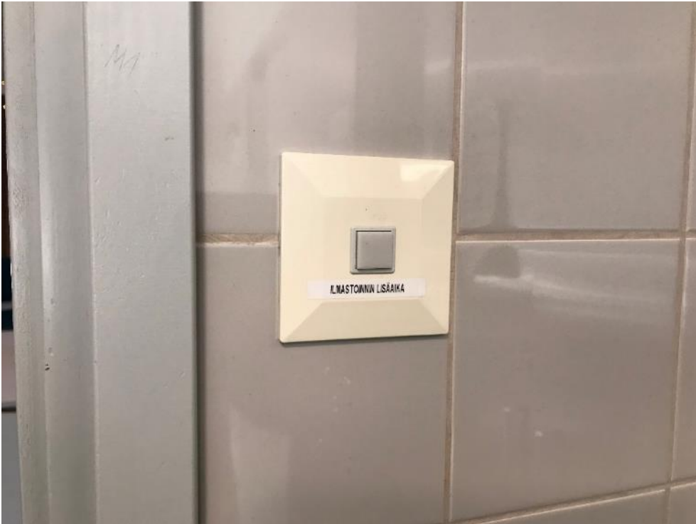
Kuva 5.6. Keittiössä sijaitsevan ilmanvaihdon lisäaikakytkimen toiminta on epäselvä.
