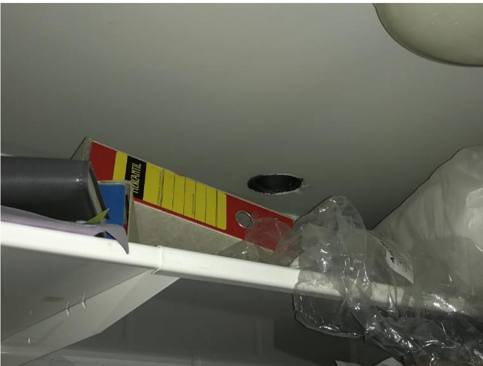
Kuva 5.3. Kodinhoitohuoneessa 14 sijaitsevasta varastosta 09 puuttuu poistoilmaventtiili.
