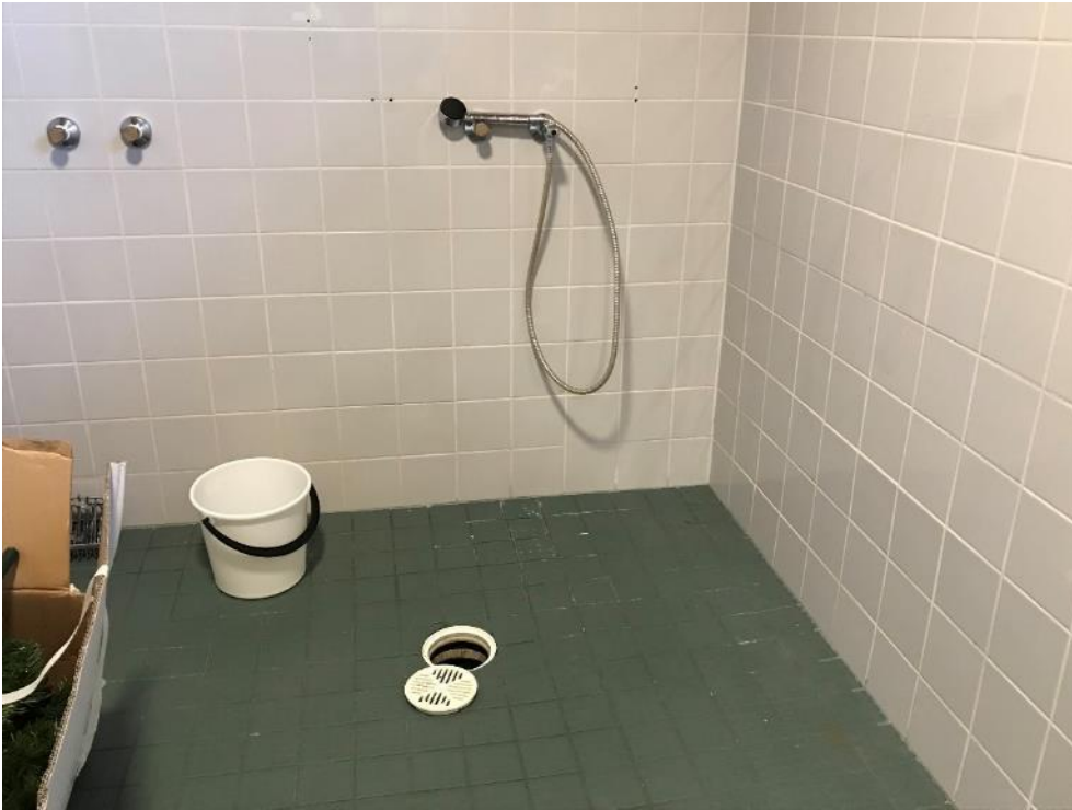
Kuva 5.10. Saunan pesuhuoneen 03 lattiakaivon nielu on irti.
