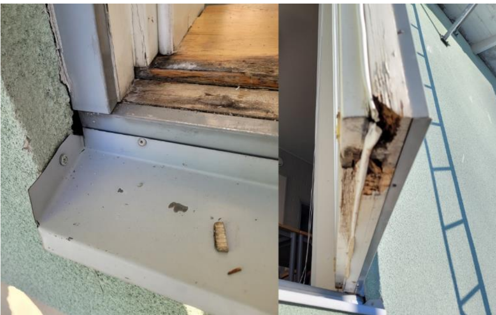
Kuva 4.10. Tilasta 38 ulos johtavan varatien ovilehden alareuna sekä kynnys ovat lahovaurioituneet.
