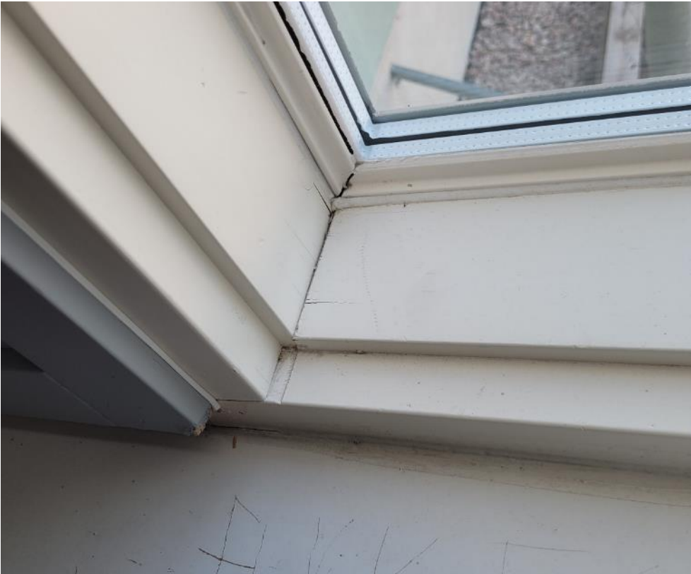
Kuva 4.3. Tilassa 13 on ilmavuotoa ikkunapuitteen kulmassa.
