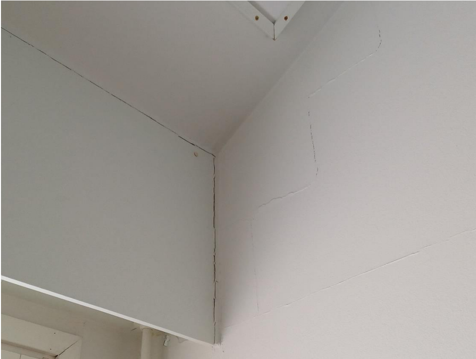
Kuva 4.3. Muuratuissa väliseinissä on halkeamia useissa tiloissa.
