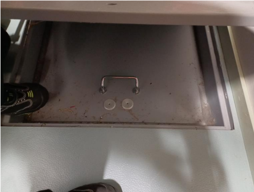
Kuva 4.1. Alapohjan kulkuluukut ei ole kaasutiiviitä.
