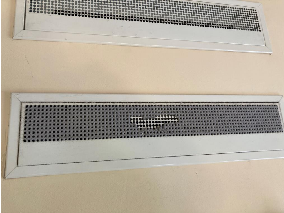
Kuva 5.1. Ilmanvaihdon poistoilmapäätelaitteet Fläkt Woods SVE keräävät pölyä päätelaitteen pintaan. Alempi on poistoilma ja ylempi tuloilman päätelaite.
