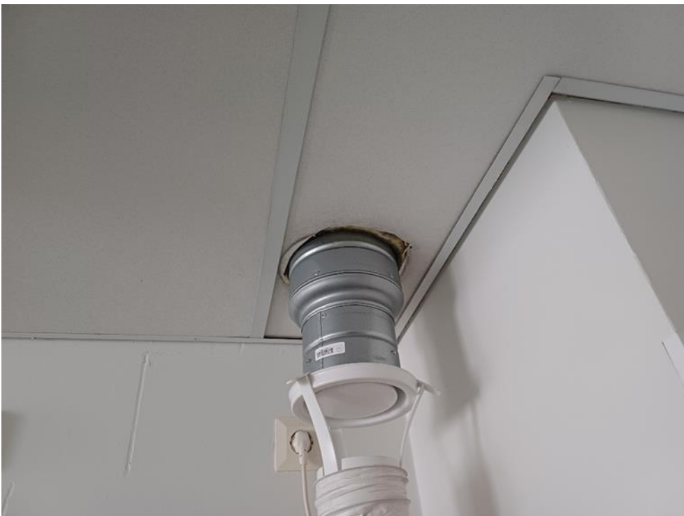
Kuva 4.2. Tila 11 poistoilmakanavan kaulus alakatosta puuttuu.
