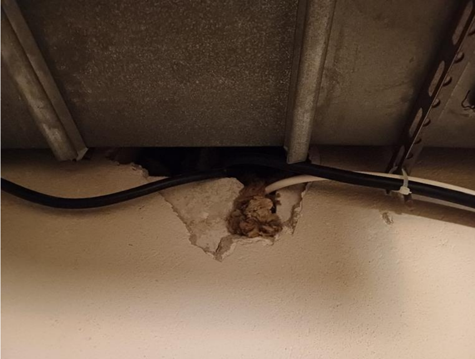
Kuva 4.2. 002 Sähköpääkeskuksen läpivientejä ja vanhoja putkenpäitä on tiivistämättä.
