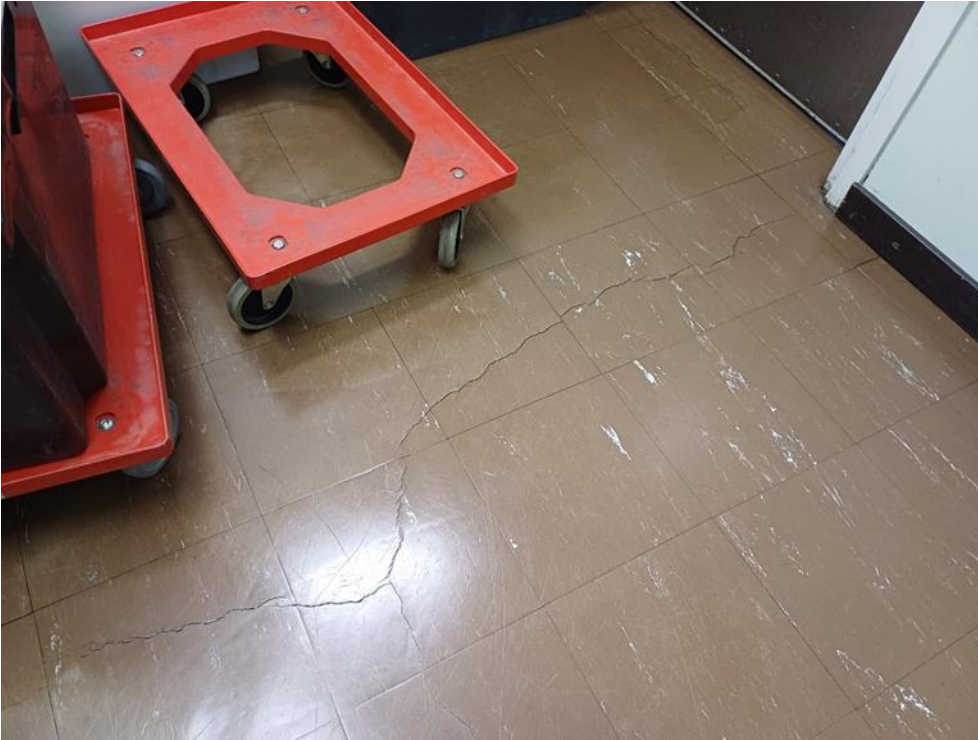
Kuva 4.4. 101 Eteisen lattialaattoja on halkeillut.
