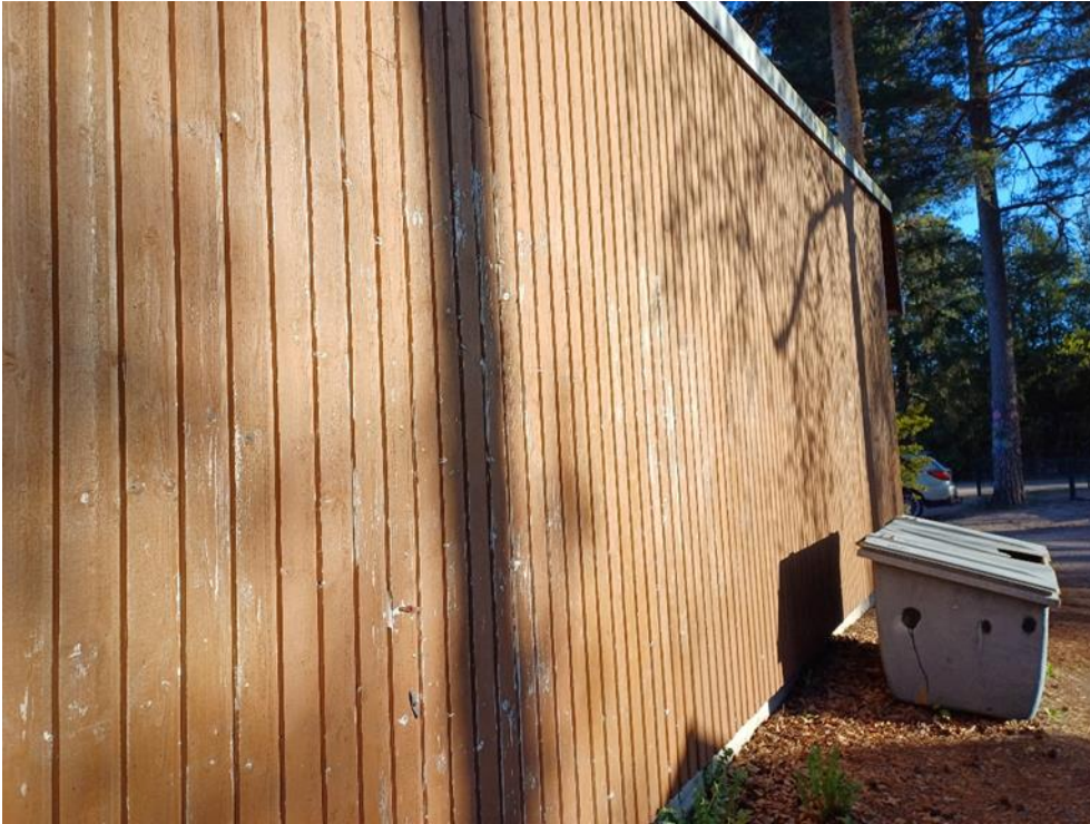
Kuva 4.8. Ulkopaneloinnin maalipinta hilseilee.
