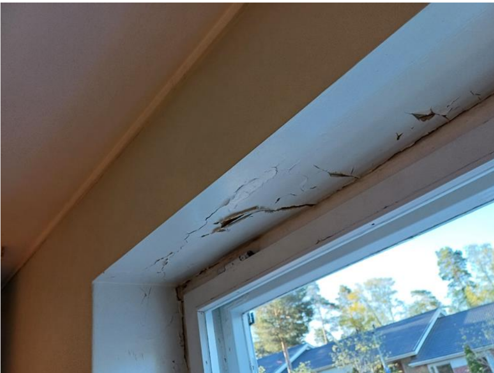
Kuva 4.5. 106 Nuorison osaston ikkunapielien pintarappaus irtoilee.
