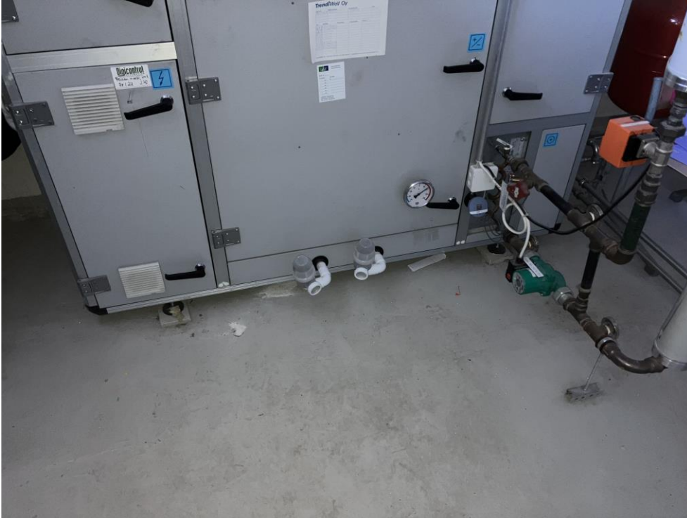
Kuva 5.1. Ilmanvaihtokoneen TK1/PK1 viemäröinti jäänyt kesken.
