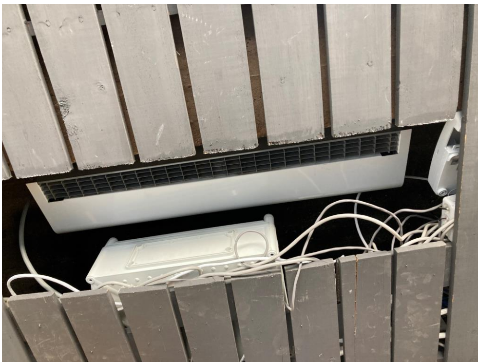
Kuva 6.2. Kirjaston pääoven oviverhopuhallin, joka käy aina.
