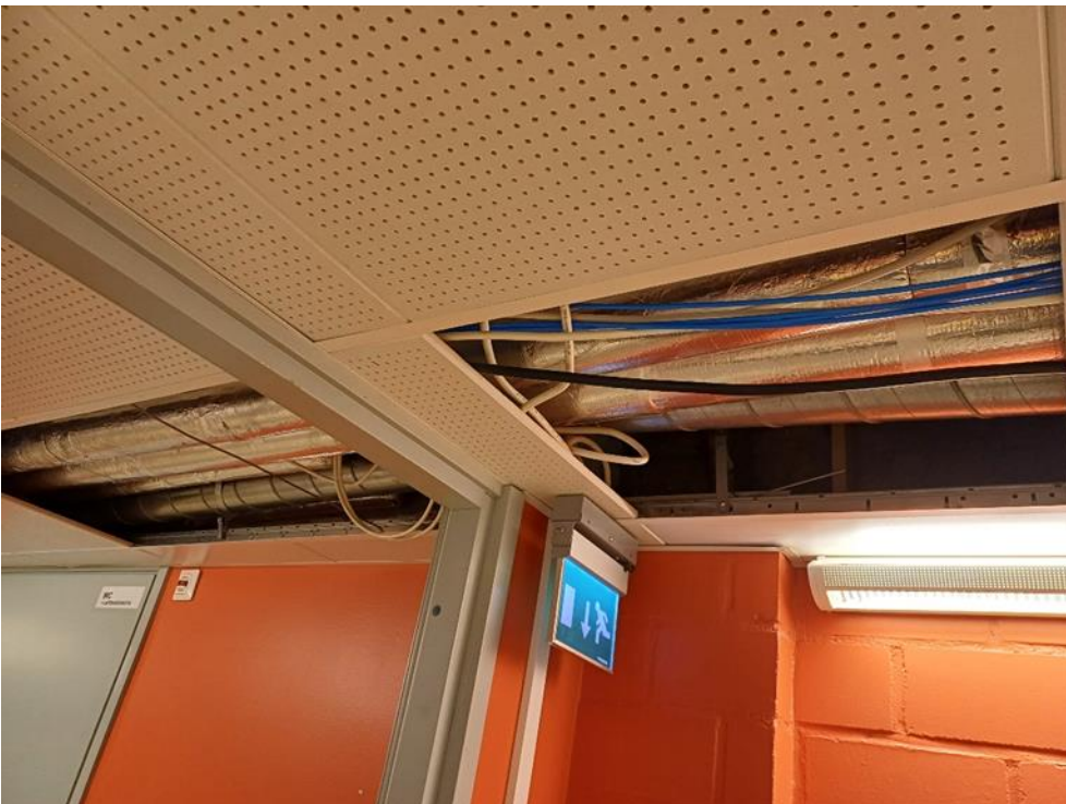
Kuva 4.3. 005 Käytävän alakattolevyjä puuttuu.
