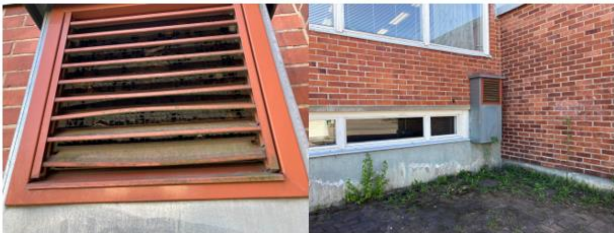
Kuva 5.4. Ilmanvaihdon raitisilmasäleikössä pieni määrä roskaa ja lehtiä.
