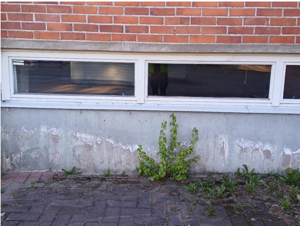
Kuva 4.9. Ulkosokkelissa on paikoittain rapautumia ja kalkkihärmettä.
