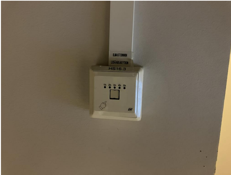
Kuva 5.3. Monitoimitilan 004 ilmanvaihdon lisäaikakytkin.
