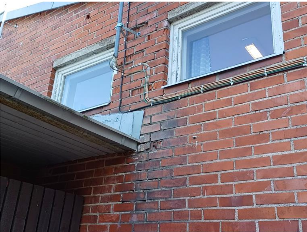
Kuva 4.7. Julkisivun tiilimuurauksessa on paikoitellen rapautumia.
