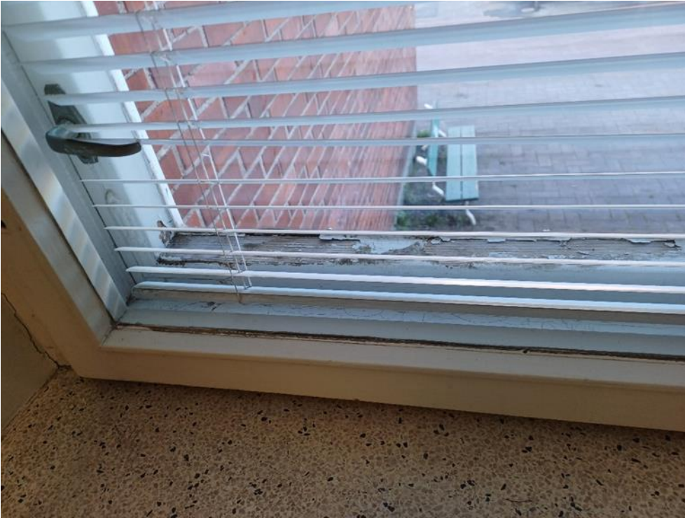
Kuva 4.6. Ikkunat ovat kauttaaltaan huollon tarpeessa.
