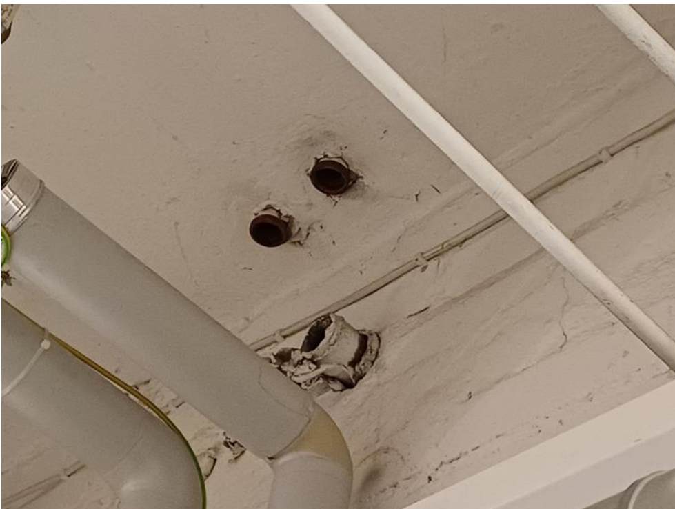
Kuva 4.1. 001 Lämmönjakohuoneen vanhoja putkenpäitä on tiivistämättä.
