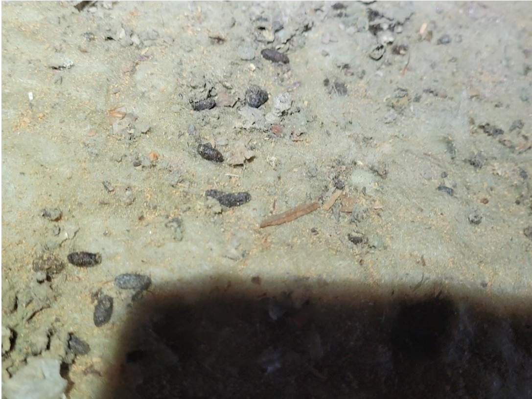
Kuva 6. Eristevillojen päällä oli hieman jyrsijöiden jätöksiä.
