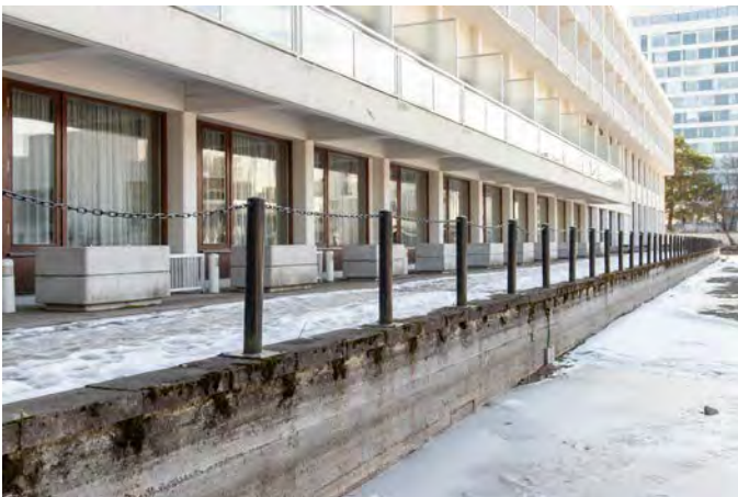
Hotellin edustalla altaan etelälaidalla altaan reunan muuri on tehty betonista ja siihen on kiinnitetty arkkitehtuuriin huonosti sopiva kaide.
