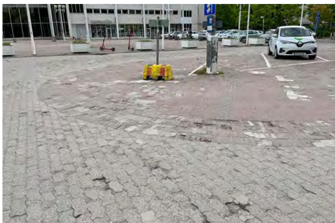
Aukion pinnoite on pääosin huonossa kunnossa.
