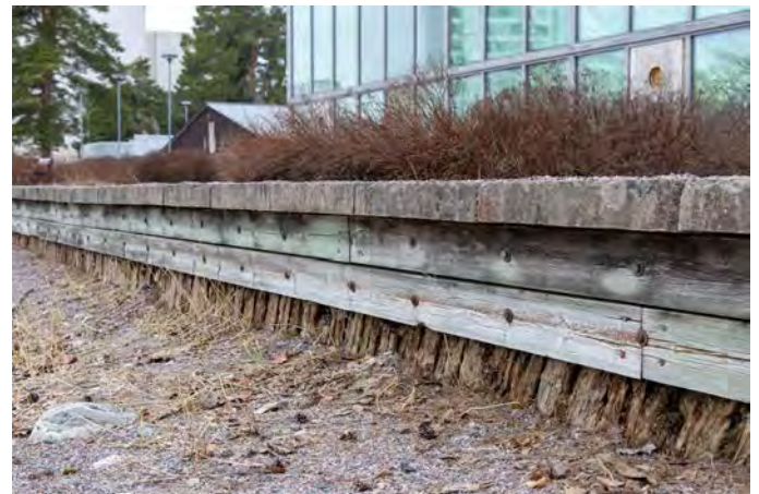
Altaan laidoilla, pois lukien etelälaita, reunan tukimuuri on puinen ja paikoin huonokuntoinen.
