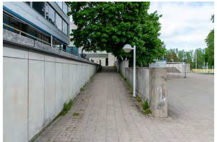
Aarne Ervin aukion pinnoite vaihdettiin betonikiveksi Kulttuurikeskuksen rakentamisen yhteydessä. Luiska nousee aukiolta Keskustornin sisäänkäyntitasolle. Muuri on paikoin huonokuntoinen, pinnoitteena käytetyt betonilaatat ovat lohkeilleet ja osa on irronnut.
