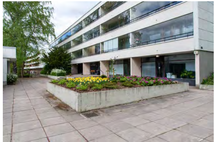
Aukion keskellä olevaa suurta betonista istutusallasta on korjailtu, eikä alkuperäinen lautamuottipinta näy selvästi.
