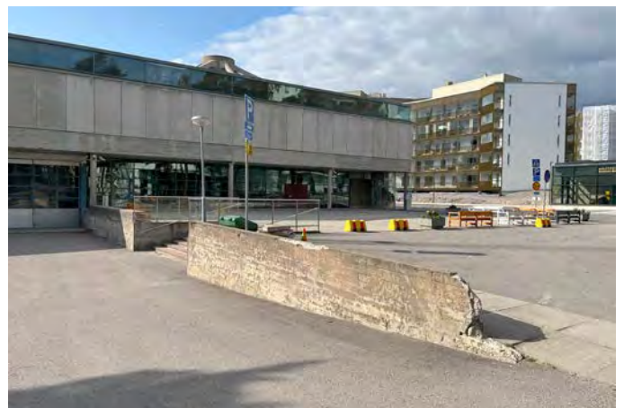
Vanha rapistunut lautamuottipintainen betonimuuri lastauspihan koillisreunalla.
