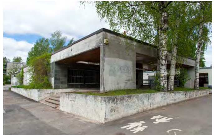
Louhentorin liikekeskus kaakosta Louhentien puolelta. Eteläinen rakennusosa on huonokuntoinen.
