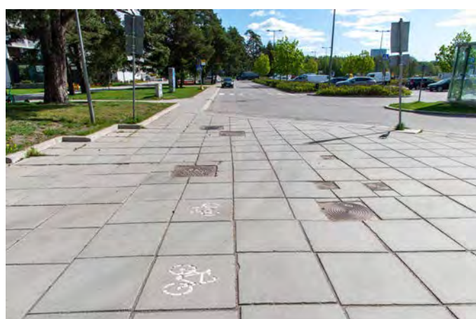
Laatoituksen muodostama rasteri on rikottu huolimattomasti esimerkiksi kaivonkansilla. Vasemmalla Tapiolalle epätyypillisesti reunakivillä rajattu kasvillisuusalue Tapionaukion pohjoispäässä.
