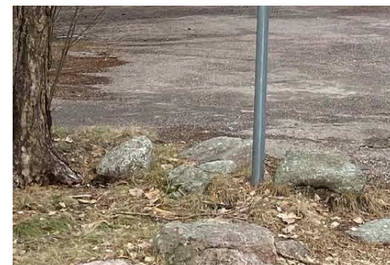
Murtuneet rajat asfalttialueiden reunoissa
