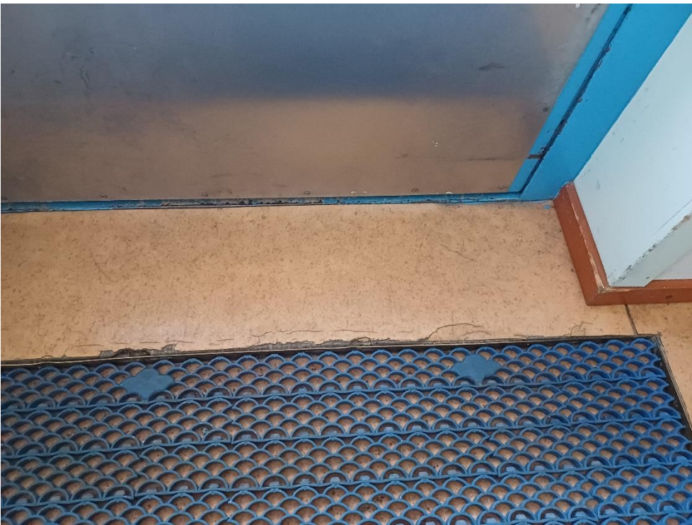
Kuva 4.3. 122 Tuulikaappi, lattiamatto halkeilee ulko-oven edestä.
