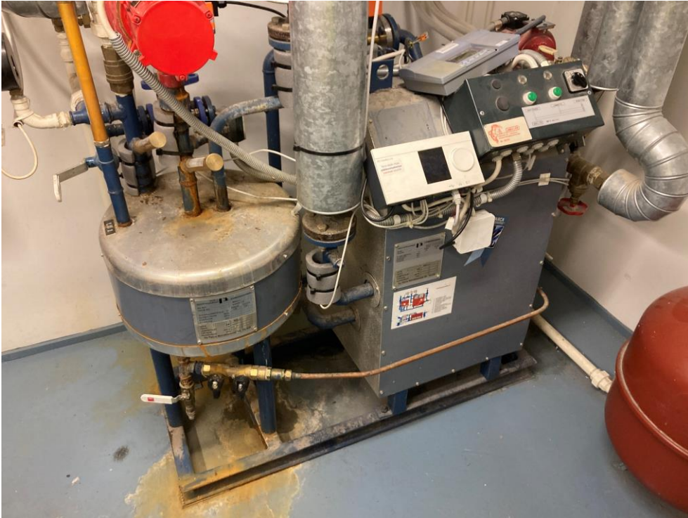
Kuva 5.2. Alkuperäinen lämmönsiirrinpaketti vuodelta 1985.
