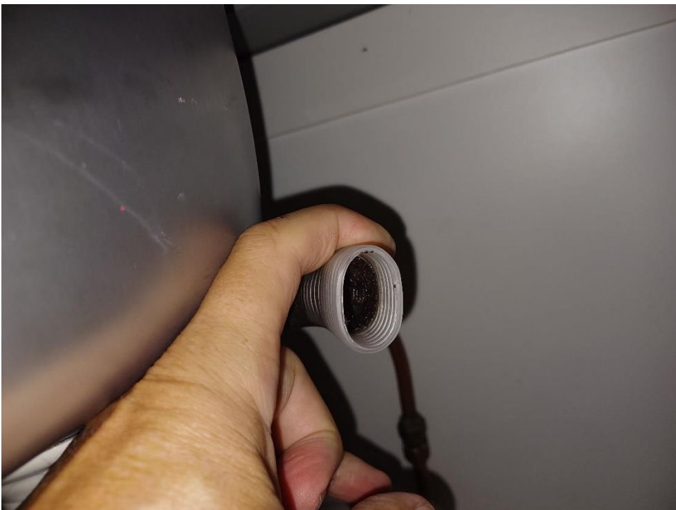
Kuva 5.3. Pesualtaiden ylivuotoputket keräävät lietettä, mikä voi aiheuttaa tunkkaista hajua.
