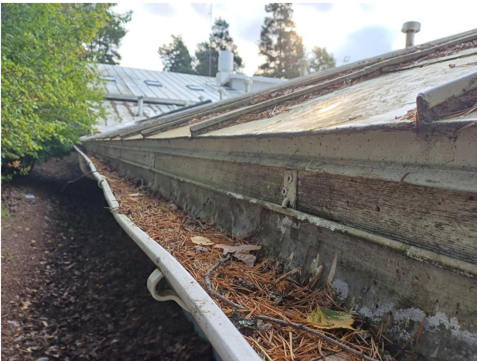
Kuva 4.7. Sadevesikouruihin on kertynyt paljon havunneulasia ja muuta roskaa.
