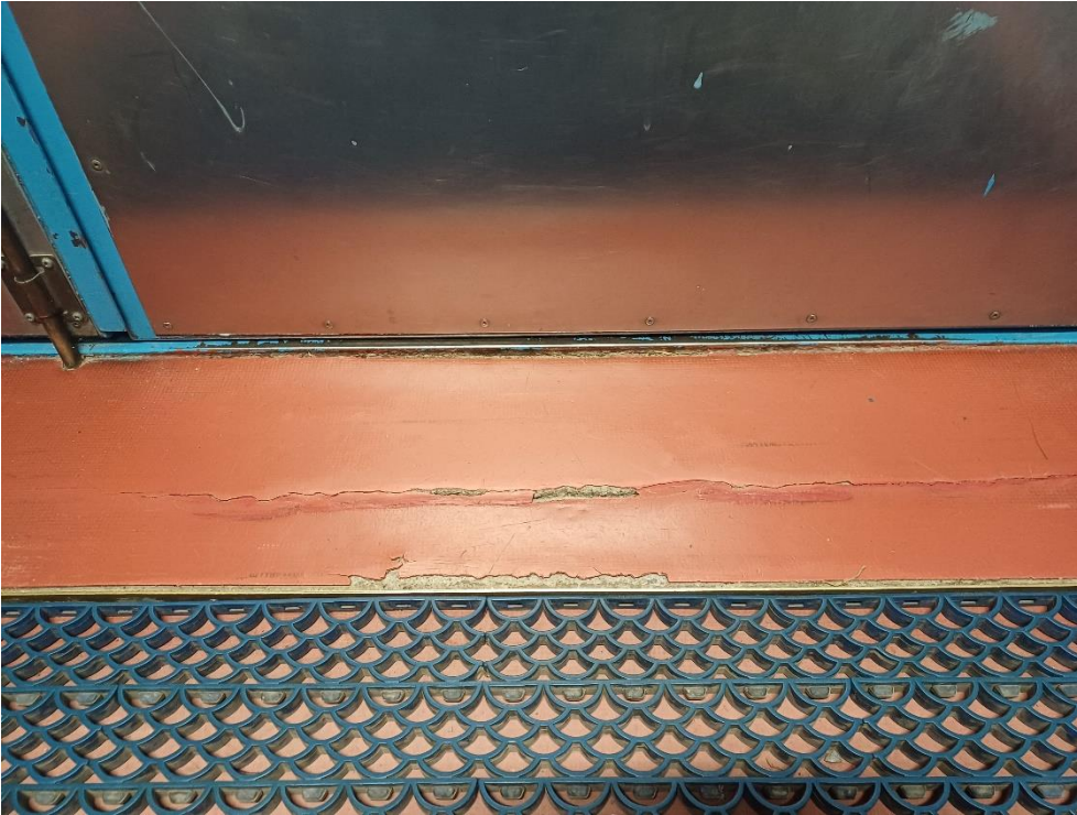
Kuva 4.2. Lattiamatto halkeilee ulko-oven edestä.
