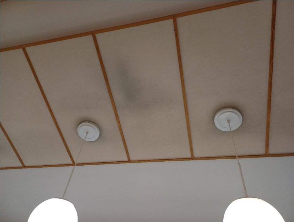
Kuva 4.4. Alakattoihin asennetuissa akustointilevyissä on useissa kohdissa ilmavuotojälkiä.
