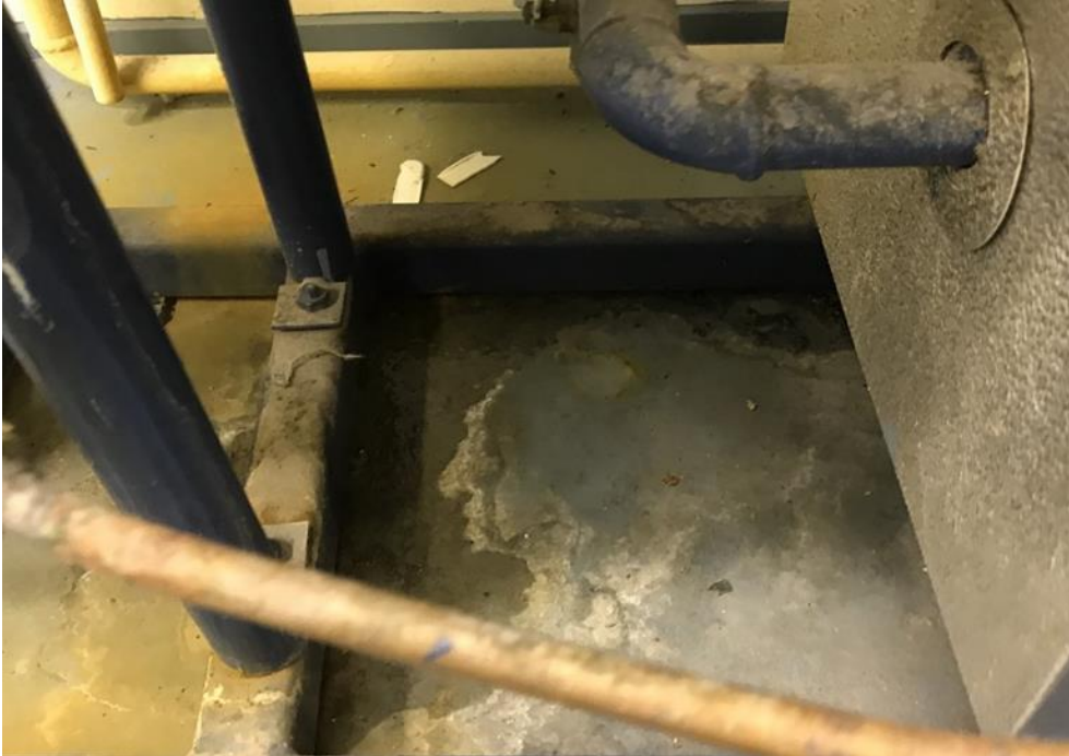
Kuva 6.1. Lämmönvaihdivpaketti vuotaa vettä.
