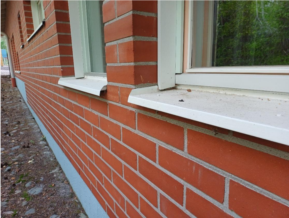
Kuva 4.6. Osa ikkunapeltien kaadoista ei ole riittäviä.
