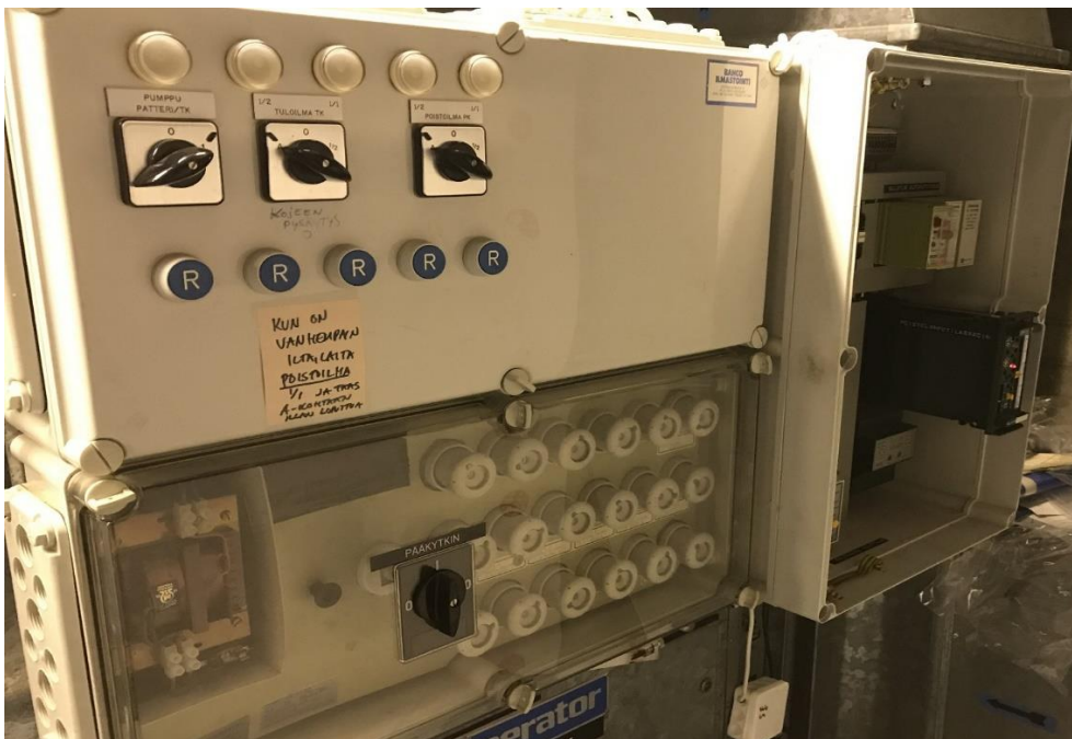
Kuva 6.2. Ilmanvaihtokoneen TK01/PK01 rakennusautomaatio.
