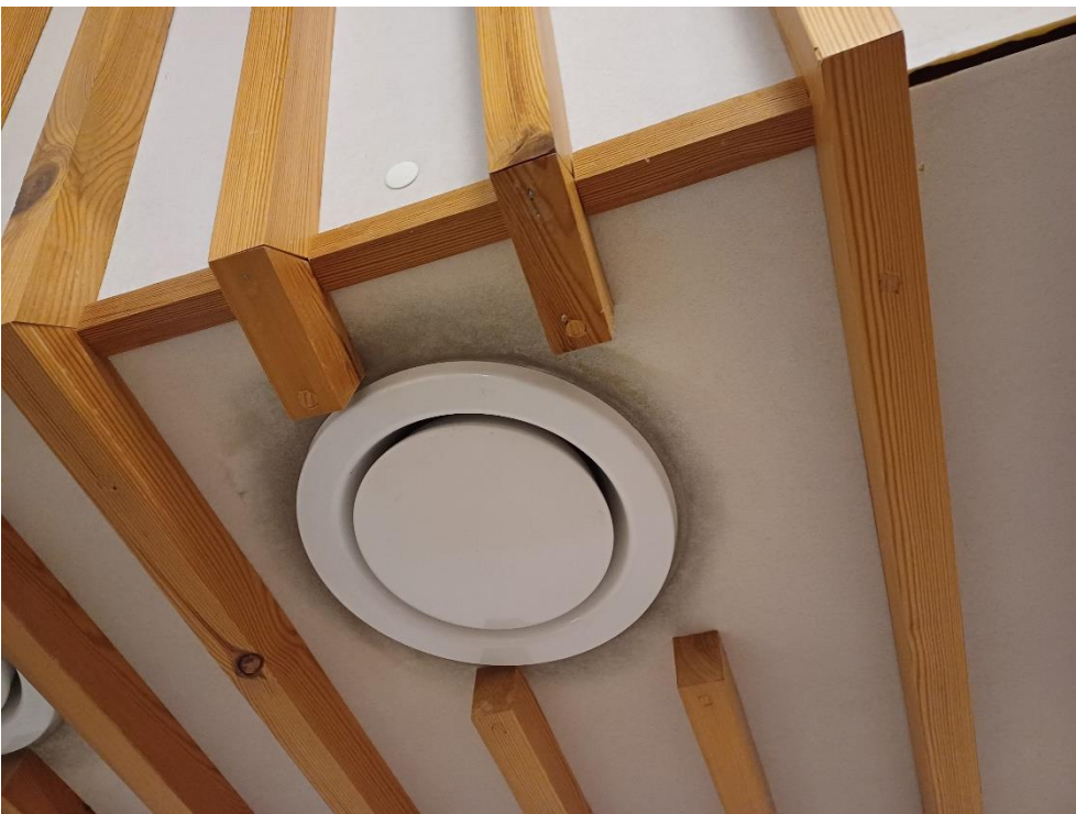
Kuva 4.5. Akustointilevyjä on likaantunut IV-päätelaitteiden ympäriltä useissa tiloissa.
