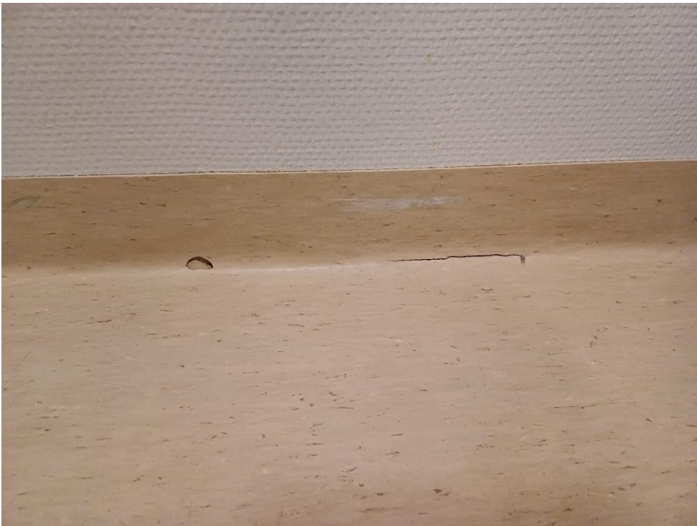
Kuva 4.1. 101 Lepohuone, lattiamatto halkeilee ylösnoston taitteesta.
