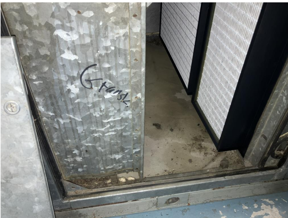
Kuva 5.1. Tuloilmanvaihtokoneen kammiassa roskaa.
