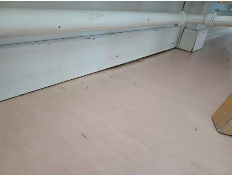
Kuva 4.18. Lattia on painunut alaspäin useissa tiloissa.
