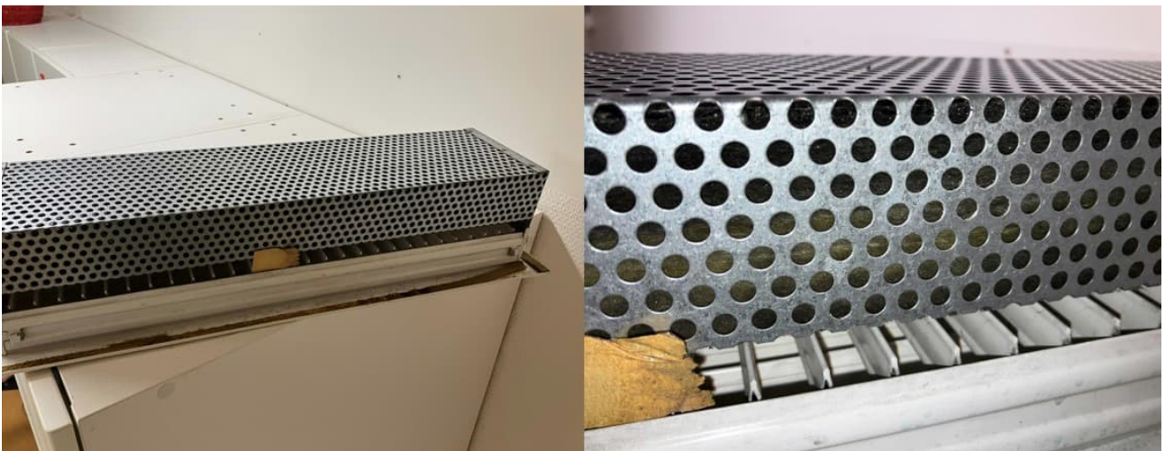
Kuva 5.2. Vanhoissa tuloilmapäätelaitteissa on käytetty mineraalivillaa ääneneristyksissä (reikäpellin sisällä äänenvaimennuksena käytetty mineraalivilla).
