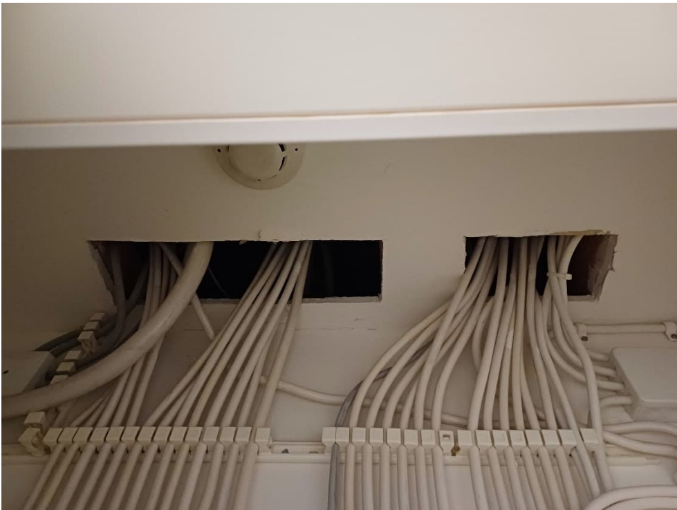
Kuva 4.14. 35 Sähkökeskus, ylöspäin menevät sähköjohtojen läpiviennit ei ole tiiviitä.
