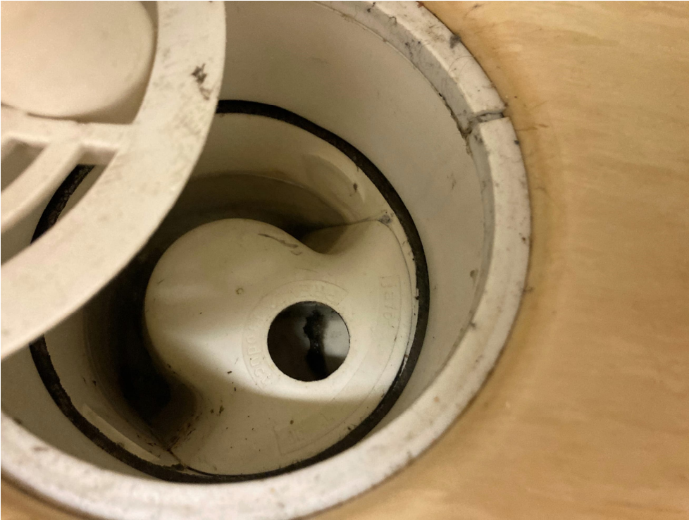
Kuva 5.5. Lattiakaivon puhdistustulpat puuttuivat Siivouskeskuksesta 23 ja Työtilasta 15.
