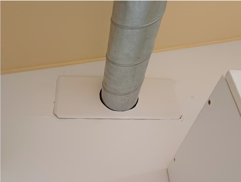
Kuva 4.19. IV-kanavien uudet seinäkehukset ei ole tiiviitä, jolloin seinien sisältä voi päästä epäpuhtauksia huonetiloihin.
