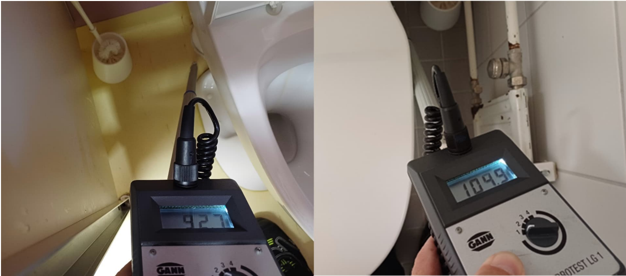
Kuva 4.21. Useissa WC-tiloissa mitattiin pintakosteuden osoittimella kohonneita pintakosteuksien vertailuarvoja WC-pönttöjen ympäristössä.
