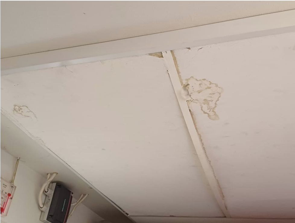
Kuva 4.7. 18 Keittiön tuulikaappi, alakaton akustointilevyissä on kosteusjälkiä.
