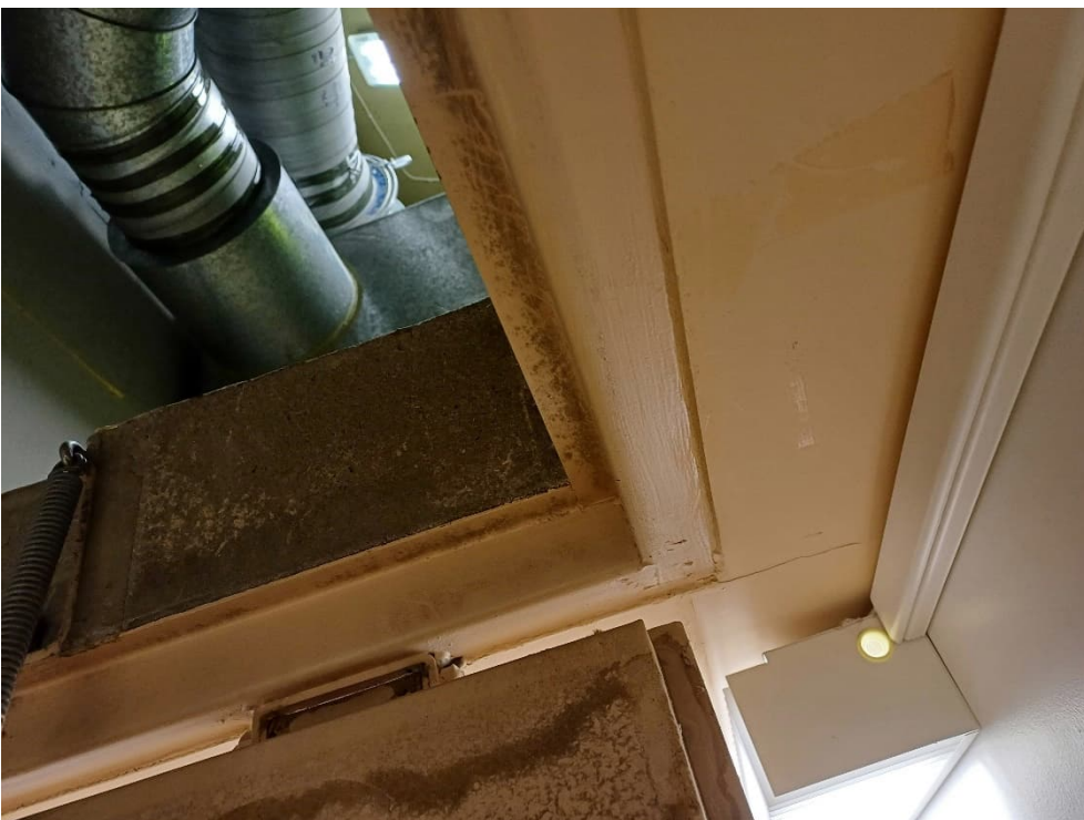
Kuva 4.20. IV-konehuoneen kulkuluukusta puuttuu tiivisteet.
