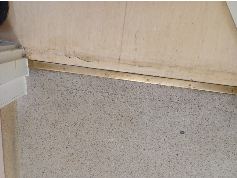
Kuva 4.8. 19 Keittiön ja käytävän välisen oviaukon lattiapinnoitteissa on halkeamia.
