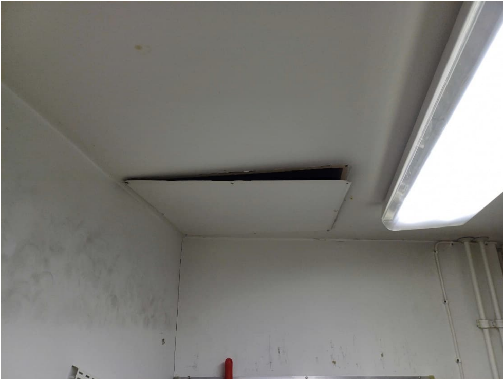
Kuva 4.9. 23 Siivouskeskus, katossa olevien tarkistusluukkujen kansia 2 kpl. on irtoamassa kiinnikkeistään.
