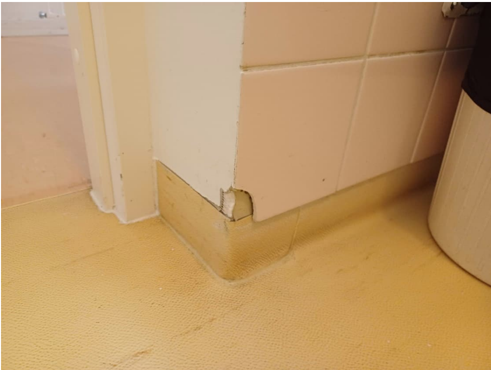
Kuva 4.6. 16 WC-tila, seinälaatoitus on lohjennut alanurkasta.
