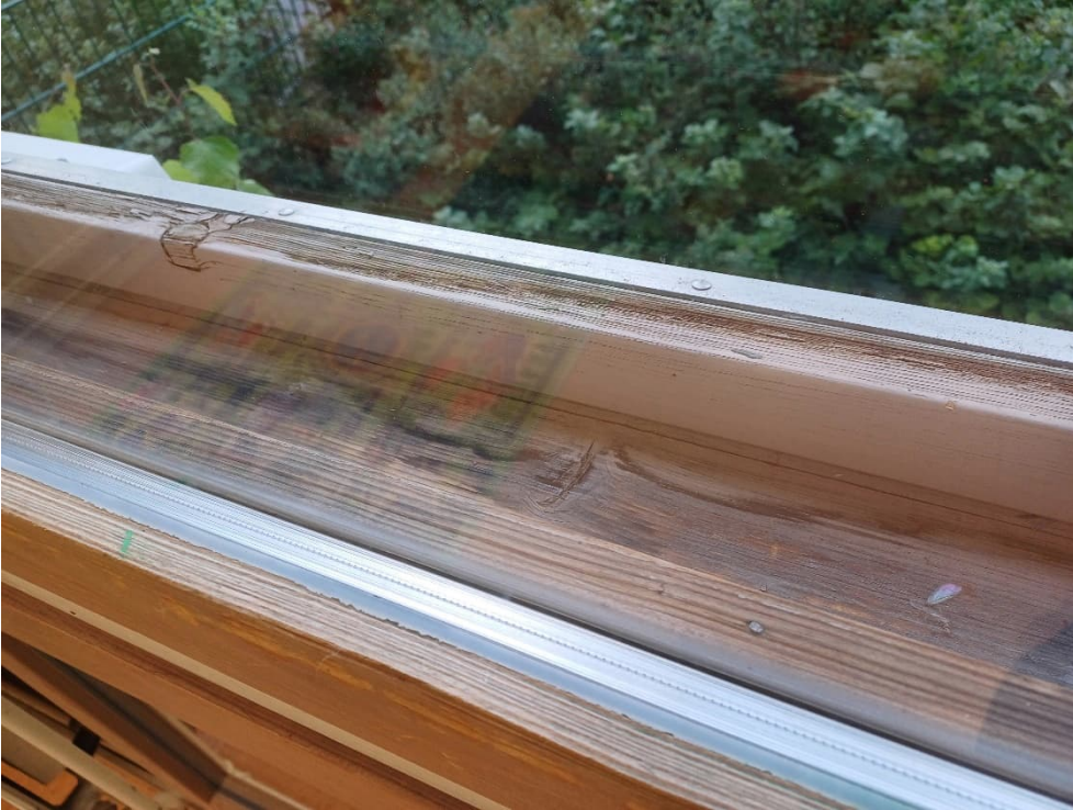
Kuva 4.17. Ikkunarakenteet ovat kauttaaltaan huollon tarpeessa.
