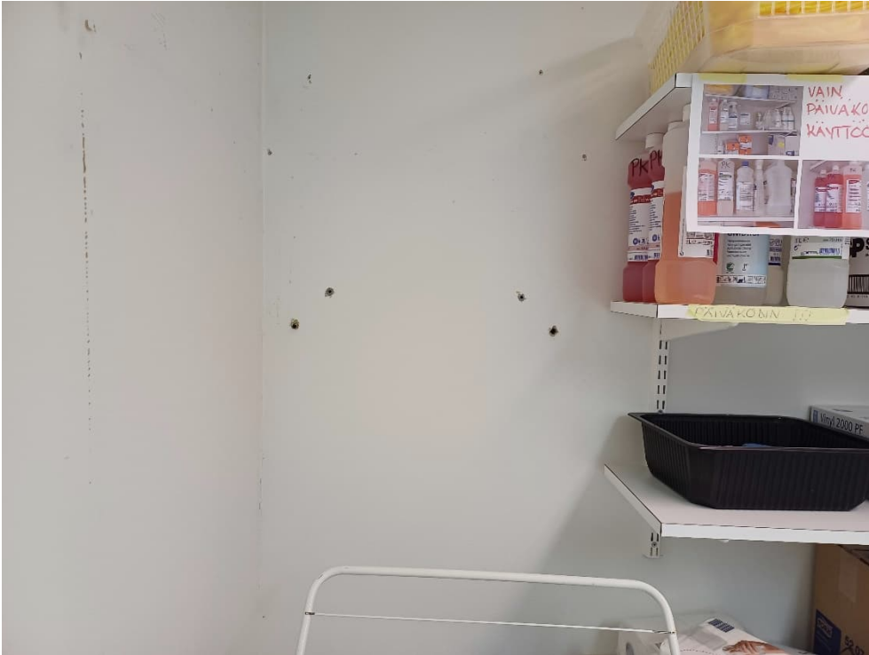
Kuva 4.5. 15 Vaatehuolto, poistettujen kalusteiden kiinnityskohdissa on reikiä.
