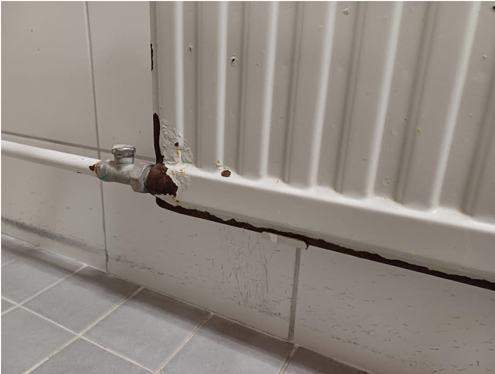
Kuva 4.15. 46 WC-tila, lämpöpatteri on alkanut ruostumaan.
