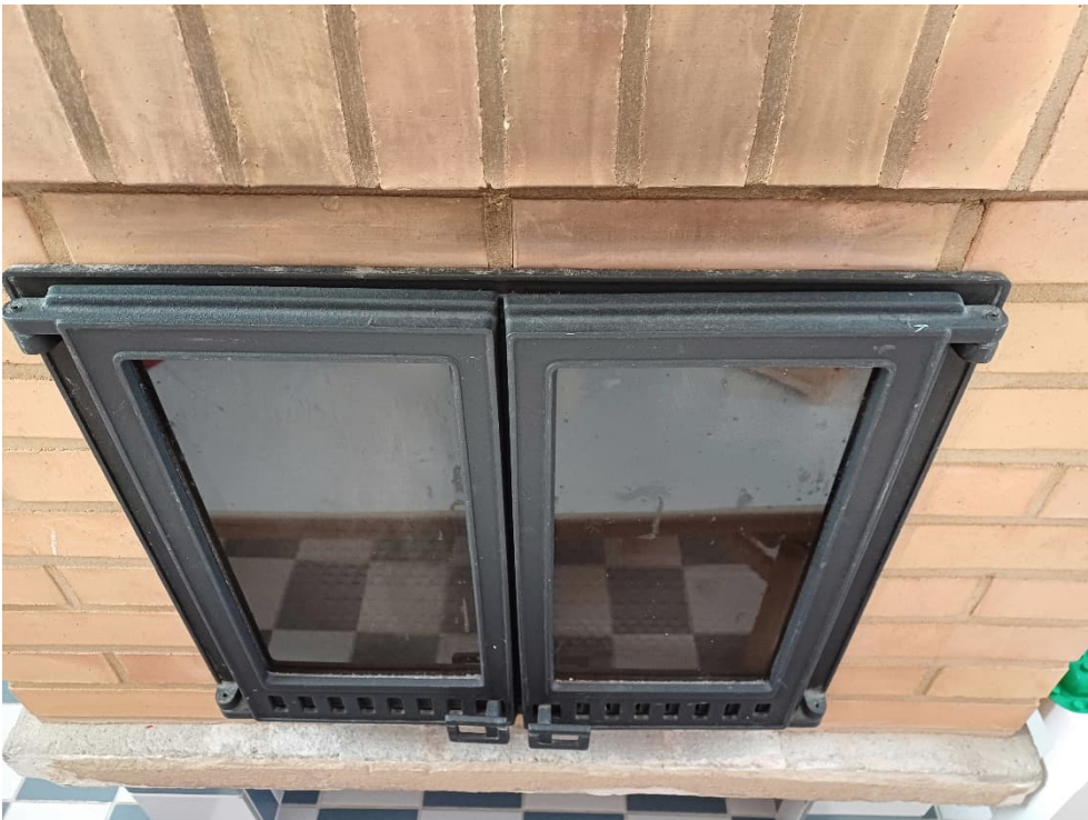
Kuva 4.10. 25 Monitoimitila, takan luukut ei ole tiiviitä, luukkujen kautta voi epäpuhtauksia levitä tiloihin.
