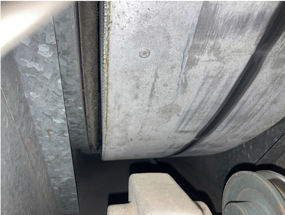
Kuva 5.4. Ilmanvaihtokoneen TK01/PK01 lämmöntalteenottokiekon harjakset ovat kuluneet.
