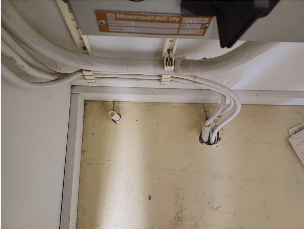
Kuva 4.3. 10 Sähkökeskus, lattian alle menevien sähköputkien päitä on tiivistämättä.
