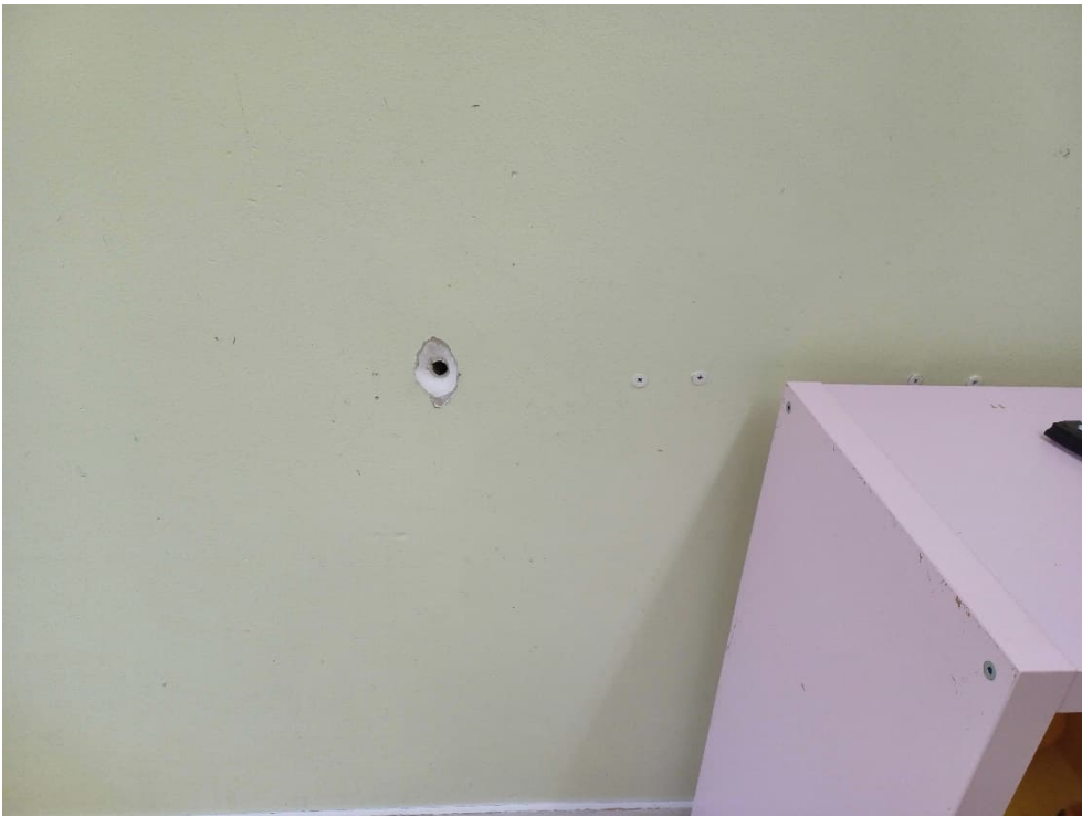
Kuva 4.4. 13 Leikkitila, väliseinän kipsilevyssä on reikä.
