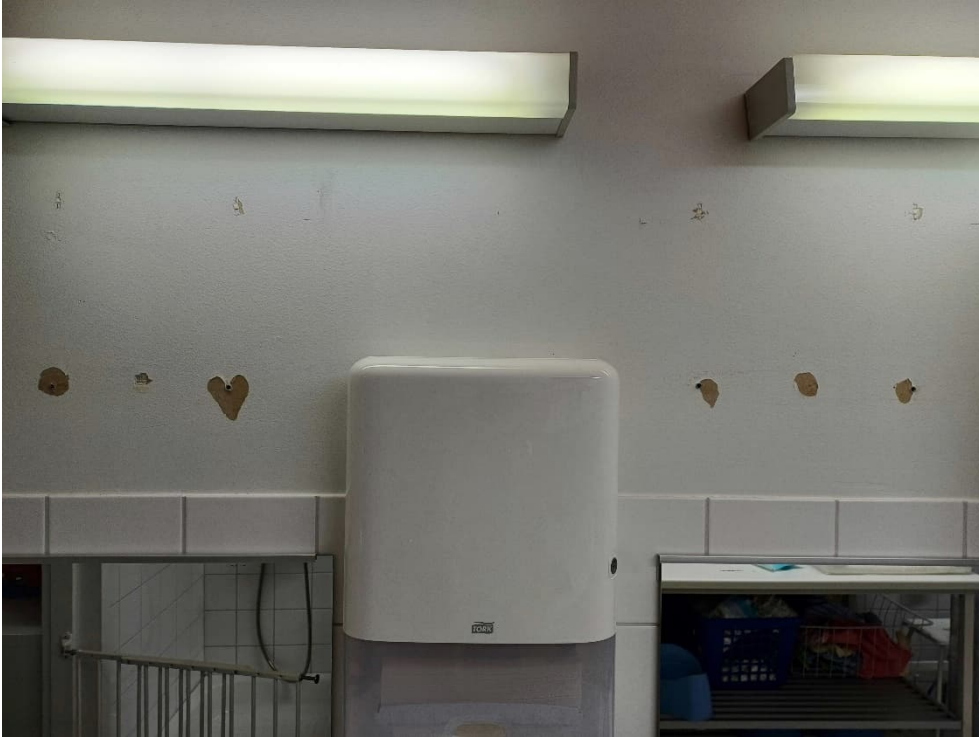
Kuva 4.1. 03 Pesuhuone, poistettujen seinäkalusteiden kiinnityskohdista on maalia irtoillut.
