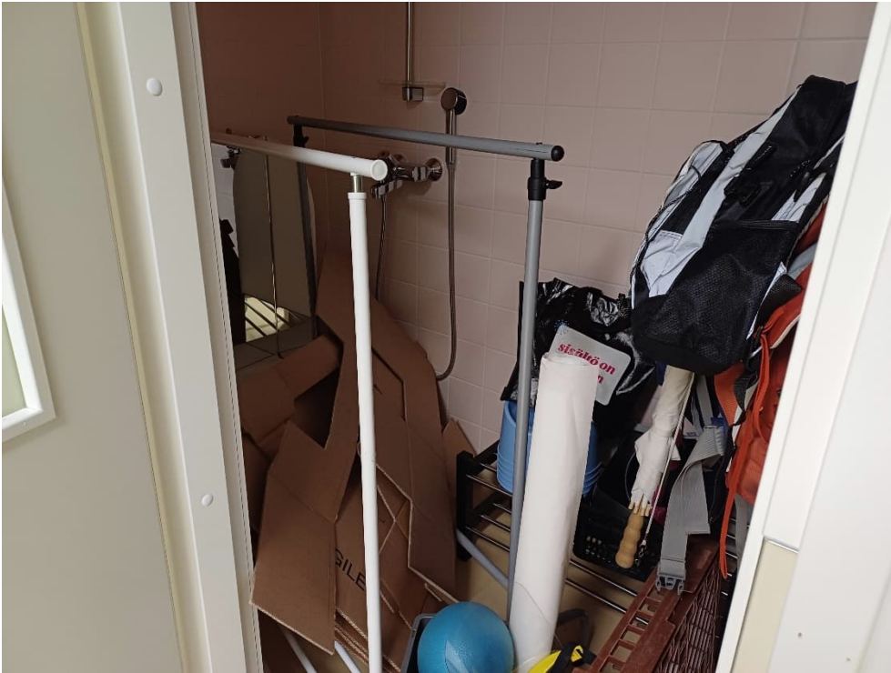
Kuva 4.13. 33 Suihkutilassa on ylimääräistä tavaraa, eikä tilassa olevaa lattiakaivoa pääse täyttämään vedellä, kaivon kautta voi viemärin hajua päästä tiloihin.
