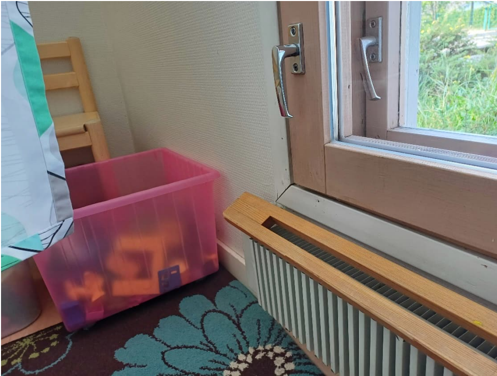
Kuva 4.11. 25 Monitoimitila, lämpöpatterin yläpuolinen ikkunapenkki on painunut kiinni patteriin.
