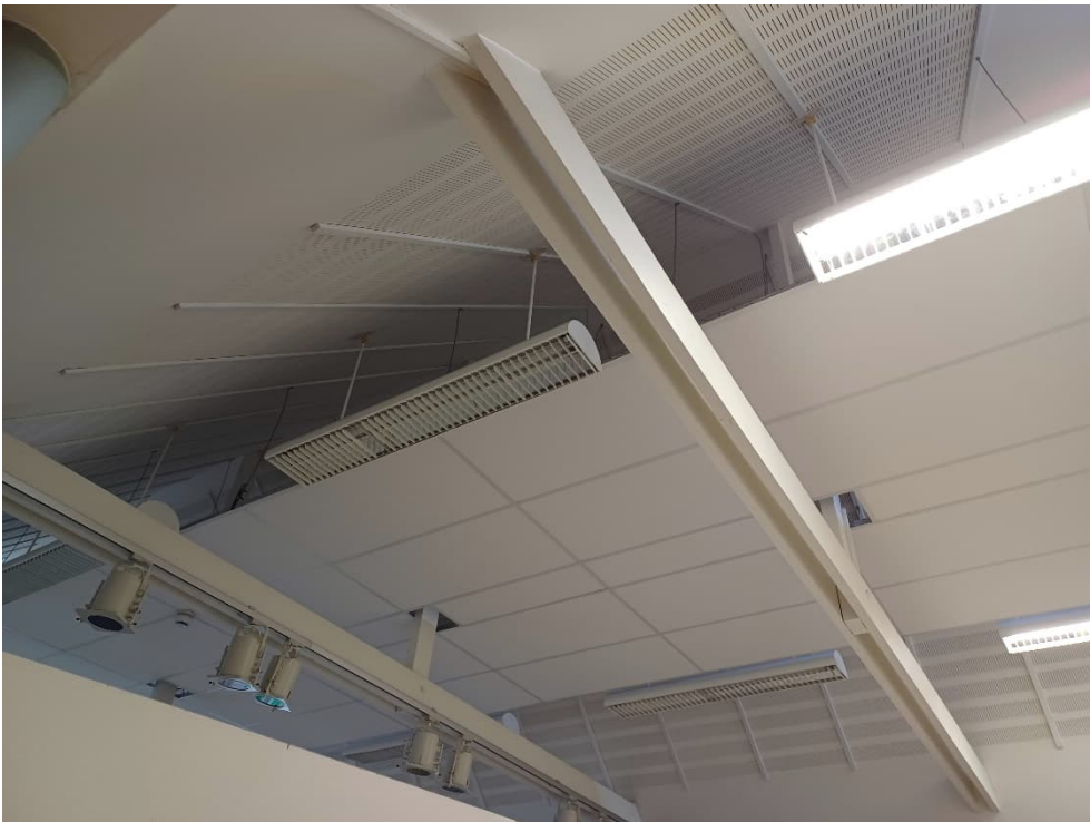
Kuva 4.12. 25 Monitoimitila, ylhäällä olevan vaakasuuntaan asennetun akustointilevytason päälle kertyy pölyä, mistä se on hankala siivota ja saattaa heikentää sisäilman laatua.
