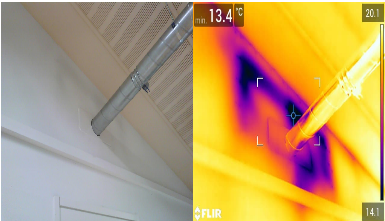
49 Leikkitila, IV-kanavan läpiviennin ympäristön seinäpinnassa on tummentumaa ja lämpökamerakuvauksissa näkyy puutteita seinän lämpöeristyksessä.
