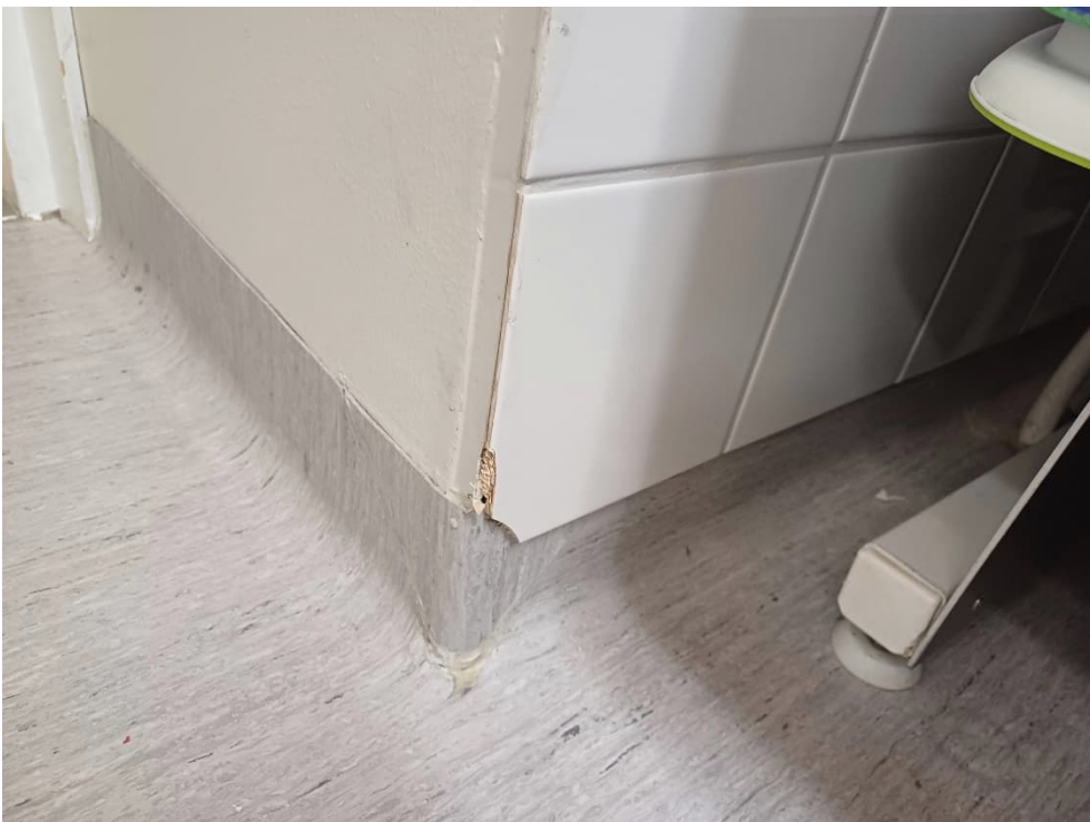
Kuva 4.2. 09 Pesuhuone, seinälaatoitus on lohjennut alanurkasta.
