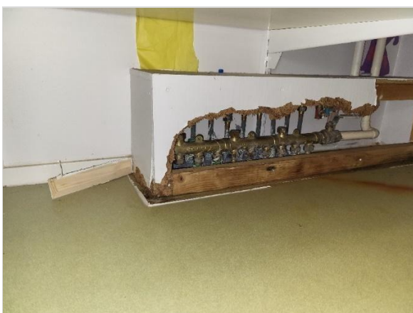
Kuva 4. Varaston 150 jakotukki ja kosteusvaurioitunut kotelo, joka purettiin osittain tutkimusten yhteydessä.
