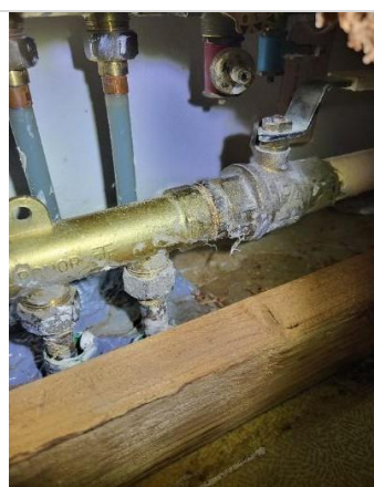
Kuva 5. Kotelon sisällä jälkiä kuivuneesta vedestä.
