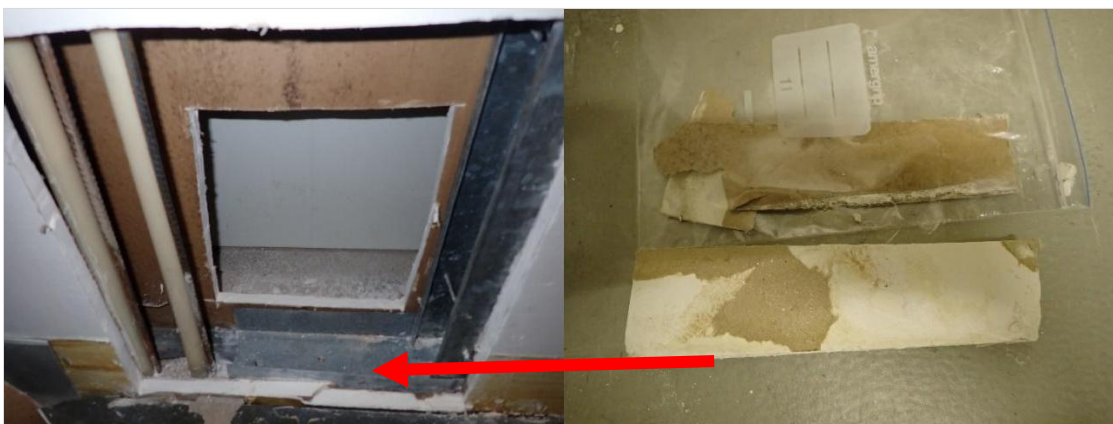
Kuva 8. Rakennearvauksen RA1 (VS) kohdalla tuuletusrakoon rajoittuvan kipsilevyn alareunassa havaittiin kosteusvaurioitumiseen viittaavia värimuutoksia levyn molemmin puolin. Taustakartongista otetussa materiaalinäytteessä RMS1 oli selvä viite mikrobikasvusta.
