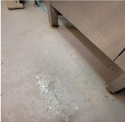
Kuva 9. Keittiön 125 lattiapinnoitteessa olevat halkeamat tiskikoneen alla.
