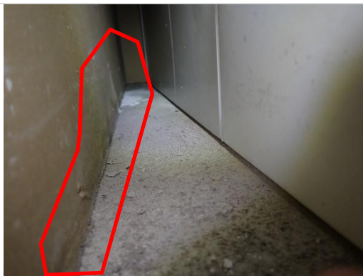
Kuva 7. Kylmähuoneiden 125A ja 125B seinäelementin ja niitä rajaavien väliseinien välissä on n. 10 cm leveä tuuletusrako. Väliseinän tuuletusrakoon rajoittuvan kipsilevyn alareunassa havaittiin kosteusvaurioitumiseen viittaavia värimuutoksia (alue rajattu punaisella).
