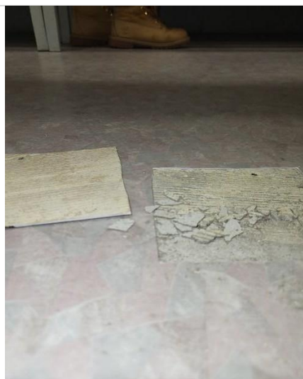
Kuva 3. Pukuhuoneessa 142 lattiapäällysteen kiinnitys oli heikko ja murtuminen tapahtui liimakerroksessa, myös tasoitteen tartunta betoniin oli heikko. Lattiapäällysteen haju oli aistinvaraisesti normaali. Lattiapäällysteen alla betonilaatan pintakosteuslukema 120.
