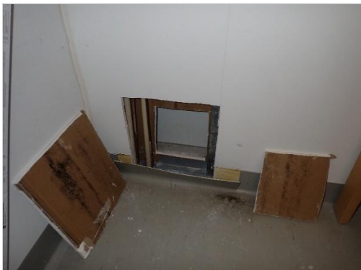
Kuva 6. Havainnekuva sähköpääkeskuksen 121 väliseinän rakennearvauksesta RA1 (VS). Kipsilevyn sisäpinnoilla olevien tummien jälkien arvioidaan olevan nokea.
