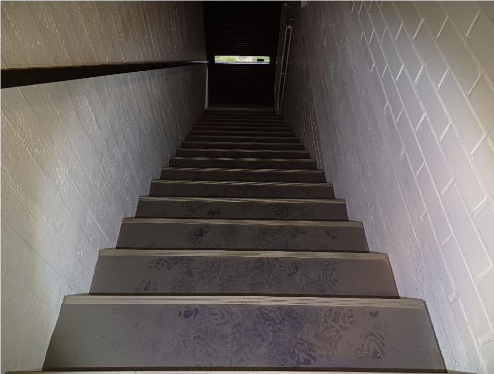
Kuva 4.6. 209 Porrastila, siivous on puutteellista.
