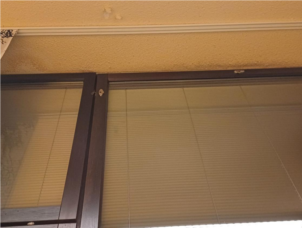
Kuva 4.2. 108 Sali, ikkunaseinä-kattoliittymässä on vanhoja kosteuden aiheuttamia jälkiä.
