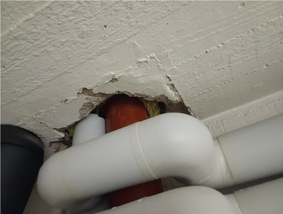
Kuva 4.10. Osa kellarikerroksen ylöspäin johtavista läpivienneistä ei ole tiiviitä.
