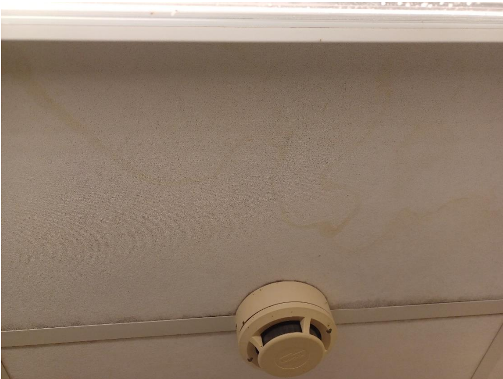
Kuva 4.5. 119 Varasto, alakaton akustointilevyssä on kosteusjälkiä.
