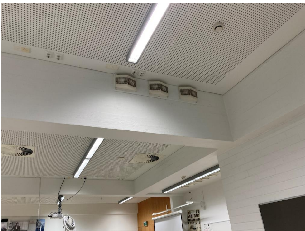
Kuva 5.2. Ilmanvaihdon tuloilmapäätelaitteet ovat puhdistamatta tilassa 111.
