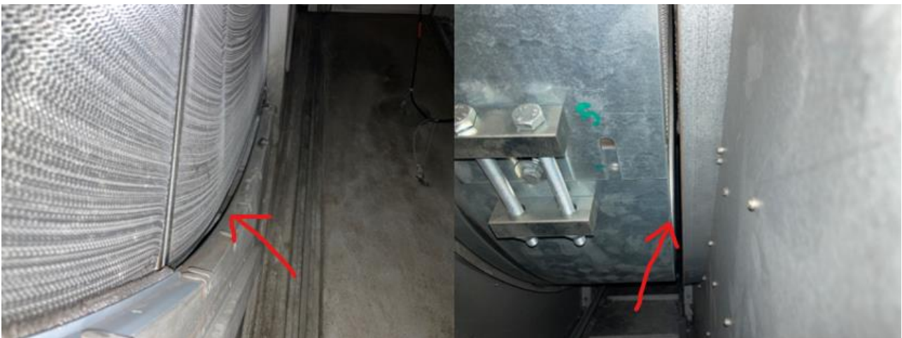
Kuva 5.1. Ilmanvaihtokoneen TK01 pyörivän lämmöntalteenoton harjakset ovat kuluneet ja irronneet kokonaan.
