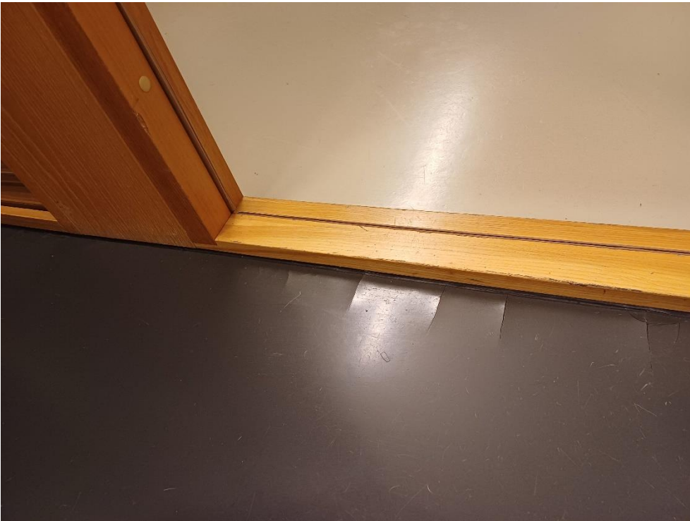
Kuva 4.9. Lattiapinnoite irtoilee oviaukkojen edustalta useissa kohdissa 2krs. alueella.
