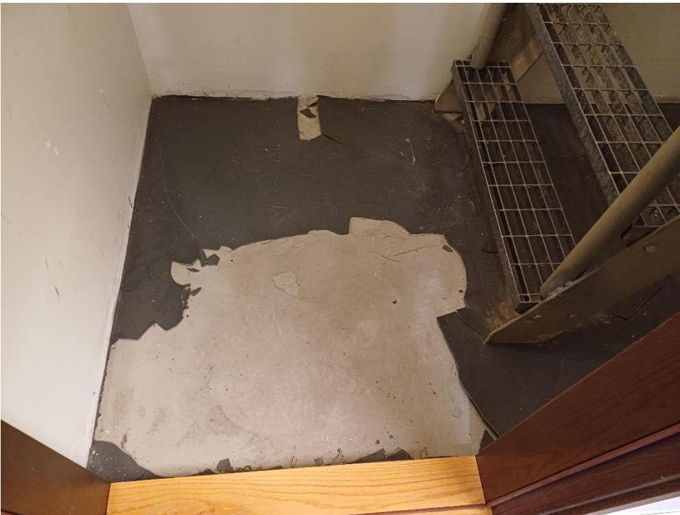
Kuva 4.7. 213 Porrashuone, lattiapinnoite irtoilee kauttaaltaan.
