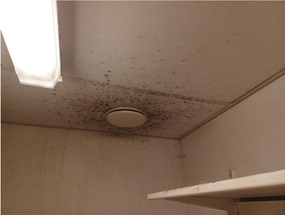
Kuva 4.4. 119 Varasto, IV-venttiilit ja niiden ympäristö on likaiset.
