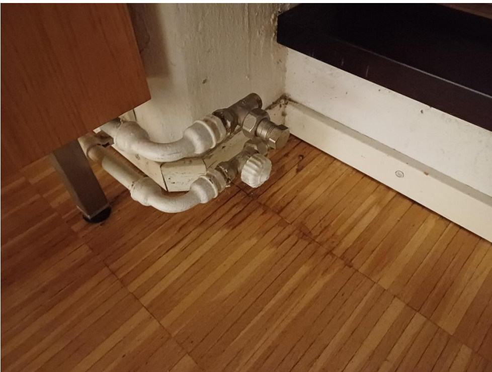
Kuva 4.3. 108 Sali, parkettilattiassa on patteriputkiston vuotojen aiheuttamia vanhoja kosteusjälkiä.
