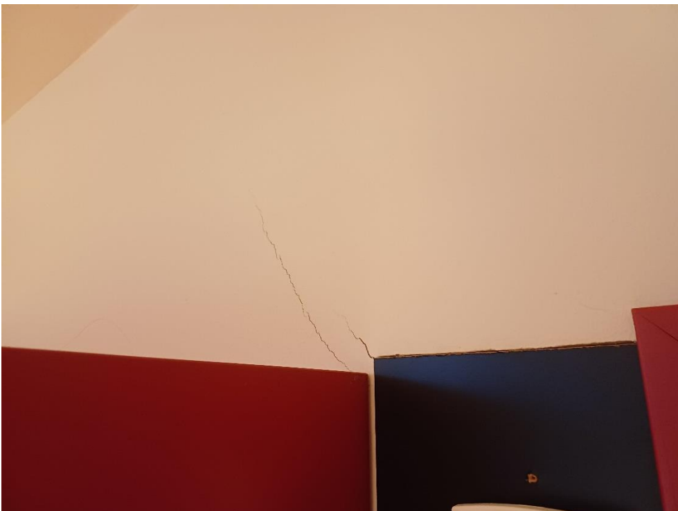
Kuva 4.2. H138 Opetustila, oviaukon ylänurkassa on seinähalkeama.
