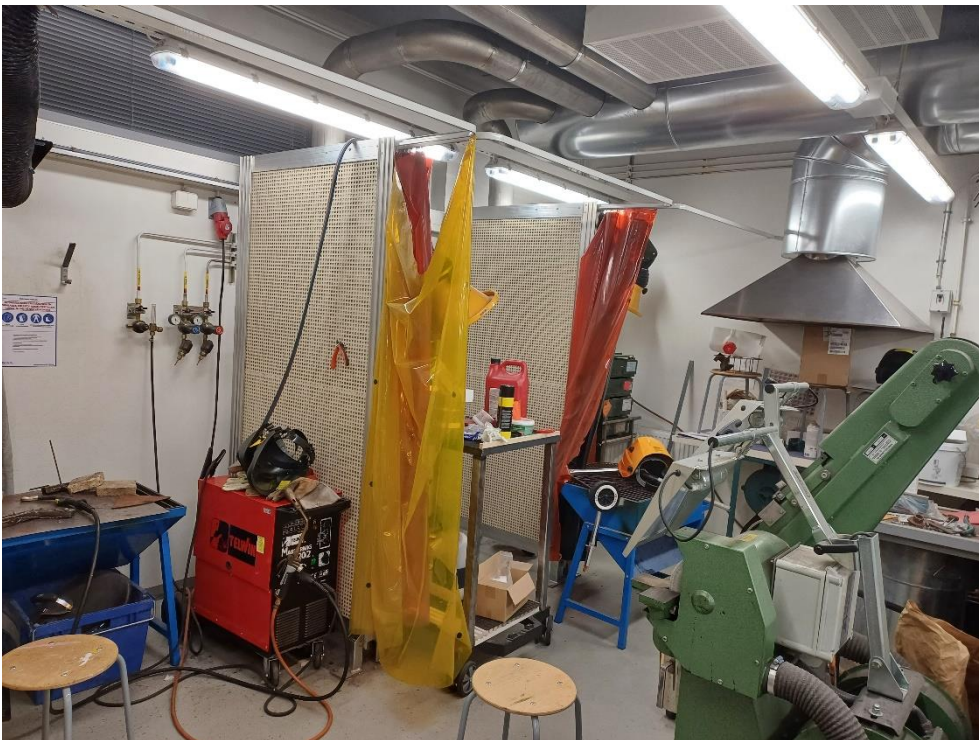
Kuva 4.4. H042 Kuumakäsittelytila, sijaitsee opetustilan H138 alapuolella. Kuumakäsittelytilasta saattaa kulkeutua opetustilaan H138 mm. hitsauskaasuja.
