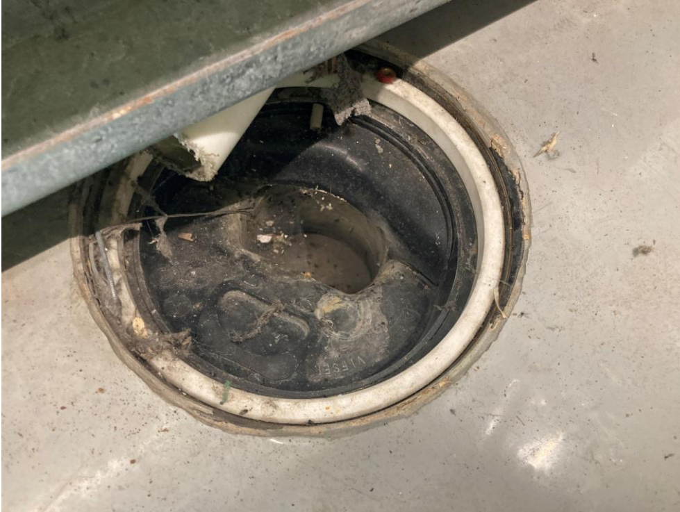
Kuva 5.1. Teknisen tilan H2002 kuiva lattiakaivo.
