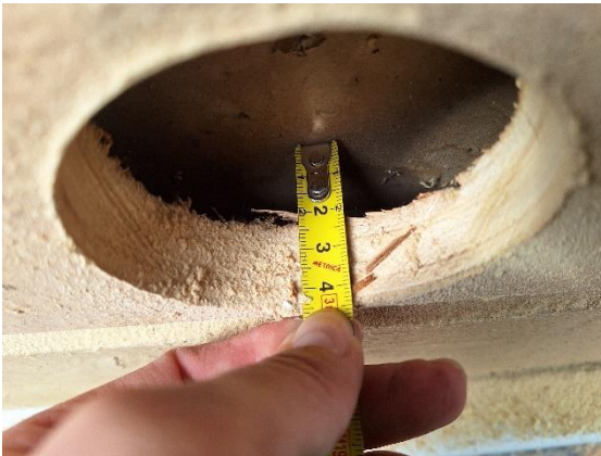
Kuva 25 Tuuletusrako oli noin 20 mm ja julkisivulauta 24 mm paksu.
