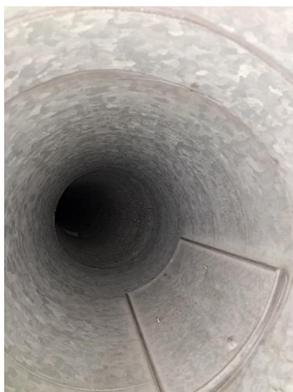
Kuva 54 Tuloilmakanava vasemmalle äänenvaimennuskammioista.
