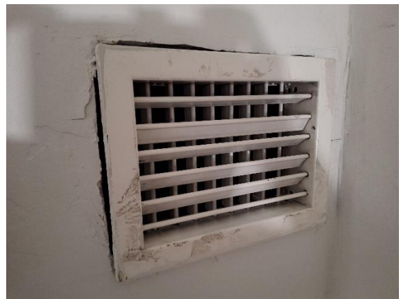
Kuva 46 Tilan 4 tuloilman päätelaitetta ei saanut irti.
