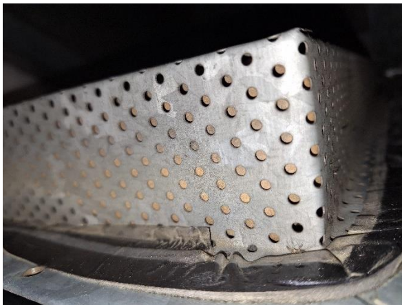
Kuva 52 Tarkastusluukun kansi on äänenvaimennettu ja tiivistetty.
