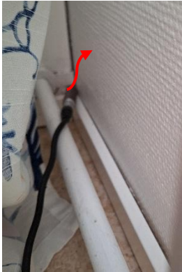
Kuva 37 Selvä vuotokohta väliseinän patteriläpiviennin kohdalla tilassa 5.
