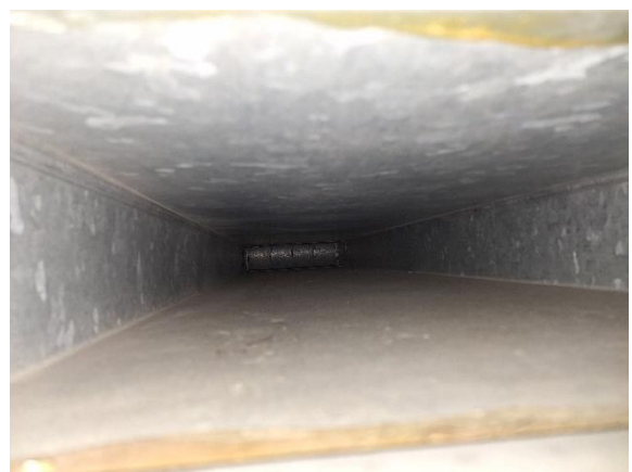
Kuva 48 Tilan 5 tuloilmakanava, josta otettiin pölynkoostumusnäyte.
