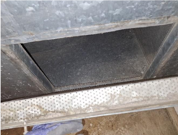
Kuva 56 Poistoilman äänenvaimennuskammio ennen suodatusta.
