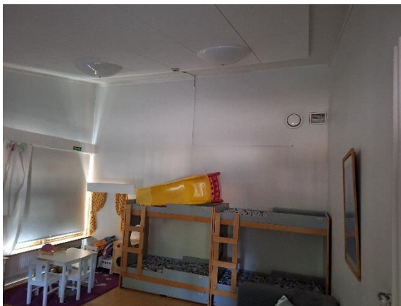
Kuva 45 Tilan 4 päätelaitteet ovat vierekkäin, mikä voi heikentää ilman vaihtuvuutta tilassa.
