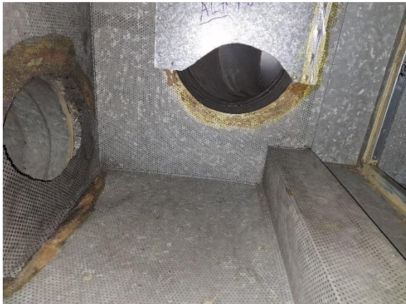
Kuva 50 Tuloilman äänenvaimennuskammio puhaltimen jälkeen.
