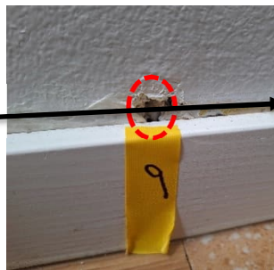
Selvä pistemäinen vuoto reiän kohdalla.
