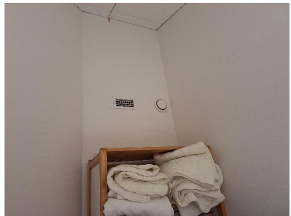
Kuva 44 Nukkumatilán 46 päätelaitteet ovat vierekkäin.
