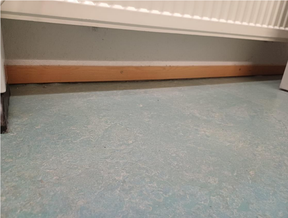
Kuva 4.12. 1182 OPO:n tila, lattia on painunut alaspäin ulkoseinän osalta.
