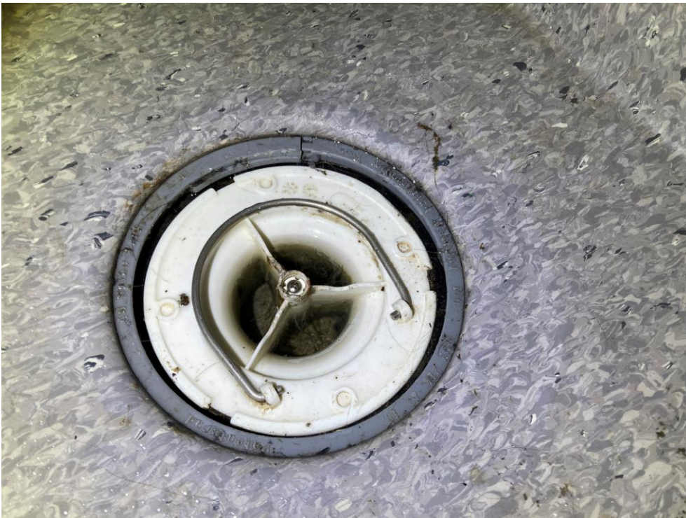
Kuva 5.1. Lattiakaivo ei ole tiiviisti paikallaan.
