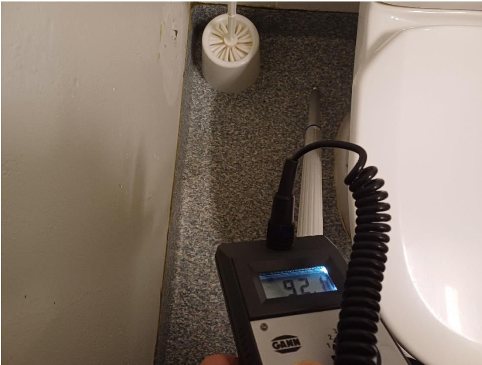
Kuva 4.30. Seuraavissa WC-tiloissa mitattiin pintakosteudenosoittimella kohonneita vertailuarvoja. 1122, 1123, 1129, 1153, 1174, 1184, 1187, 1188, 1189, 1190.
