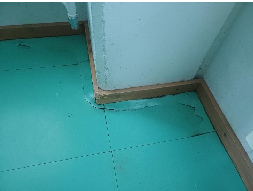
Kuva 4.5. 1140 Ruokasali, lattialaattoja on halkeillut pilareiden ympäristössä.
