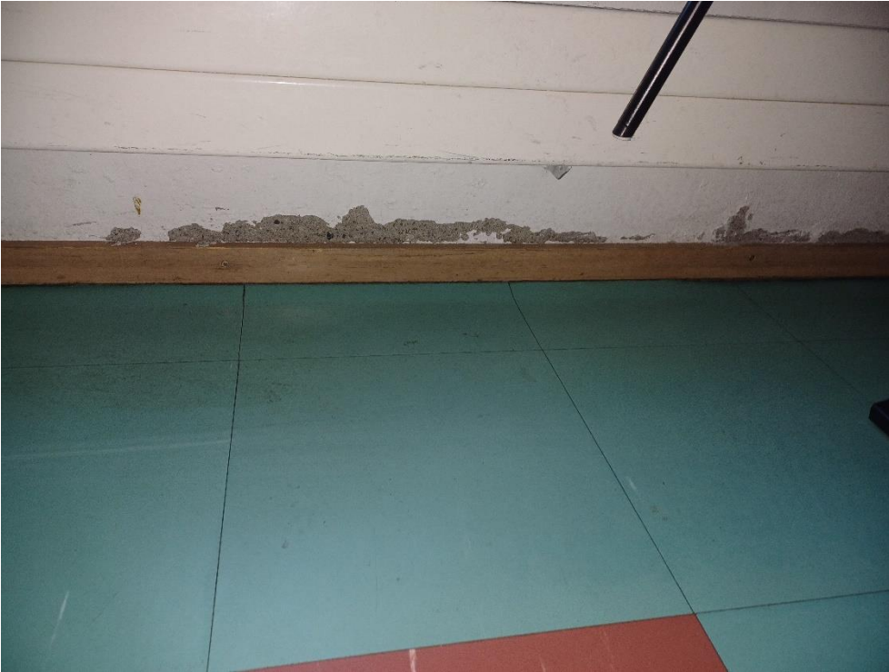
Kuva 4.6. 1140 Ruokasali, ulkoseinän maalipinta irtoilee jalkalistan yläpuolelta.
