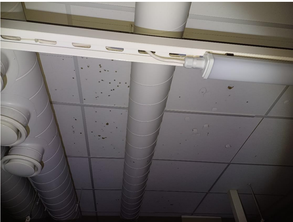
Kuva 4.3. 1116 Metallityö, alakaton akustointilevyissä on reikiä.
