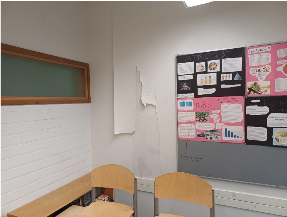
Kuva 4.18. 2121 Luokka, seinälevytyksen lasikuitutapetti irtoilee paikoittain.
