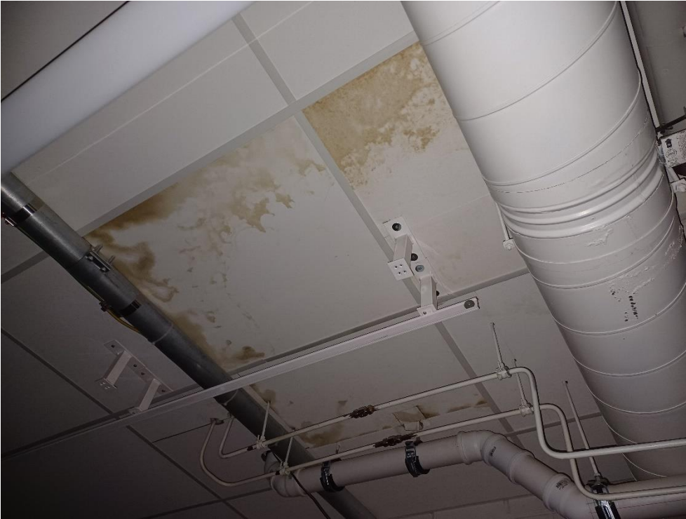
Kuva 4.2. 1114 Puutyö, alakaton akustointilevyissä on kosteusvauriojälkiä.
