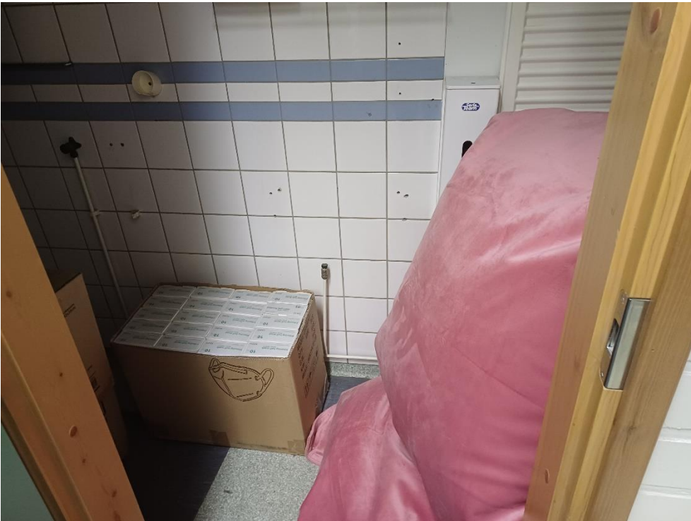
Kuva 4.9. 1148b WC-tila on poistettu käytöstä ja otettu varastotilaksi.
