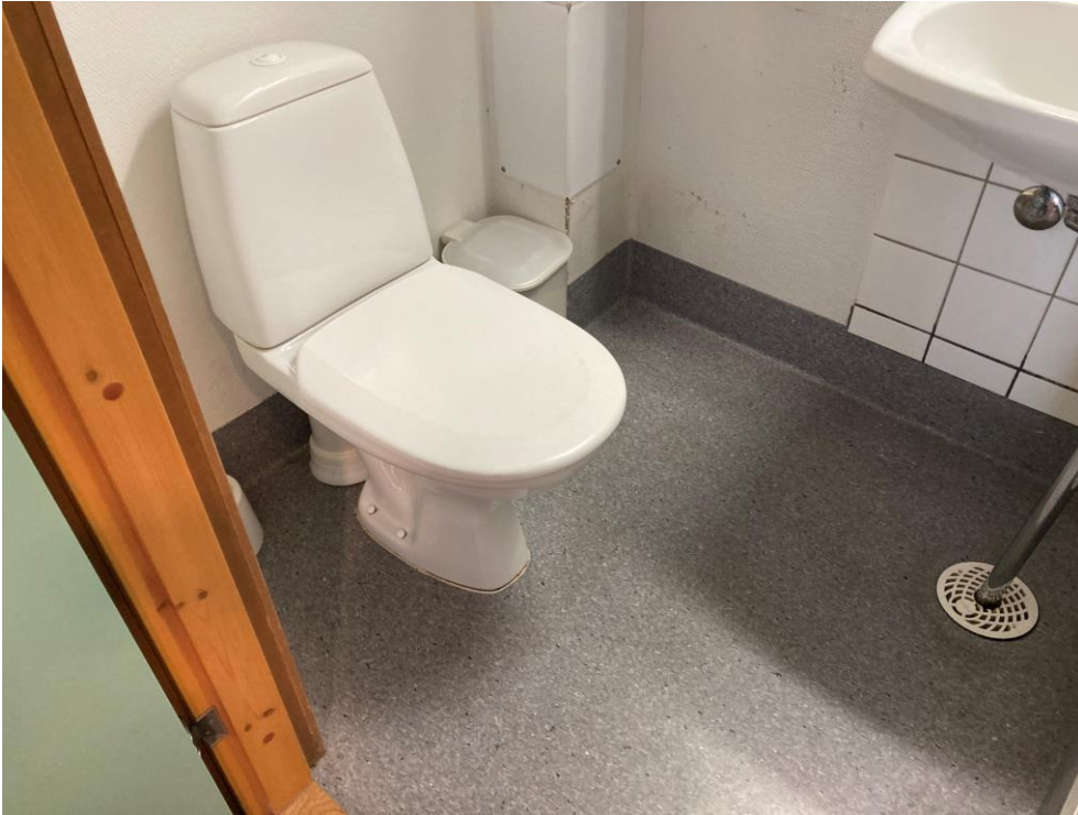
Kuva 5.2. 2145 WC-tilan kiinnityksistä irronnut istuin.
