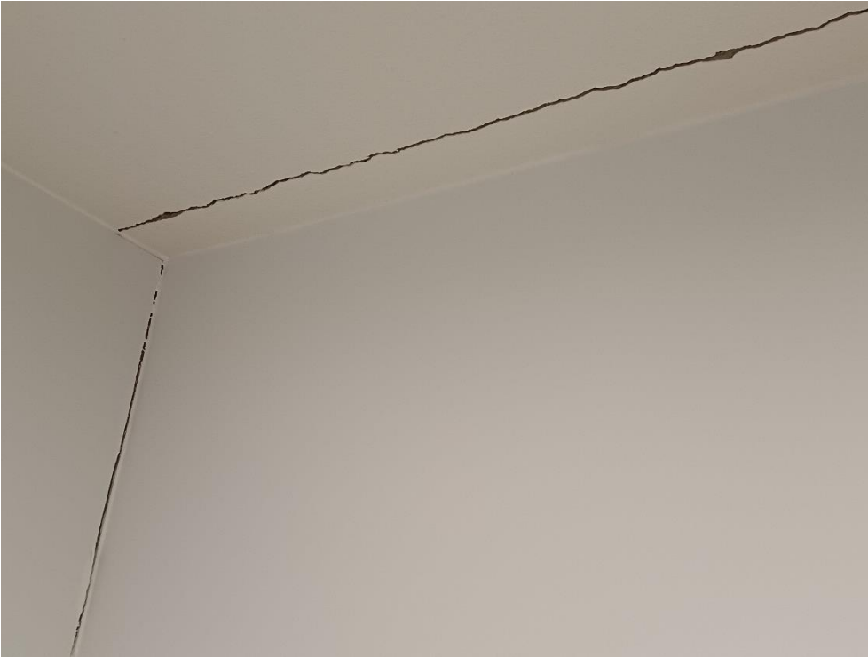
Kuva 4.26. Entinen talonmiehen as. rakenneliittymien ratkeamia.
