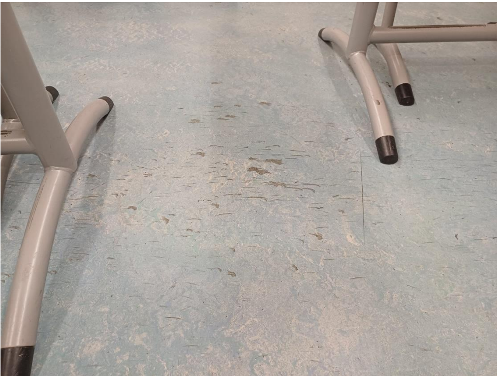
Kuva 4.27. Useissa luokkatiloissa on lattiapinnoitteiden vaurioita.
