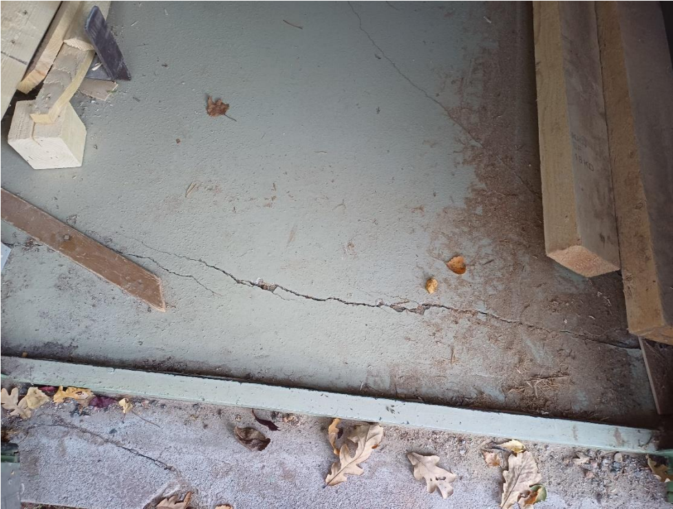
Kuva 4.4. 1119 Varasto, ulko-oven kynnyksen kohdalla on lattiahalkeama.
