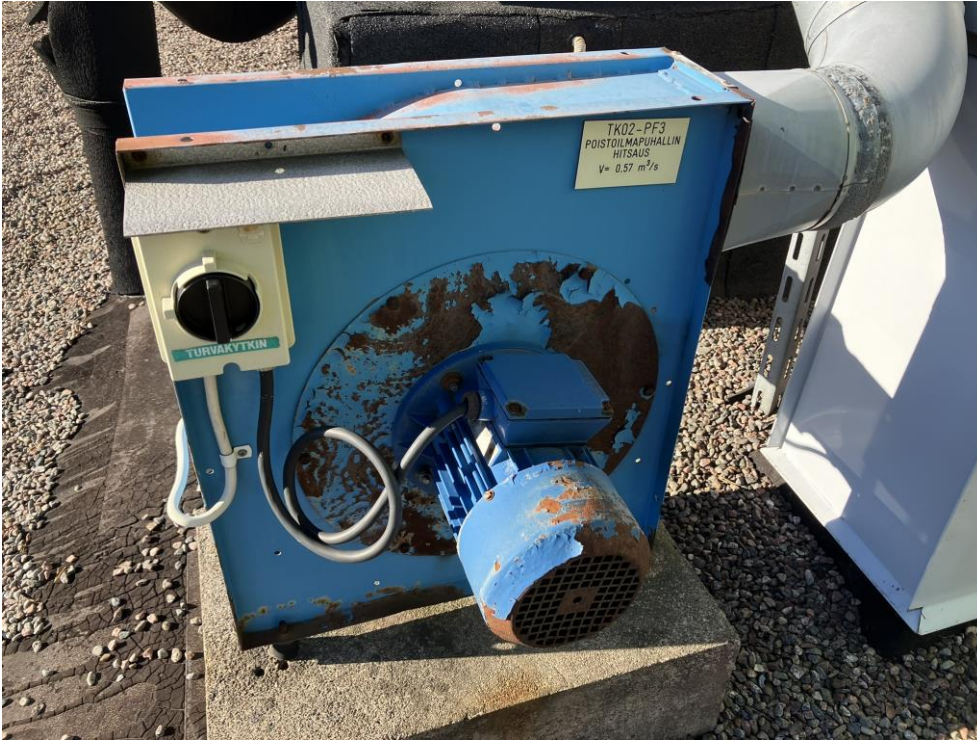
Kuva 5.4. Vesikatolla sijaitseva värisevä poistopuhallin TK02-PF3.
