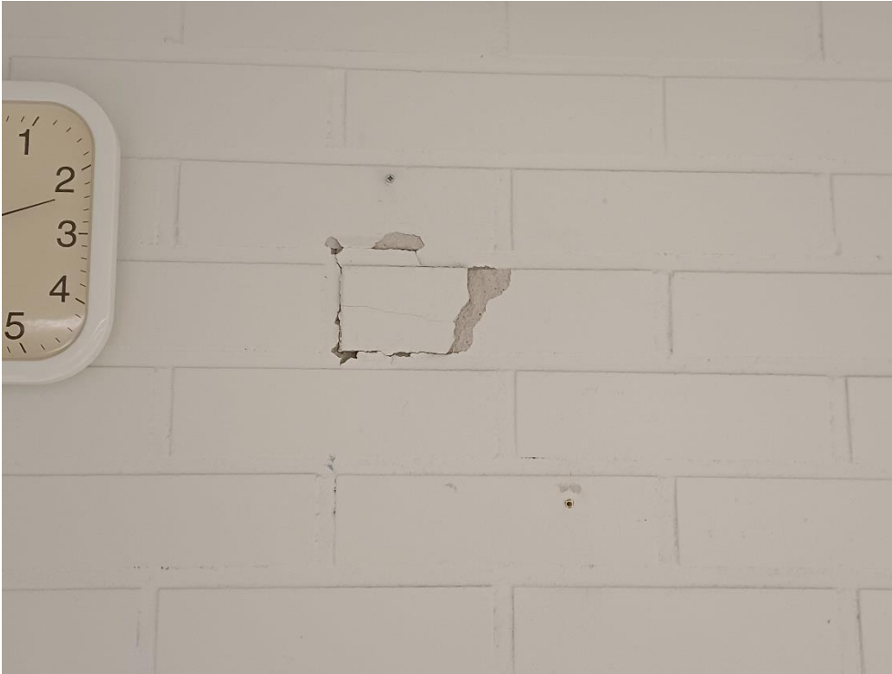
Kuva 4.22. 2137 Luokka, seinämuurauksen tiilipinta on rikkoutunut.
