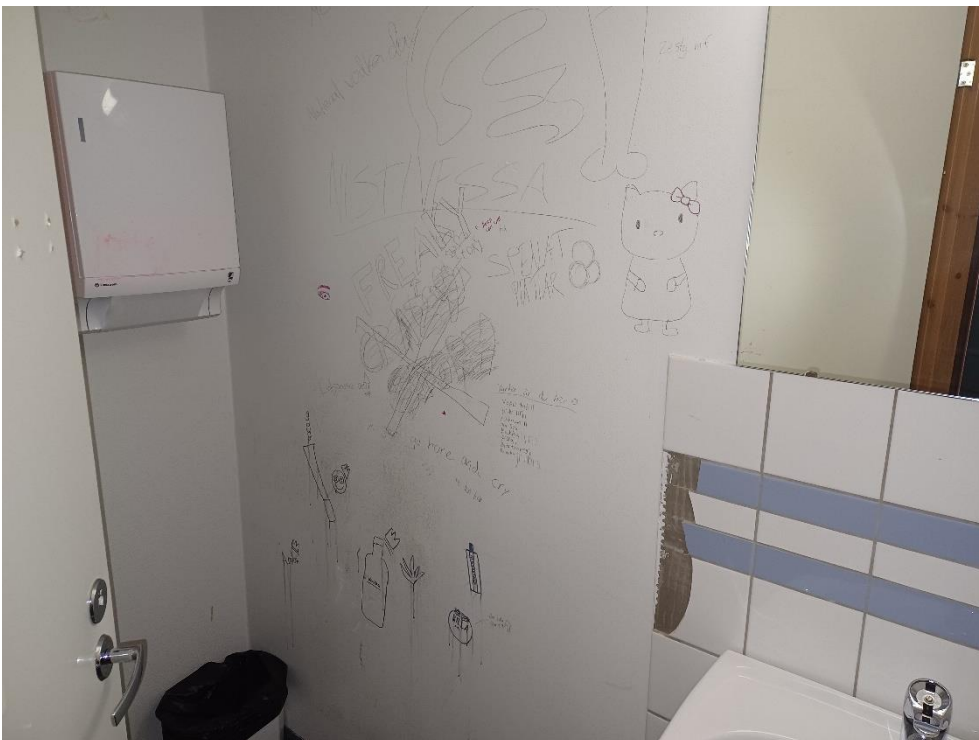
Kuva 4.23. 2146 ja 2147 WC-tilat, seiniä on tuhrittu piirroksilla.
