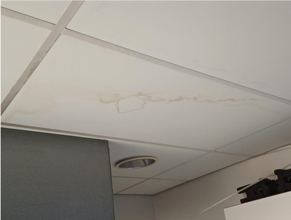
Kuva 4.20. 2126 Luokka, alakaton akustointilevyissä on kosteusvauriojälkiä.
