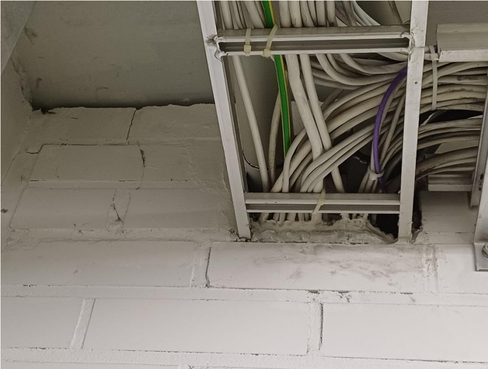
Kuva 4.8. 1147 Tekninen tila, läpiviennit sekä tiilimuurauksen yläosa eivät ole tiiviitä viereisiin tiloihin.
