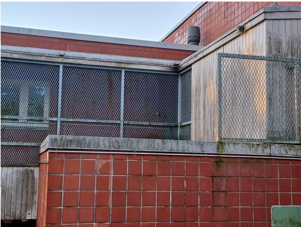
Kuva 4.29. Ulkopuolen maalatut puupinnat vaativat kauttaaltaan huoltokunnostusta.
