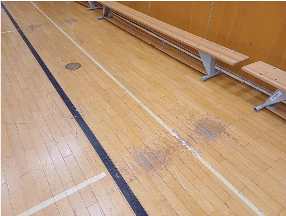
Kuva 4.11. 1158 Voimistelusal, lattiassa on vanhoja kosteusjälkiä.
