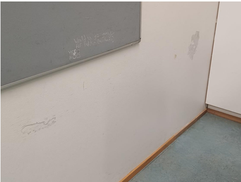
Kuva 4.19. 2123 Luokka, seinäpinnoite irtoilee paikoittain.
