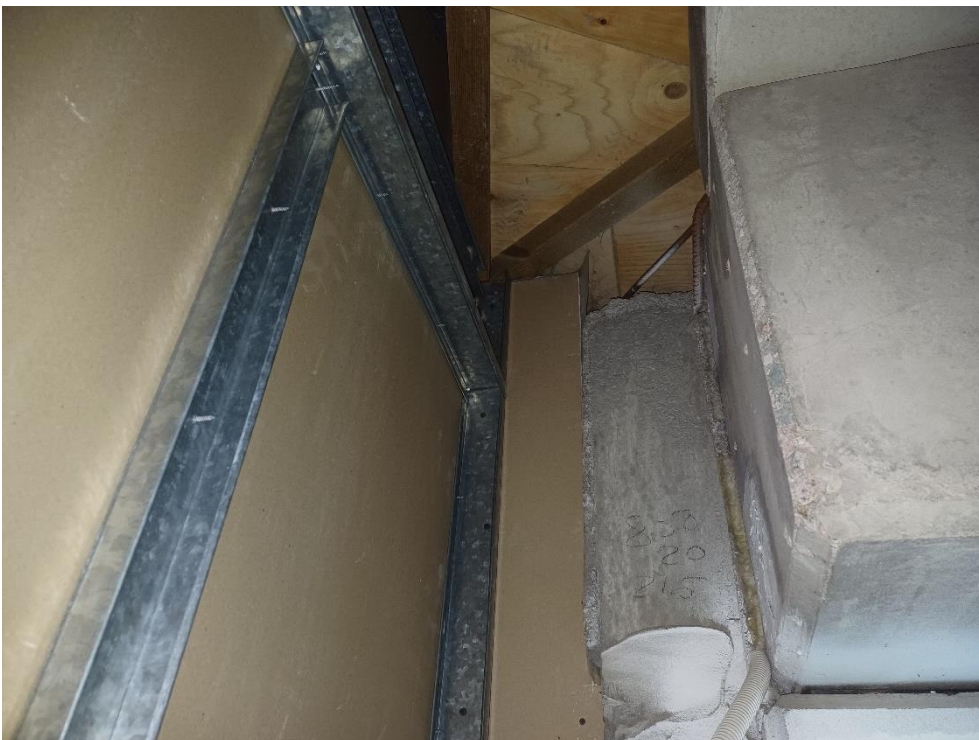
Kuva 4.21. 2127 Erkkeri, alakaton yläpuolisissa rakenteissa on selkeitä ilmavuotoja.
