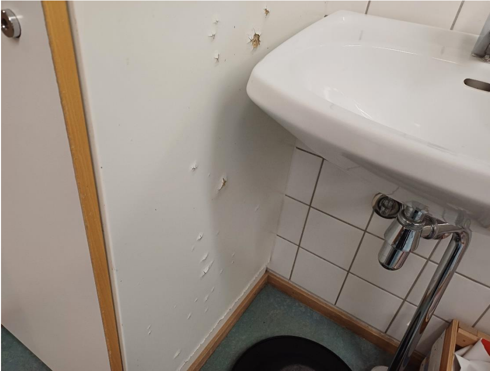
Kuva 4.28. Useissa luokkatiloissa on vesipisteiden vieressä sijaitsevista kaapistoista kosteuden aiheuttamia vaurioita.
