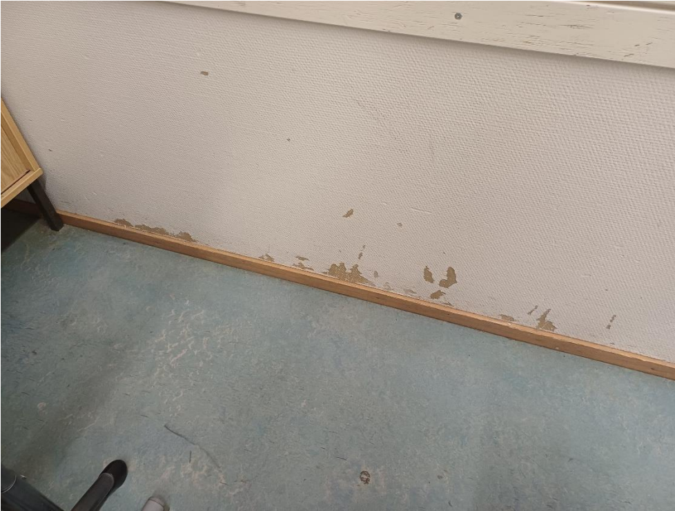
Kuva 4.16. 2111 Luokka, seinäpinnoite irttoilee paikoittain.
