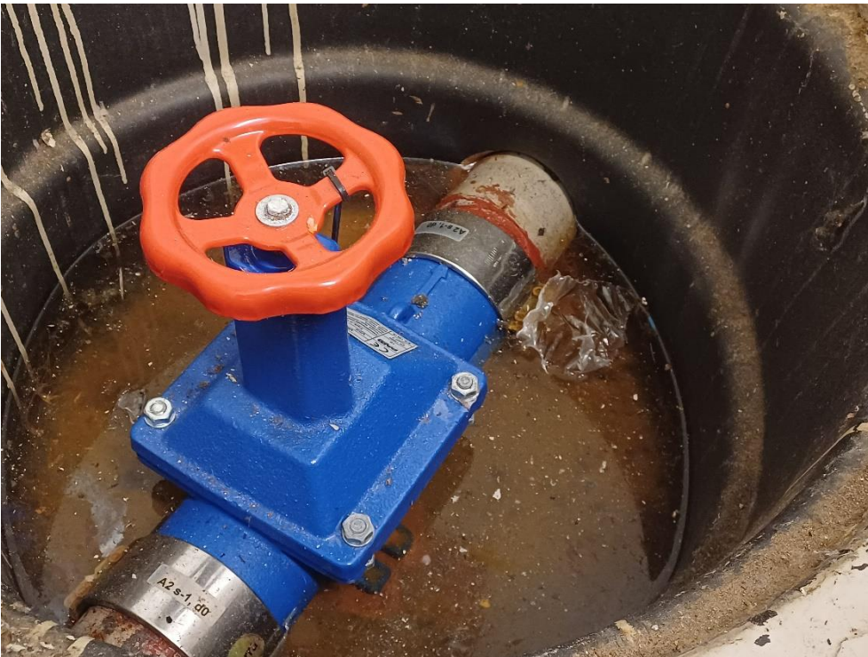
Kuva 4.7. 1142 VS. Eteinen, sulkuventtiilin kaivossa on vettä.
