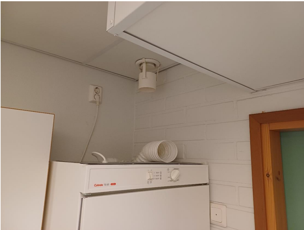
Kuva 4.1. 1111 Vaatehuolto, kuivauskaapin poistoilmaletku on irti kiinnikkeestään.
