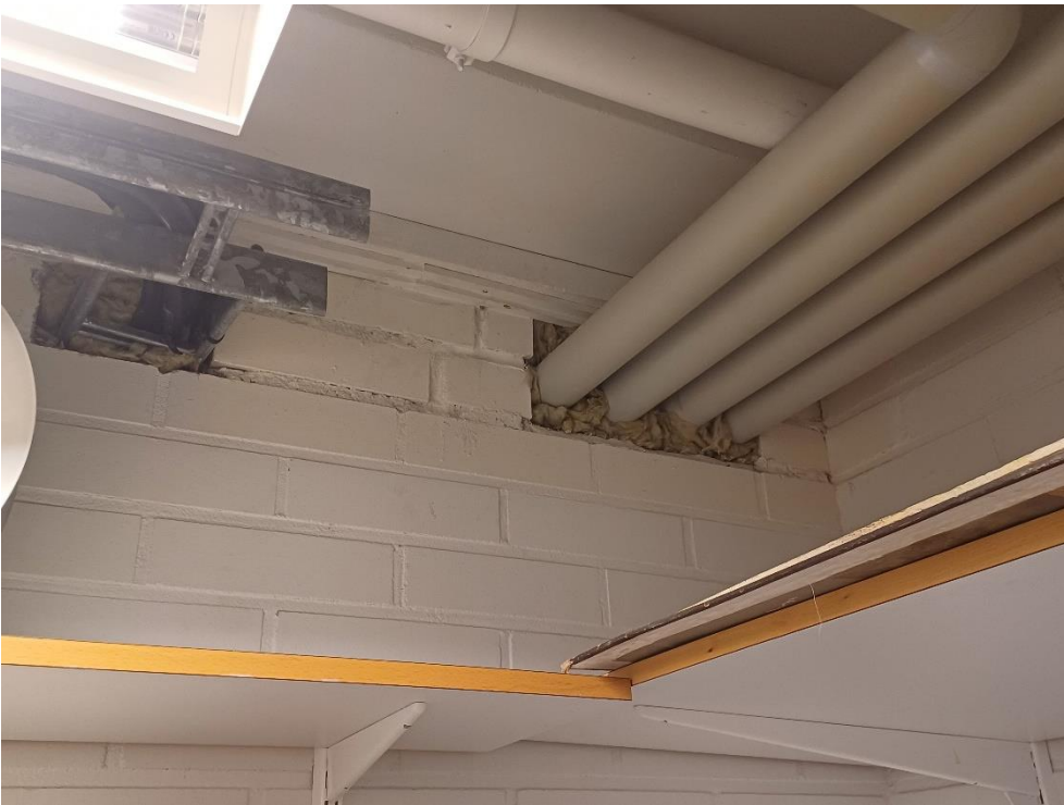
Kuva 4.13. 1200 Varasto, läpivientien tiivistyksessä on käytetty mineraalivillaa.
