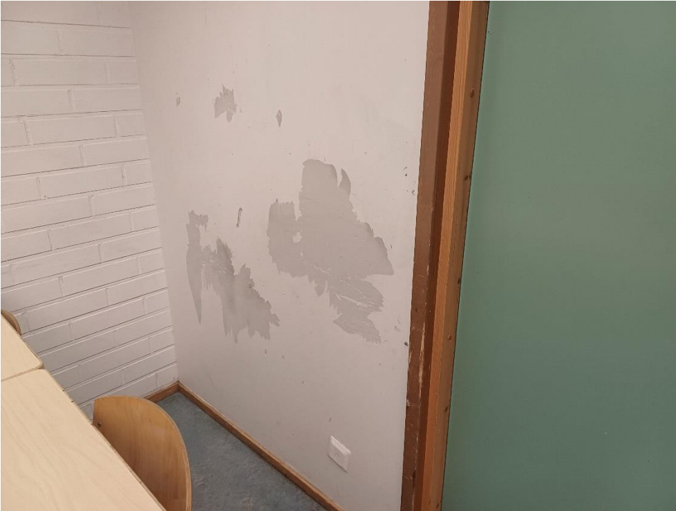
Kuva 4.24. 2154 Luokka, seinien maalipinta irtoilee paikoittain.
