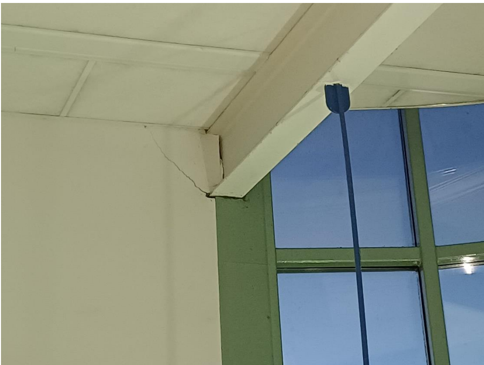
Kuva 4.15. 2101 Porrashuone, teräspalkin seinäliittymä ei ole tiivis ja seinässä on halkeamia.
