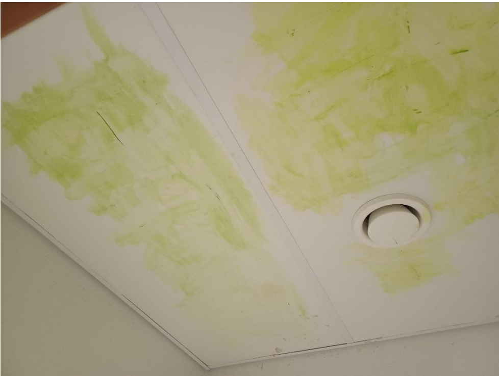
Kuva 4.17. 2113 WC-tila, alakattolevyjä on sotkettu.
