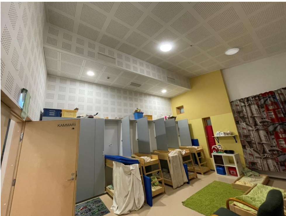
Kuva 5.3. Muutamia lepo- ja leikkotiloja ovat korkeita tiloja sekä tuloilman päätelaitteet ovat katon rajassa.
