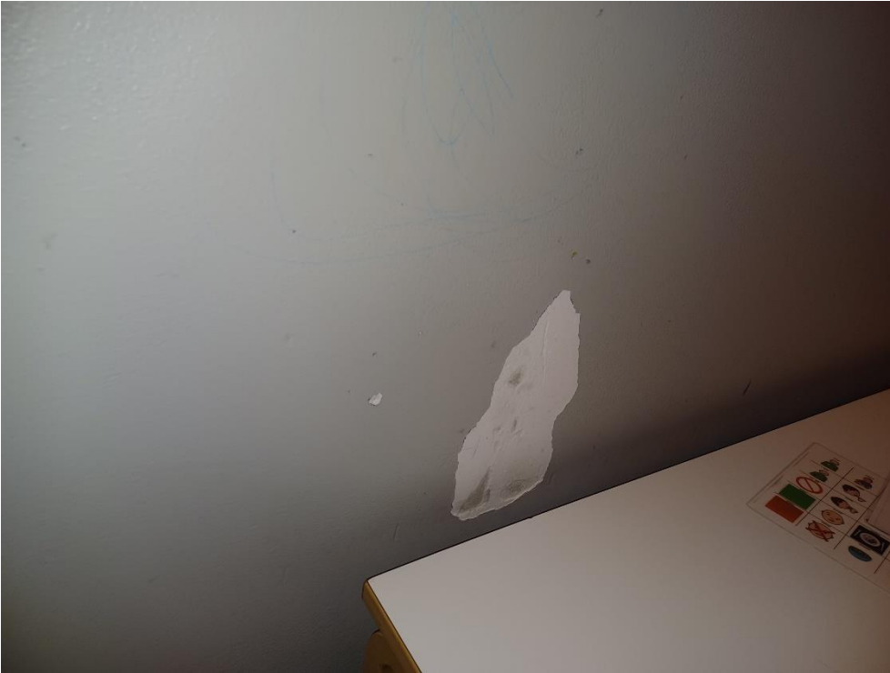
Kuva 4.9. B146 Ryhmätila, seinämaali on irtoillut paikoittain.
