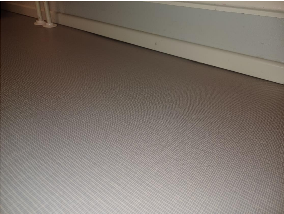
Kuva 4.10. B152.1 Ryhmätila, lattia on painunut alaspäin ulkoseinän osalla.
