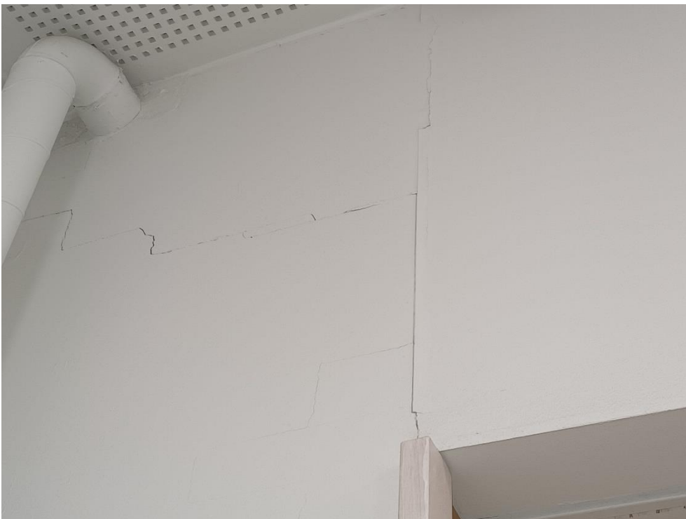
Kuva 4.12. Rakenneliittymien ratkeamia/seinähalkeamia oli seuraavissa tiloissa. A108, A110, A111, A116, A117, A121, A134, A137, B 140, A-osan korkeissa käytävätiloissa
