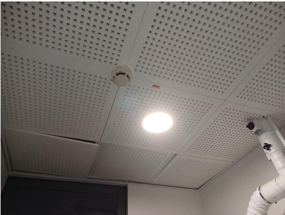
Kuva 4.8. B144 Märkäeteinen, osa alakattolevyistä ei ole kunnolla paikoillaan.
