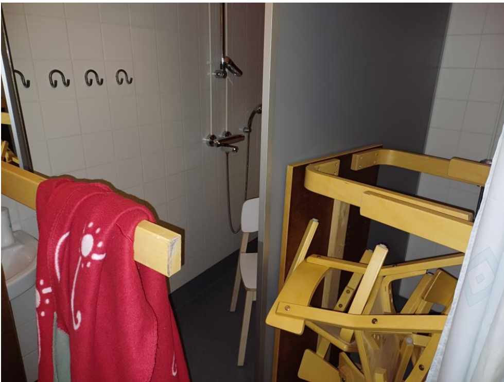
Kuva 5.2. A 129 & 130 sosiaalitilat, ylimääräistä tavaraa lattiakaivojen päällä eikä lattiakaivoja pääse täyttämään.
