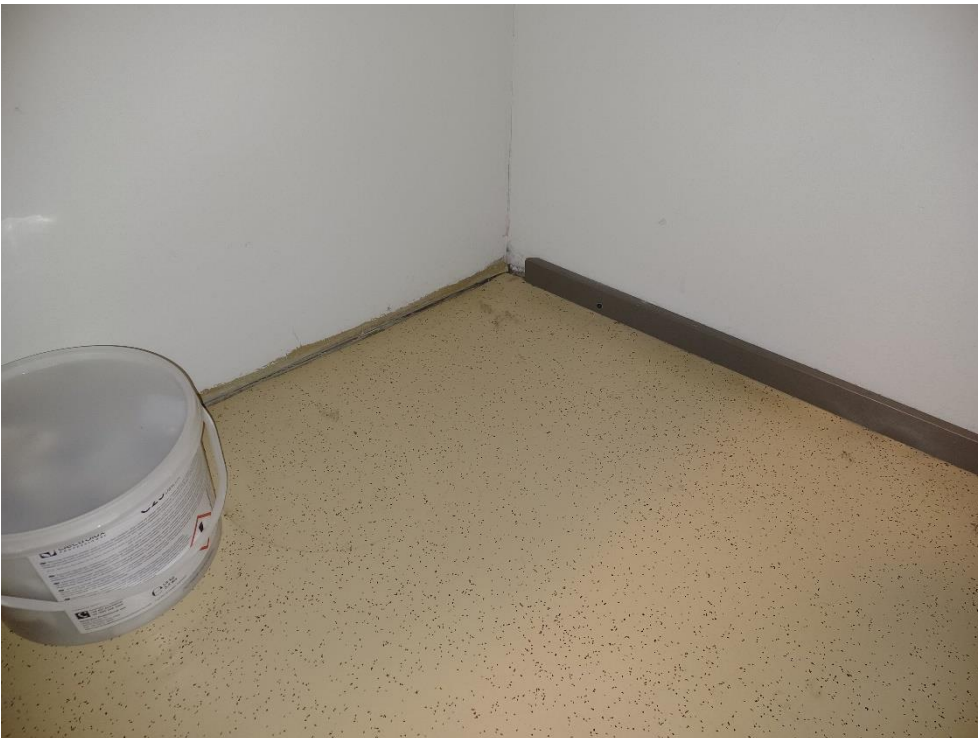
Kuva 4.4. A115 Pikkukeittiö, jalkalistoja puuttuu.
