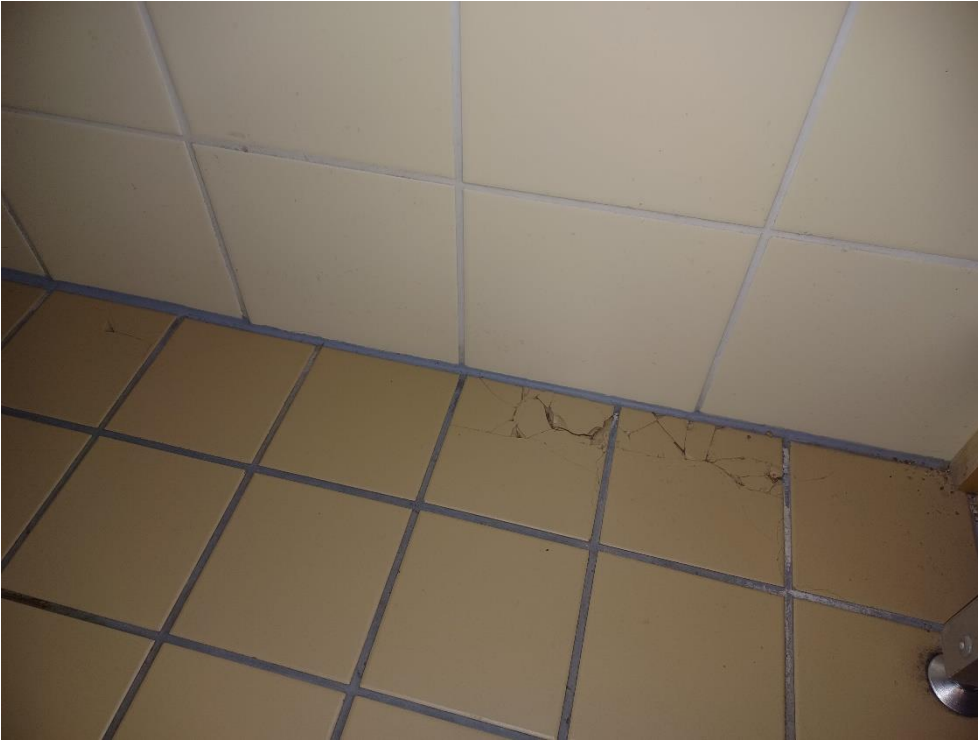
Kuva 4.3. A109 WC/Pesuhuone, lattialaattoja on rikkoutunut.
