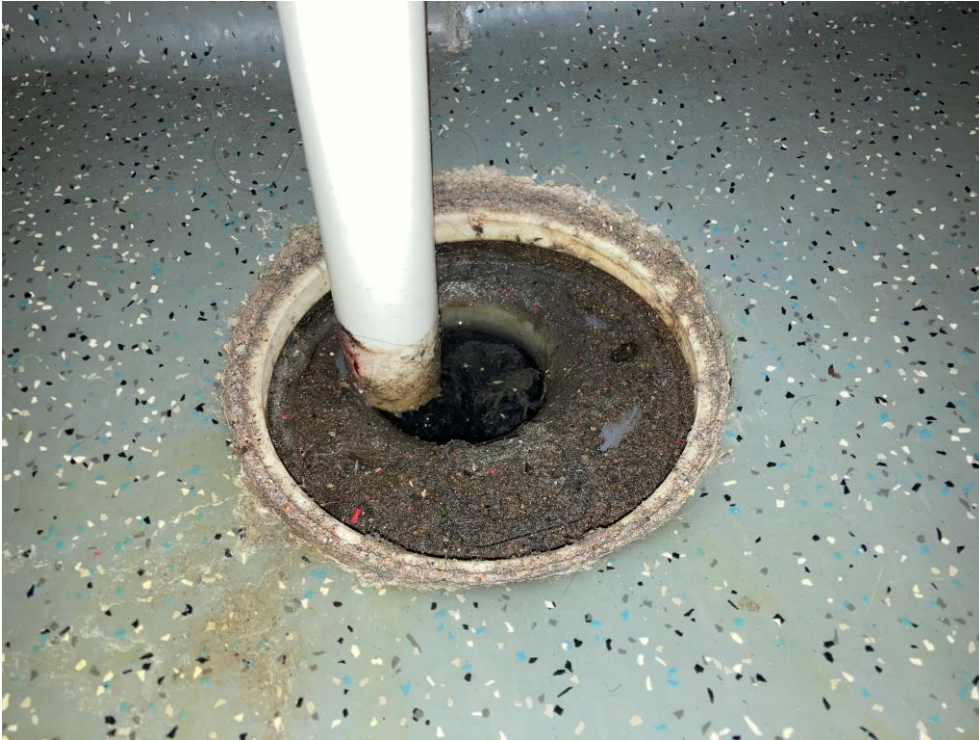
Kuva 5.3. A 128 Siivous, lattiakaivo likainen ja aiheuttaa tunkkaista hajua.
