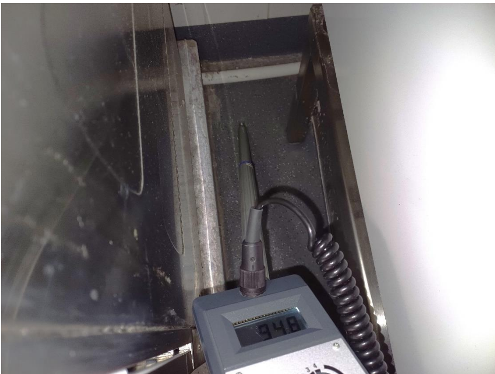
Kuva 4.6. A133 Pyykki, pyykinpesukoneen ympäriltä mitattiin pintakosteudenosoittimella kohonneita vertailuarvoja.
