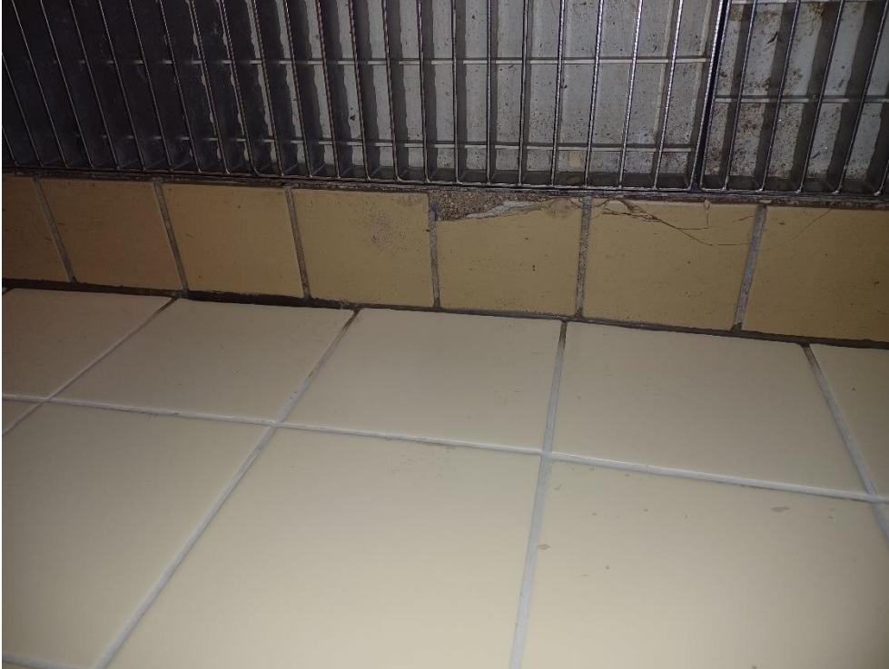
Kuva 4.1. A108 Kuraeteinen, jalkalistalaattoja on rikkoutunut.
