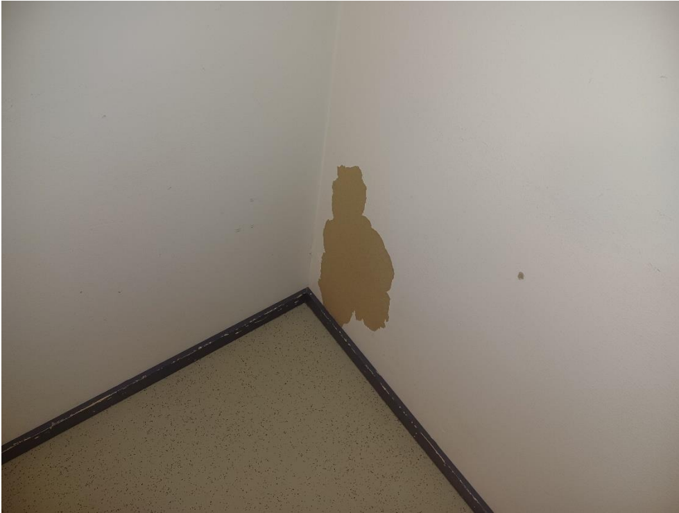
Kuva 4.11. B155 Pienryhmä/Lepo, seinämaali on irtoillut paikoittain.
