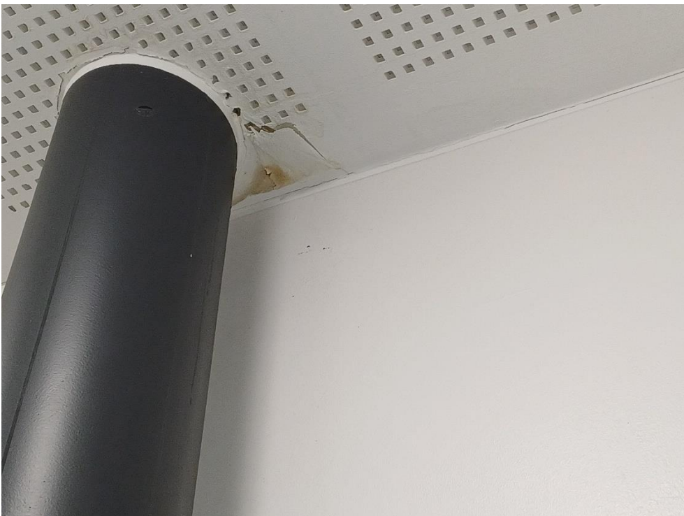
Kuva 4.2. A108 Kuraeteinen, alakattolevytyksessä on teräspilarin läpiviennin kohdalla vesivuodon aiheuttama vauriojälki.
