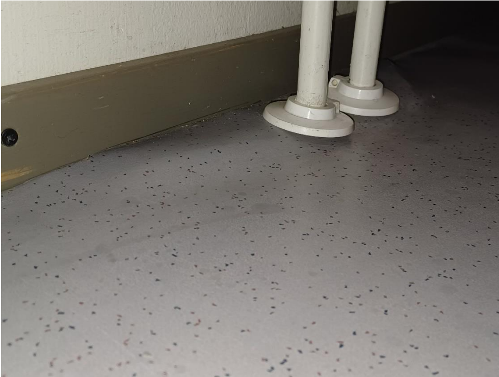
Kuva 4.7. A137 Henkilökunta/Neuvottelu, lattiapinnoite kupruilee patteriputkien läpivientien kohdissa.
