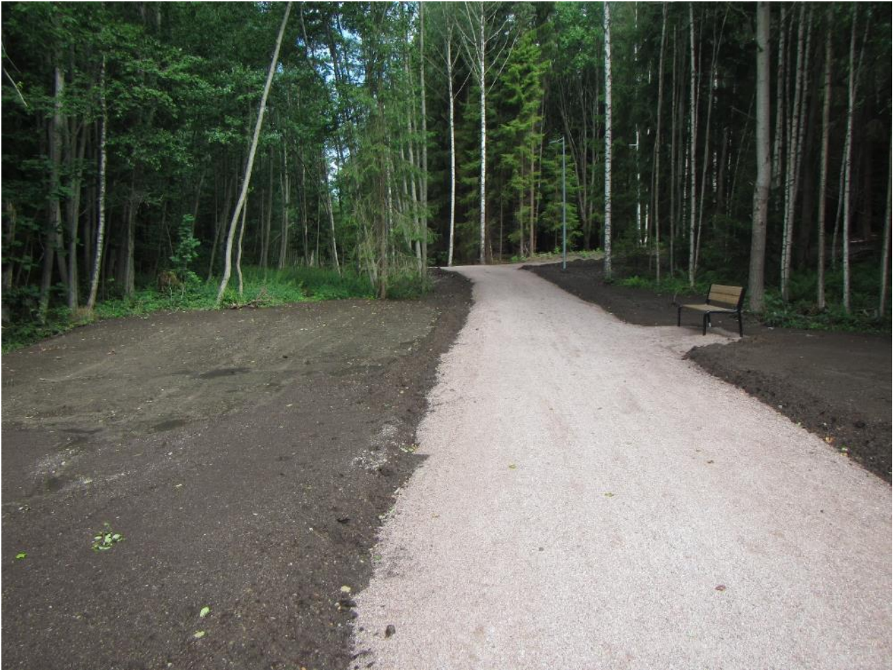
Kuva 17. Finnobäckenin purolehdon poikki rakennetun ulkoilutien varresta on raivattu puustoa monin paikoin aivan puron rantaan asti. Suojaavaa puustoa tulee istuttaa pikaisesti puron varteen. Ulkoilutie on myös valaistu, mikä saattaa häiritä siippojen saalistusta. Älykkään valaistuksen käyttö laajoilla metsäalueilla olisi luonteva keino vähentää valaistuksen häiritsevää vaikutusta.
