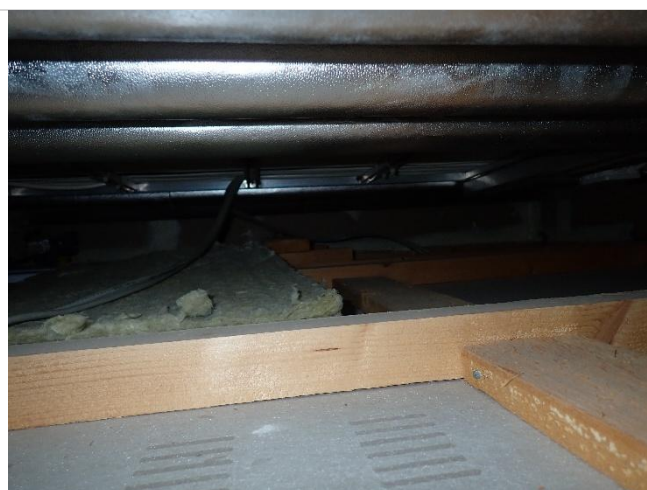
Kuva 13. Taukotilan 134 alakattorakenteessa todettiin irtonainen mineraalivillalevy. Alakaton päältä otetussa vanhan pölyn pölynkoostumusnäytteessä todettiin runsaasti mineraalikuituja (PP3).
