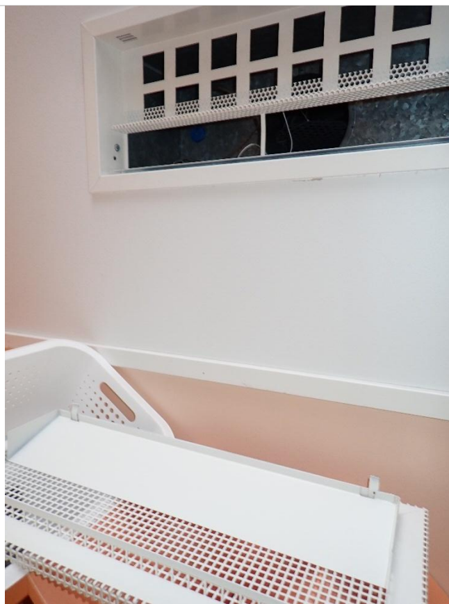
Kuva 5. Käytävän 112 tuloilmakanavan sisäpinnalta otettiin geeliteippinäyte KK3, jossa mineraalikuitupitoisuus oli vähäinen: 2,79 kuitua/cm 2 .
