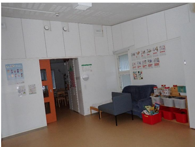
Kuva 16. Tilassa 104 tuloilman ulkoseinän viereisen päätelaitteen heittokuvio on suoraan kaapin päälle, jonka vieressä on vanhoja akustiikkalevyjen jäämiä seinässä.
