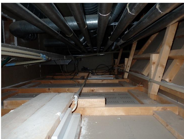
Kuva 12. Käytävän 112 alakaton yläpuolista tilaa. Alakaton ja muiden rakenteiden päällä on paljon rakennuspölyä. Pölyä oli niin paljon, että geeliteippinäytteestä ei laboratorio pystynyt analysoimaan mineraalikuitupitoisuutta. Puhdistetusta alakattolevyn huopamaisesta päällisestä irtosi vain vähän mineraalikuituja (KK6: 3,71 kuitua/cm 2 .)
