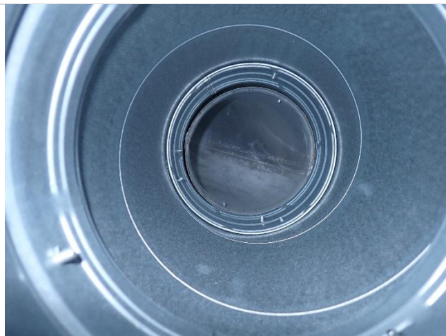
Kuva 7. Liikuntasalin 137 tuloilmakanavan sisäpinnalta otettiin geeliteippinäyte KK4, tulos: 15,79 kuitua/cm 2 . Tulos on Työterveyslaitoksen aineiston perusteella tavanomainen.
