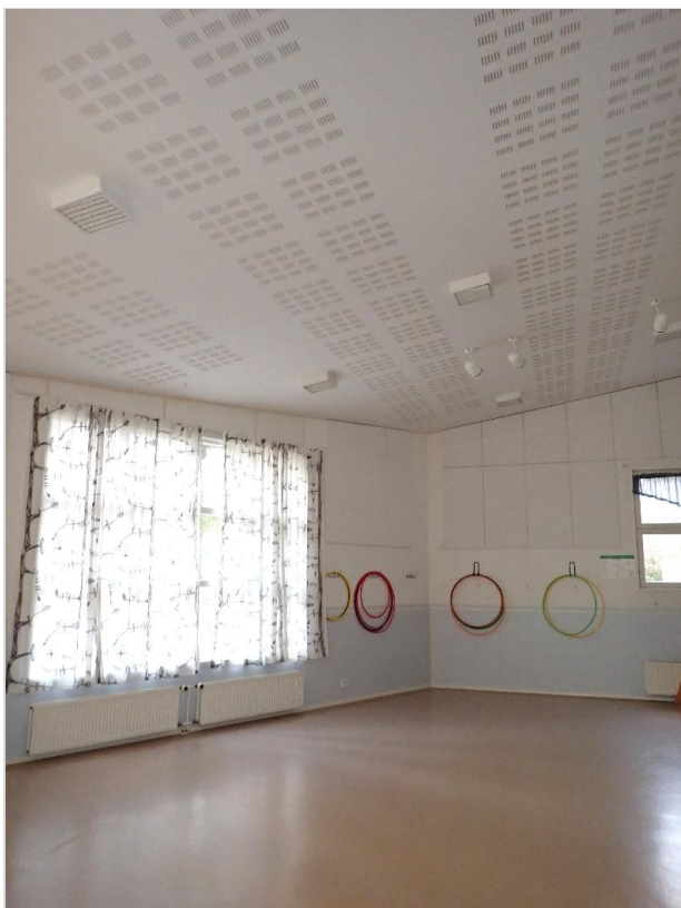
Kuva 10. Rakennuksen A katossa on paljon akustoivia kipsilevyjä (Saint-Cobain Oy:n Gyptone -levy). Liikuntasalin koko katossa on kyseistä materiaalia ja kipsilevyjen päällä on lämpökamerakuvauksen perusteella mineraalivillalevyjä.
