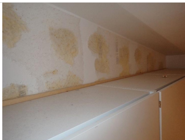
Kuva 17. Tilan 104 kaappien päällä todettiin paljon vanhaa pölyä. Kaapin päältä puhdistettiin alue ja 16 vrk:n jälkeen uudesta pölystä otettiin pölynkoostumusnäyte (PP1). Näytteessä ei havaittu mineraalikuituja.
