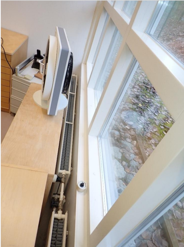
Kuva 18. Rakennuksen A useassa tilassa on ilmanpuhdistimia (ainakin kolme erilaista mallia). Aulatilassa 136 ilmanpuhdistin puhalttaa poistoilman suoraan mm. pattereihin, joissa havaittiin pölyä.
