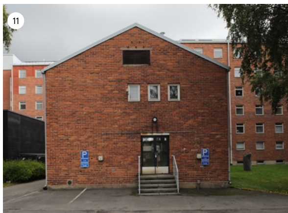
Kivimuseon alkuperäinen sisäänkäynti Kivimiehentien puolelta. Ilmanvaihtoritilä on lisätty myöhemmin.
