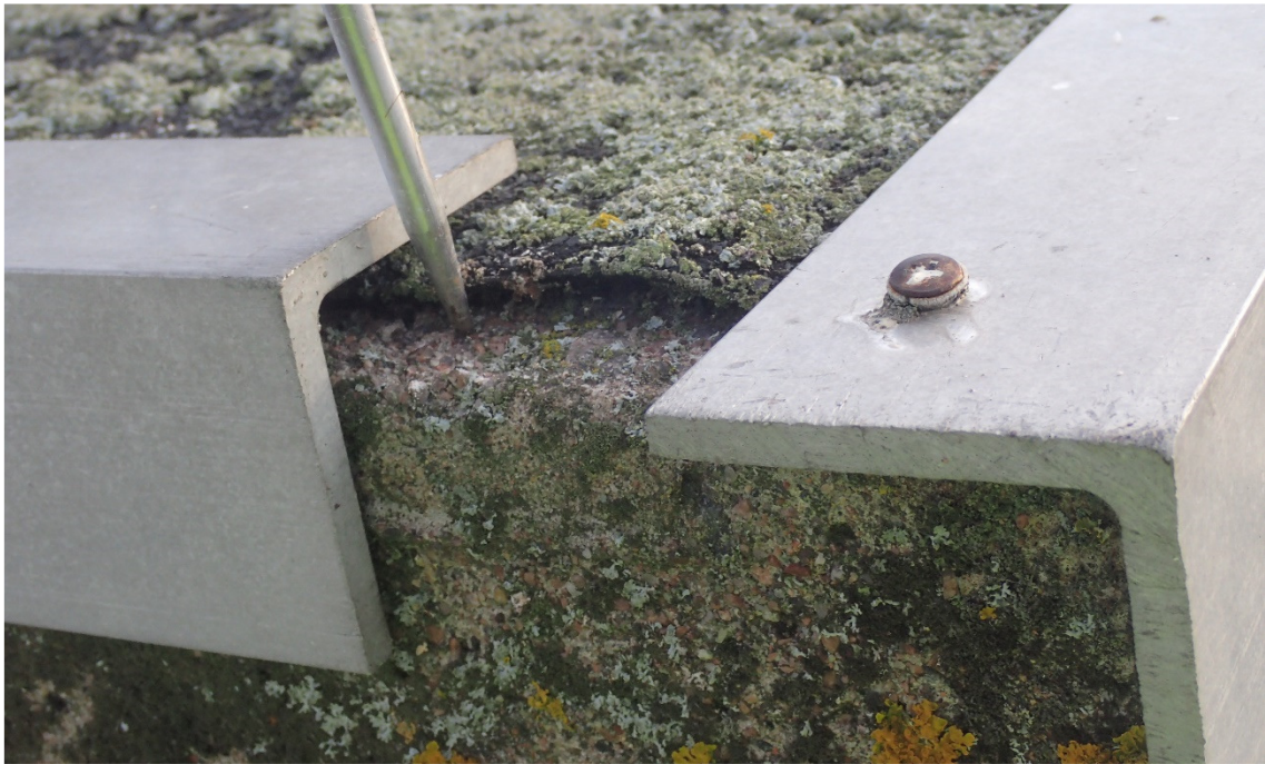
Kuva x: Tornin vesikaton kulma. Ylemmän betonilaatan pinta on rapautunut. Suunnitelmasta poiketen tässä on bitumikermi laatan pinnalla.
