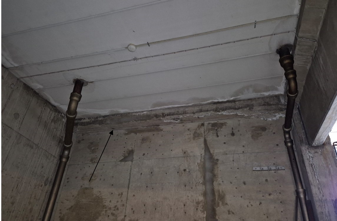
Kuva 15: Länsijulkisivun liitos betonirungon saapaspalkin päällä. Muurauksen eristetilaan päätynyt vesi on kuviteltu ohjattavan ulos rakenteesta ilmaraon kohdalla olevalla saapaspalkin läpi ulottuvalla kupariputkella. Vettä tulee läpi kaikkialta muualta paitsi suunnitellusta kupariputkesta. Eristetilaan päässyt vesi tulee näkyviin valtaosin saapaspalkin pintaa pitkin ja myös Siporex-palkkikaton kautta kapillaarisesti. Valurataputket lienevät kellarikerroksen viemärintuuletusputkia, vertaa kuva 7 sman kohdan yläpuolelta.
