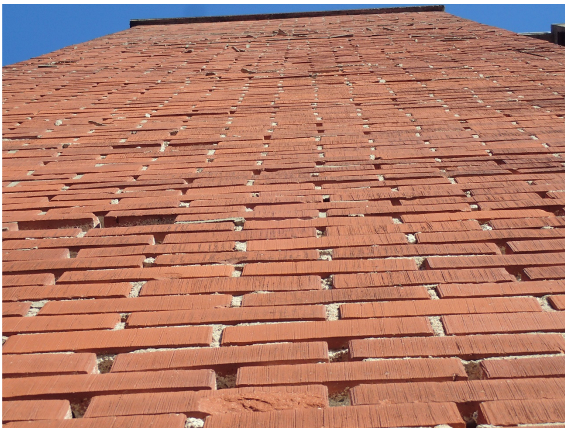
Kuva 14. Julkisivun pinta oli muodoltaan aaltomainen. Sidelankojen irrotessa laastista voi ilmetä sortumia rapautuneessa muurauksessa.
