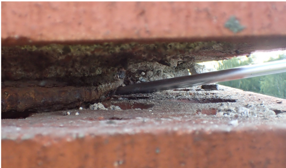
Kuva 11. Lähikuva tornin kulmasta. Teräksen poikkileikkaus on ohentunut korroosion vaikutuksesta.
