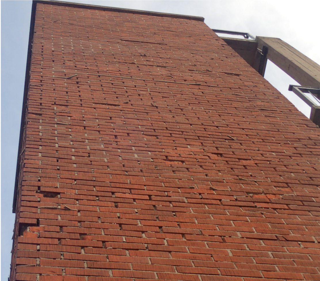
Kuva 8. Kovemmalla laastilla tehdyt jälki tai korjausmaukset nousevat ulos tiiltä välistä. Eteläjulkisivulla oli paljon lohkeamassa olevia tiilipintoja.
