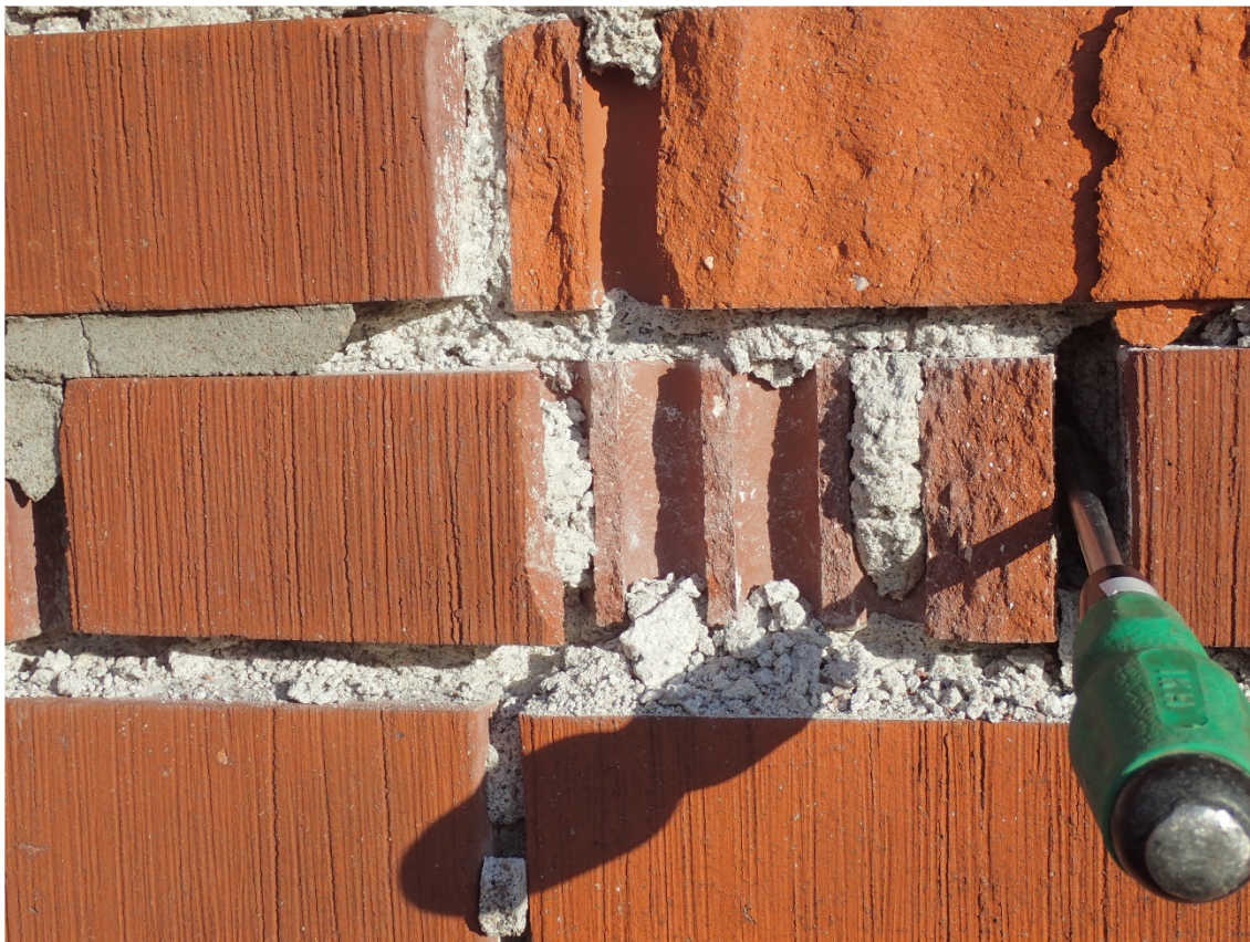
Kuva 13. Eri syvyyksiltä lohjenneita tiilipintoja ja erilaisia laasteja. Meisselin sai työnnettyä läpi nokkalaastista.
