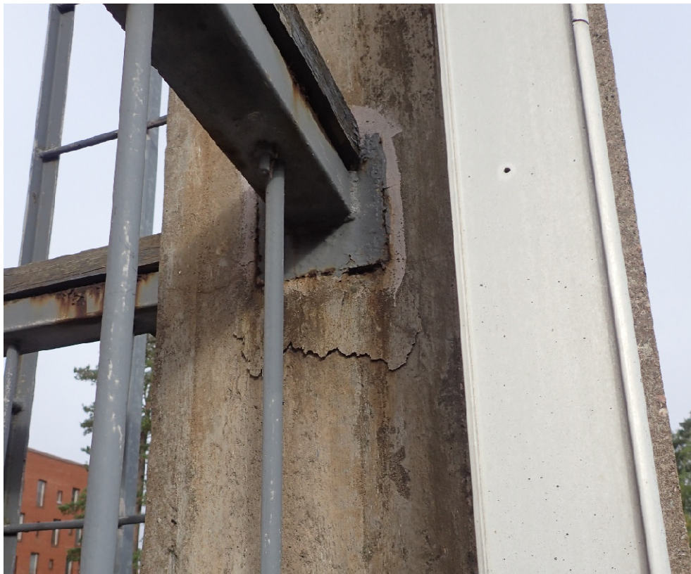
Kuva 22. Pinnakaiteen putkipalkki on repinyt irti pilarin pintaa.
