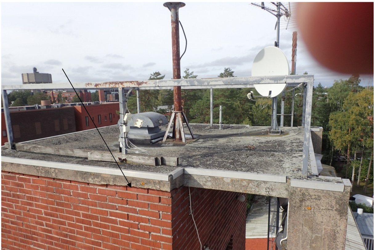
Kuva 25: Tornin vesikattoa etelästä kuvattuna. Räystäällä jossakin vaiheessa asennettu vedeneriste on katkaistu betonirakenteiden yläsärmästä ja kiinnitetty alumiinikulmilla. Kermin pinnalla kasvaa jäkälää. Nuolen kohdalla laatan alareunan betonista on pudonnut pitkä kappale.
