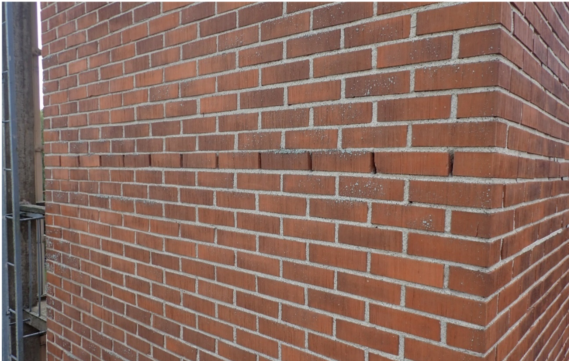
Kuva 5. Vasemmalla tornin jäkäläpintaista pohjoisjulkisivua. Tornin keskellä kiersi vaakasauma, jossa ei ollut käytetty nokkalaastia. Tarkoituksen on ollut eristetilan tuulettaminen. Autohallien vesikaton yläpuolella oli samaan tapaan avosaumat. Pohjoissivu on säärasituksen suhteen suojaisin ja ulkonäöltään parhaassa kunnossa.
