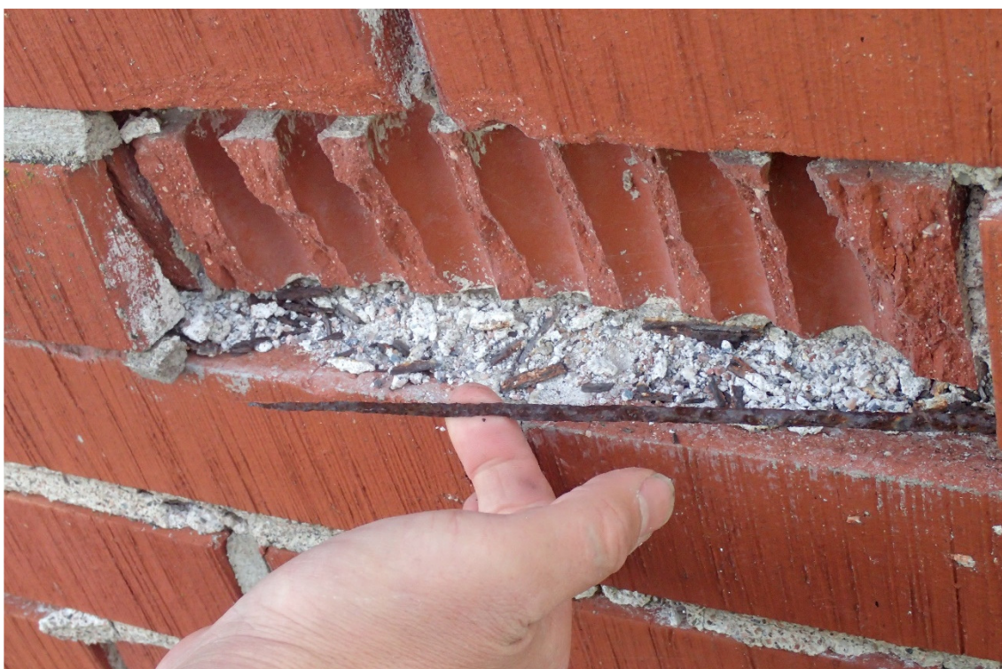
Kuva 12. Saumojen rengasteräket korroosoituvat olemattomiin.
