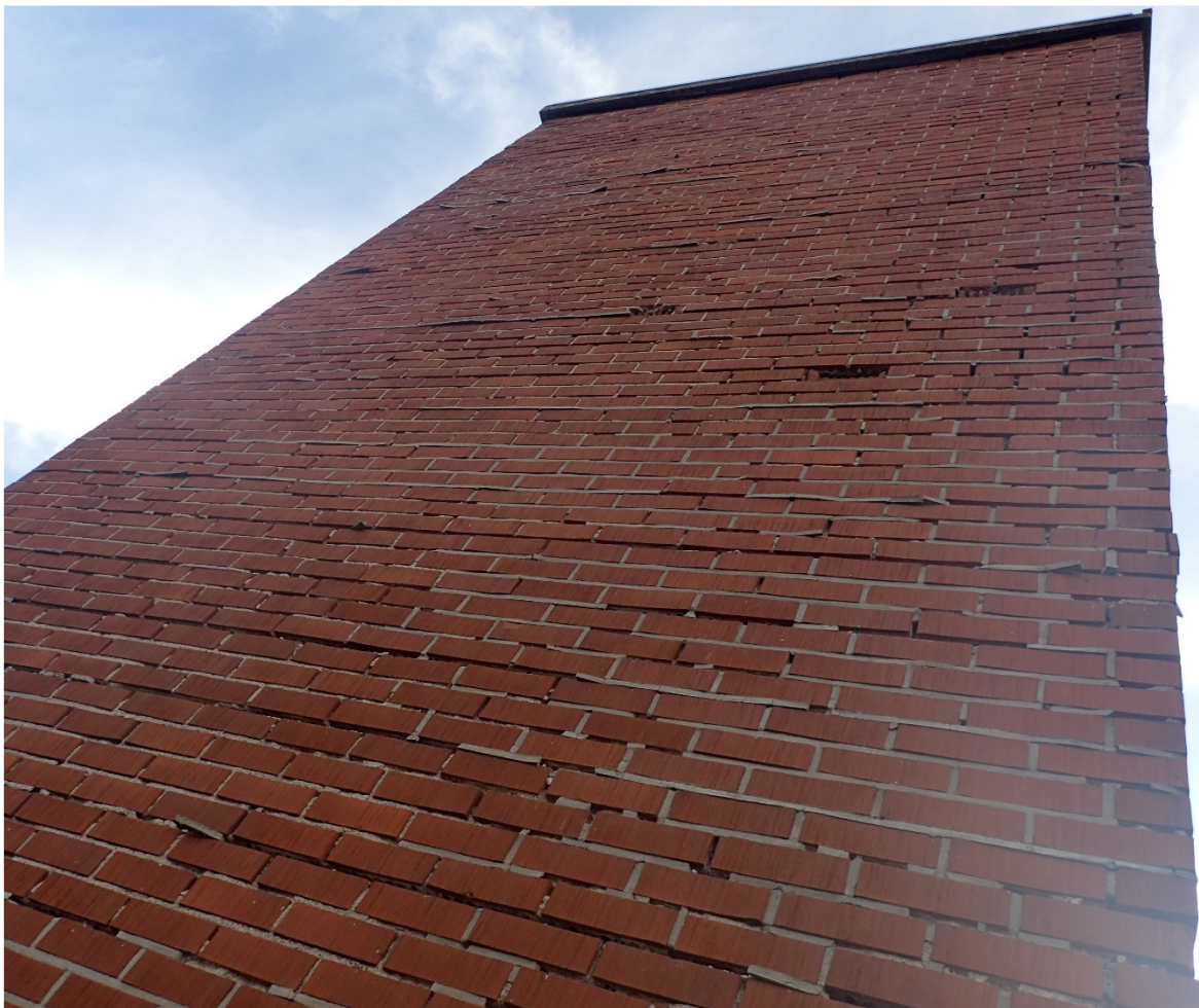
Kuva 9. Länsijulkisivu oli samalla tavalla vaurioitunut.
