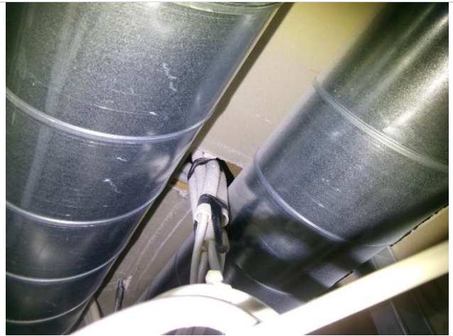
Kuva 10. Yläpohjaan meneviä läpivientejä oli tiivistämättä.
