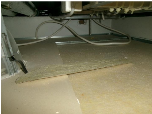
Kuva 5. Alaslaskettujen kattojen yläpuolisessa tilassa oli rakennusaikaista roskaa.
