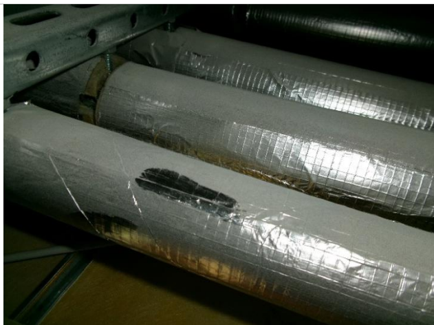
Kuva 6. Alaslaskettujen kattojen yläpuolisessa tilassa, taloteknisten järjestelmien pinnoilla oli runsaasti pölyä.
