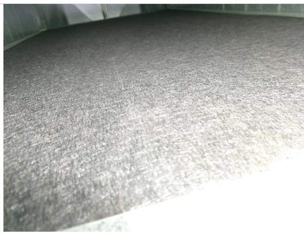
Kuva 14. Ilmanvaihtokonehuoneessa tuloilmakanavan lamelli äänenvaimentimen materiaalin päällä on lasihuopapinnoite.
