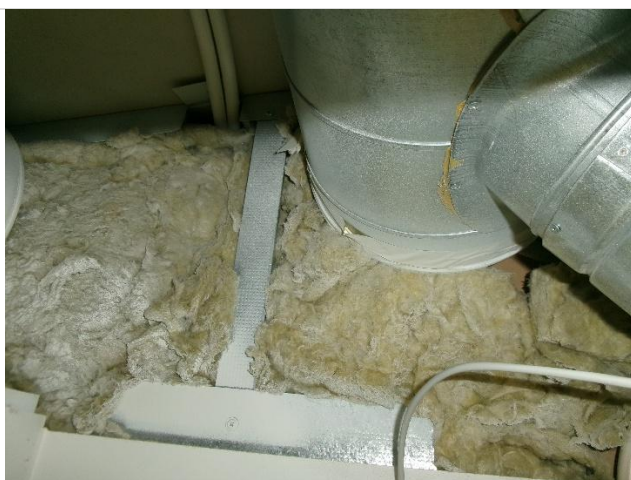
Kuva 8. Alaslaskettujen kattojen yläpuolisessa tilassa oli suojaamattomia mineraalivillapintoja
