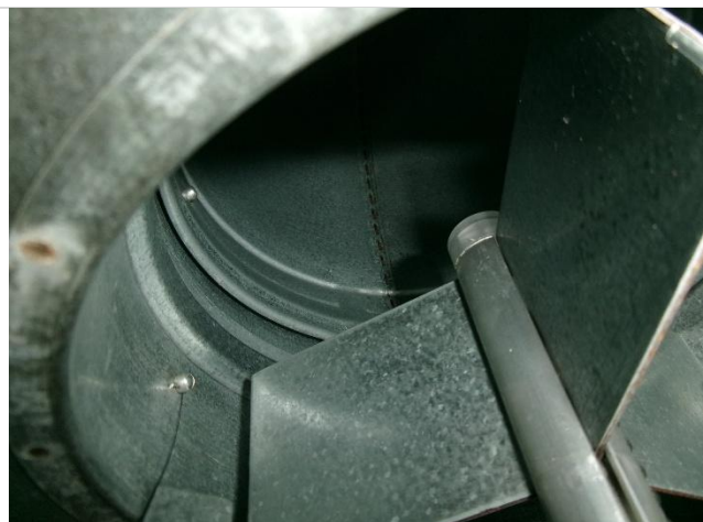
Kuva 12. Ryhmähuone 2, 16 tuloilmakanava oli visuaalisen arvioinnin perusteella puhtas.
