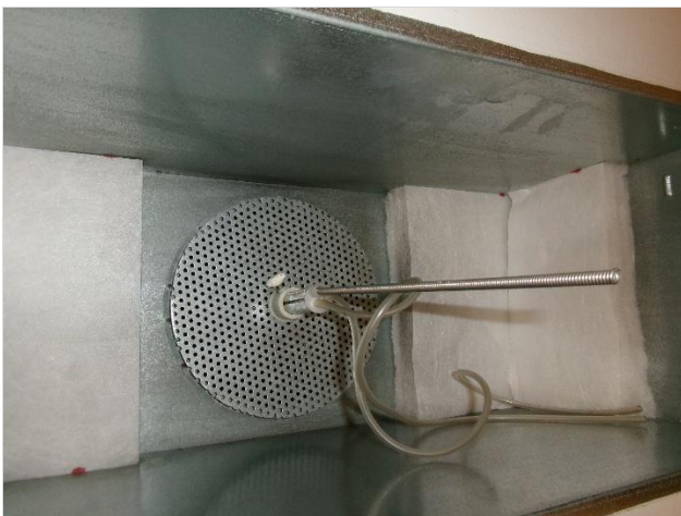
Kuva 11. Ryhmähuone 2, 16 tuloilmakanavan päätelaitteesta otettiin geeliteippinäyte. Päätelaitte oli visuaalisen arvioinnin perusteella puhtas.
