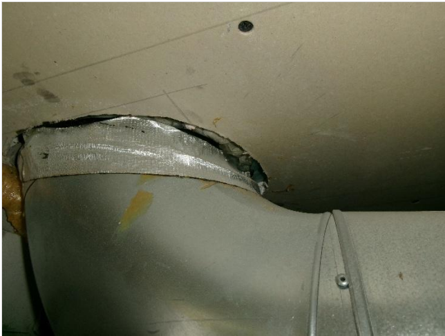
Kuva 9. Yläpohjaan meneviä läpivientejä oli tiivistämättä.
