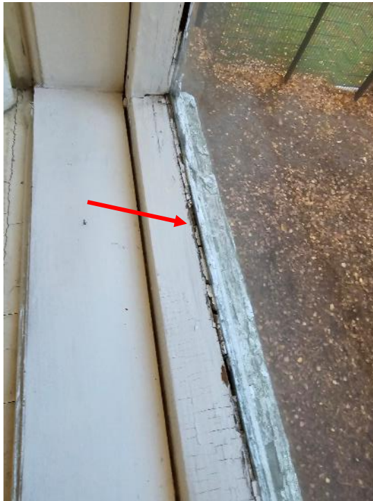
Kuva 67. Lasituskittausvaurioita havaittiin myös ikkunoiden välitilassa.
