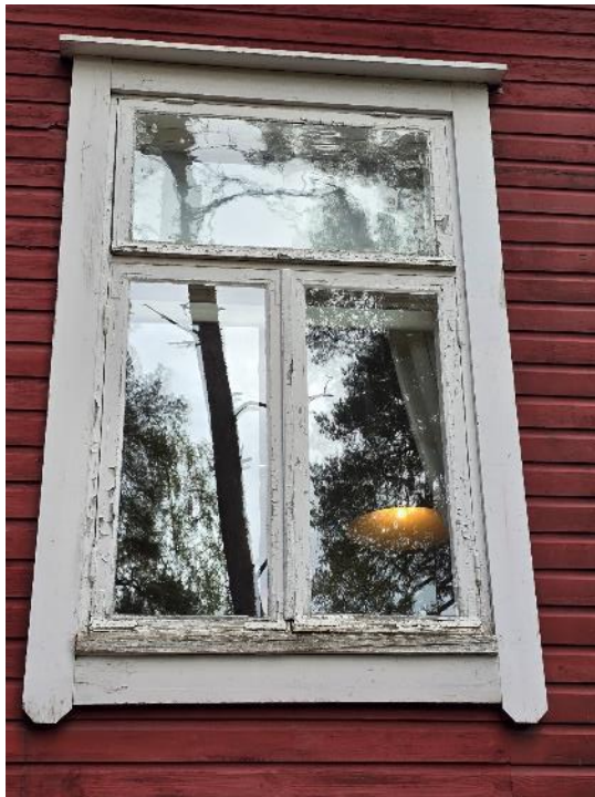
Kuva 42. Ikkunarakenteiden ulkopintojen maalipinnat ovat heikossa kunnossa.
