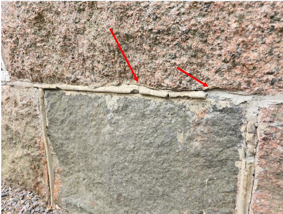
Kuva 39. Sokkelin laastisaumoissa havaittiin irtoilua ja halkeilua.
