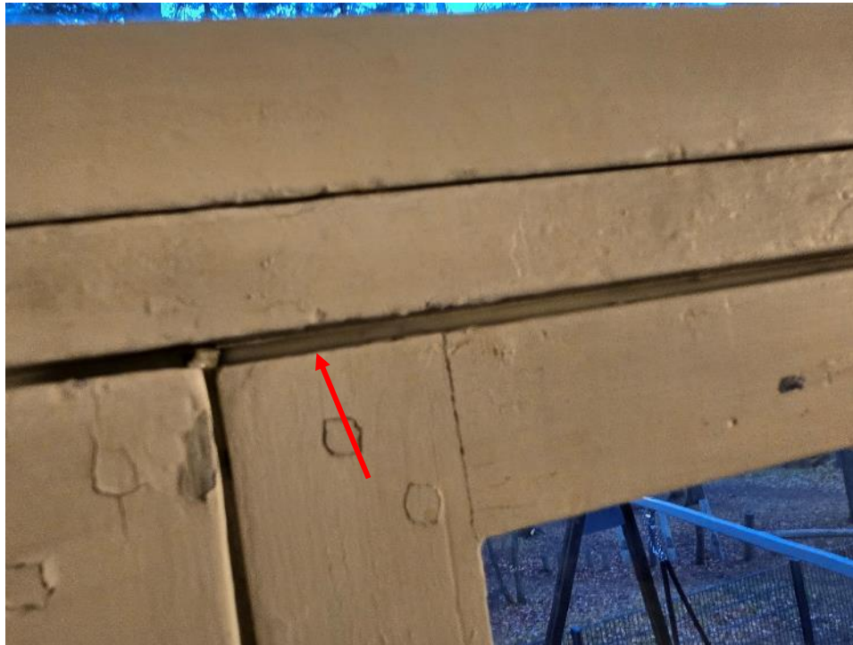
Kuva 63. Ikkunapokien ja karmien välillä havaittiin leveitä rakoja.
