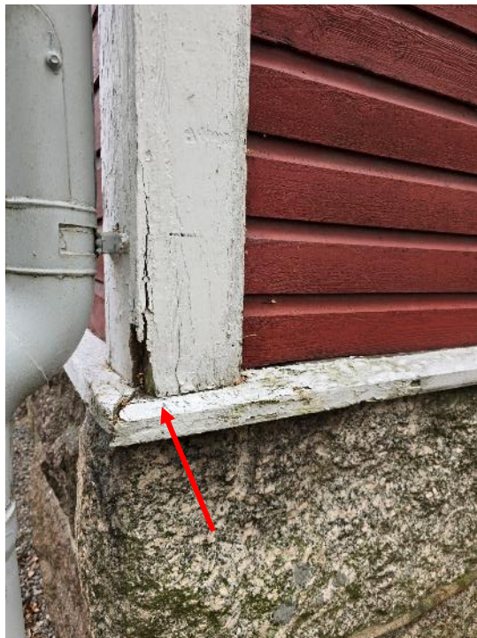
Kuva 24. Rakennuksen kulmalaudoissa havaittiin pinnoitevaurioita ja lahovaurioita.
