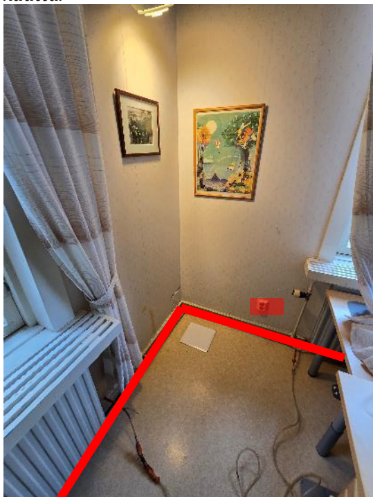
Kuva 142. Johtajan huoneessa havaittiin ilmavuotoa lattioidenraajapinnoilta ja pistorasian kautta.
