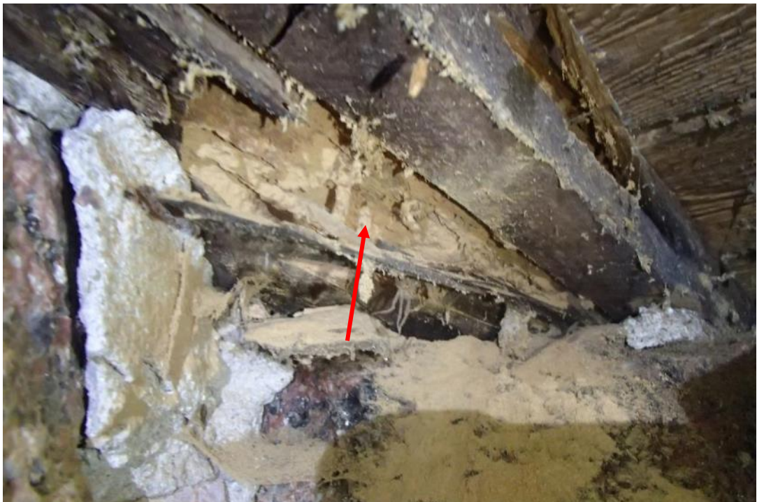
Kuva 104. Alapohjan runkokuissa havaittiin lahovaurioita.
