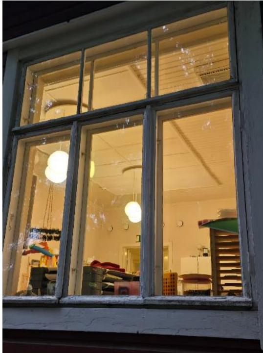
Kuva 43. Ikkunarakenteiden ulkopintojen maalipinnat ovat heikossa kunnossa.
