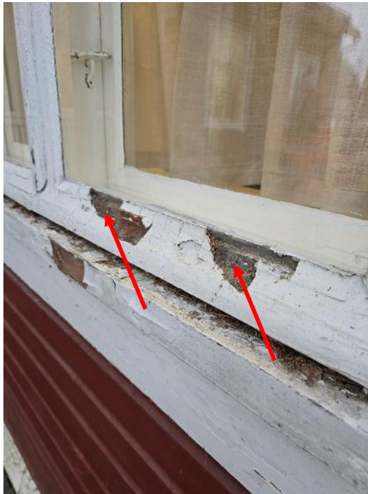
Kuva 65. Ikkunoiden lasituskittaukset ovat irtoilleet ja halkeilleet.
