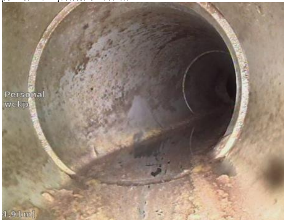
Kuva 118. Lievä kaltevuuspoikkeama 4,9 metrin kohdalla.
