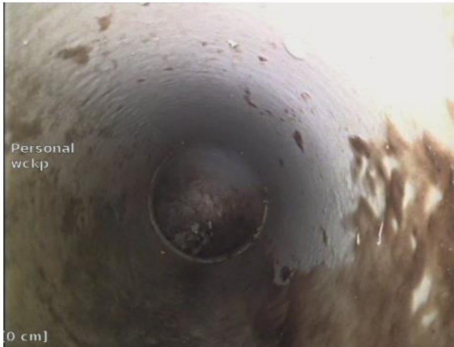
Kuva 117. Vessan pohjaviemäreissä havaittiin lieviä kaltevuuspoikkeamia. Kaltevuuspoikkeamia (5 %) havaittiin 4,9–5,5 metrin kohdalla sekä 12,2–13,1 metrin kohdalla. Muita poikkeamia linjastossa ei havaittu.
