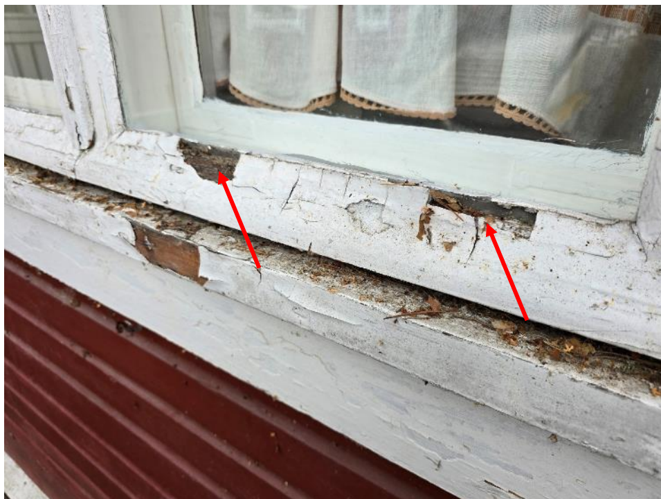
Kuva 64. Ikkunoiden lasituskittaukset ovat irtoilleet ja halkeilleet.
