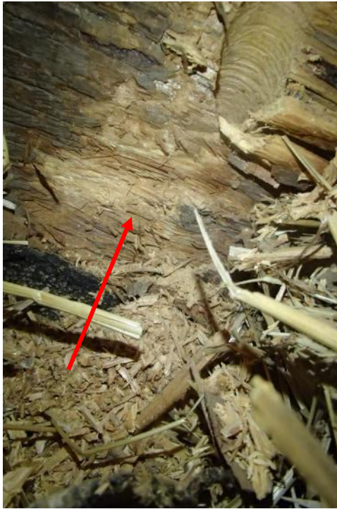
Kuva 89. Paikoin alapohjan eristetilan runkopuissa havaittiin lahovaurioita.
