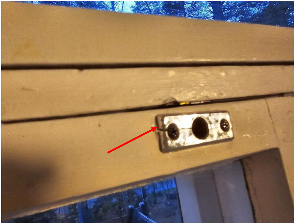
Kuva 75. Ikkunoiden heloituksia on rikkoutunut.
