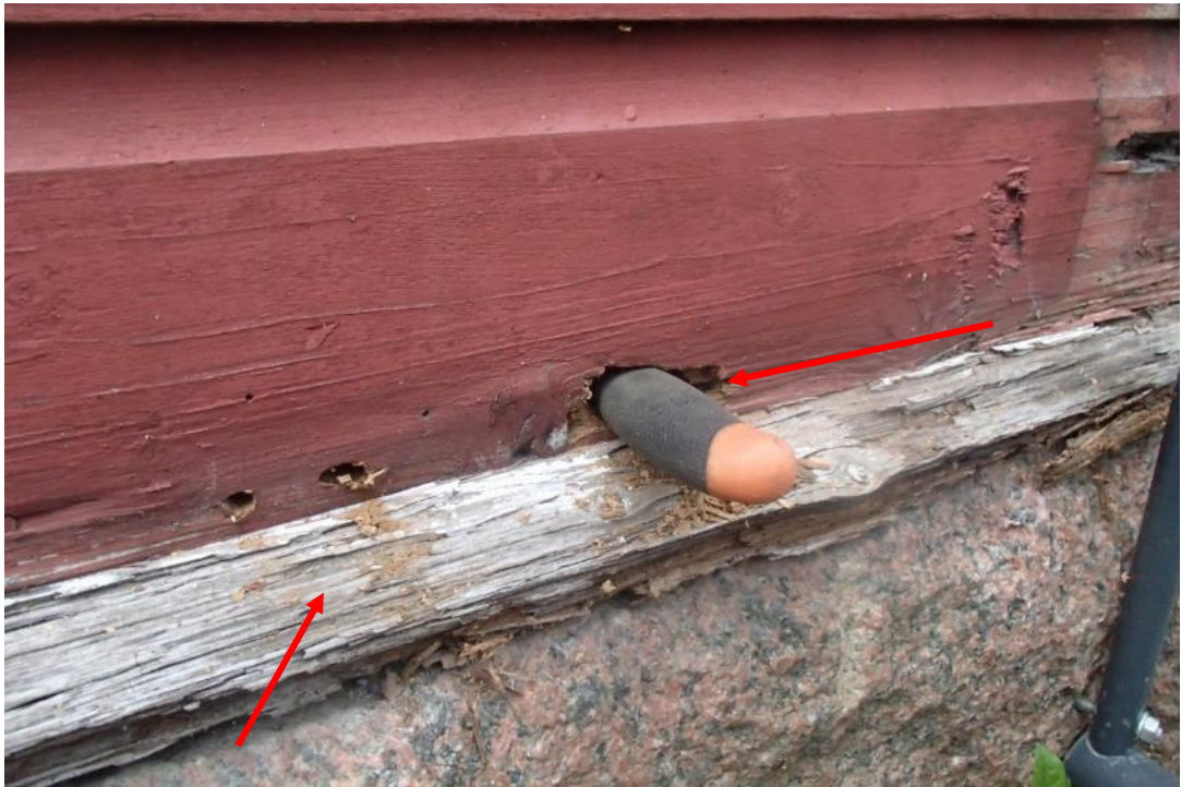
Kuva 11. Ulkoverhouksen alaosissa havaittiin maali- ja lahovaurioita.
