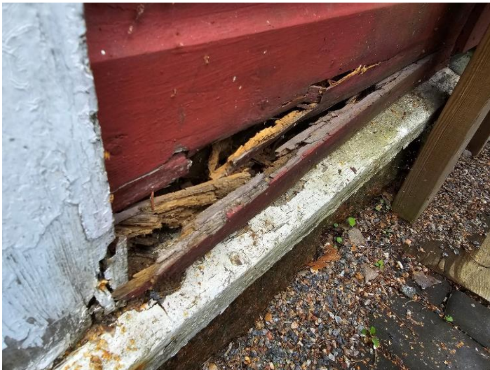
Kuva 10. Ulkoverhouksen alaosissa havaittiin maali- ja lahovaurioita.
