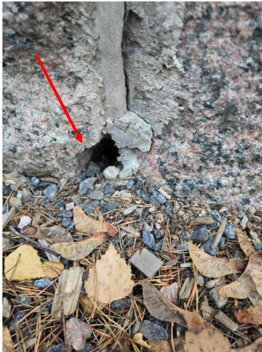
Kuva 41. Sokkelin alaosissa havaittiin reikiä rakenteisiin.
