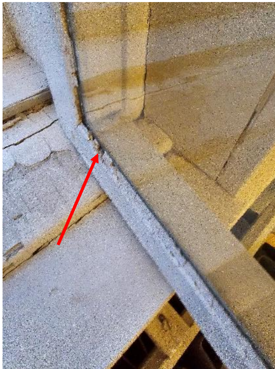
Kuva 68. Lasituskittausvaurioita havaittiin myös ikkunoiden välitilassa.
