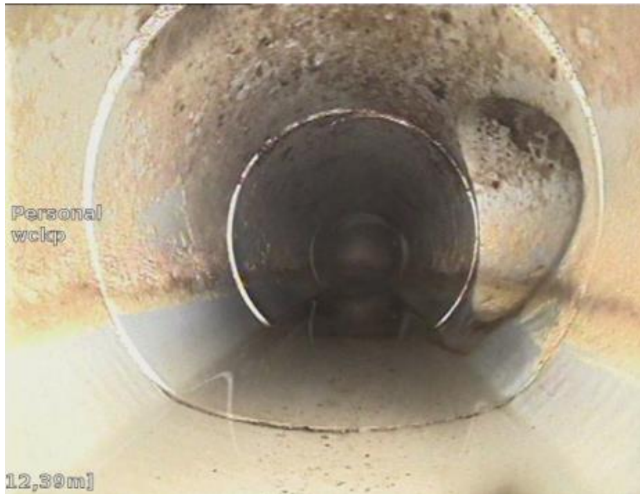
Kuva 119. Lievä kaltevuuspoikkeama 12,39 metrin kohdalla.
