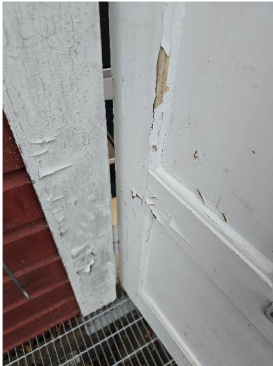
Kuva 79. Rakennuksen ovien maalipinnoilla havaittiin vaurioitumista.
