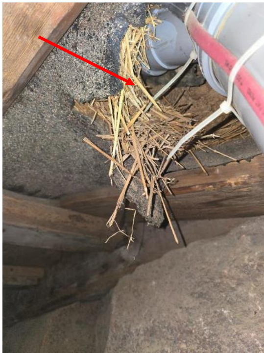
Kuva 90. Alapohjassa havaittiin avoimia läpivientejä.
