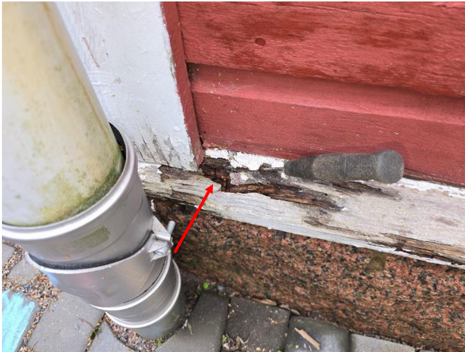
Kuva 9. Ulkoverhouksen alaosan tippalaudoissa havaittiin maali- ja lahovaurioita.
