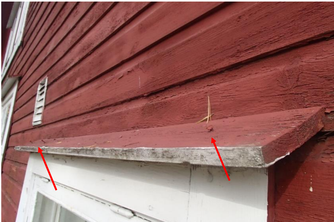
Kuva 28. Ikkunoiden yläosien tippalautojen naulat irtoilevat naulan suuntaisesti.
