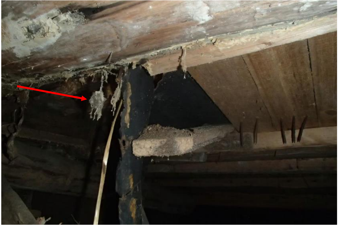
Kuva 91. Alapohjassa havaittiin avoimia läpivientejä ja vaurioita.
