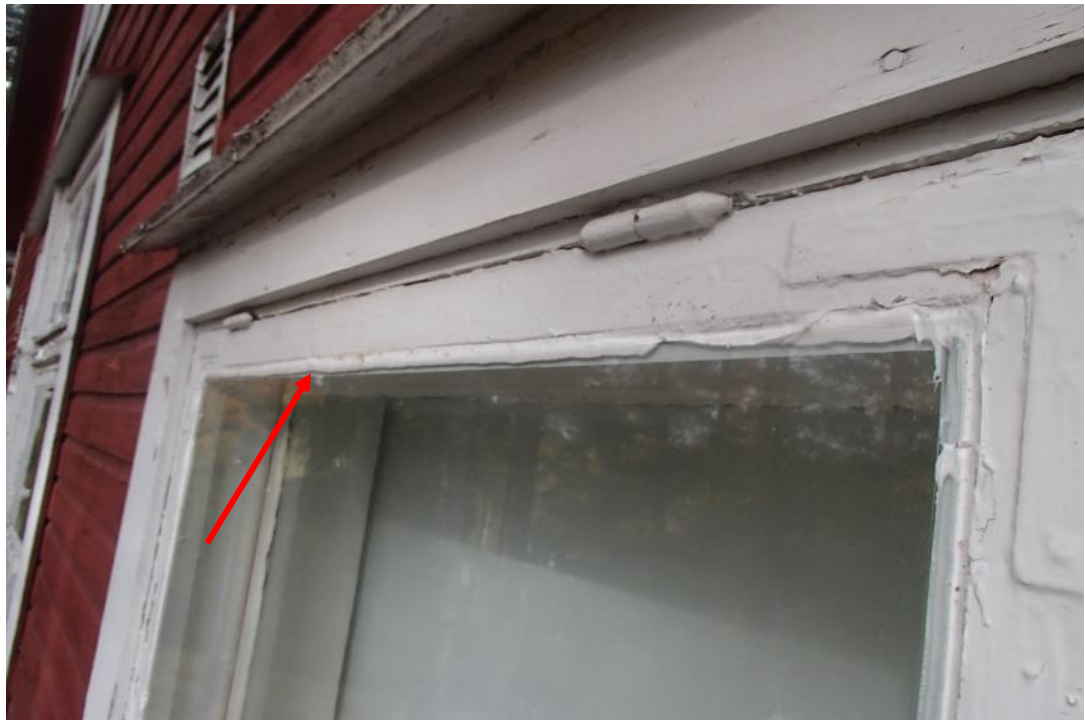
Kuva 66. Vaurioituneita lasituskittauksia on korjailtu liimamassalla.
