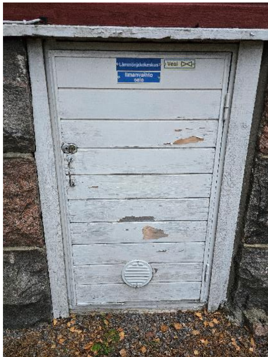
Kuva 78. Rakennuksen ovien maalipinnoilla havaittiin vaurioitumista.
