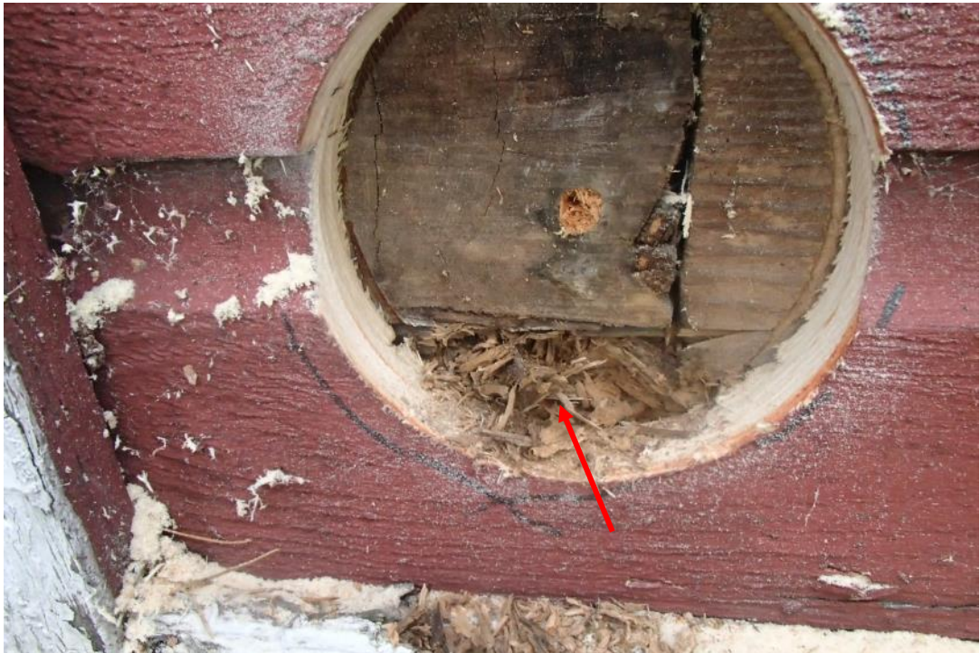
Kuva 17. Hirsirungon alaosissa havaittiin laho- ja hyönteisvaurioita.
