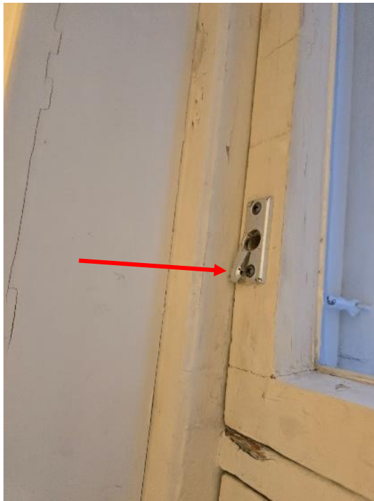
Kuva 74. Ikkunoiden heloituksia on rikkoutunut.
