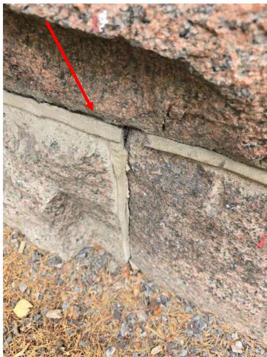
Kuva 40. Sokkelin laastisaumoissa havaittiin irtoilua ja halkeilua.
