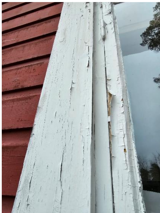
Kuva 26. Ikkunoiden vuorilaudoissa havaittiin maalivaurioita.
