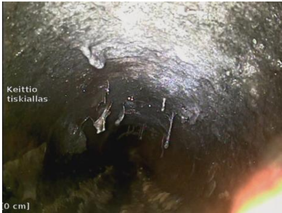
Kuva 116. Keittiön tiskialtaalta lähtevässä pohjaviemärissä ei havaittu poikkeamia. Linjastossa likaa, rasvaa ja ylimääräisiä jäämiä.
