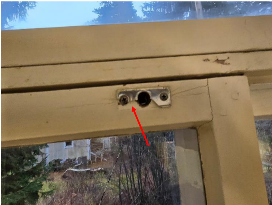
Kuva 76. Ikkunoiden heloituksia on rikkoutunut.
