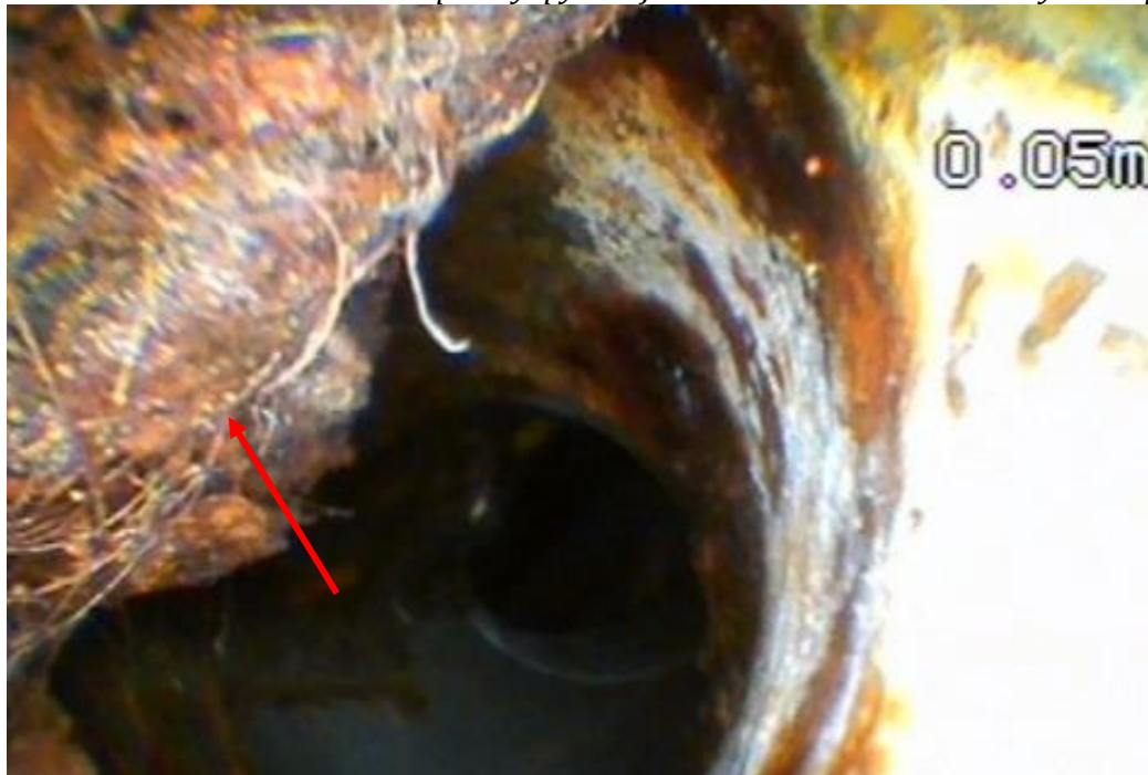
Kuva 114. Henkilökunnan pukuhuoneen suihkuhuoneen kaivon hajulukon jälkeen on havaittavissa irtonaista ruostetta.
