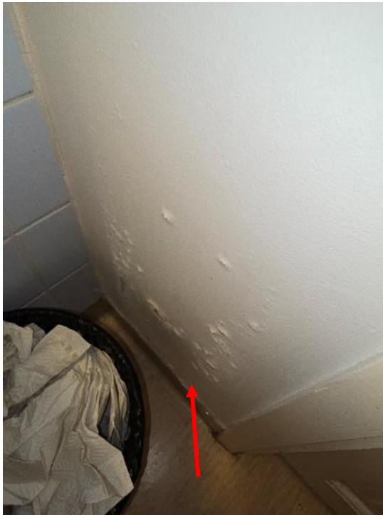
Kuva 133. Paikoin sisätilojen lastulevyt ovat turpoilleet.
