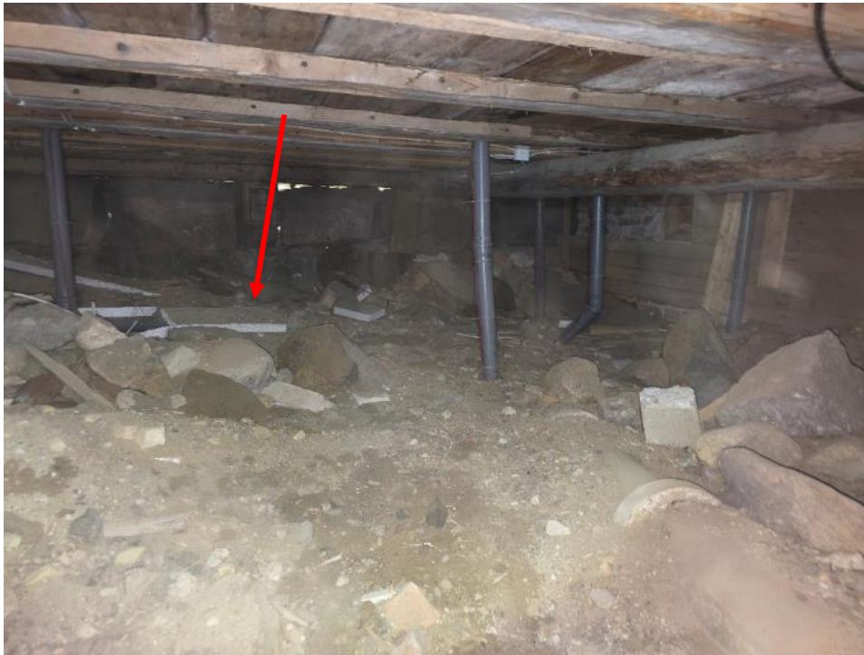
Kuva 95. Ryömintätilassa havaittiin ylimääräistä jätettä ja puumateriaalia.
