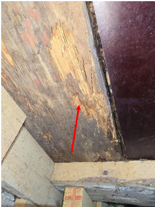
Kuva 102. Alapohjan runkokuissa havaittiin lahovaurioita.
