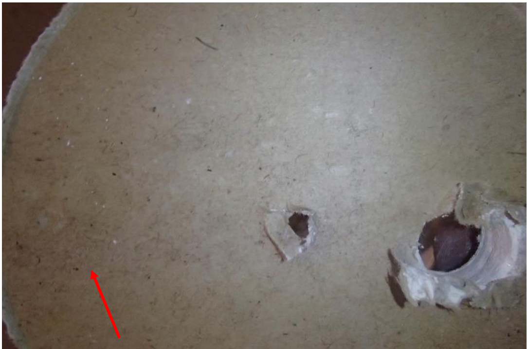
Kuva 34. Sisäpuolen kipsilevyjen kartonkipinnoilla havaittiin lievää tummentumista.
