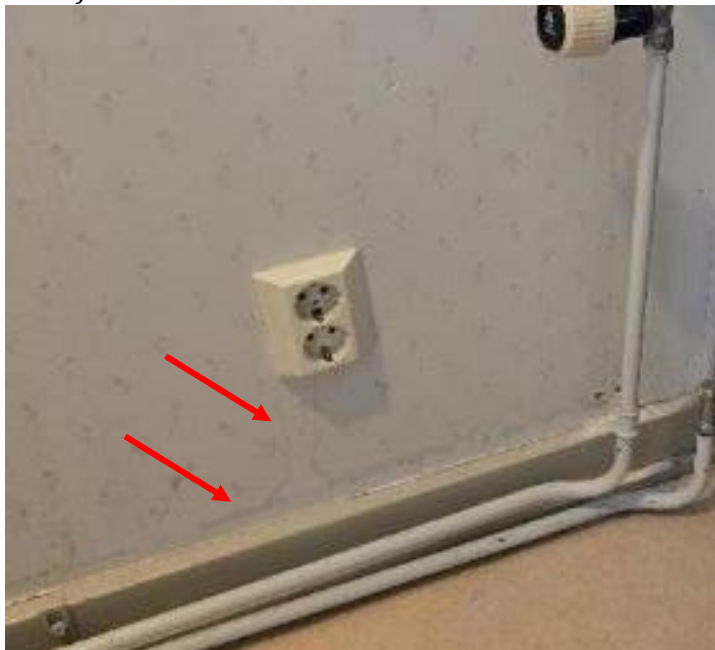
Kuva 36. Seinien kulmissa on viitteitä ylimääräisestä kosteudesta.
