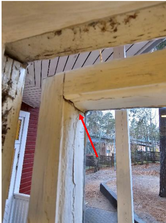
Kuva 61. Pokien ja karmien liitoskohdissa havaittiin halkeilua.
