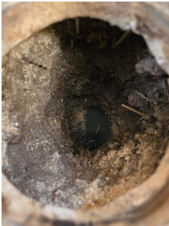
Kuva 88. Alapohjan eristeenä on vaurioherkkää orgaanista luonnonmateriaalia.
