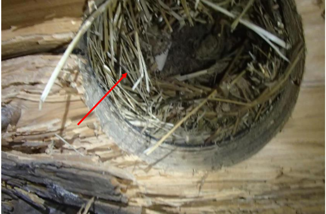
Kuva 92. Alapohjassa havaittiin avoimia reikiä.
