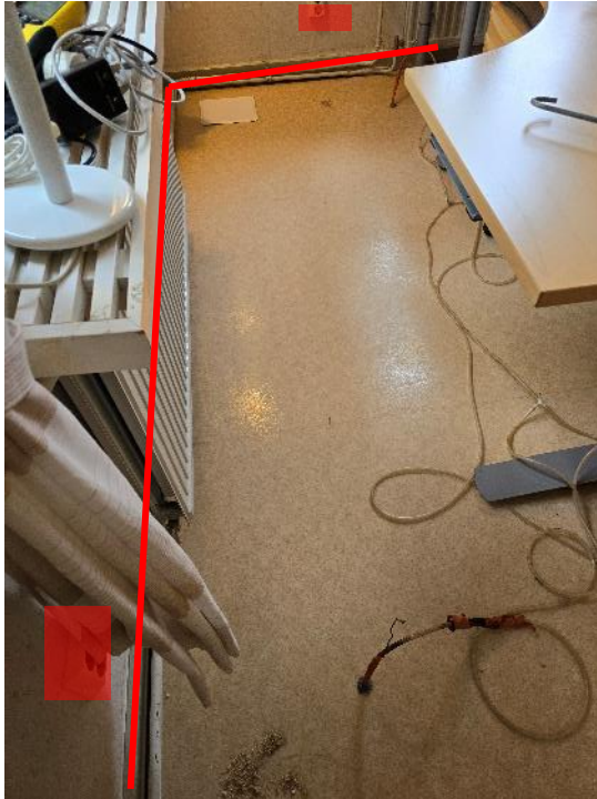
Kuva 139. Johtajan huoneessa havaittiin ilmavuotoa lattioiden rajapinnoilta ja pistorasia kautta.
