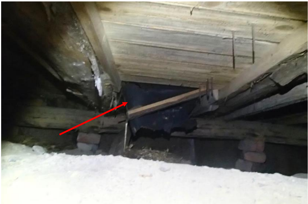
Kuva 106. Paikoin alalautoitukset ovat romahtaneet.
