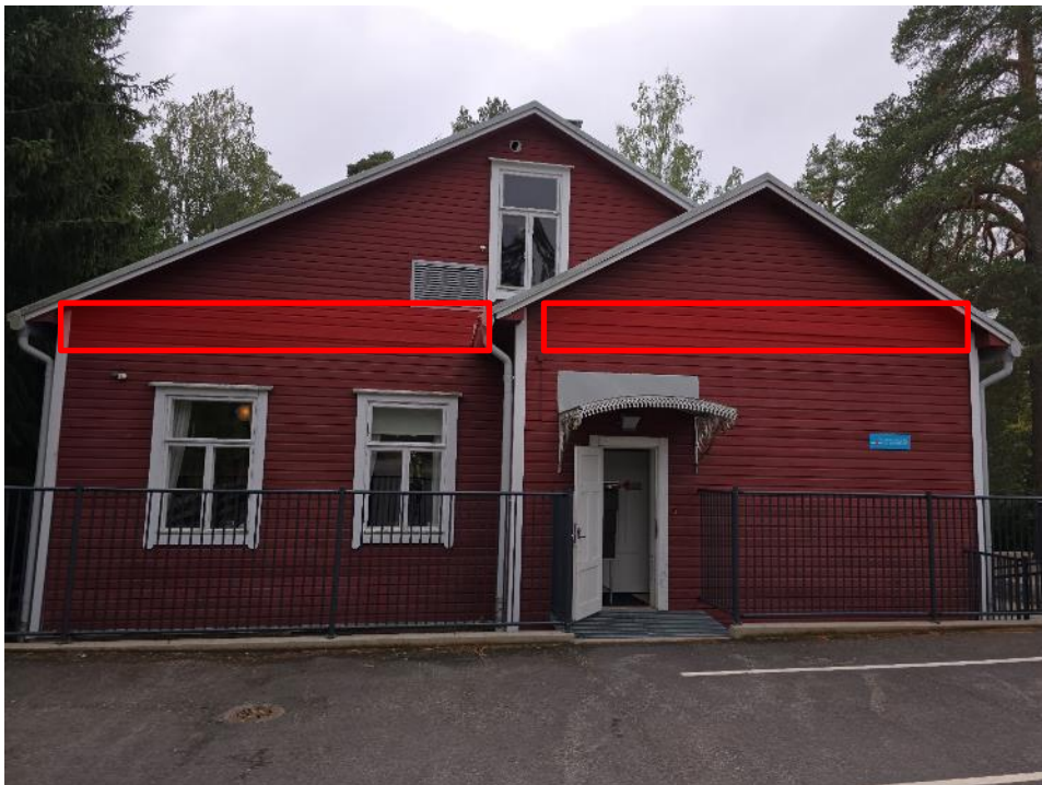
Kuva 18. Ulkoverhouspaneelissa havaittiin pullistumista yläpohjan alueella.
