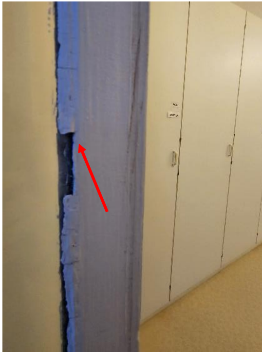
Kuva 69. Lasituskittausvaurioita havaittiin myös ikkunoiden välitilassa.
