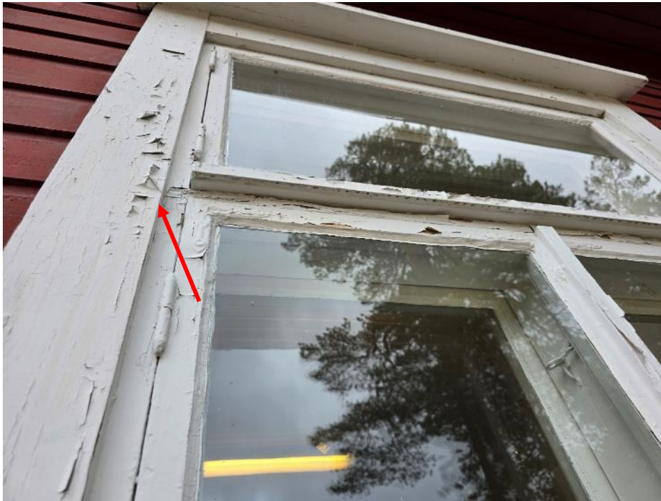
Kuva 25. Ikkunoiden vuorilaudoissa havaittiin maalivaurioita.
