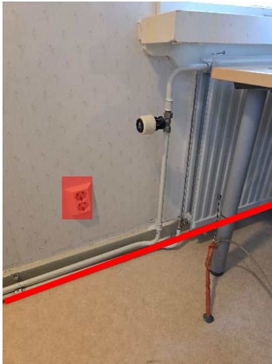
Kuva 141. Johtajan huoneessa havaittiin ilmavuotoa lattioidenraajapinnoilta ja pistorasian kautta.
