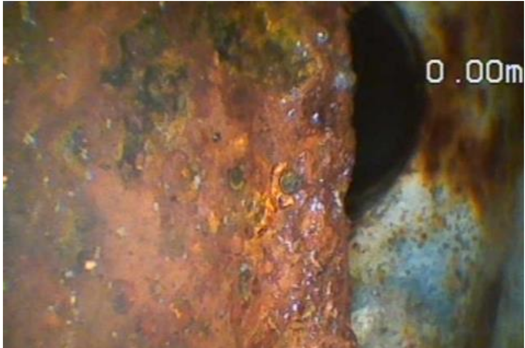
Kuva 113. Henkilökunnan pukuhuoneen suihkuhuoneen kaivo. Kaivo on valurautaa, jossa on havaittavissa liitoksen kohdalla pistesyöpymää ja korroosiota. Kaivo on liitetty muoviputkeen.
