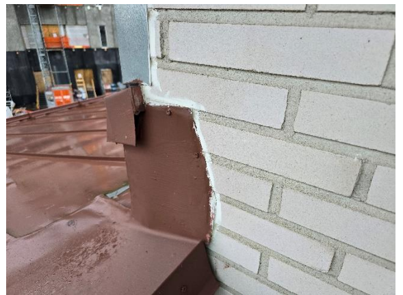
Kuva 71 Rakenneliittymä oli tiivistetty liimatiivistemassa-tyyppisellä massalla. Jälki hiukan rujoa.
