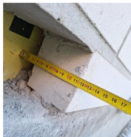
Kuva 54 Kahi-tiilen takana oli vain 35 mm tuuletusväli. Tuulensuojana oli paperipintainen eristevilla.
