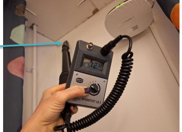
Kuva 16 Ulkokulman seinän pintakosteus vaihteli välillä 71...78.
