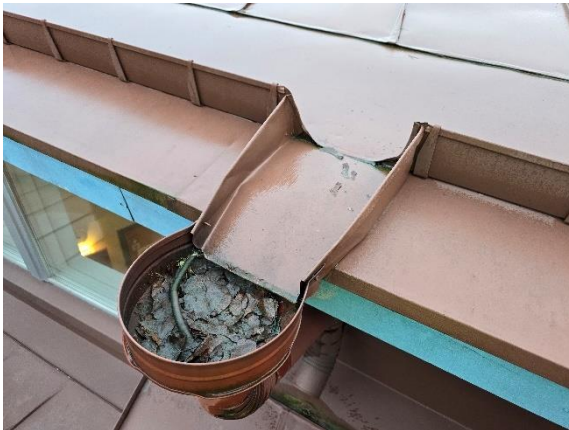
Kuva 64 Ylemmällä katolla oleva tukos syöksyputkessa.
