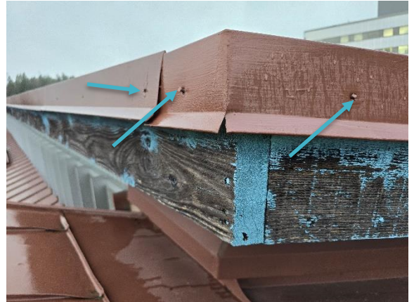
Kuva 69 Ylempien osien räystäslautojen maalipinta oli kulunut lähes kokonaan pois alkuperäisosalla. Muutamin paikoin peltien kiinnitykset irronneet alustastaan.
