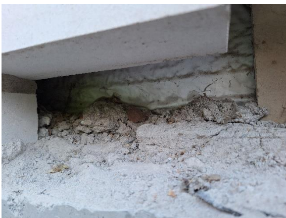
Kuva 41 Avauksen RA7 kohdalla tuuletusväli on paremmin avoinna.
