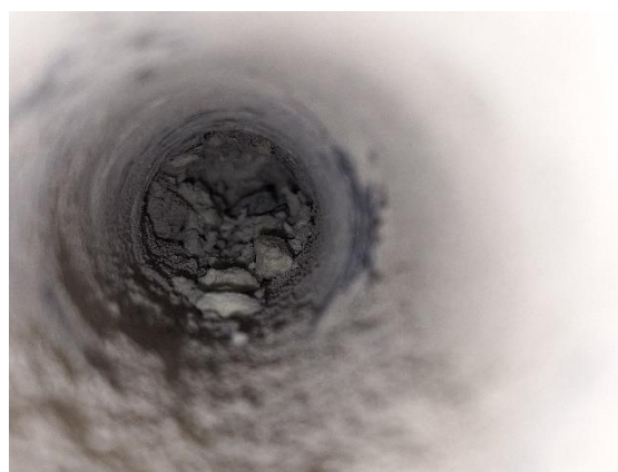
Kuva 46 Sokkelin betonin vahvuus oli 170 mm ja sen takana oli noin 55 mm paksu XPS-eriste.
