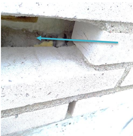
Kuva 35 Tuuletusväli on ummessa laastipurseista kahden alimman tiilirivin verran eli noin 125 mm verran sokkelin yläpinnasta.
