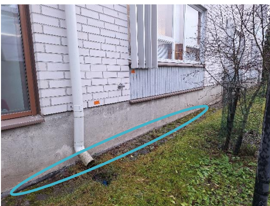
Kuva 59 Bitumi oli irronnut sokkelibetonista myös laajennososalla.
