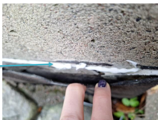
Kuva 48 Bitumikermi oli irti syöksytorven takana. Kermiin yläpintaa on yritetty tiivistää valkoisella tiivisteellä.
