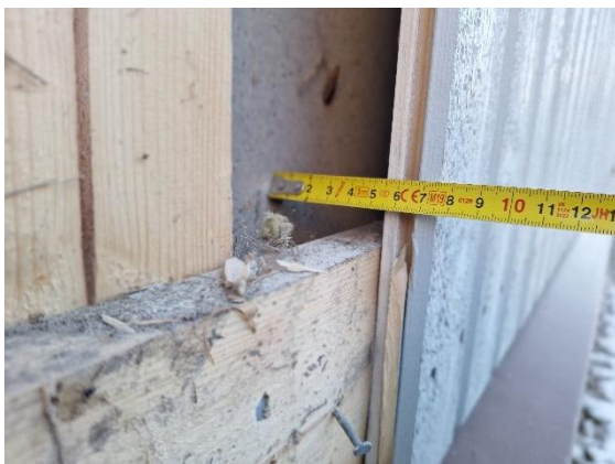
Kuva 51 Julkisivulauta oli 20 mm paksu ja sen takana oli 55 mm syvä tuuletusväli.
