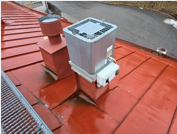
Kuva 62 Vesikatteella oli muutamia yksittäisiä maalipuut- teita.
