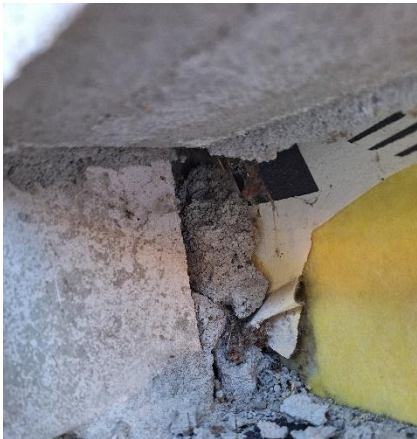
Kuva 55 Tuuletusväli oli toiselta puolen tukossa.
