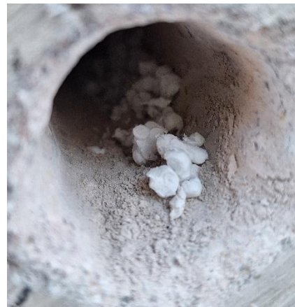
Kuva 58 Sokkelibetoni oli 180 mm paksua ja sokkelihalaisussa oli 55 mm EPS-eristettä.
