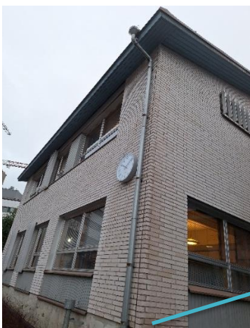
Kuva 29 Ongelmatila SK0007 ulkopuolelta. Syöksytornin yläosa on ollut tukossa ja kastellut ulkoseinää pidemmän aikaa.
