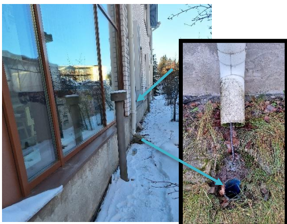
Kuva 49 Rakenneavaus RA9 ja RA10 tehtiin laajennos- osan tilan SK0015 kohdalle. Avauskohtien vie- restä puuttui yksi sadevesikaivo.
