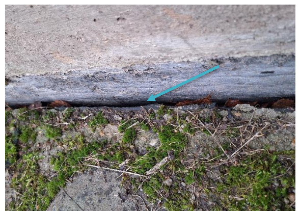
Kuva 60 Vesi pääsee bitumin ja sokkelin väliin yläreunasta.
