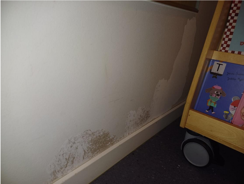
Kuva 4.10. Seinämaalia irtoilee lähes kaikissa tiloissa.
