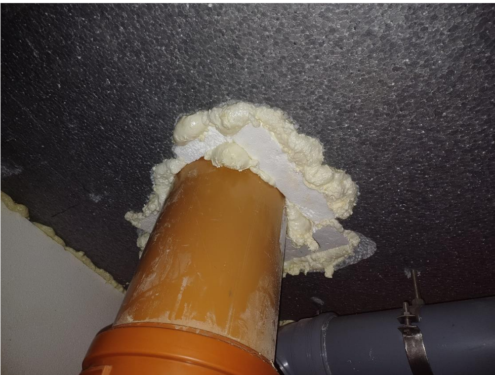
Kuva 4.9. Ryömintätila, jätevesiviemäreiden läpivienteihin ei ole asennettu palokatko-osia.
