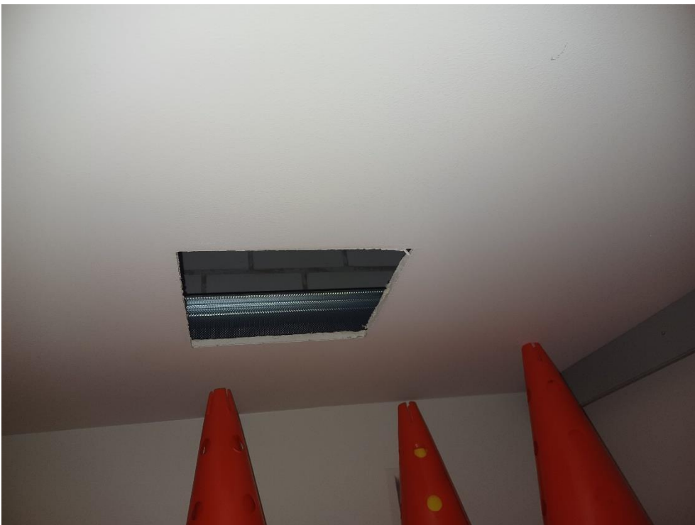
Kuva 4.7. 226 Varasto, alakatosta puuttuu tarkastusluukun kansi.
