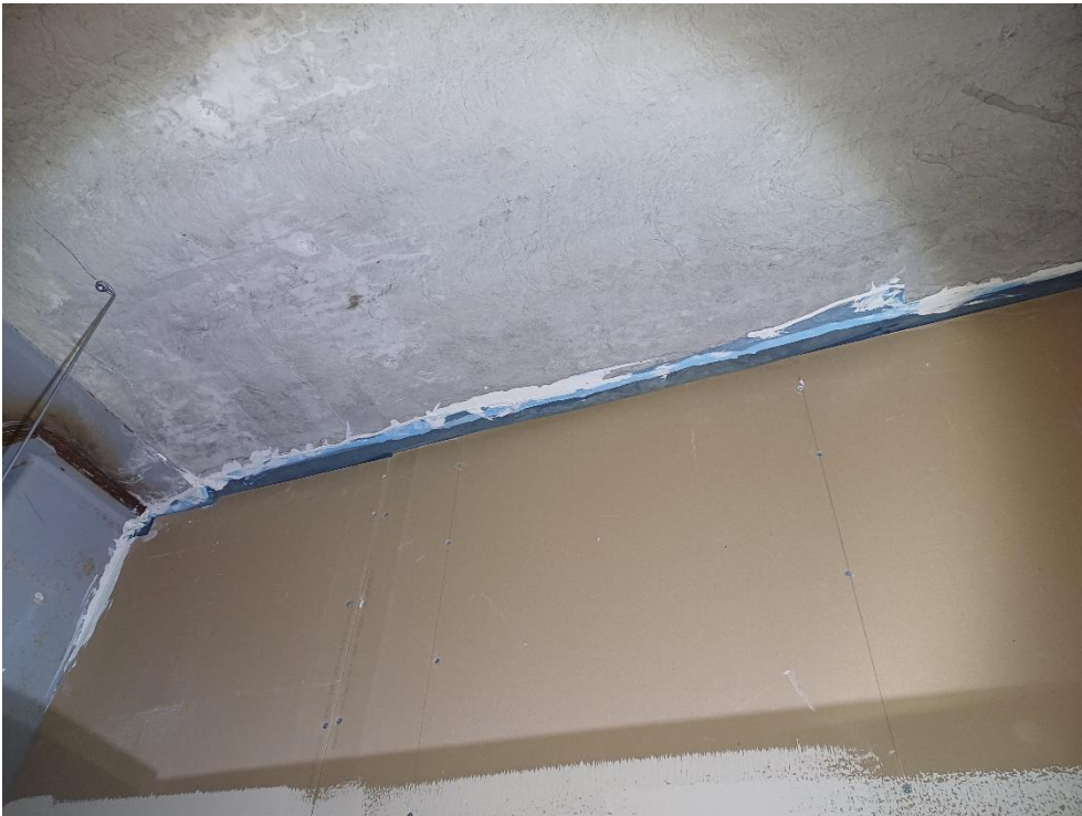
Kuva 4.13. Puurakenteisten osien höyrösulun liitoskohtien tiiveys ilmavuotojen osalta on epävarmaa.
