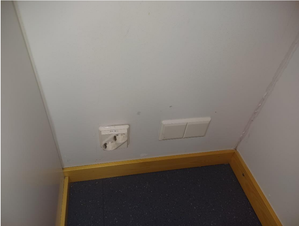
Kuva 4.12. Ulkoseinärakenteisiin asennettujen sähkörsioiden tiiveys ilmavuotojen osalta on epävarmaa.
