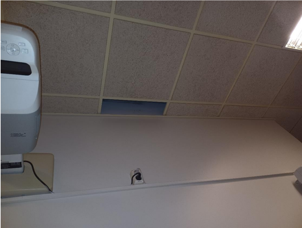
Kuva 4.6. 225 Liikuntasali, alakatosta puuttuu levyelementti.
