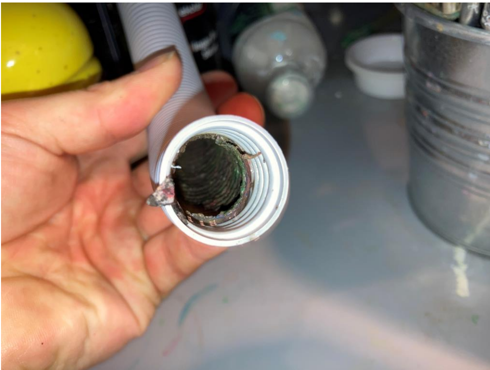
Kuva 5.3. Pesualtaiden viemärit ja ylivuotoputket ryhmätiloissa paikoitellen likaiset. Ylivuotoputkiin jäänyt lika saattaa päästä tilaan tunkkaista maakellarin tapaista hajua.
