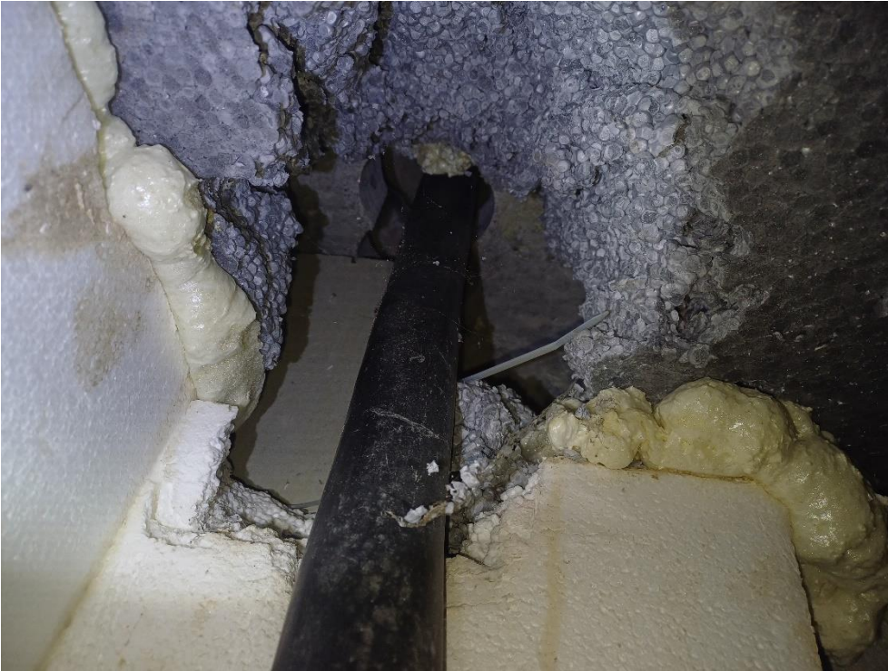
Kuva 4.8. Ryömintätila, osa ylöspäin menevistä läpivienneistä ei ole tiiviitä.
