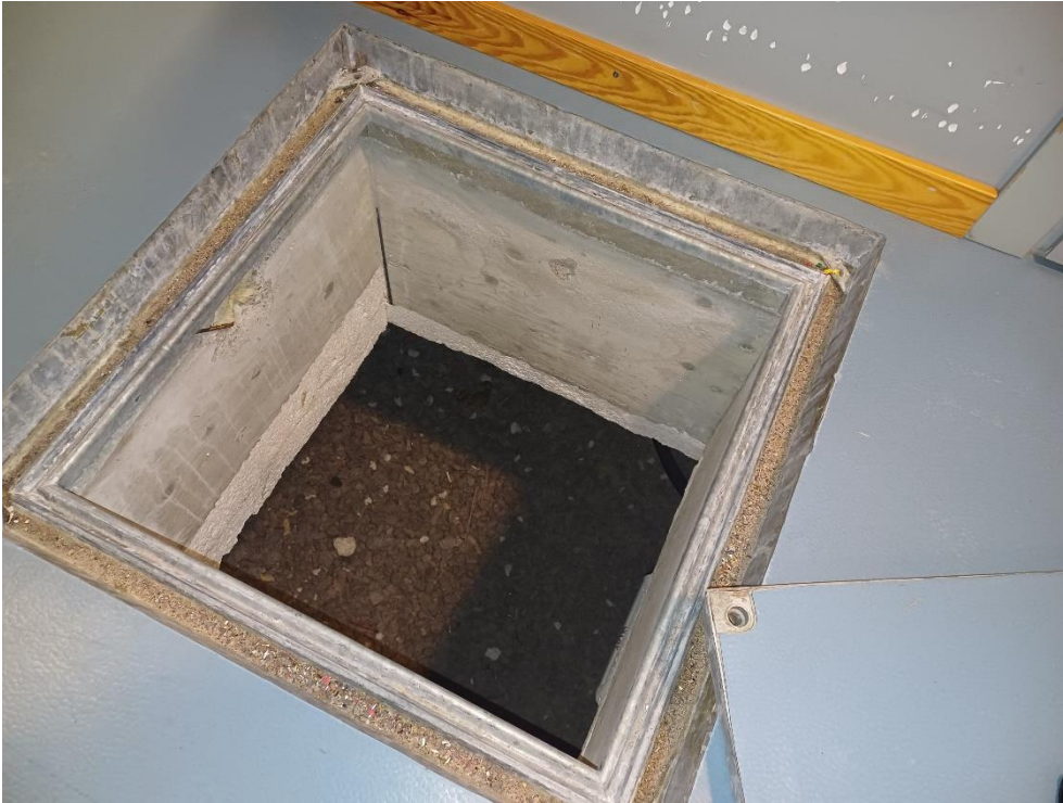
Kuva 4.4. 141 Käytävä, alapohjan kaasutiivistä kulkuluukkaa ei ollut kiinnitetty siihen tarkoitetuilla pulteilla, lisäksi luukusta puuttuvat kumitiivisteet.
