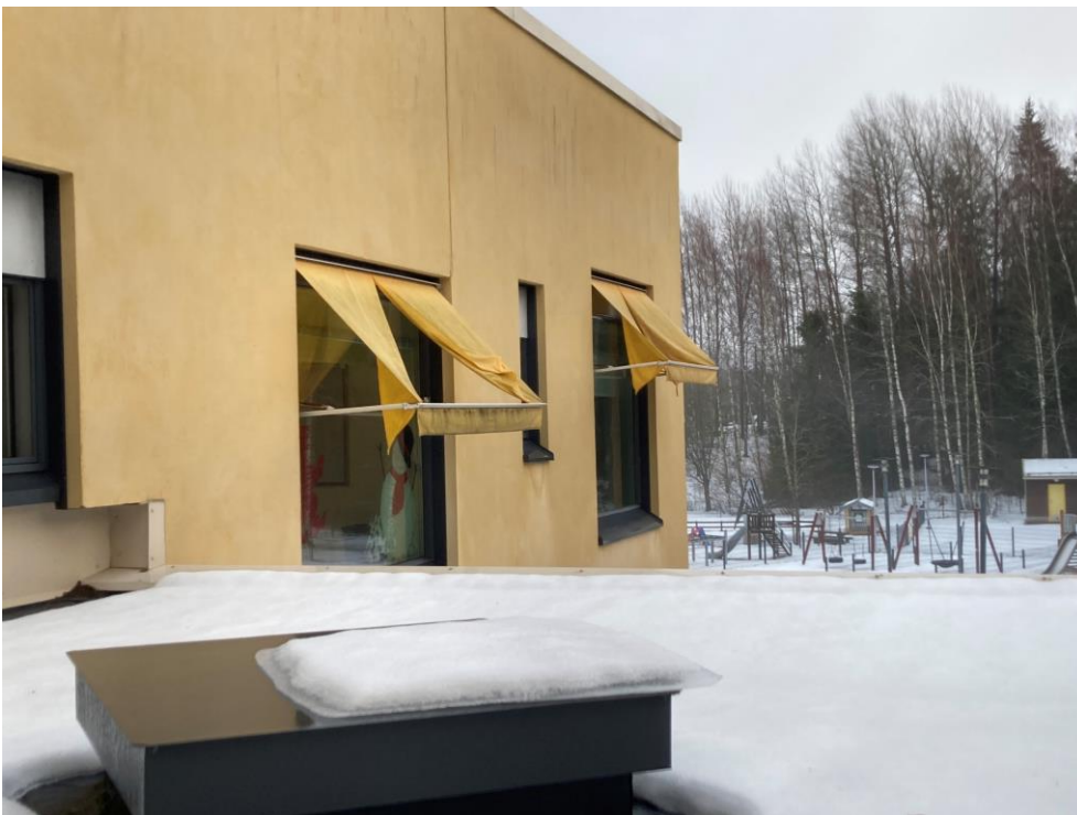
Kuva 4.15. Auringon lämpösäteilyn suojaukseen tarkoitettuja markiiseja ovat repeytyneet useiden ikkunoiden kohdilla.
