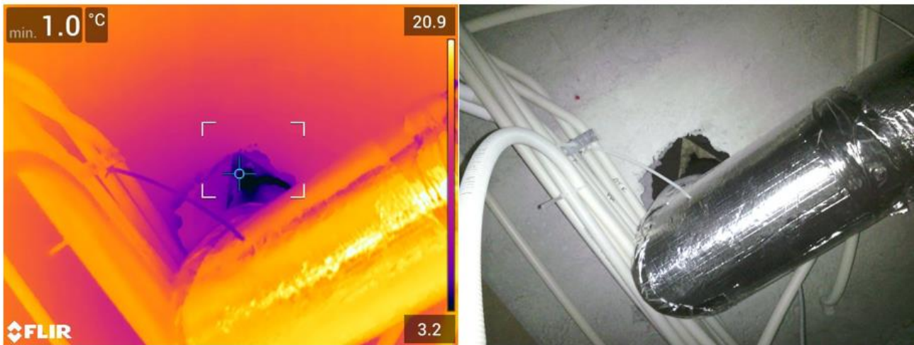
Kuva 4.14. Katon sadevesiviemäreiden läpiviennit vesikaton läpi eivät ole tiiviitä useassa tilassa.
