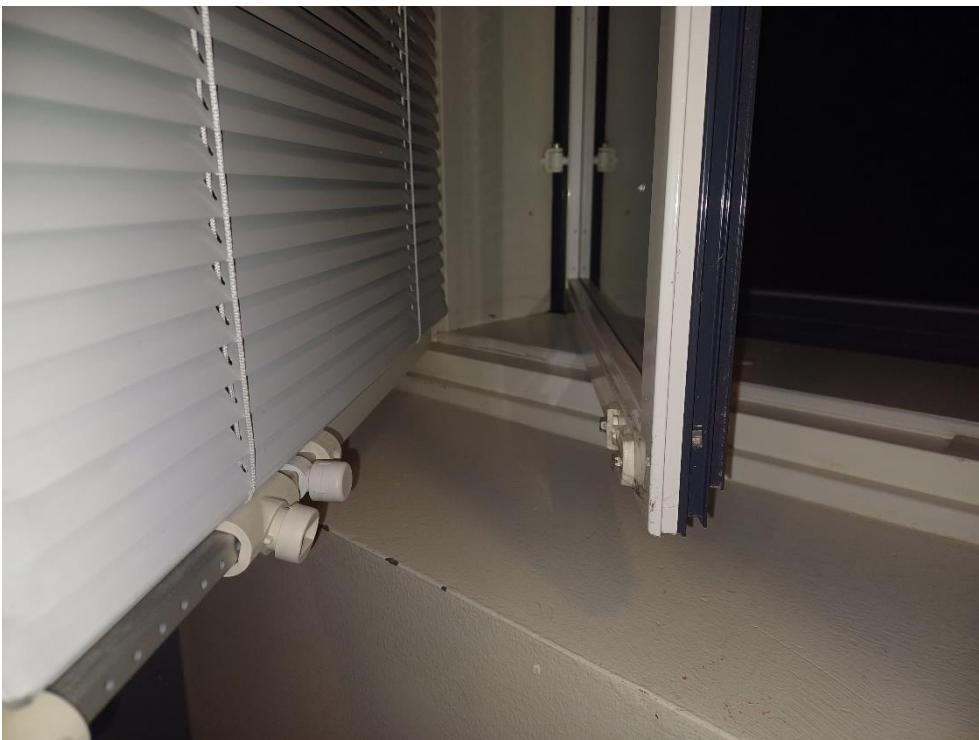
Kuva 4.11. Tuuletusikkunoiden aukipitolaitteita on rikkoutunut useissa tiloissa.
