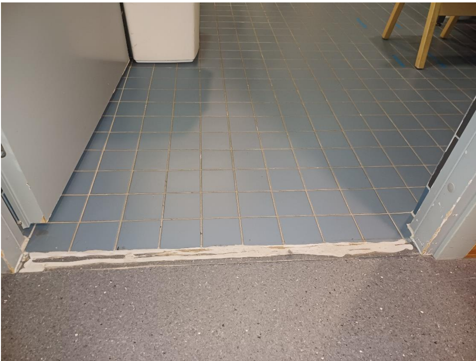
Kuva 4.1. 105 WC-tila, oviaukon kynnysosa puuttuu.
