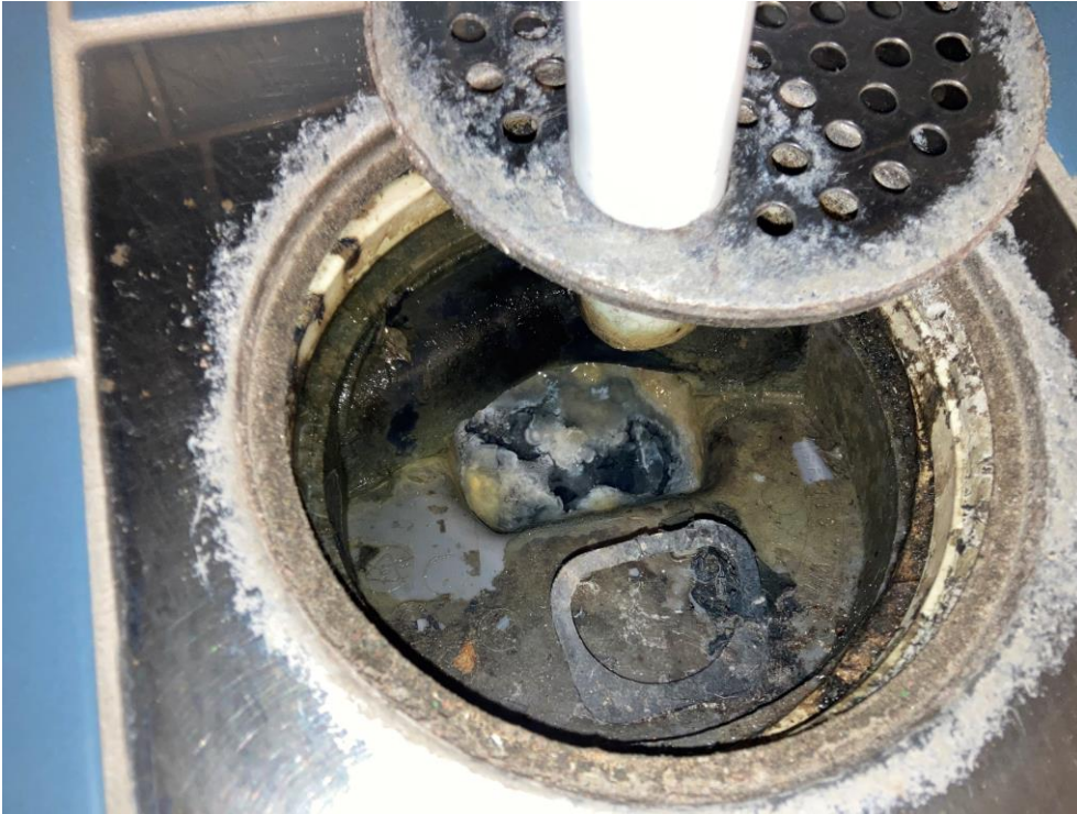
Kuva 5.2. Lattiakaivo likainen tilassa 105. Likainen lattiakaivo saattaa tuoda tilaan tunkkaista hajua.
