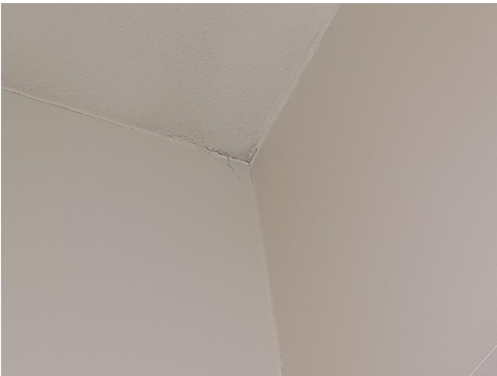
Kuva 4.3. 121 Lepuhuone, seinä-kattonurkkaliittymässä on ilmavuotojälkiä.
