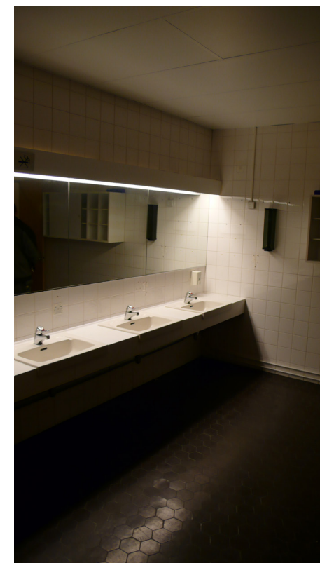
Kuva 55. Liikenne- ja aputilatornissa sijaitsevien saniteettitilojen alkuperäiset vesikalusteet. JRT Oy, 2008.
